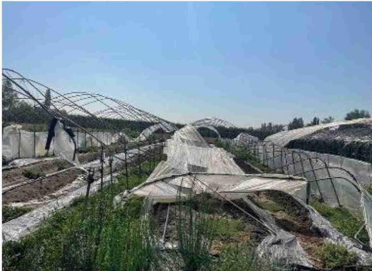
Una serra distrutta dalle raffiche di vento
