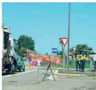
L'impianto semaforico da ieri in funzione sul ponte della Sp 66
