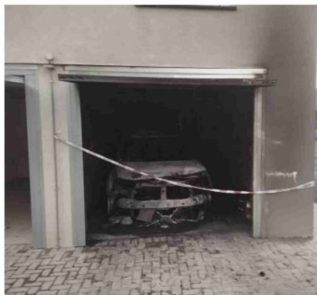
I danni causati il 17 ottobre dal secondo incendio doloso a Granarolo
