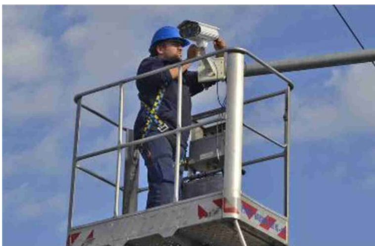
La manutenzione di una telecamera di videosorveglianza (foto d'archivio)
