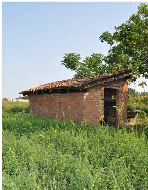
Foto 1. Vista del forno sul retro dell'abitazione
