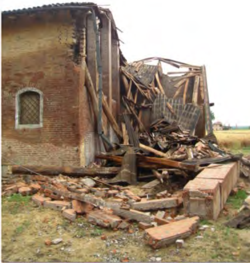
CROLLO PARZIALE DI UNA PARTE DELL'EDIFICIO
