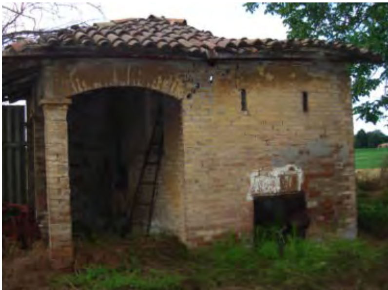
VISTA DELL'EDIFICIO CHE EVIDENZIA I PILASTRI FUORI PIOMBO E LE AMPIE LESIONE ALLE VOLTE
