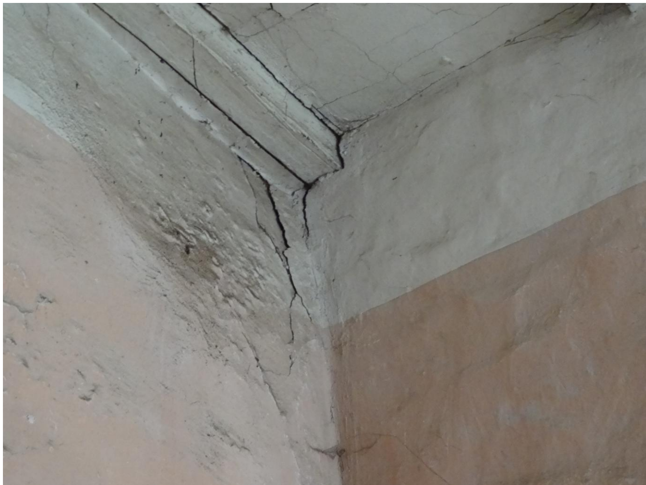
Foto 37- Martellamento degli elementi costruttivi e distacco del solaio dai muri
