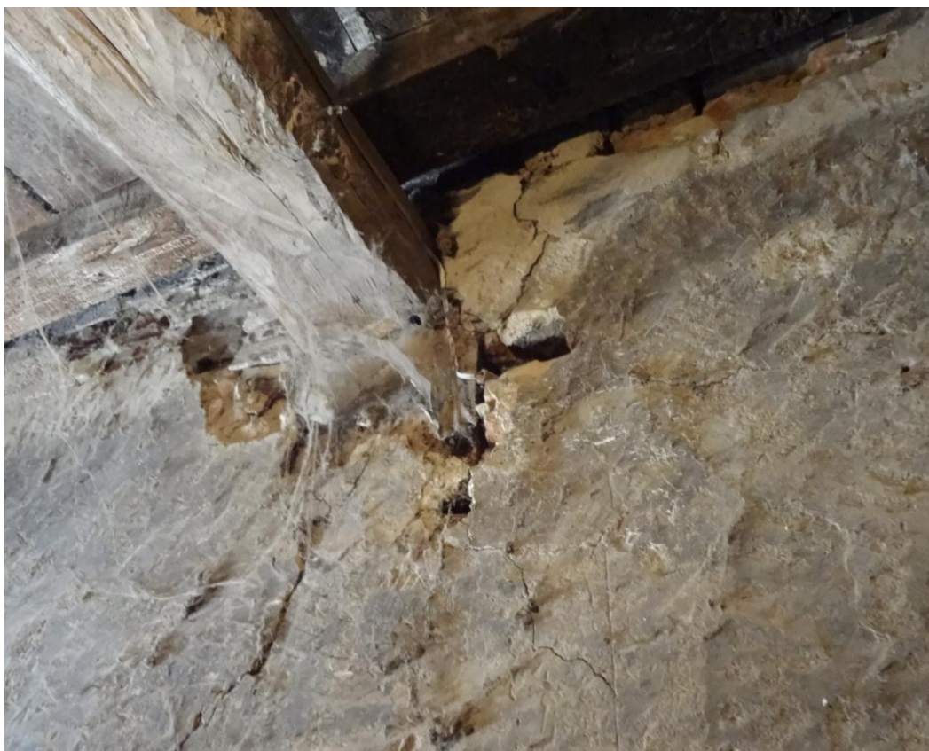
Foto 21 – Martellamento della trave con espulsione di materiali.
