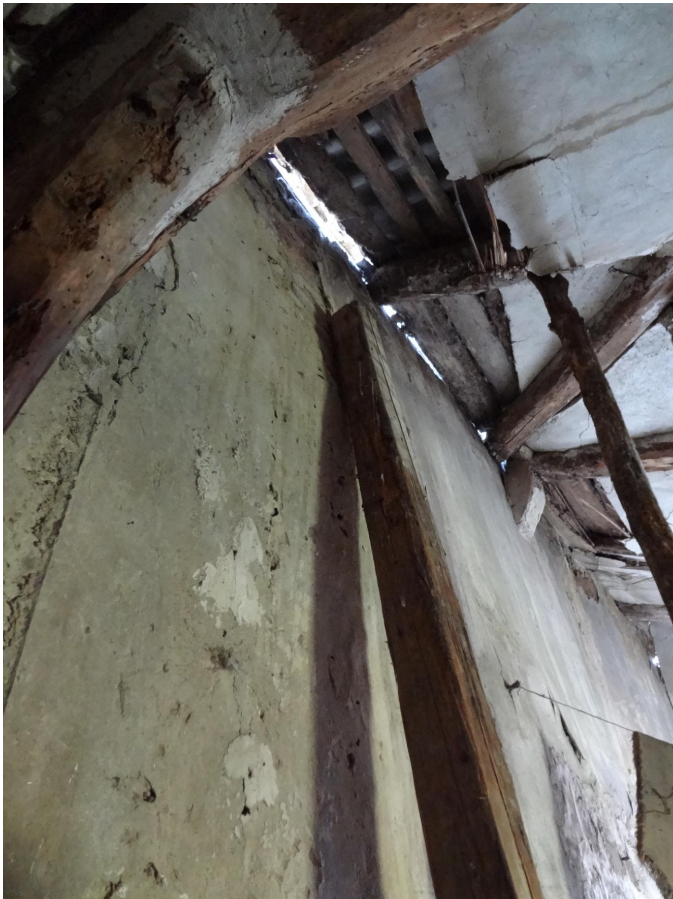
Foto 53 – Completo distacco della copertura dal muro portante
