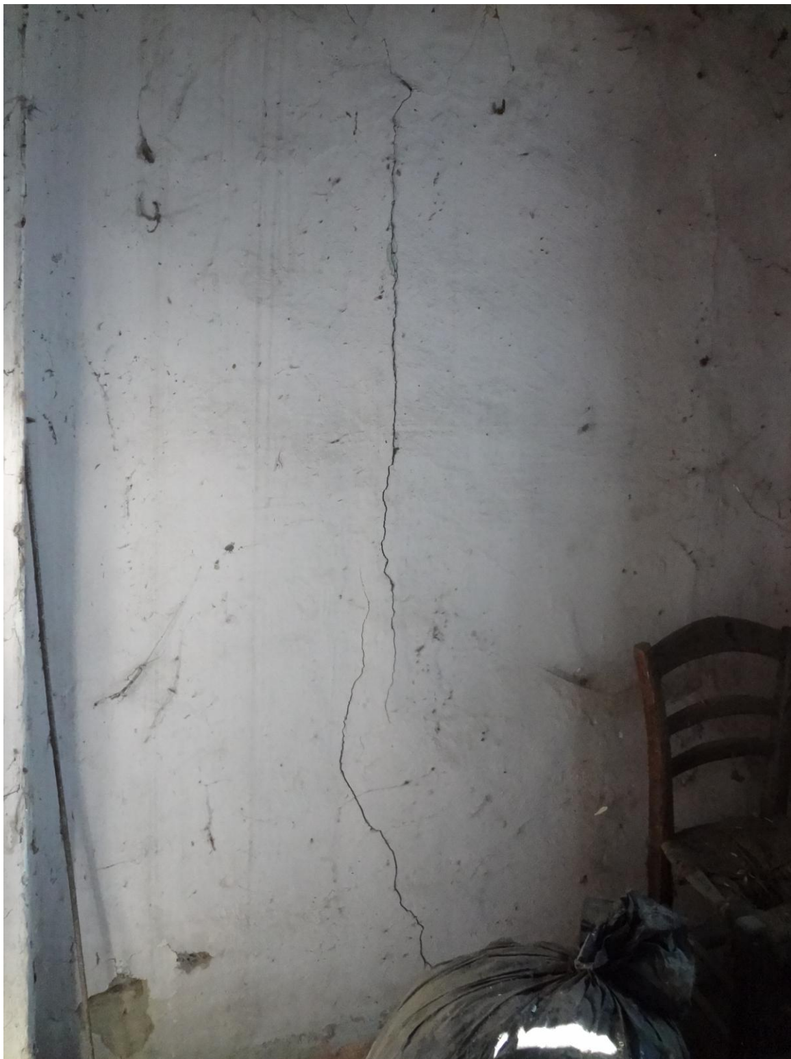
Foto 30 – Lesione verticale della muratura portante.
