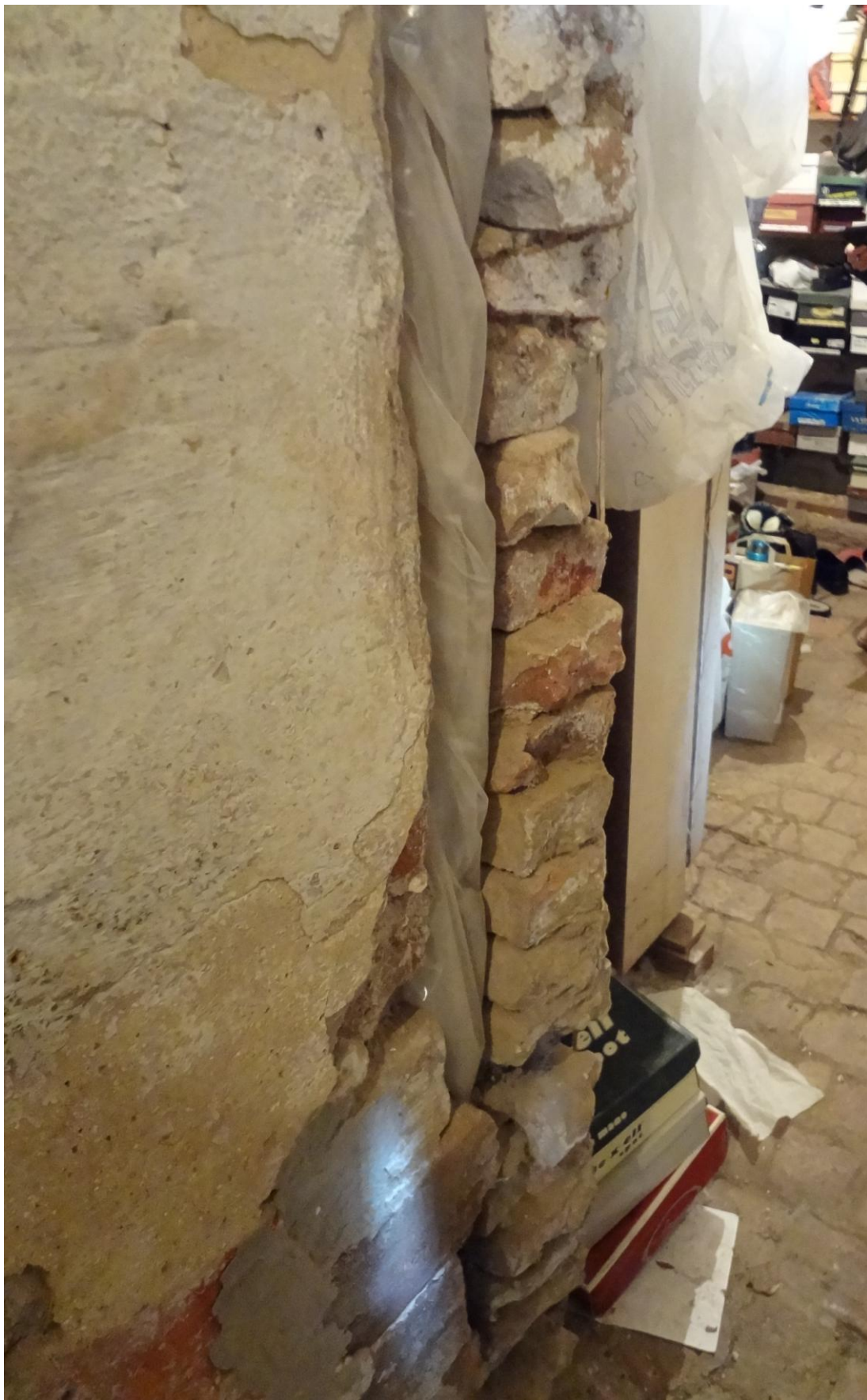
Foto 14 – Immagine della pessima tessitura muraria e dell'incoerenza della malta.
