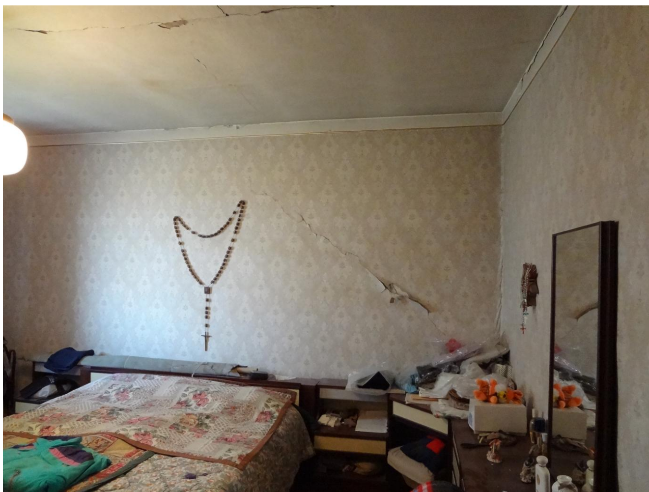
Foto 46 – Lesione diagonale da taglio passante.
