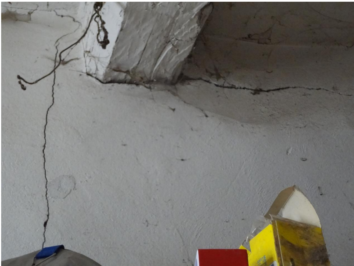
Foto 17- Lesioni da martellamento delle travi sui muri portanti.
