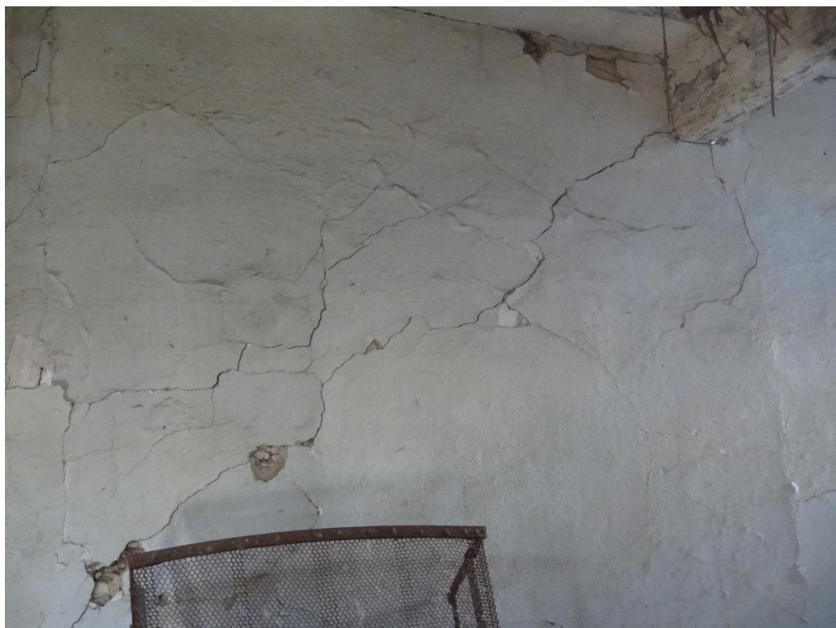
Foto 43 – Lesione diagonale a partire dall'appoggio della trave sul muro
