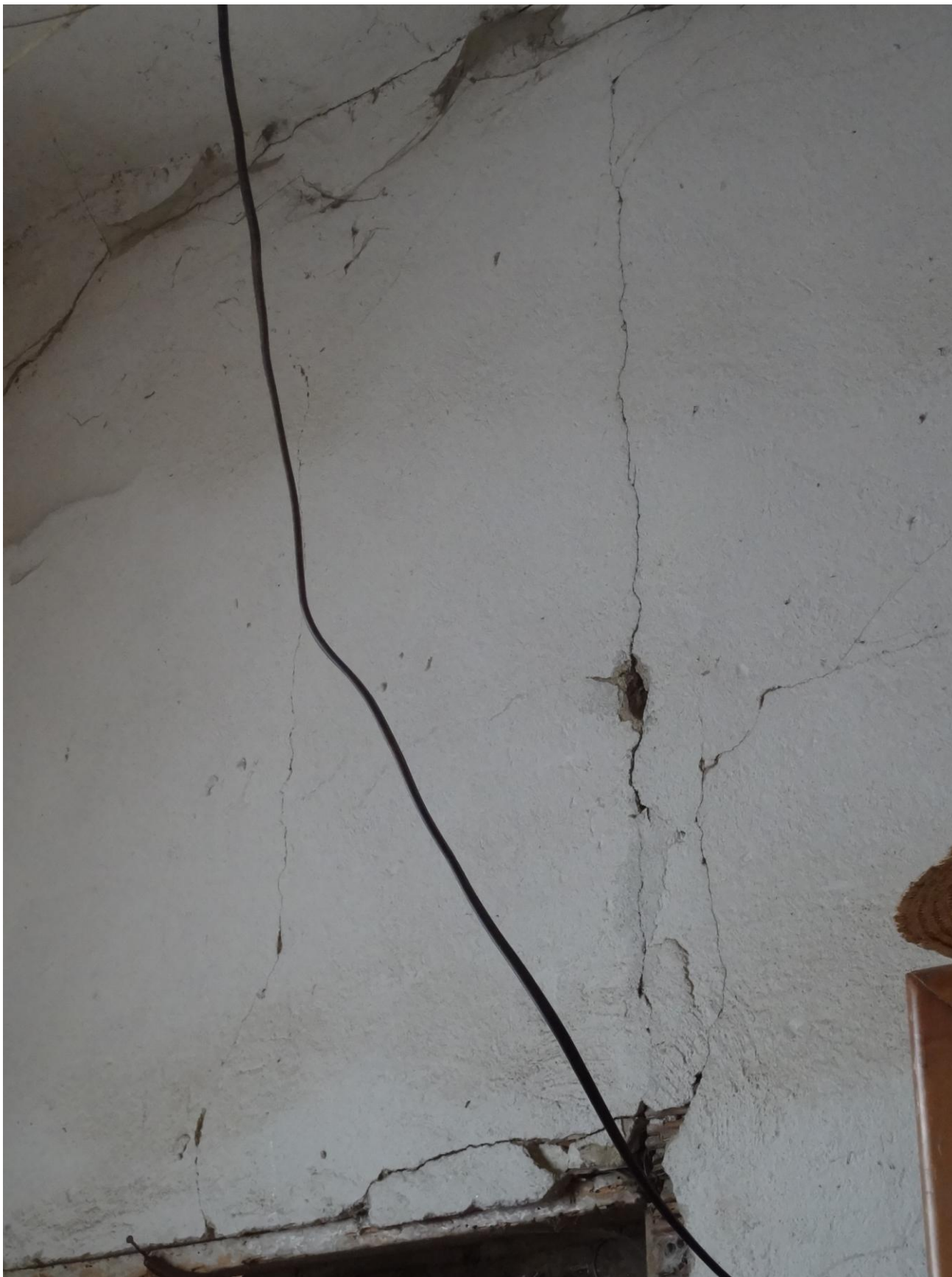
Foto 19- Lesioni verticali per flessioni sopra l'apertura della porta.
