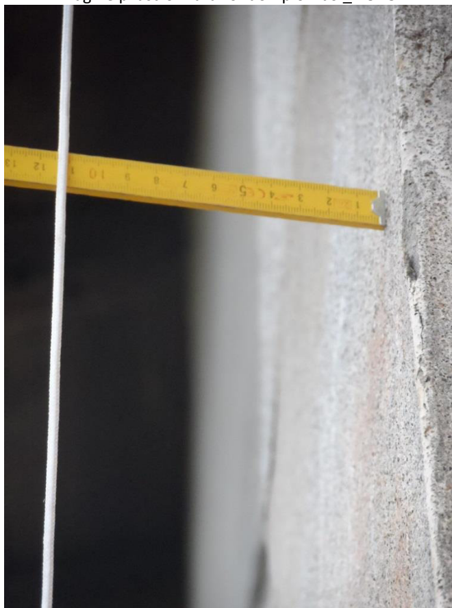
Immagine pilastro murario fuori piombo _ FOTO 41
