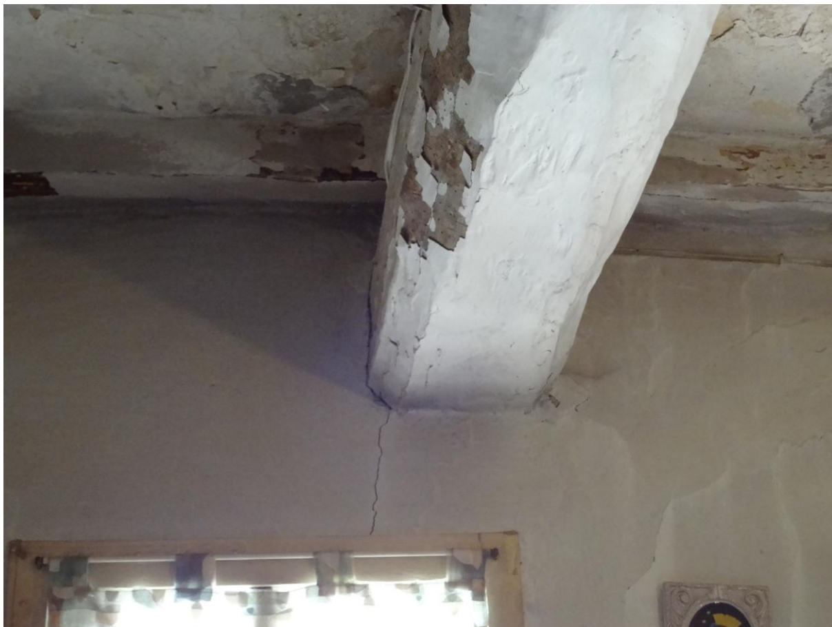
Foto 7- Punzonamento in corrispondenza dell'appoggio della trave.
