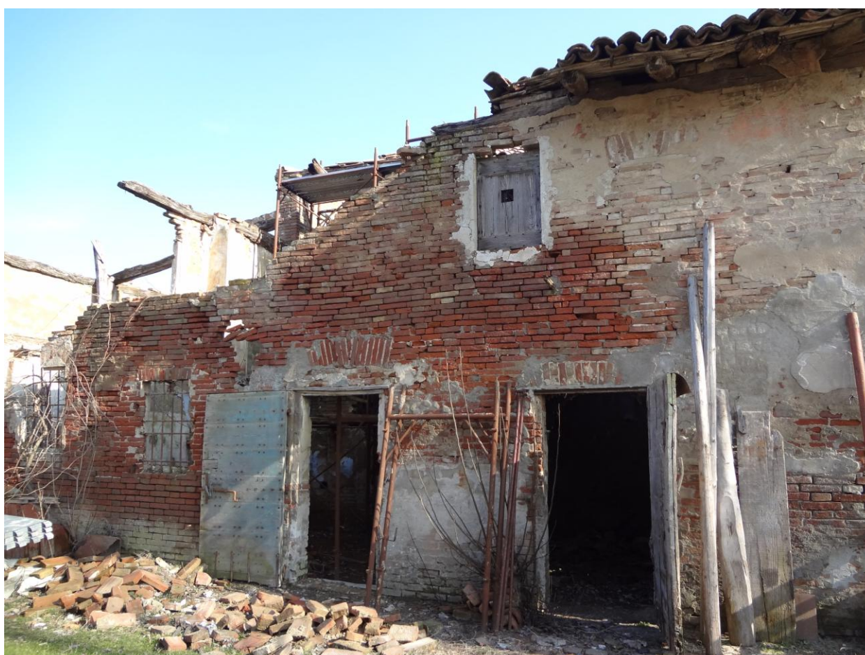
Foto 6- Vista lato Nord-Ovest già collabente prima degli eventi sismici.
