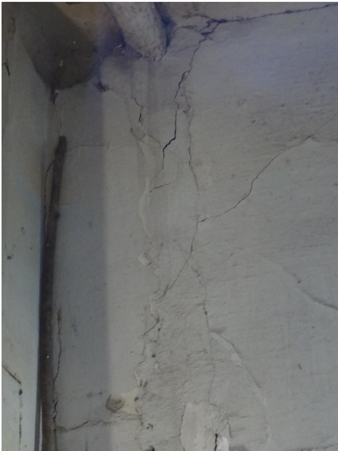
Foto 45 – Lesioni diffuse verticali e diagonali
