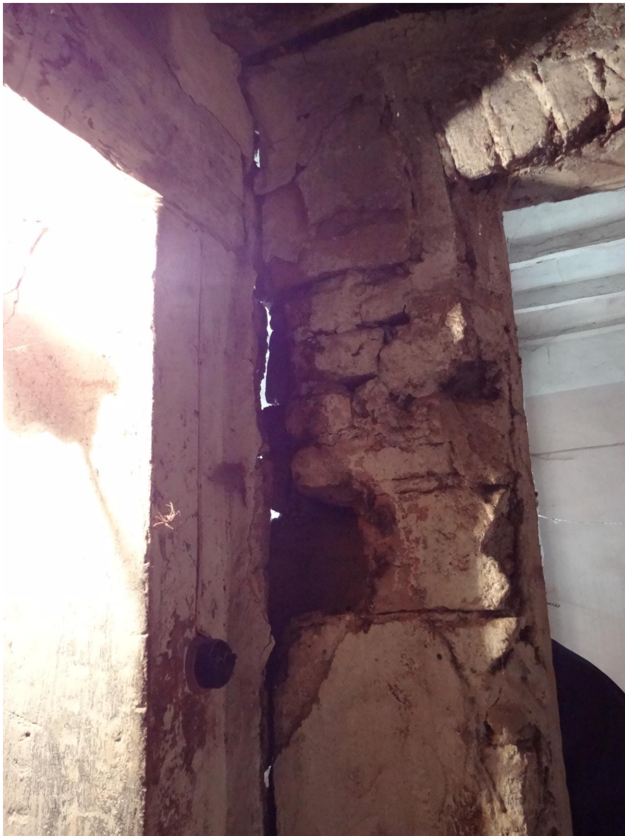
Foto 40 – Lesione verticale passante tra il pilastro in falso citato sopra nella foto 35 e il muro.
