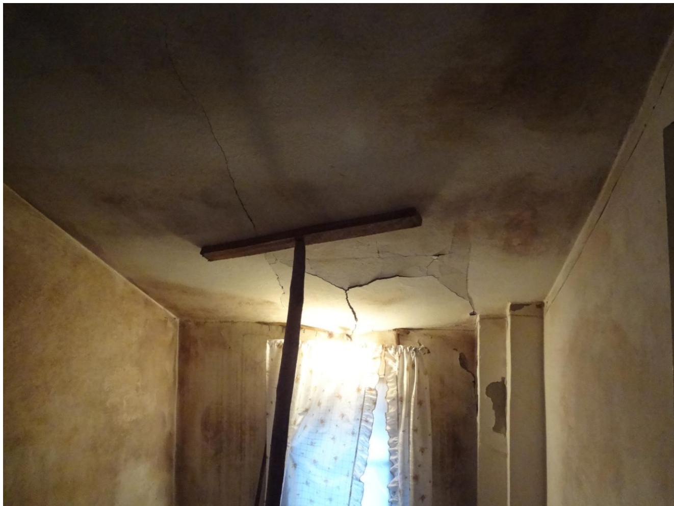
Foto 51- Gravissima lesione e parziale crollo del controsoffitto
