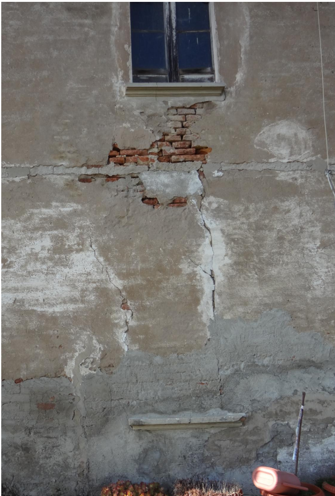
Foto 4- Vista di una lesione passante sul lato Sud-Est
