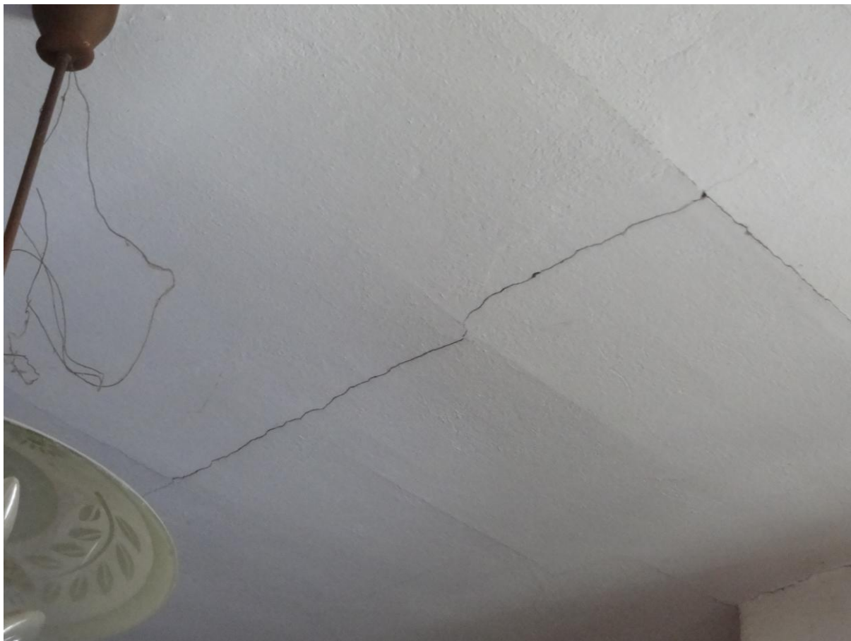
Foto 50 – Lesioni dei controsoffitti
