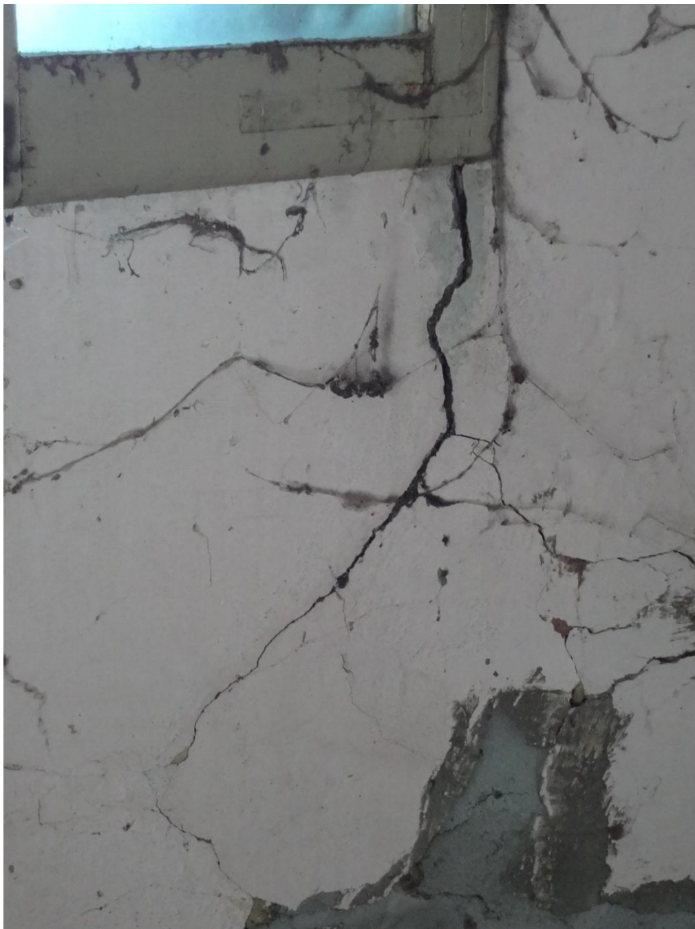
Foto 31 – Lesioni in prossimità delle aperture.
