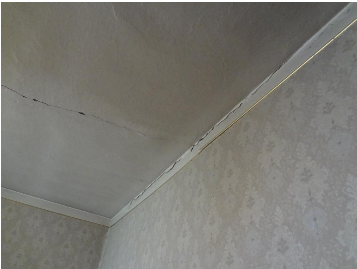
Foto 47 – Distacchi dei solai dai muri e lesioni dei controsoffitti
