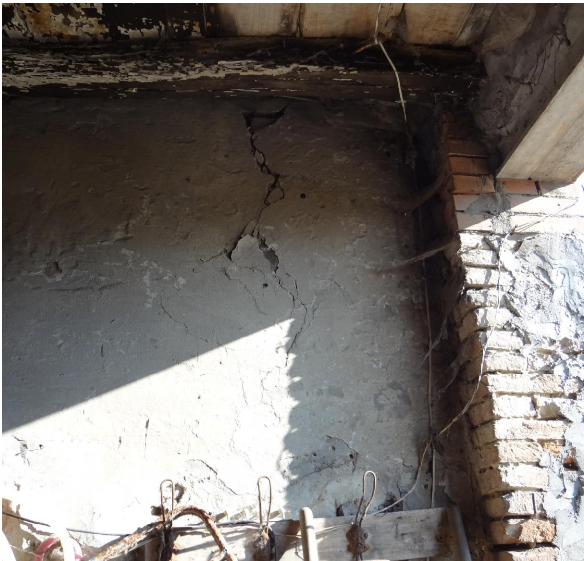
Foto 27- lesioni passanti su muro portante
