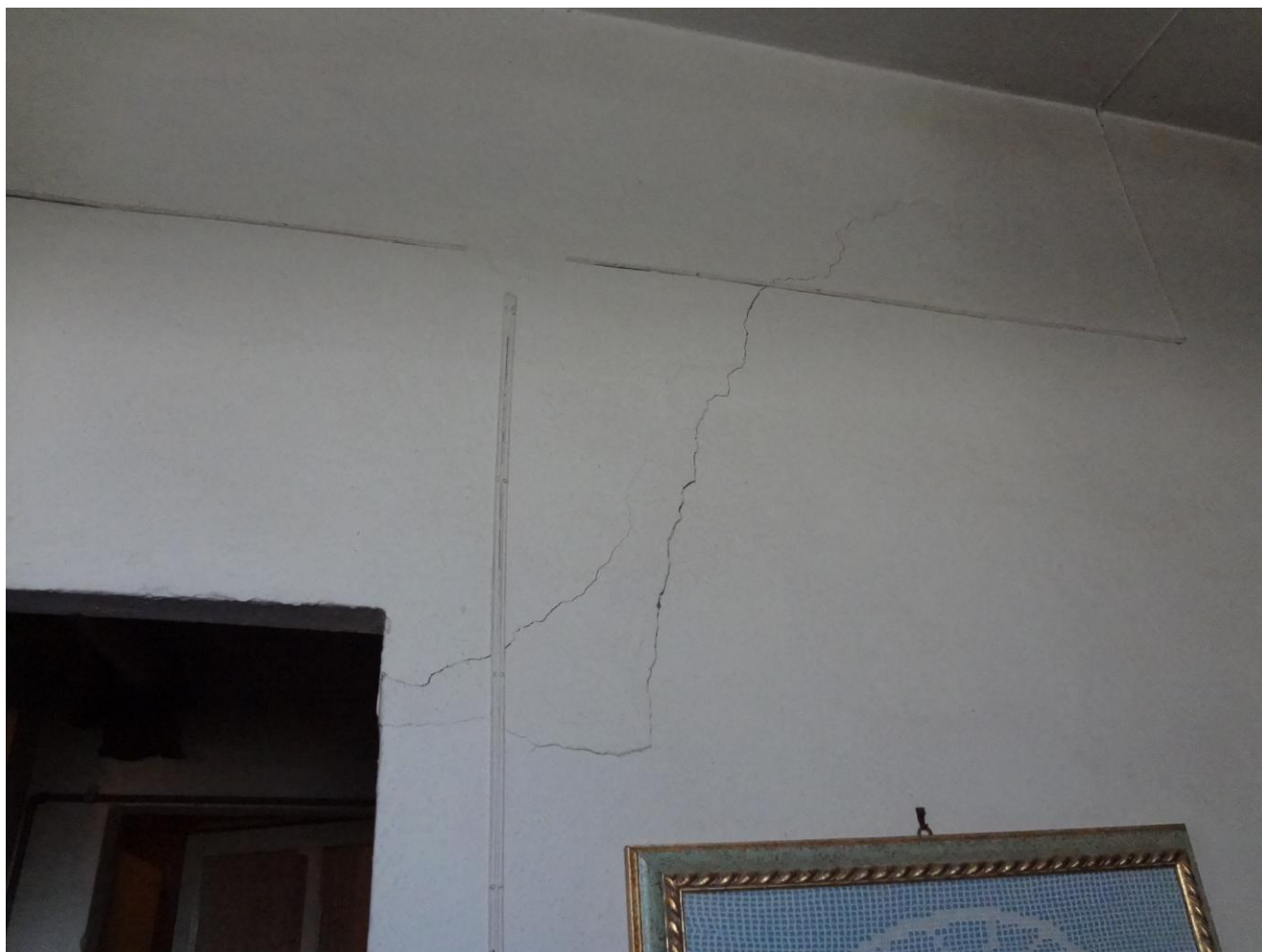
Foto 49 – lesioni diagonali sopra l'architrave della porta
