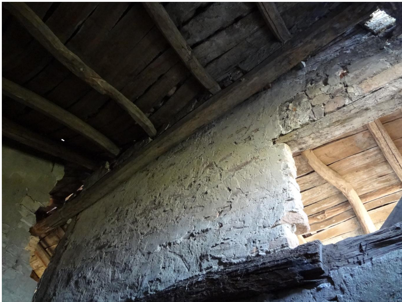
Foto 54 – Distacchi della copertura e lesioni dei muri portanti.
