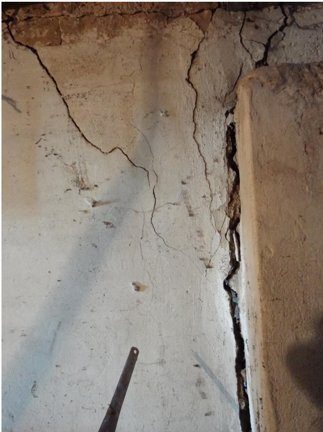
Foto 39 – lesione verticale d'angolo tra pilastro e muratura contigua.
