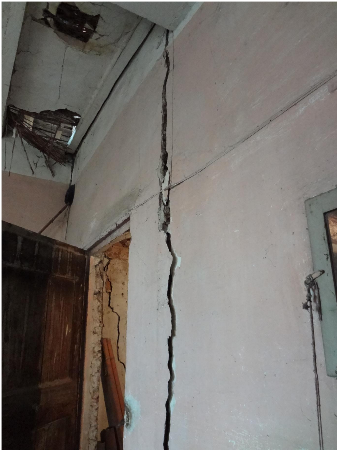
Foto 35 – Crepa passante verticale in corrispondenza dell'innesto di un pilastro portante nella stanza attigua in falso su un solaio.
