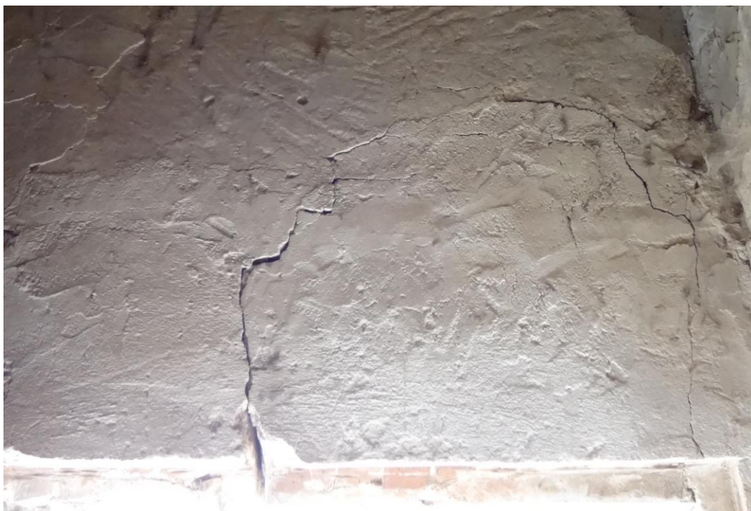
Foto 23 – Lesione per taglio sopra un'apertura con formazione di "arco immaginario" nella muratura
