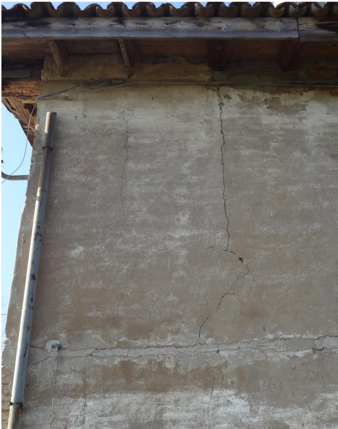
Foto 3 - Vista di una lesione passante sul lato Sud-Est
