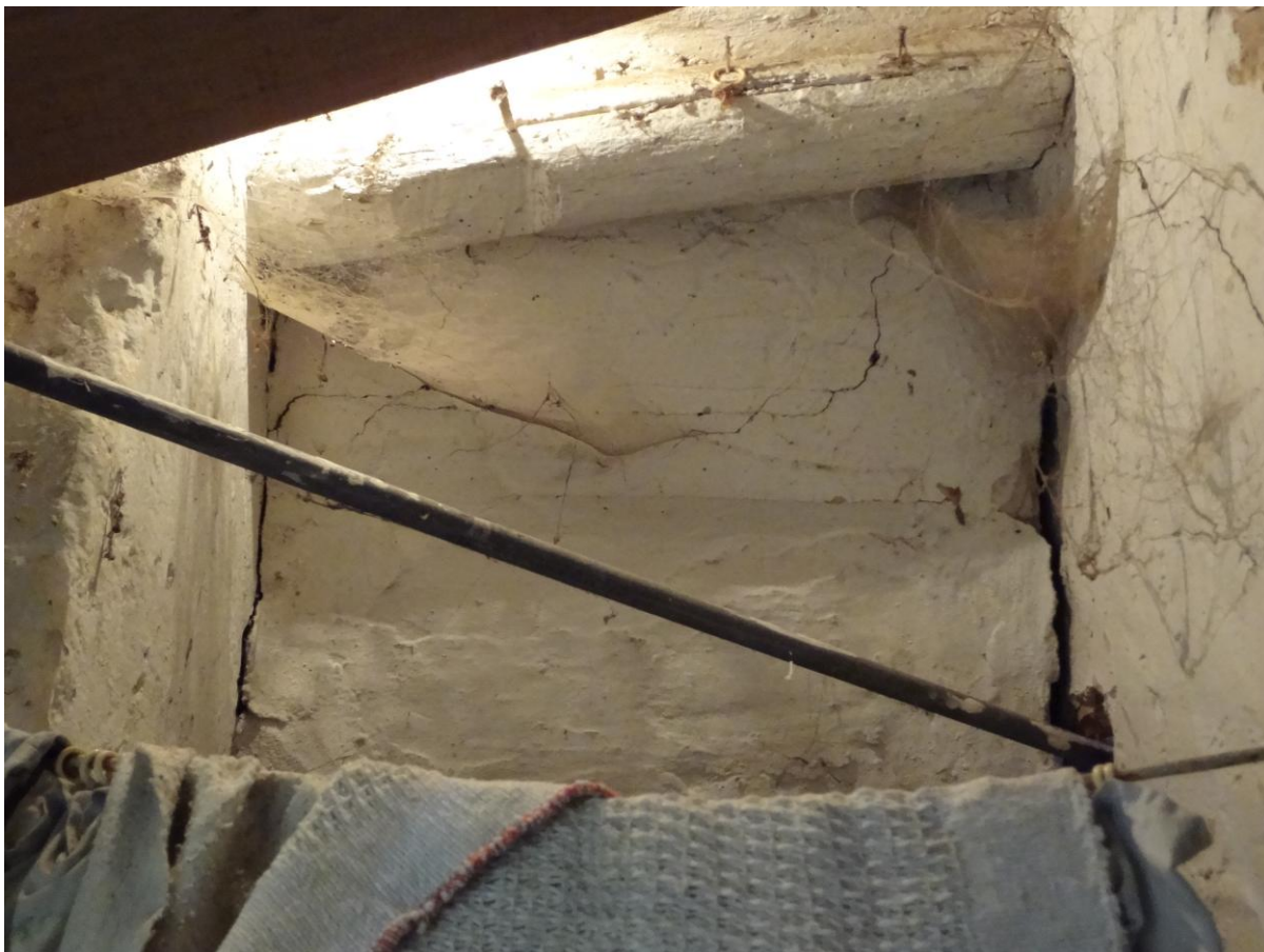
Foto 12- Evidenti distacchi della soletta della scala dai muri portanti laterali.
