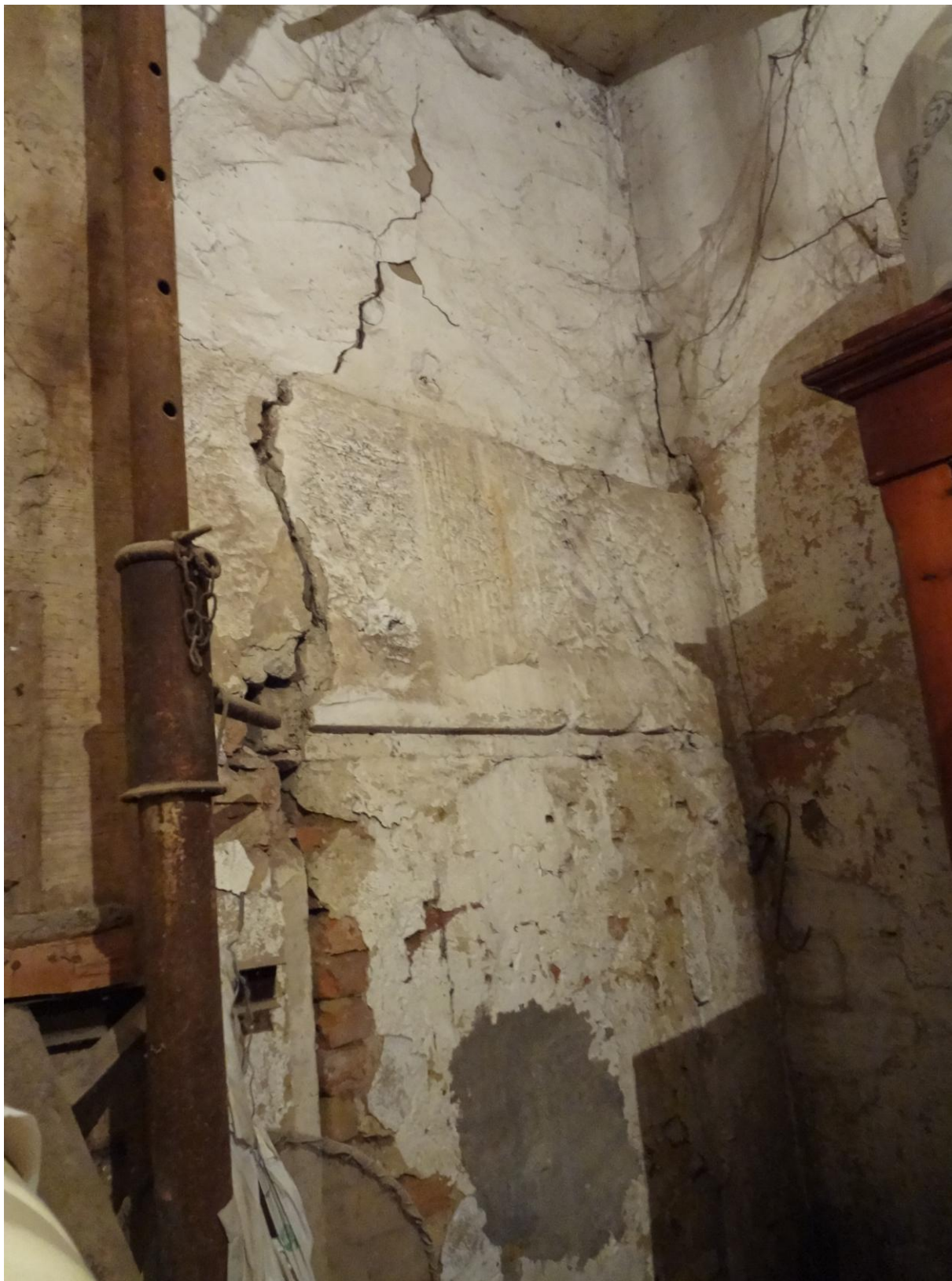
Foto 13- Lesione diagonale passante per taglio.
