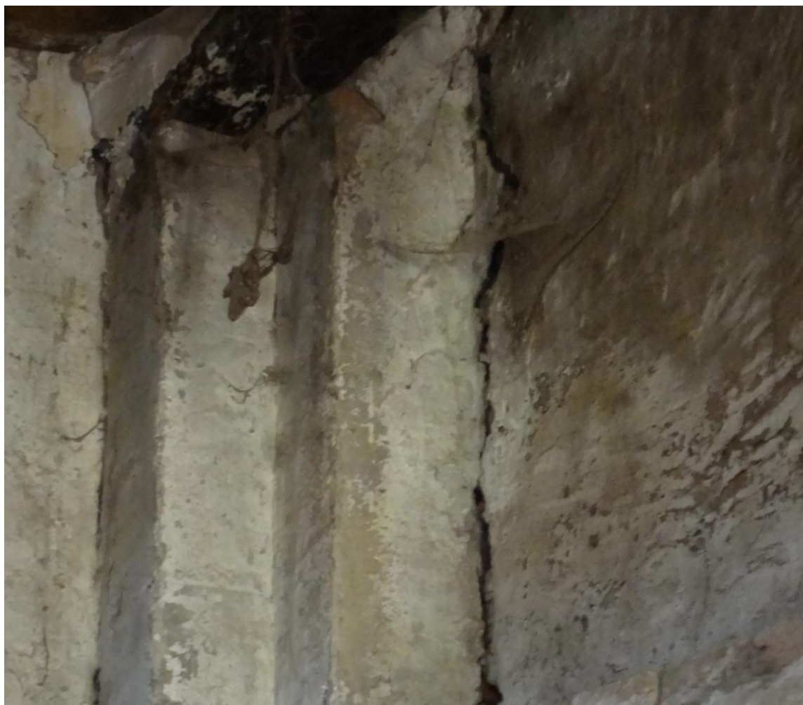
Foto 26 – Distacco tra due pareti d'angolo.
