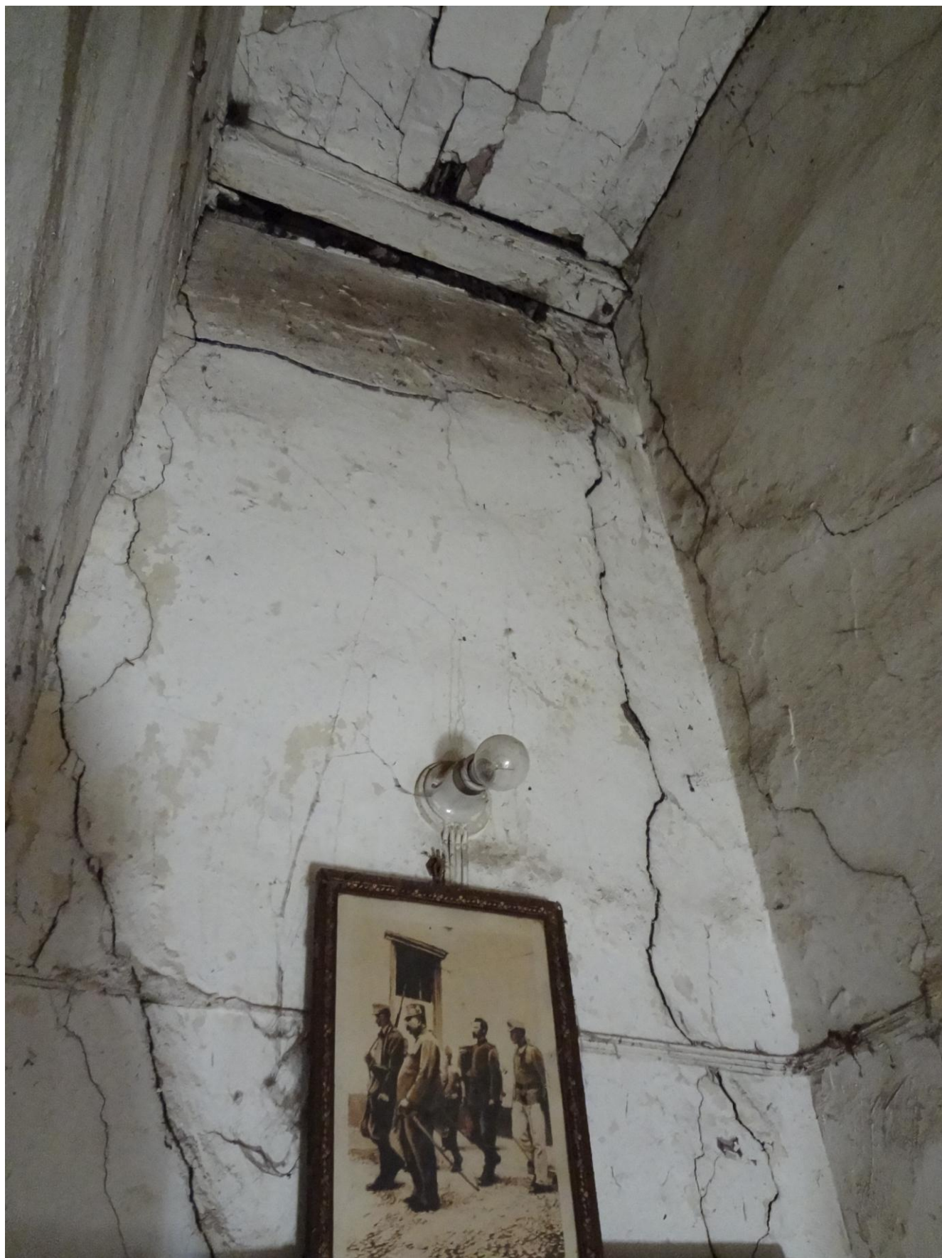
Foto 33 – Lesioni passanti da taglio e completo distacco del solaio dal muro.
