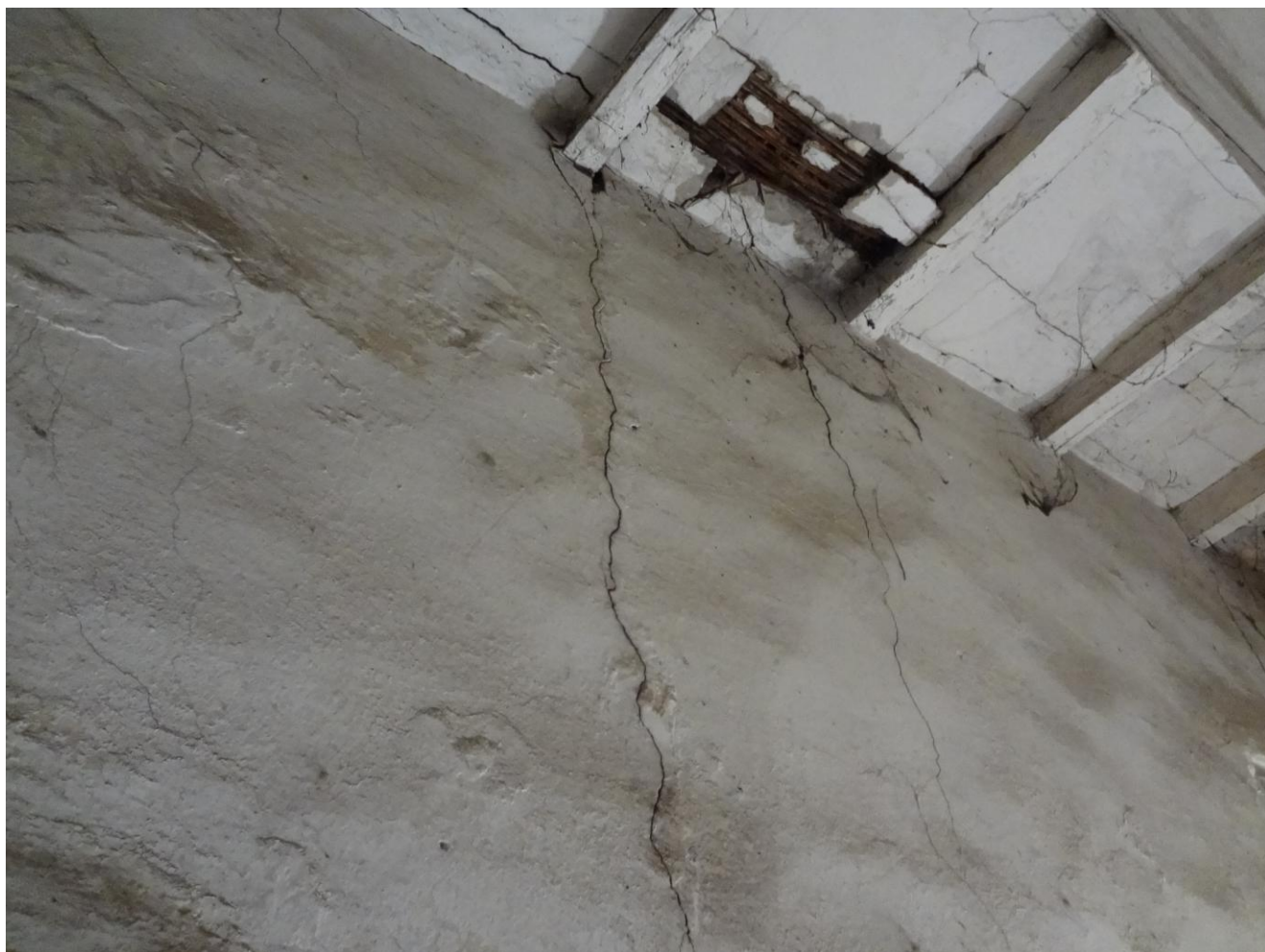
Foto 34 - Lesioni verticali passanti
