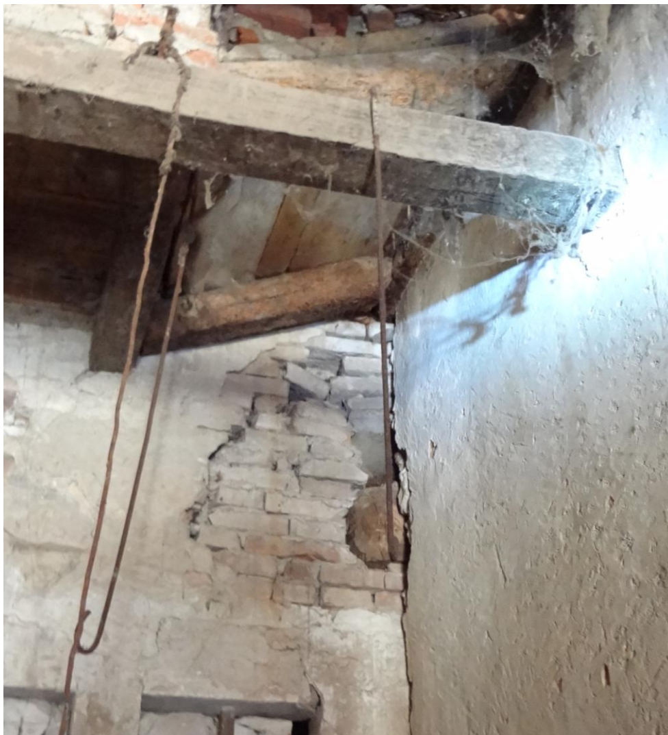
Foto 24 – Distacchi tra due pareti ad angolo.
