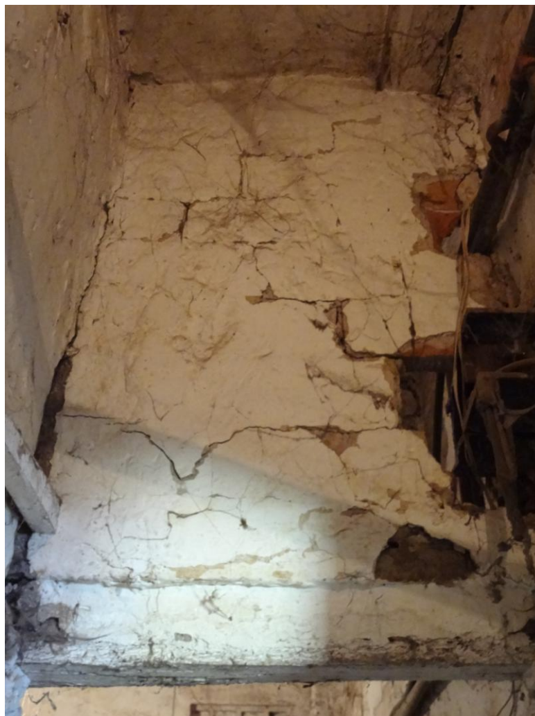
Foto 11- Lesioni diagonali da taglio ed evidenti distacchi
