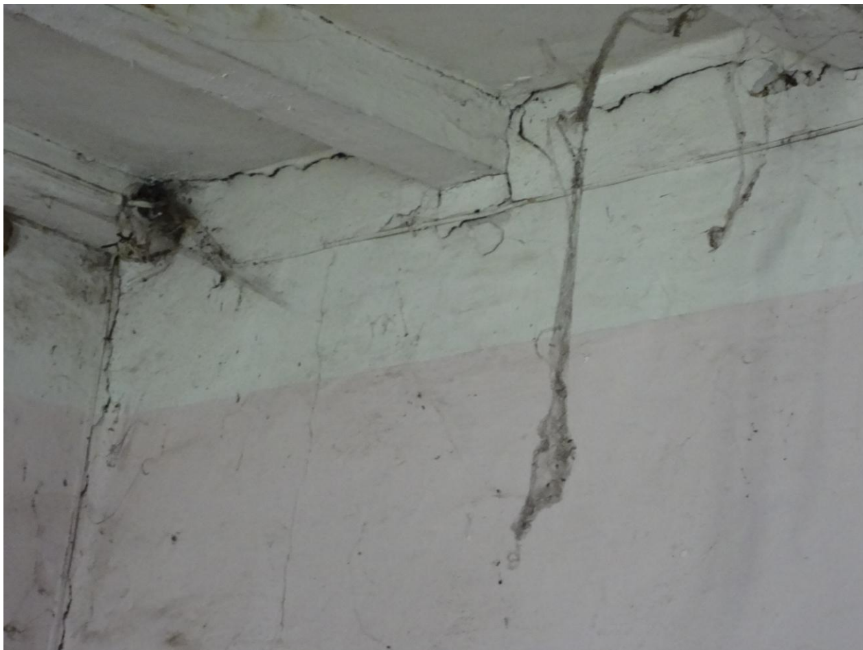
Foto 29 – Distacco dei solai dai muri portanti
