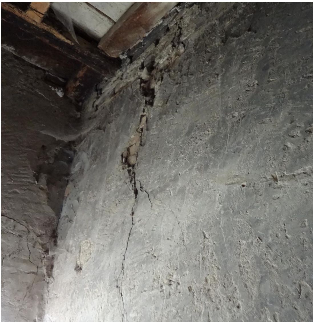
Foto 22 – Lesioni passanti su muro portante
