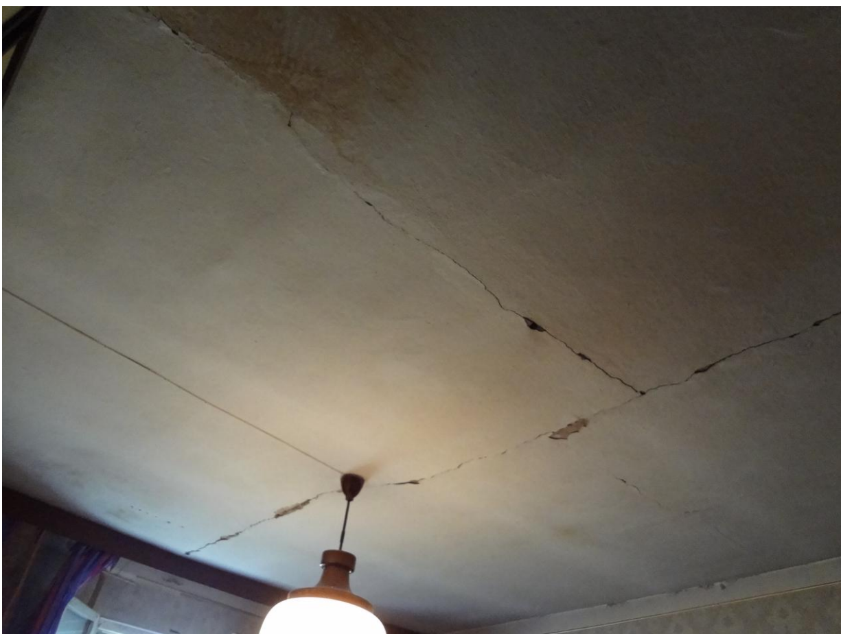
Foto 48 – Lesioni gravi del controsoffitto.
