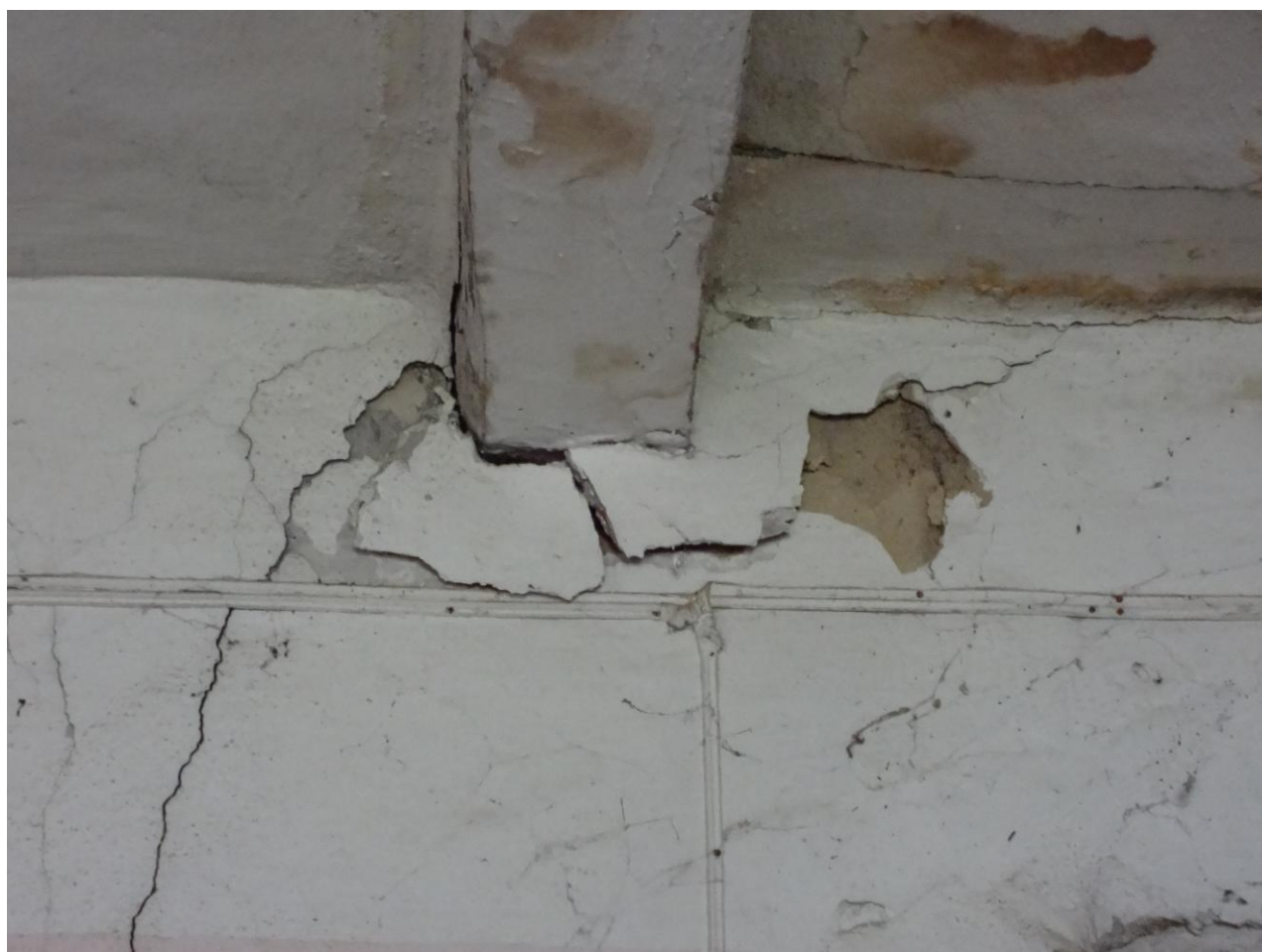
Foto 28 - Martellamento degli elementi costruttivi sui muri con espulsione del materiale.
