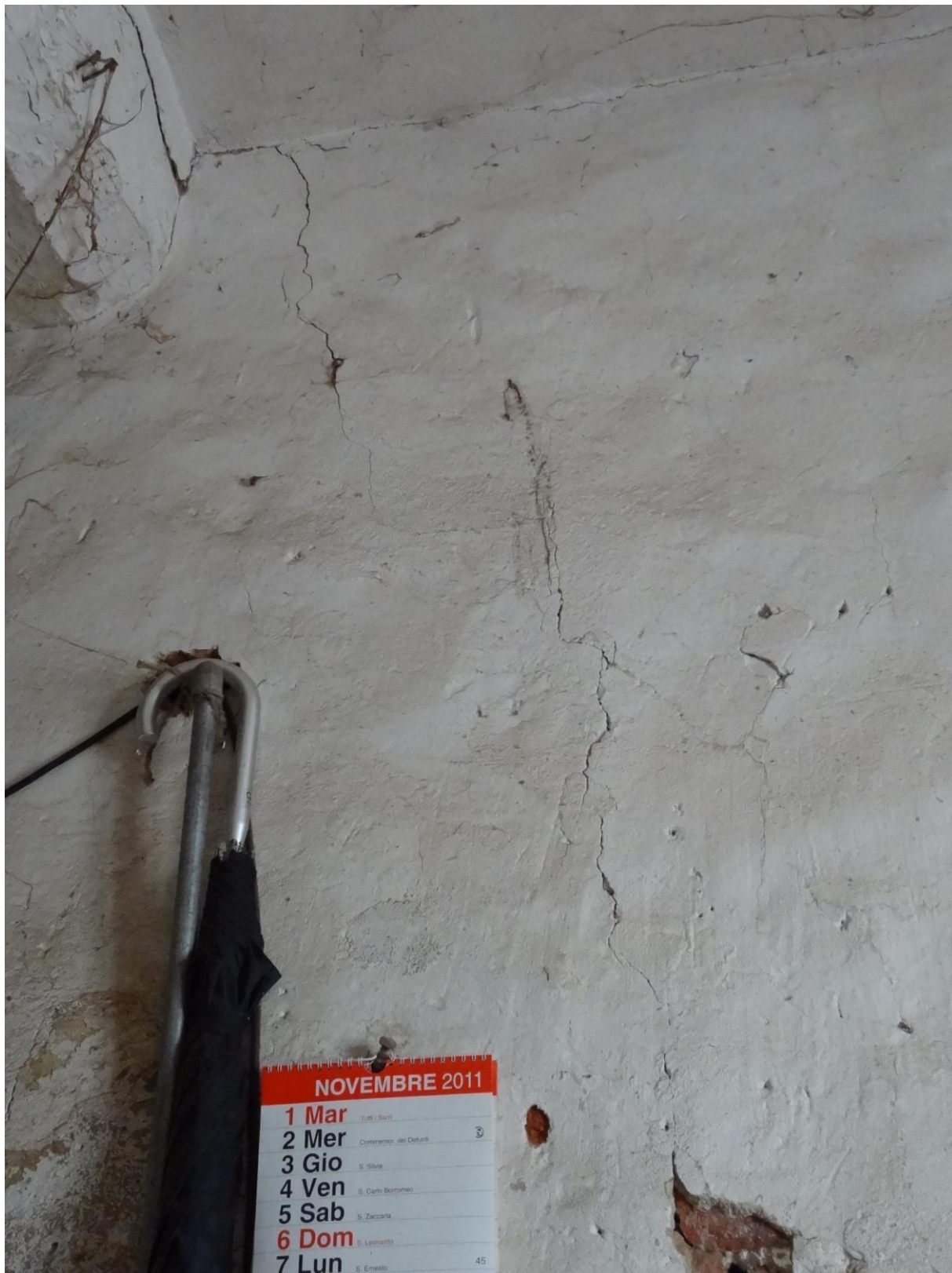
Foto 20 – Lesioni verticali e diagonali su muro portante.
