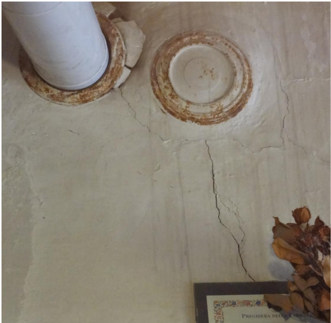
Foto 10- Lesione verticale su muro portante
