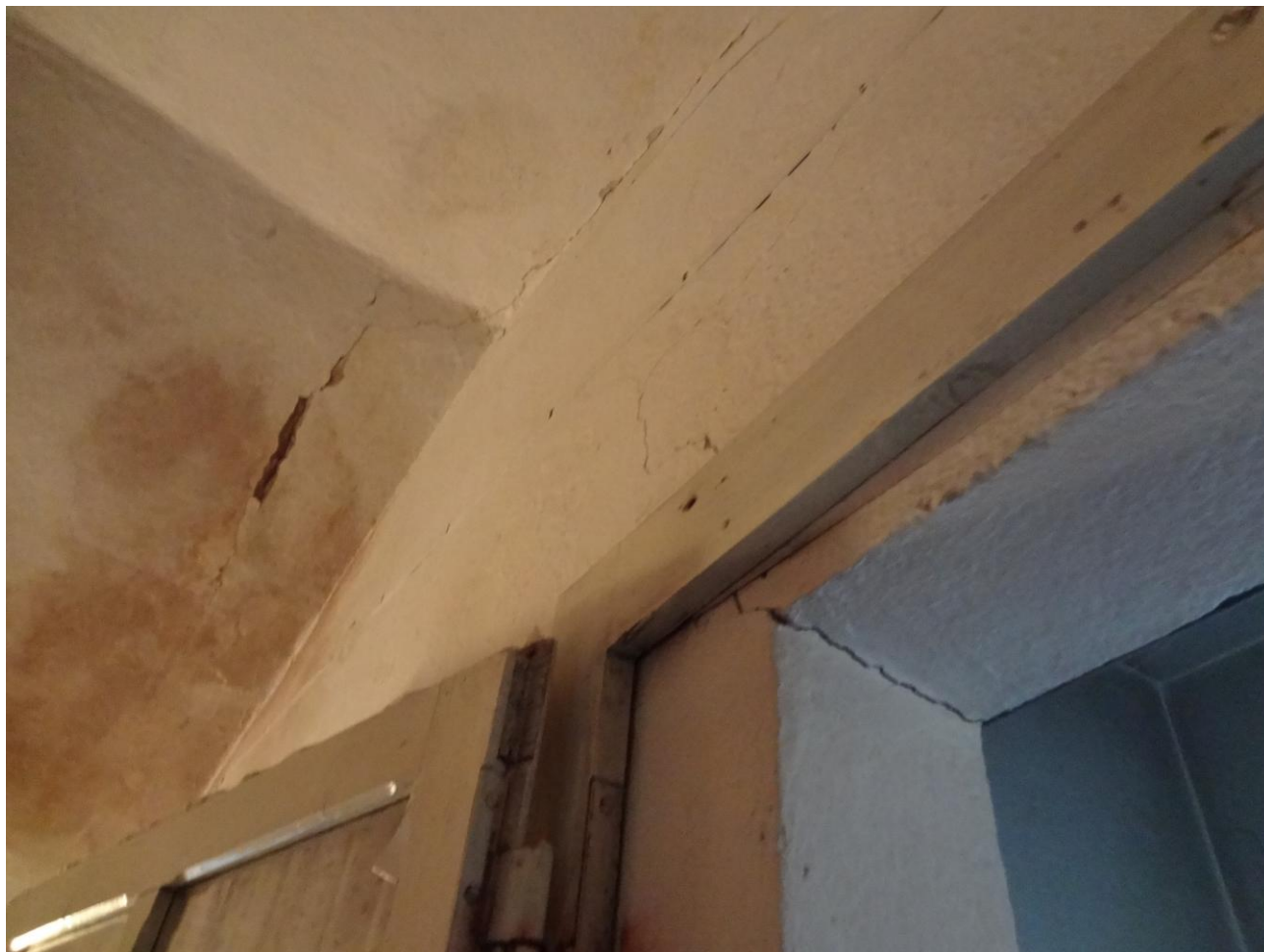
Foto 52 – Lesioni sopra l'architrave della porta e nel controsoffitto
