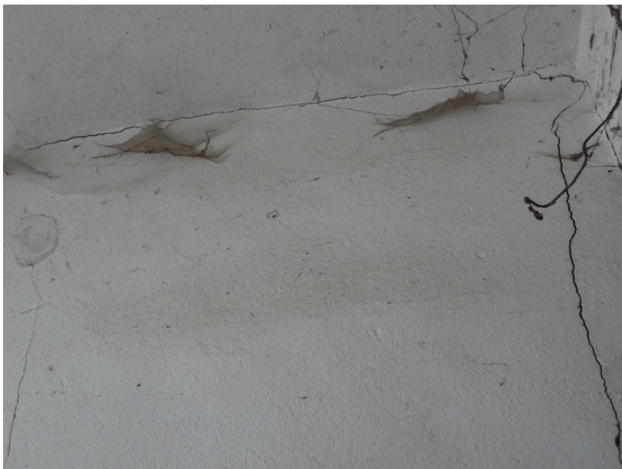
Foto 18- Lesioni verticali e distacchi dei solai dai muri.
