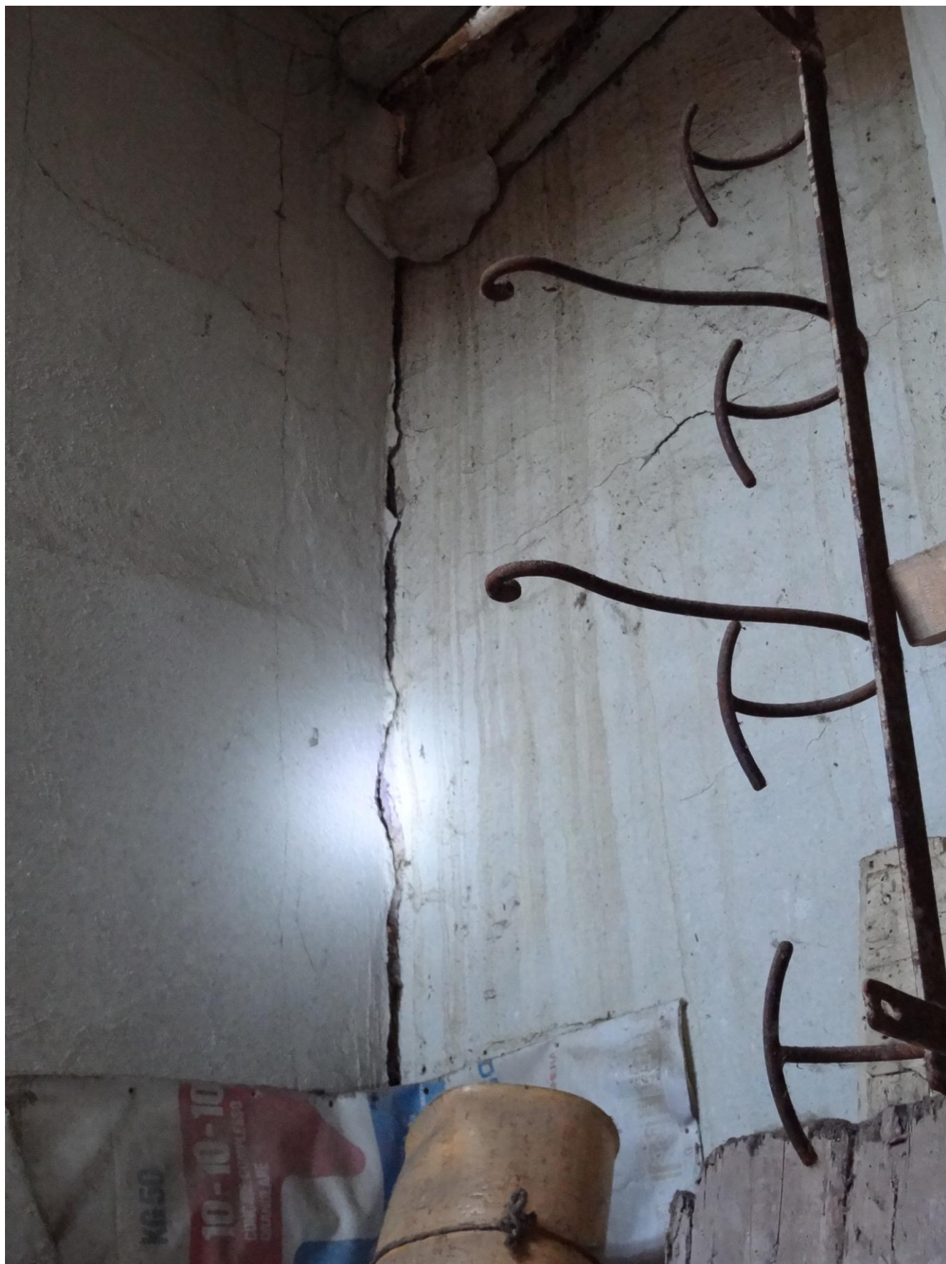
Foto 44- Ampio distacco tra due muri d'angolo
