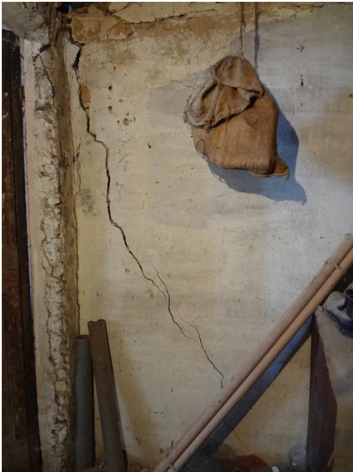
Foto 38 – Lesione diagonale da taglio passante
