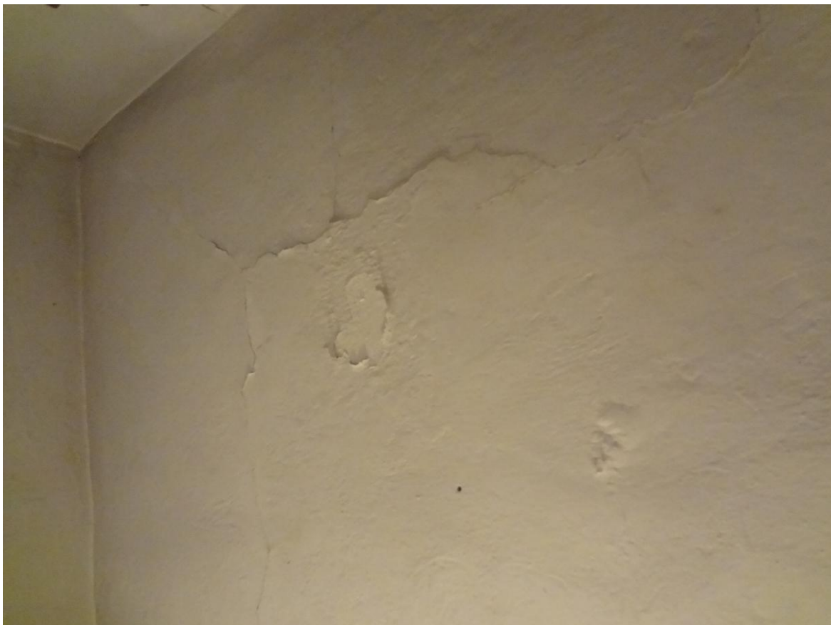
Foto 16- Lesioni non passanti di taglio.
