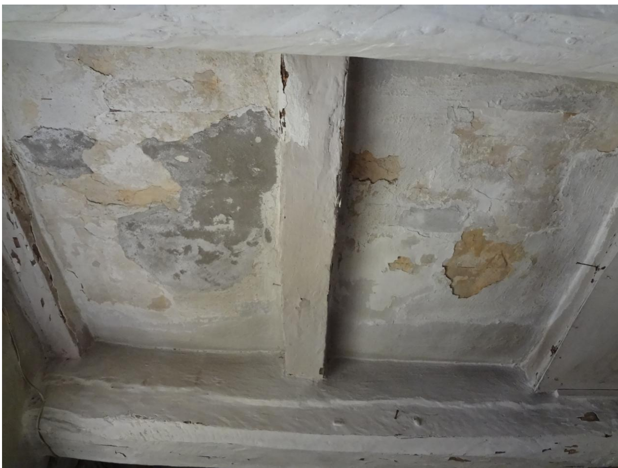
Foto 8- Spanciamenti e distacchi di intonaco nel solaio.
