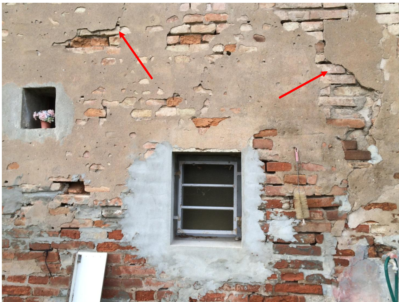
Fig. 15 – Lesioni nella parete esterna
