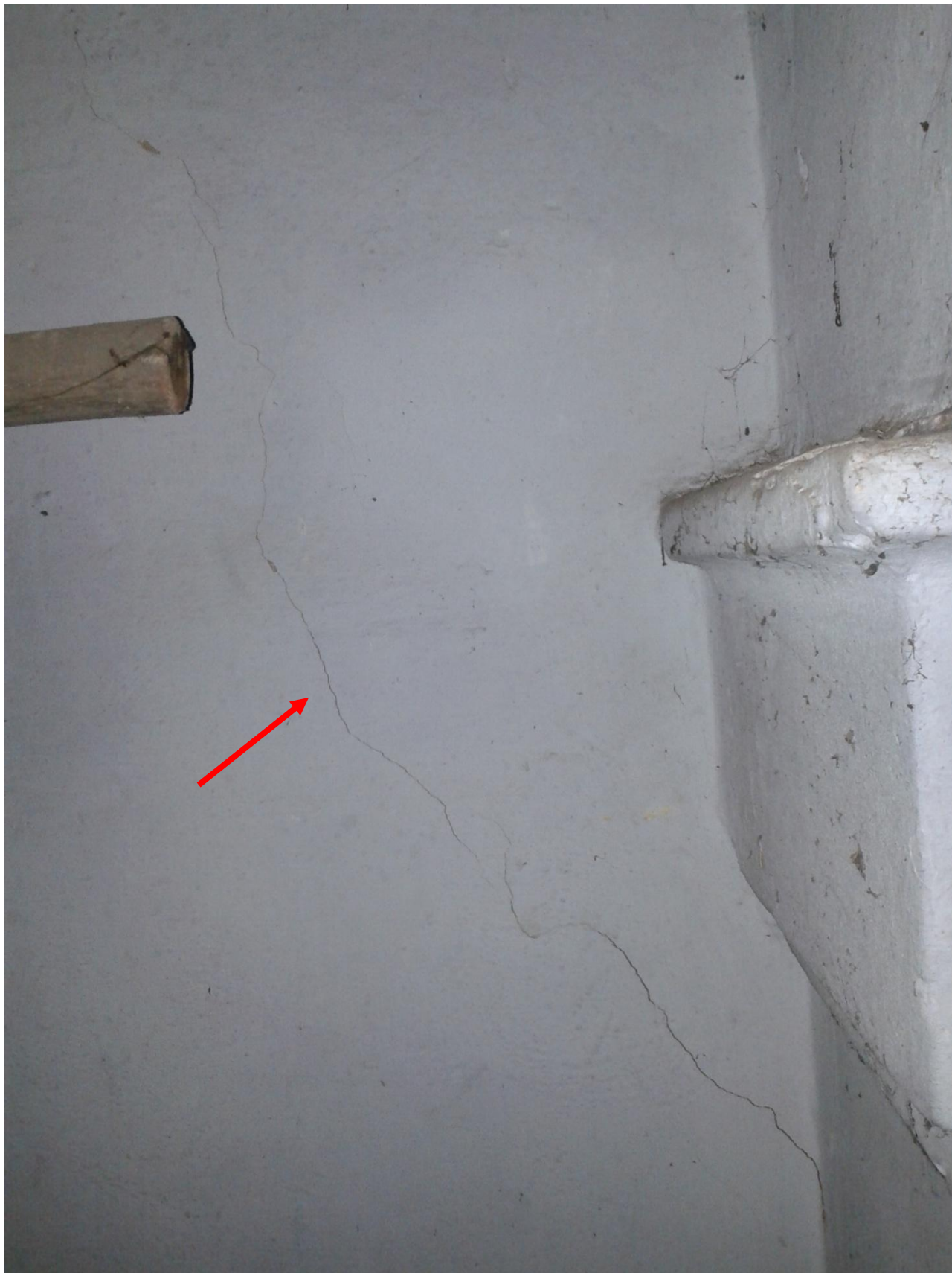
Fig. 81 – Lesione nella parete portante
