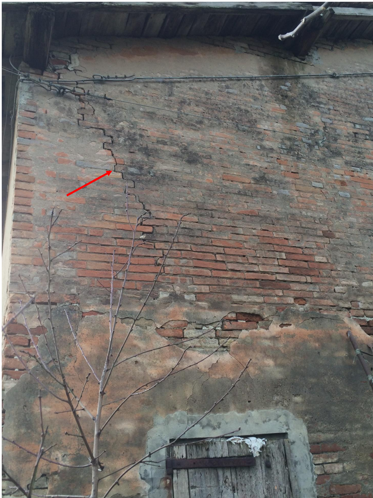
Fig. 20 – Lesione diagonale nella parete esterna
