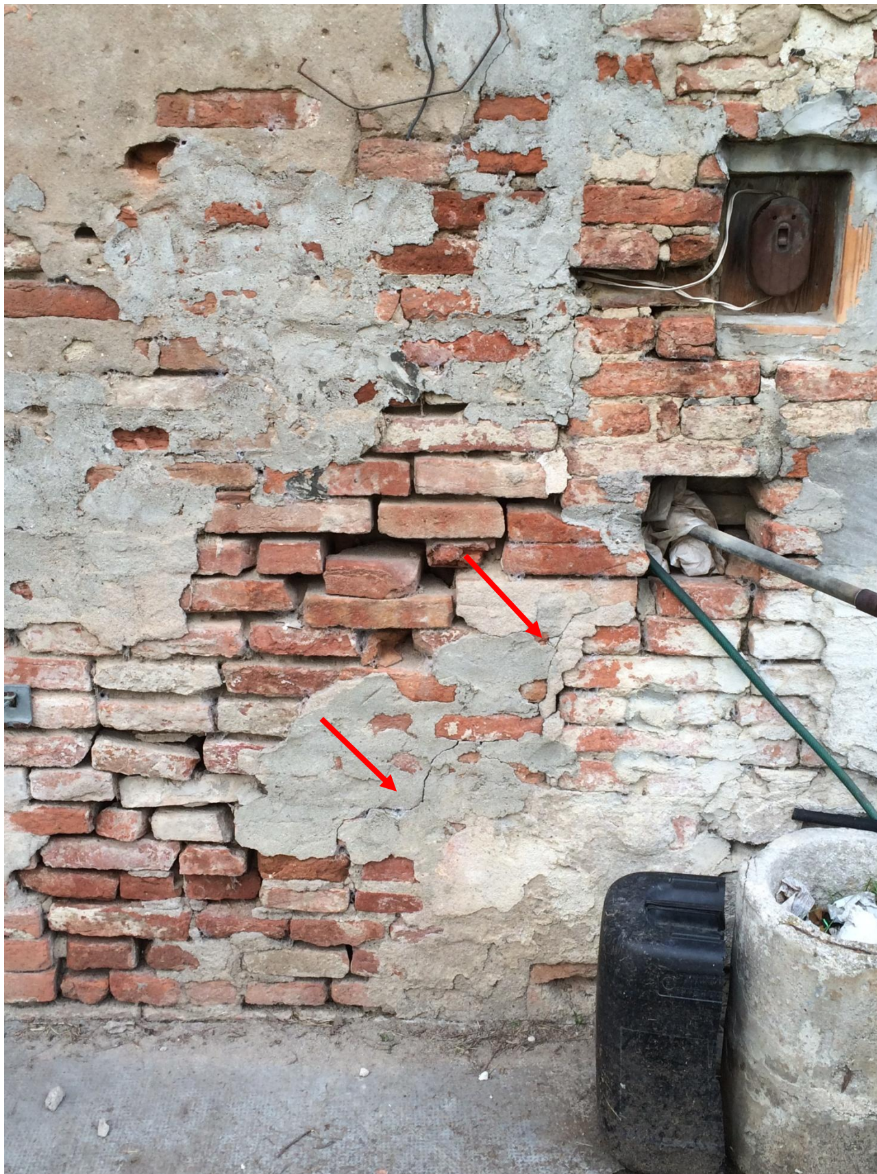
Fig. 14 – Lesione diagonale nella parete portante
