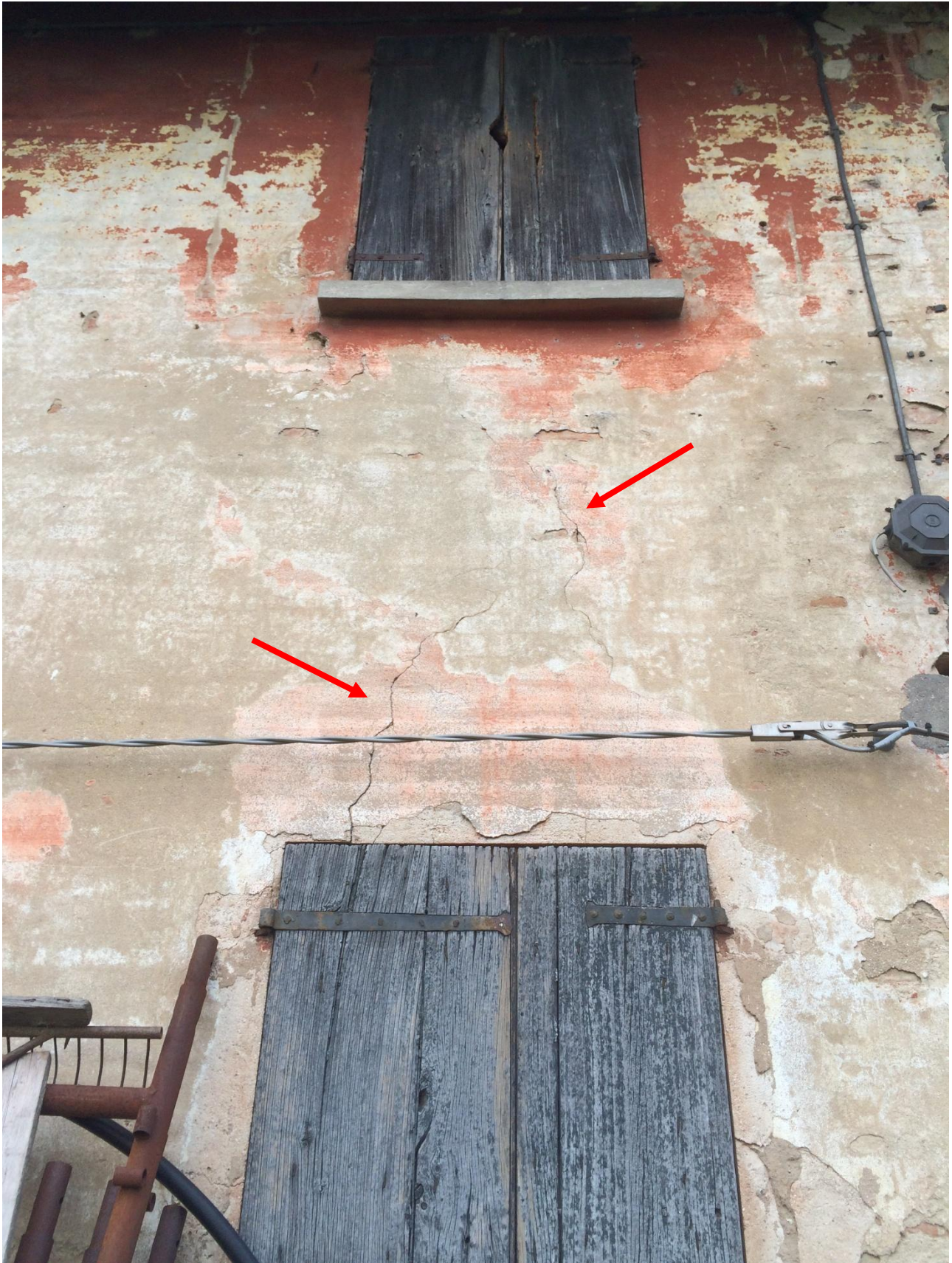
Fig. 10 – Lesioni diagonali nella parete portante
