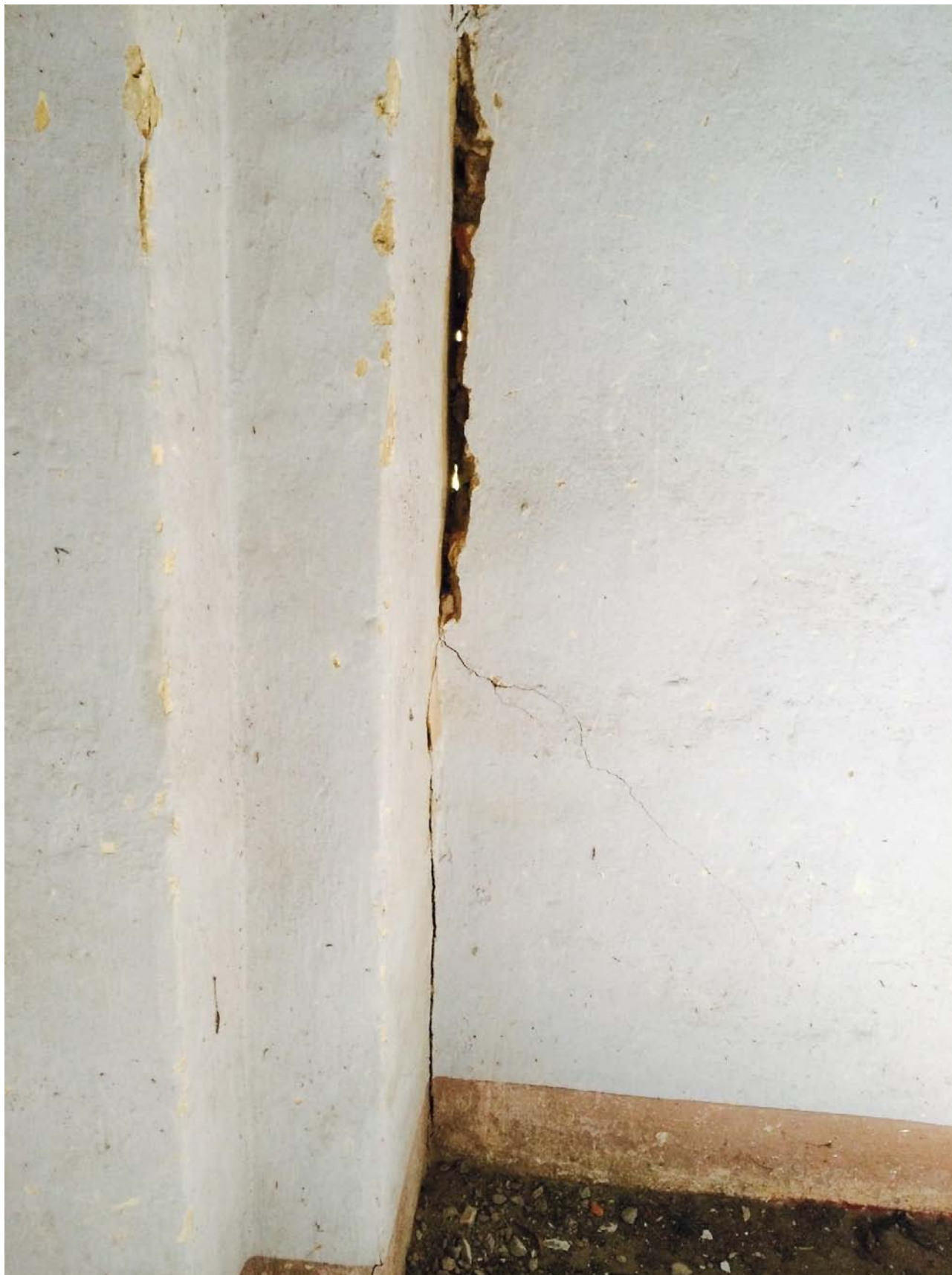
Fig. 36 – Lesione passante nella parete portante
