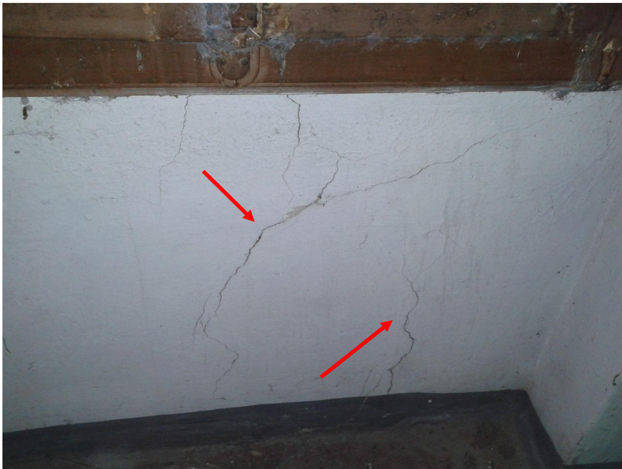
Fig. 102 – Lesione verticale e diagonale nella parete portante
