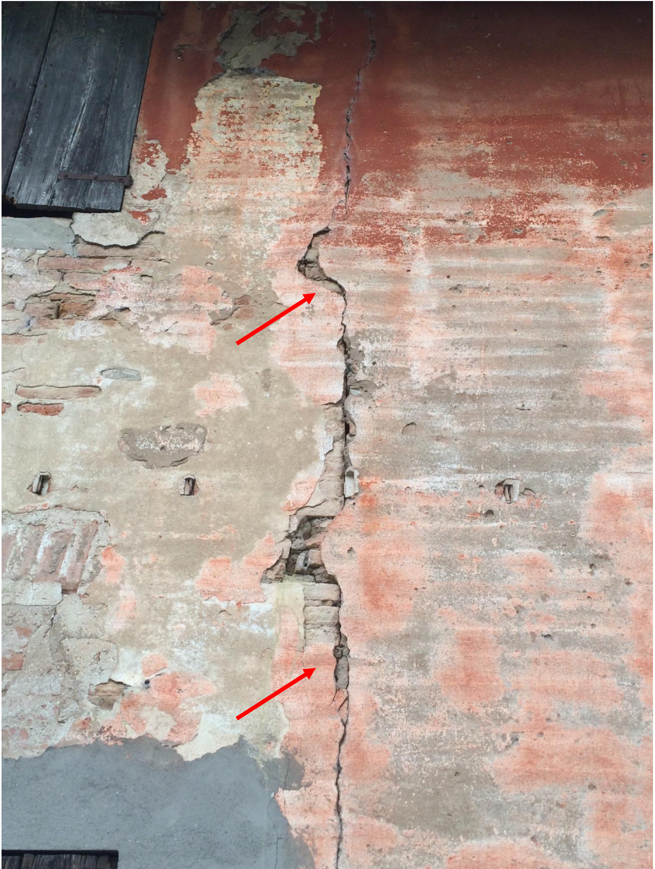
Fig. 12 – Fessure passanti con distacchi della parete portante
