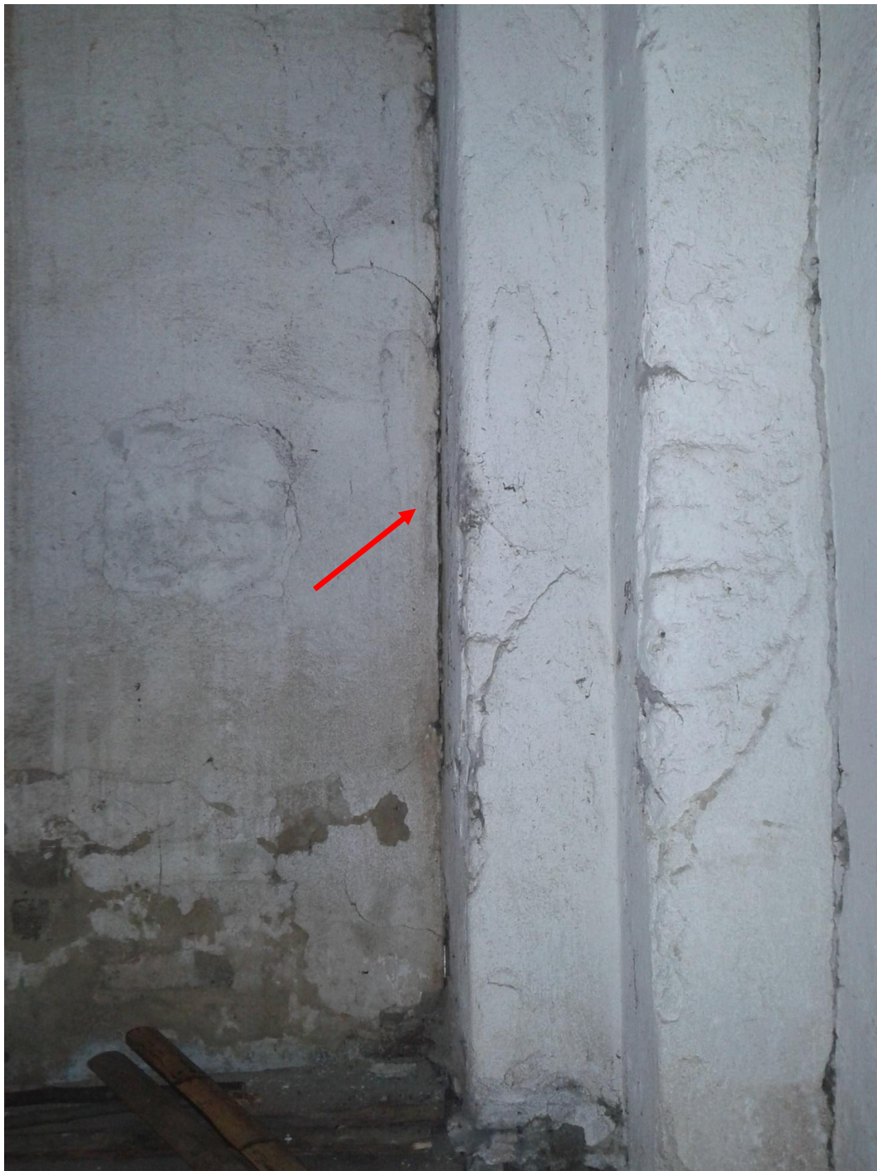
Fig. 43 – Lesione passante nella parete portante
