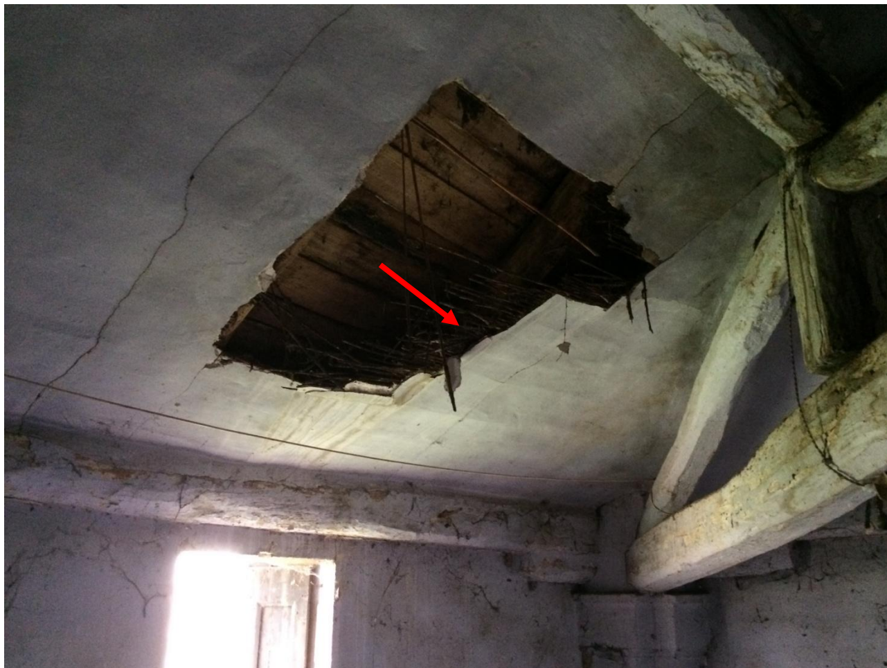
Fig. 32 – Crollo dell'arellato di copertura
