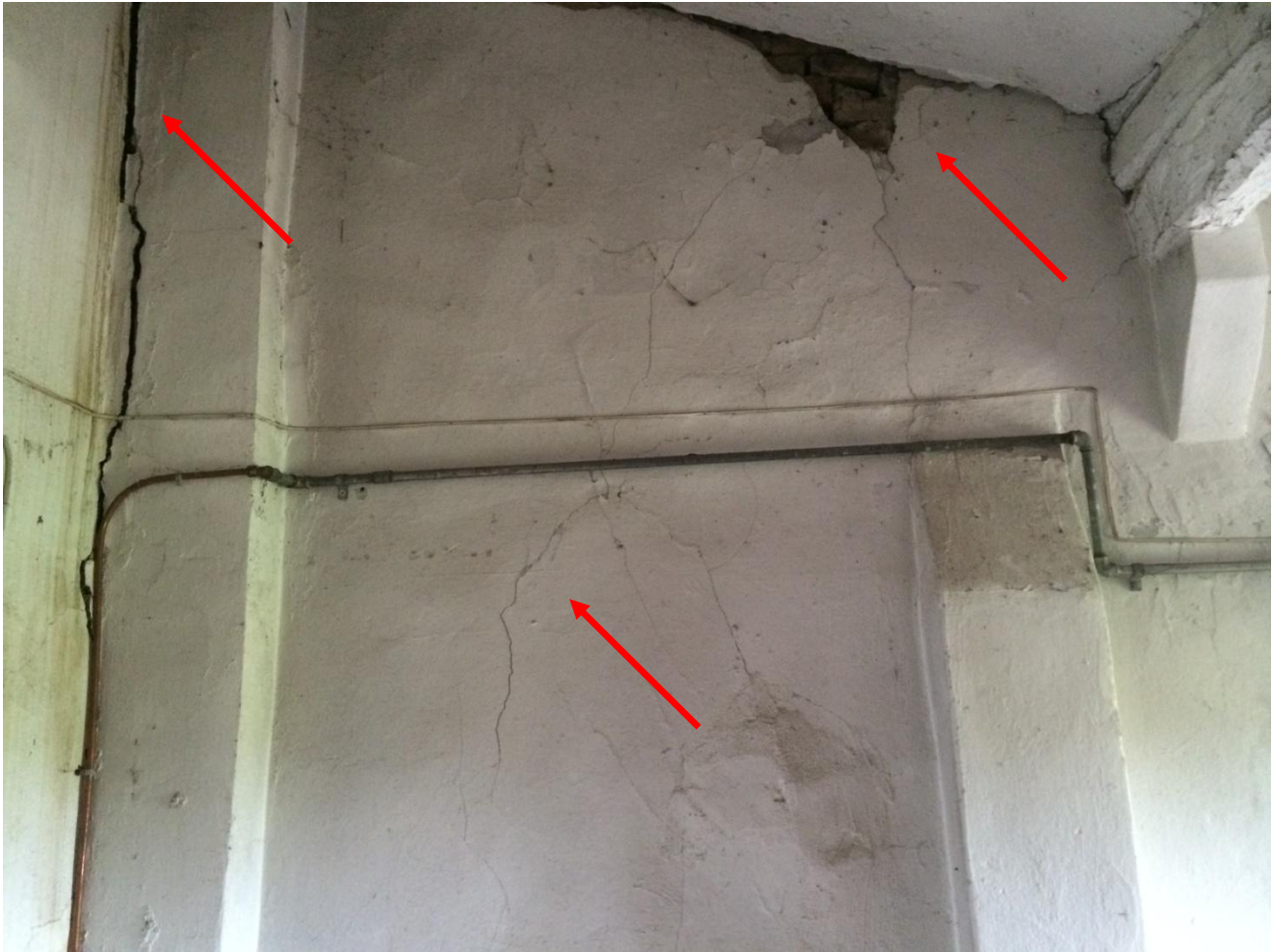
Fig. 37 – Crolli parziali di parete portante
