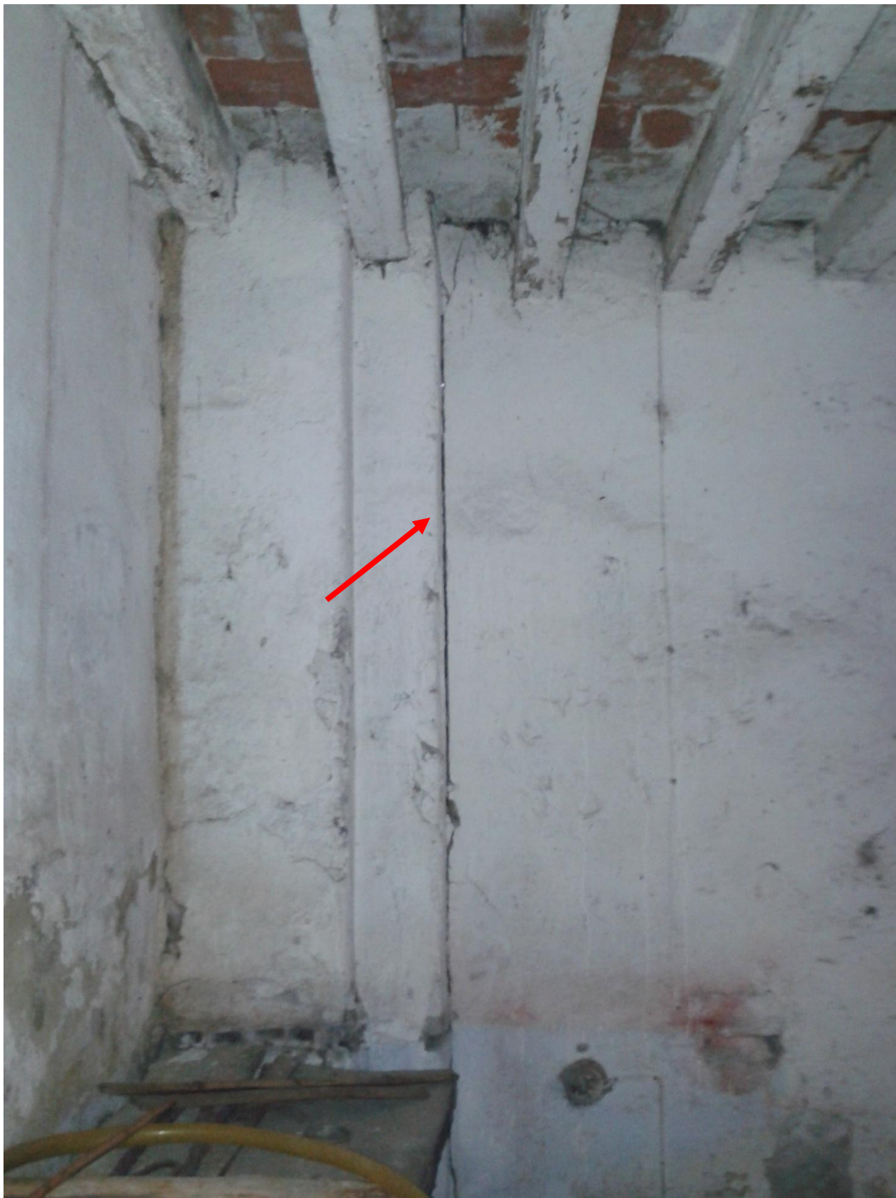
Fig. 42 – Lesione passante nella parete portante
