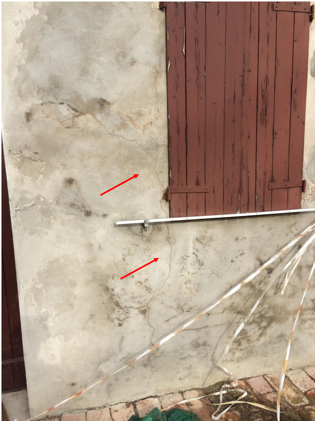
Fig. 7 – Lesioni nella parete esterna
