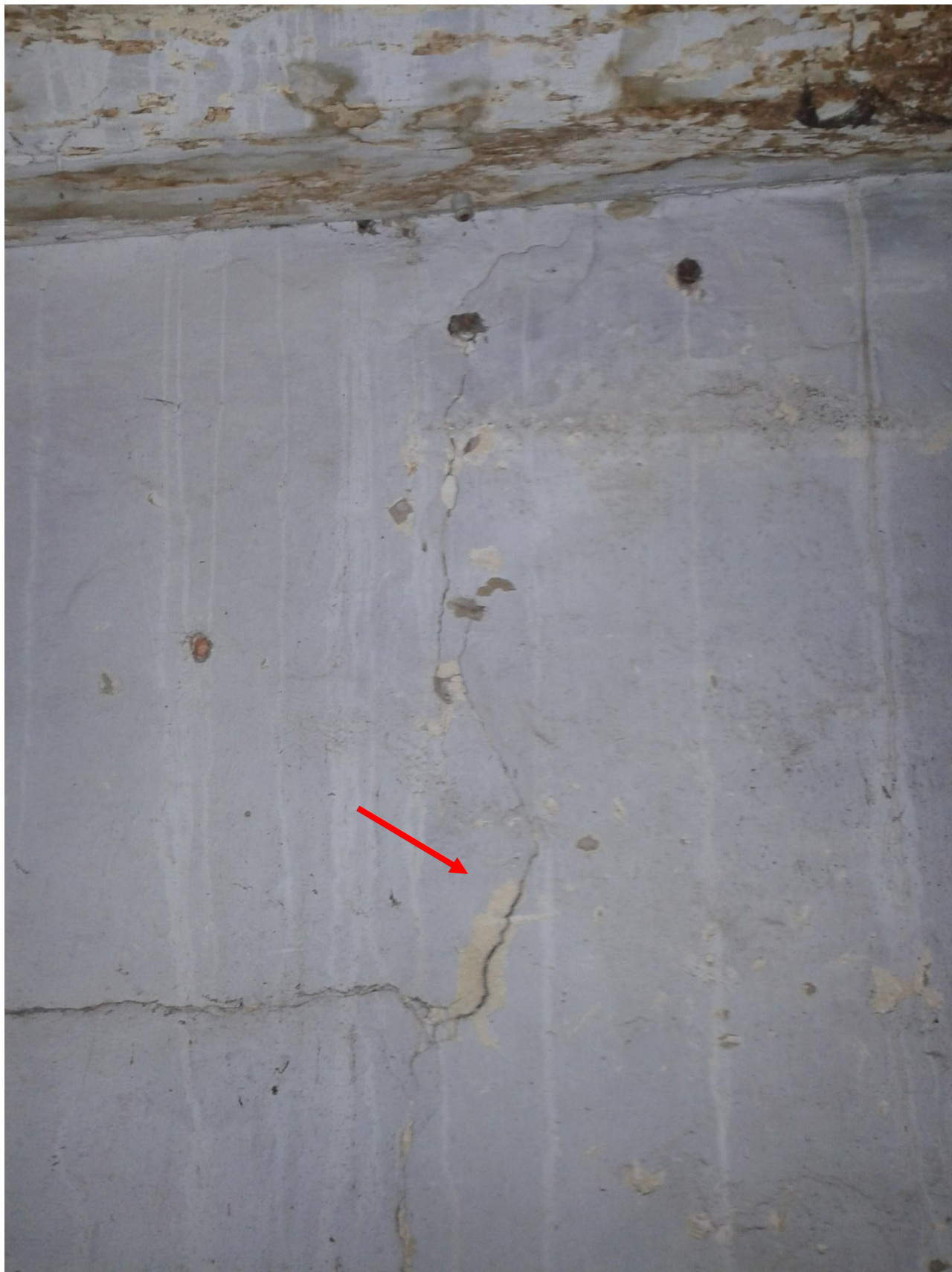
Fig. 38 – Lesione nella parete portante
