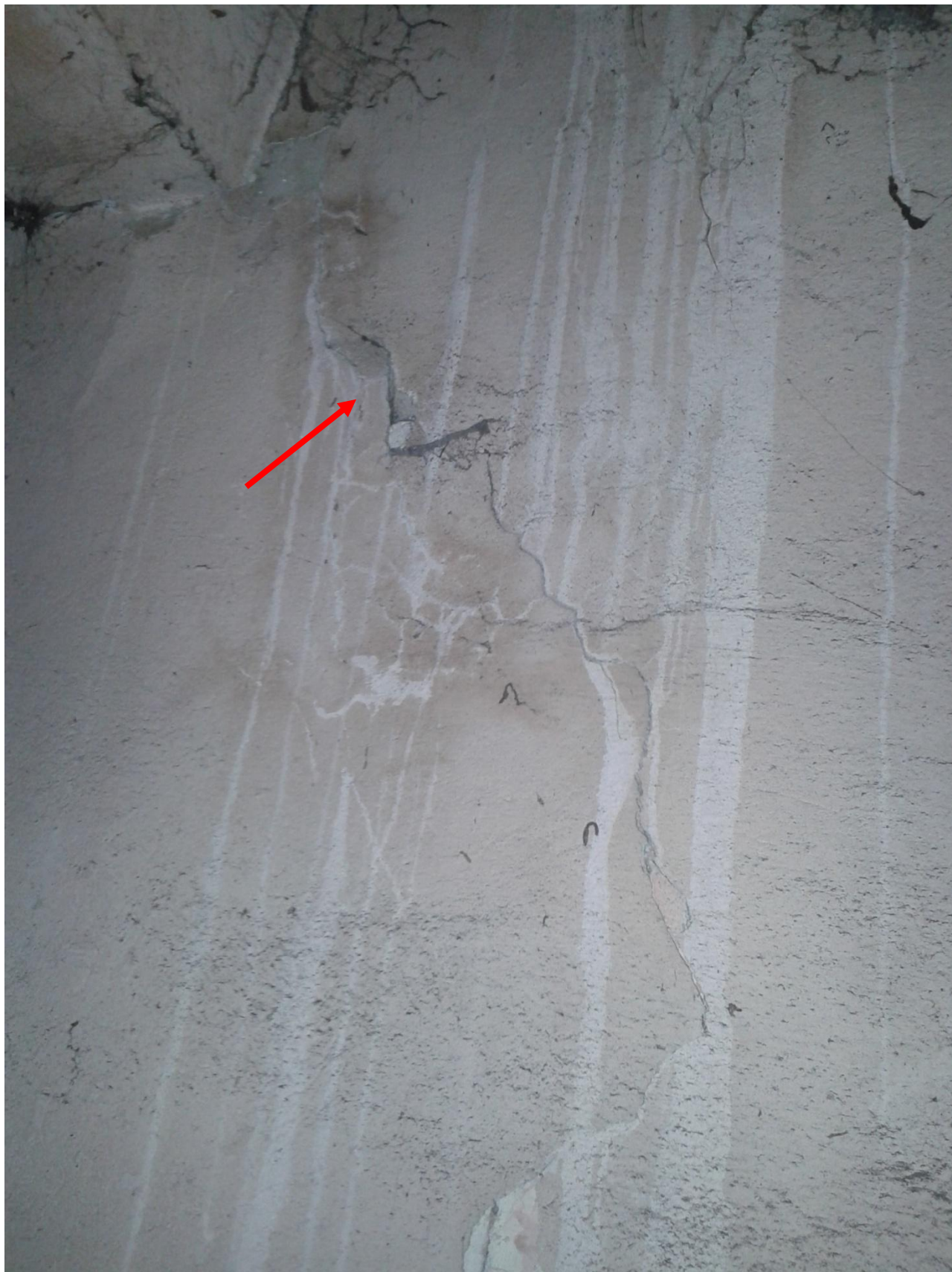
Fig. 57 – Lesione nella parete portante
