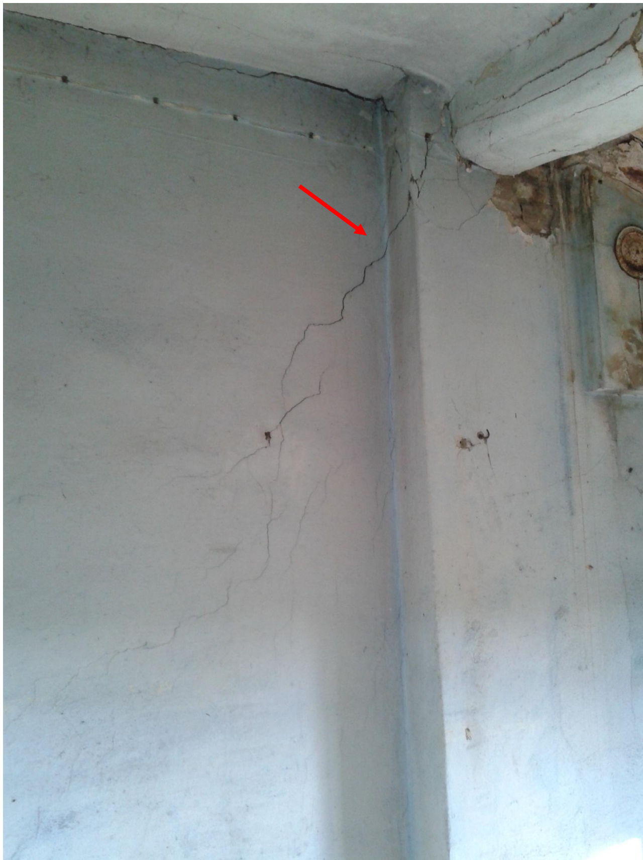
Fig. 70 – Lesione nella parete portante
