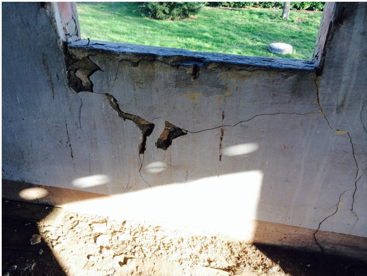
Fig. 80 – Lesione passante nella parete portante
