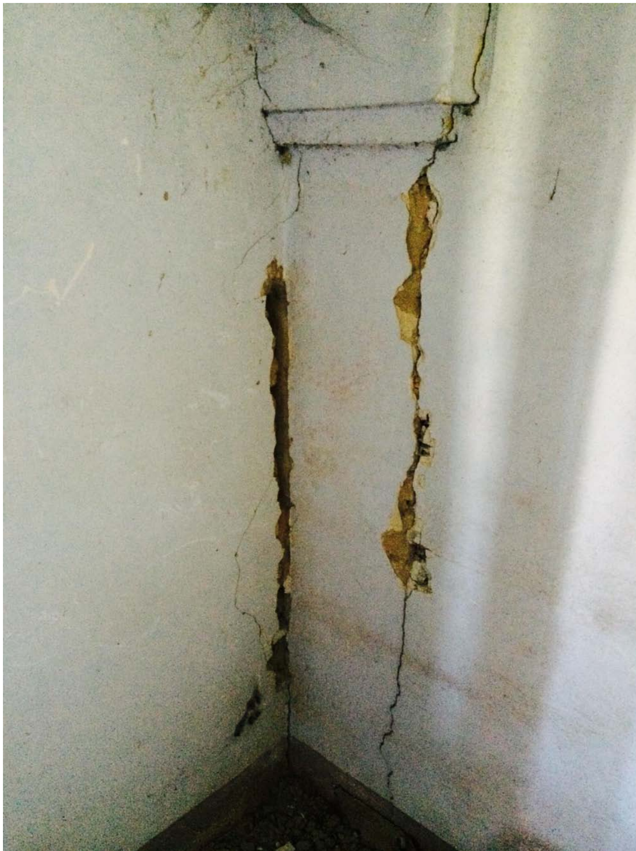
Fig. 53 – Lesione passante nella parete portante
