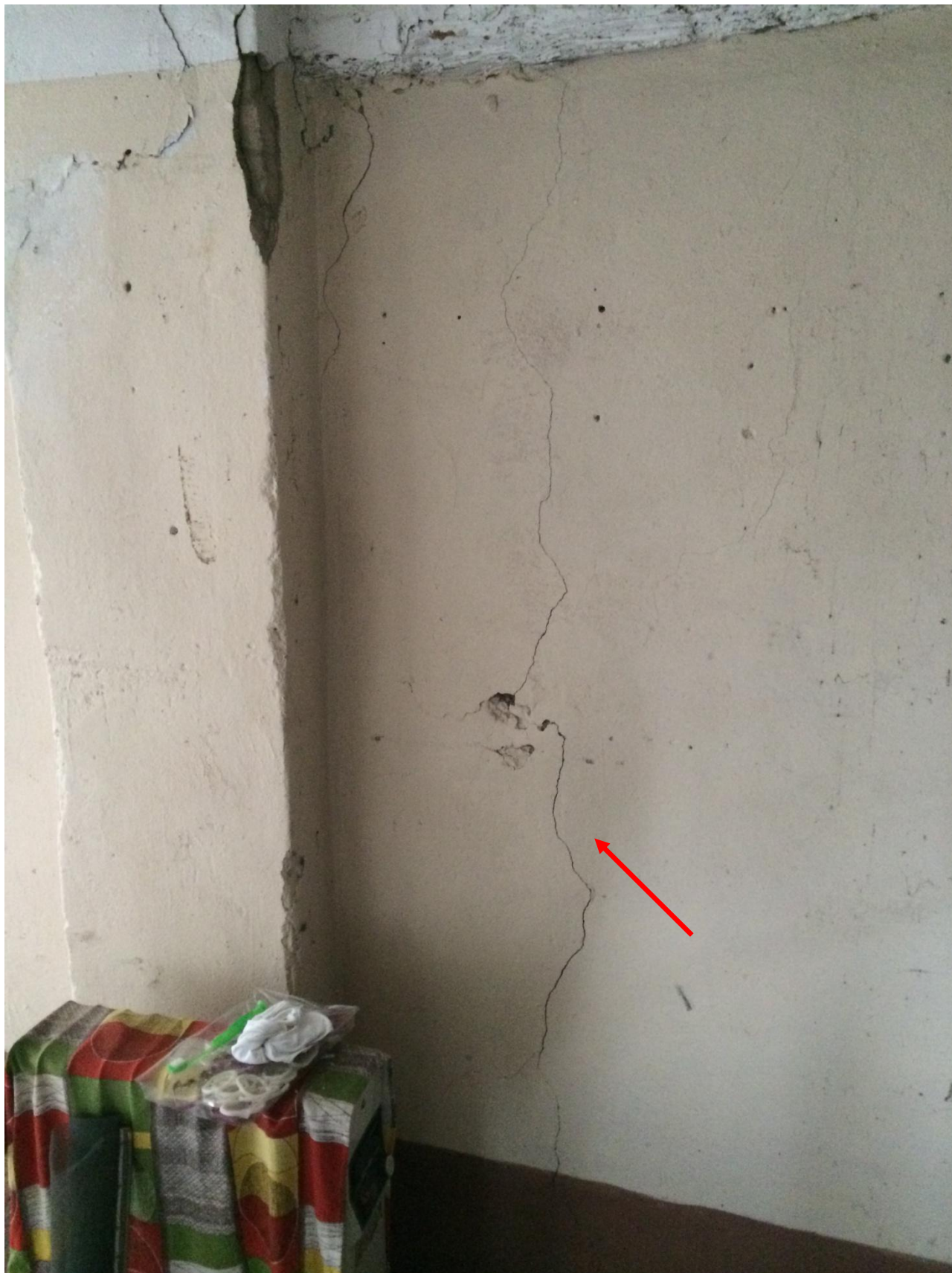
Fig. 47 – Lesioni verticali nella parete portante
