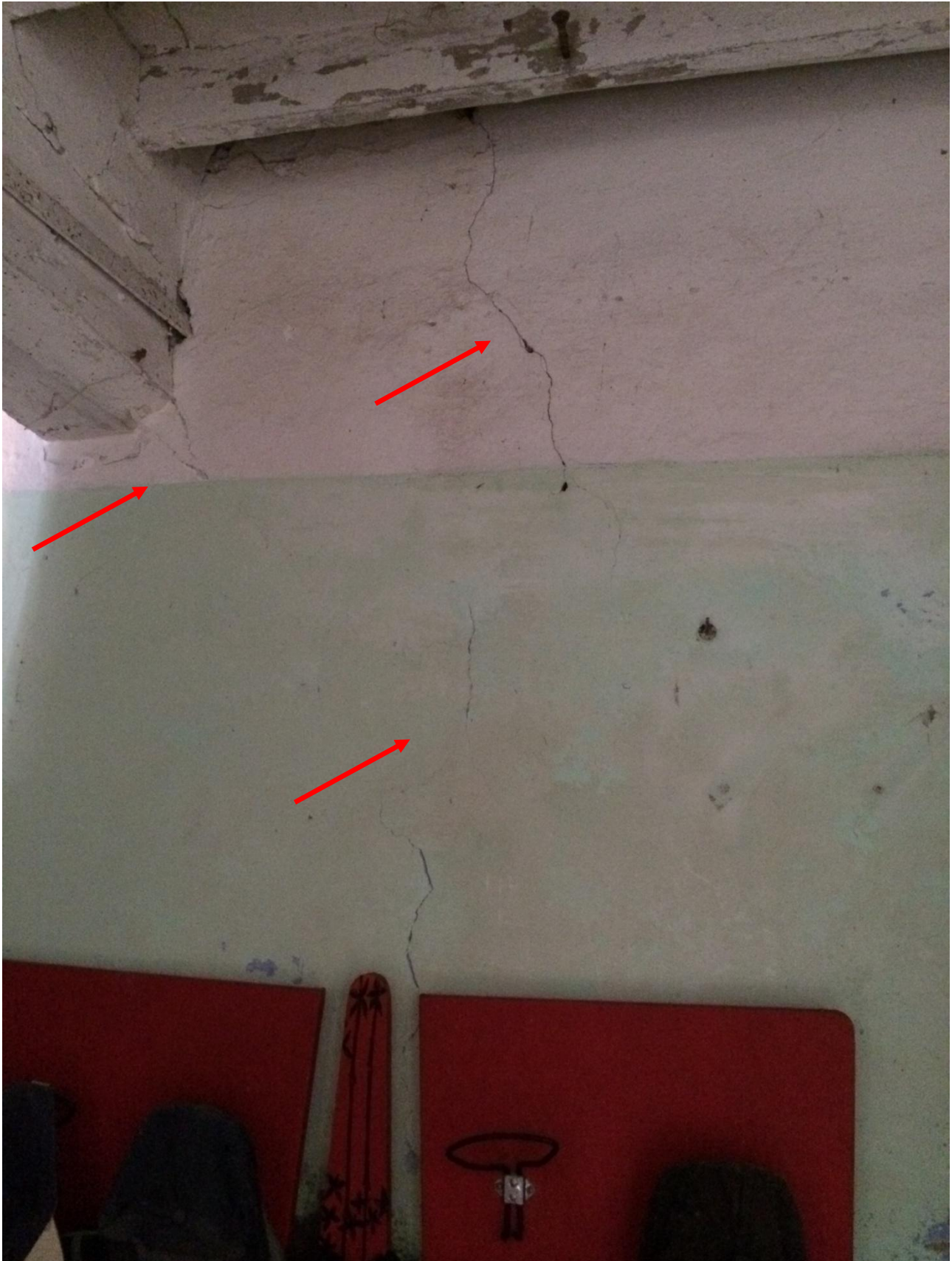
Fig. 30 – Lesioni nella muratura portante
