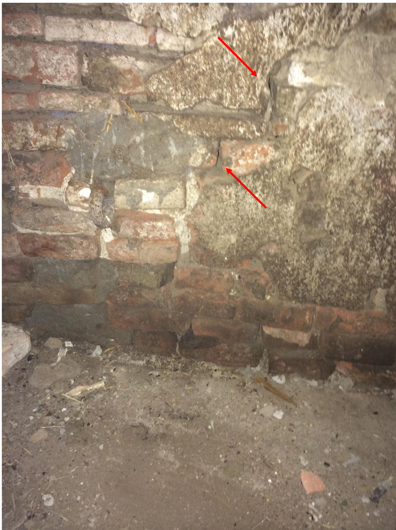
Fig. 58 – Lesione passante ai piedi della parete portante
