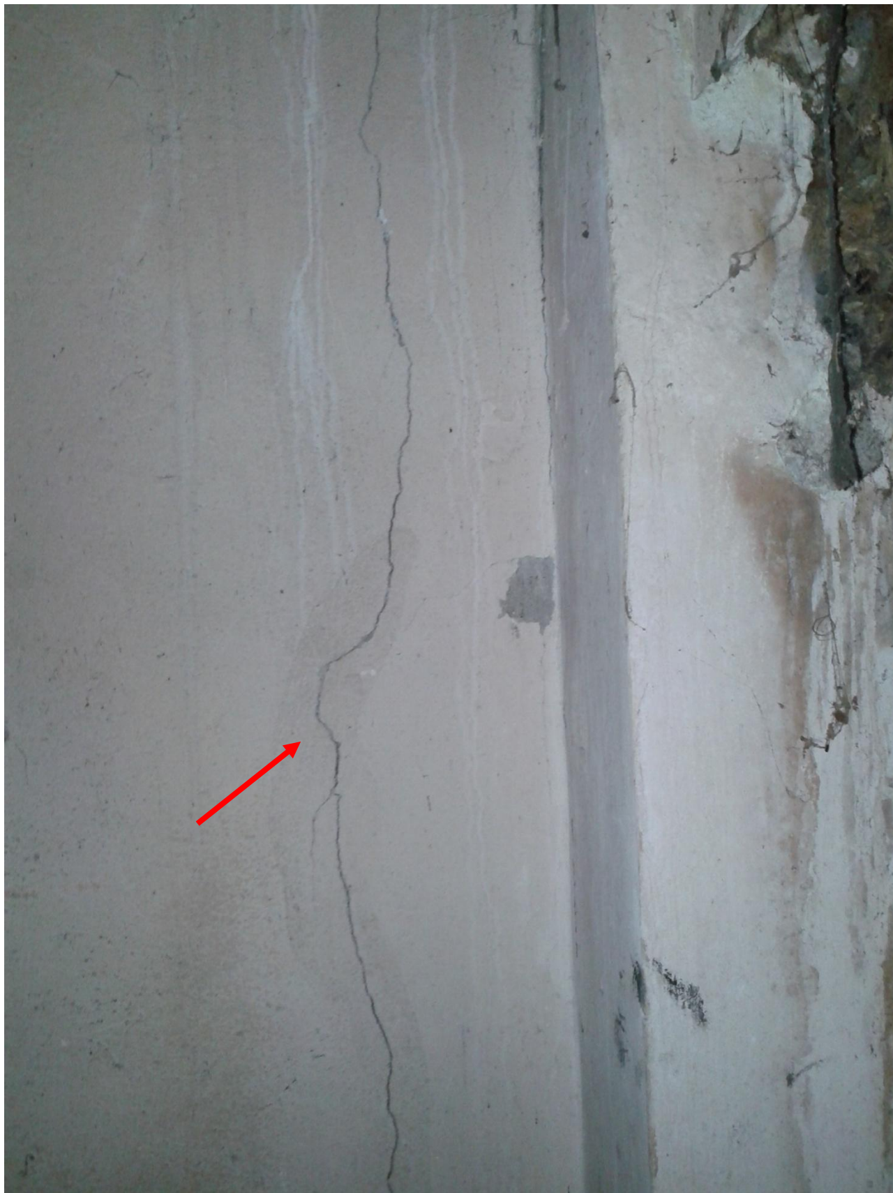
Fig. 56 – Lesione nella parete portante
