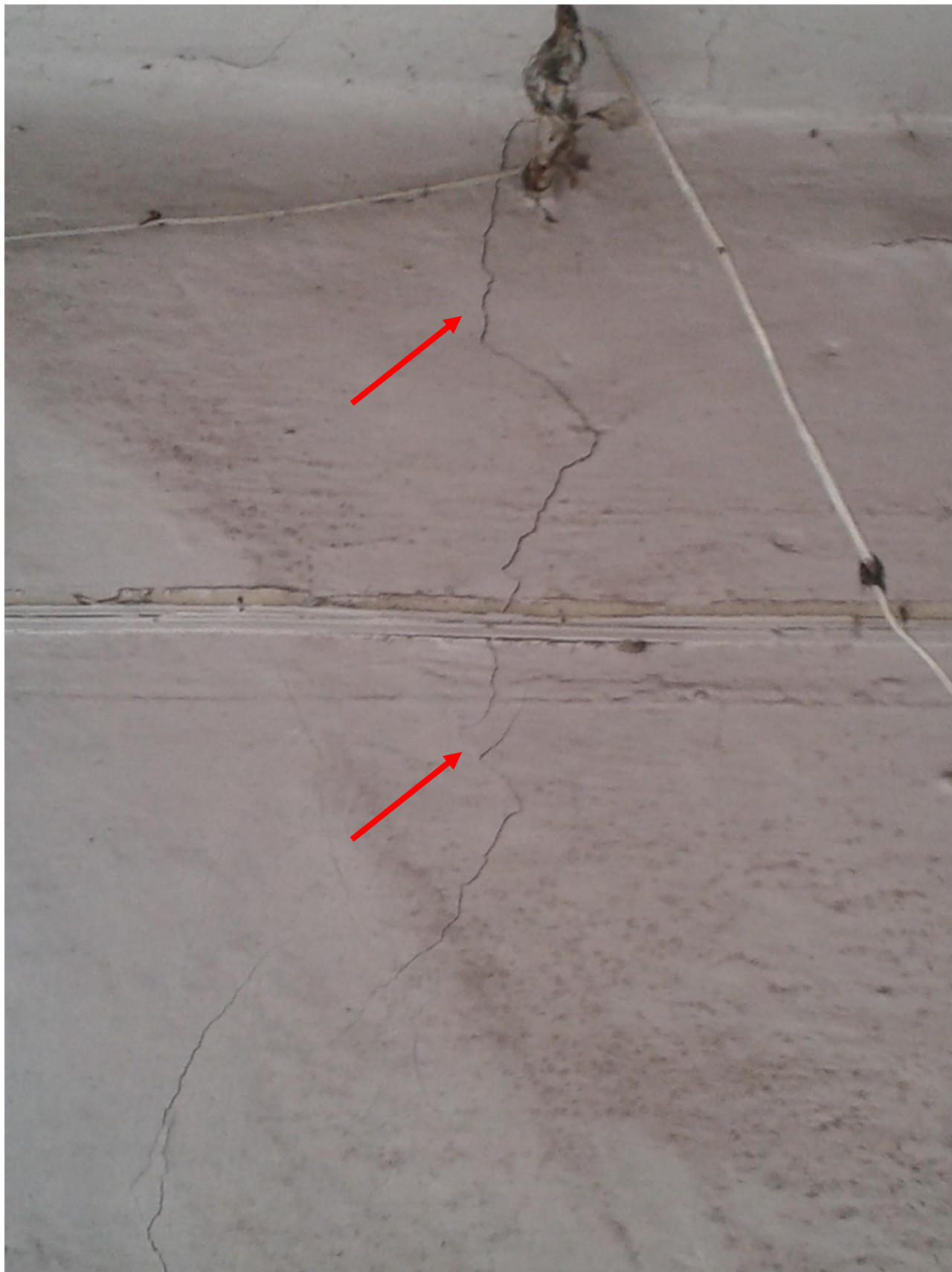
Fig. 58 – Lesione nella parete portante
