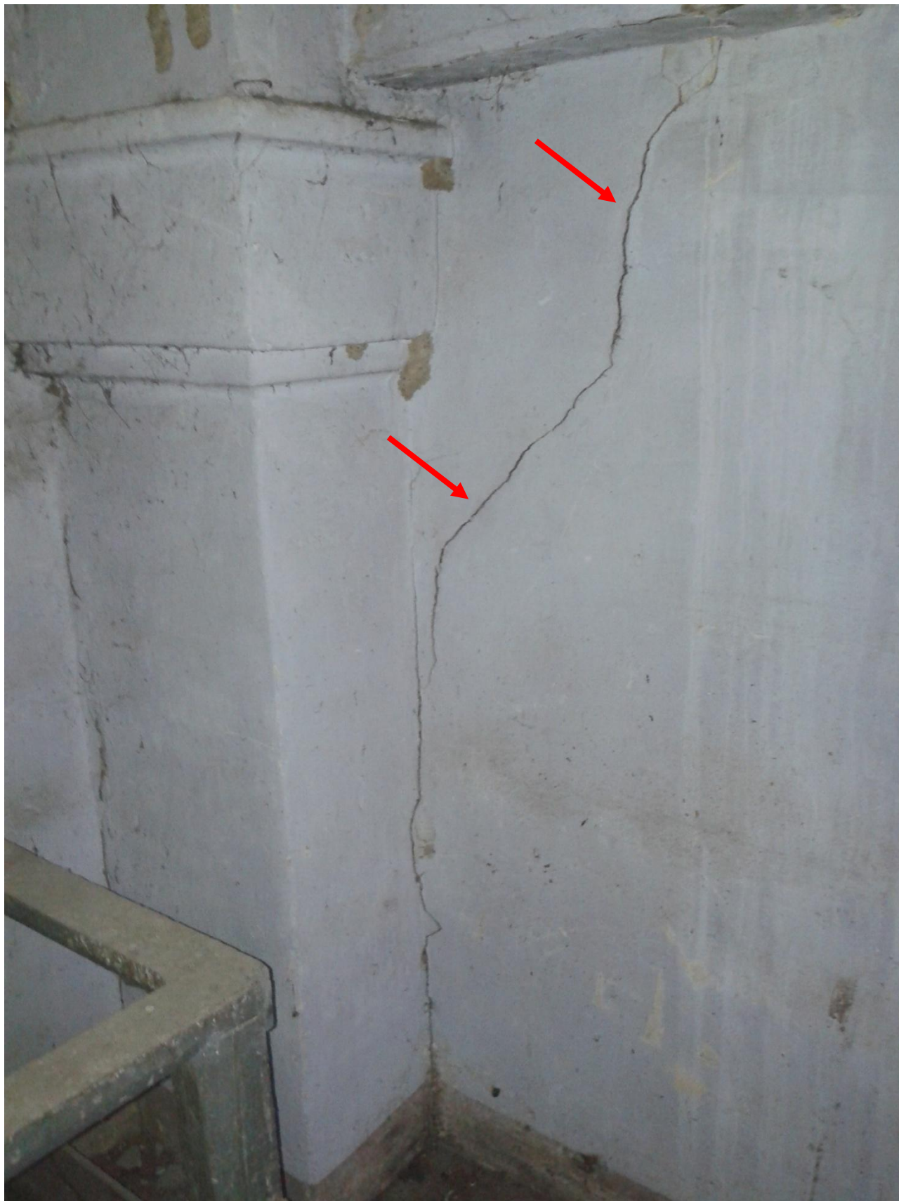
Fig. 33 – Lesione nella parete portante
