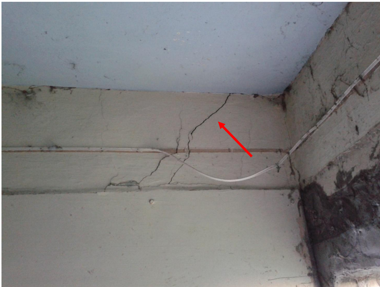
Fig. 75 – Lesione nella parete portante
