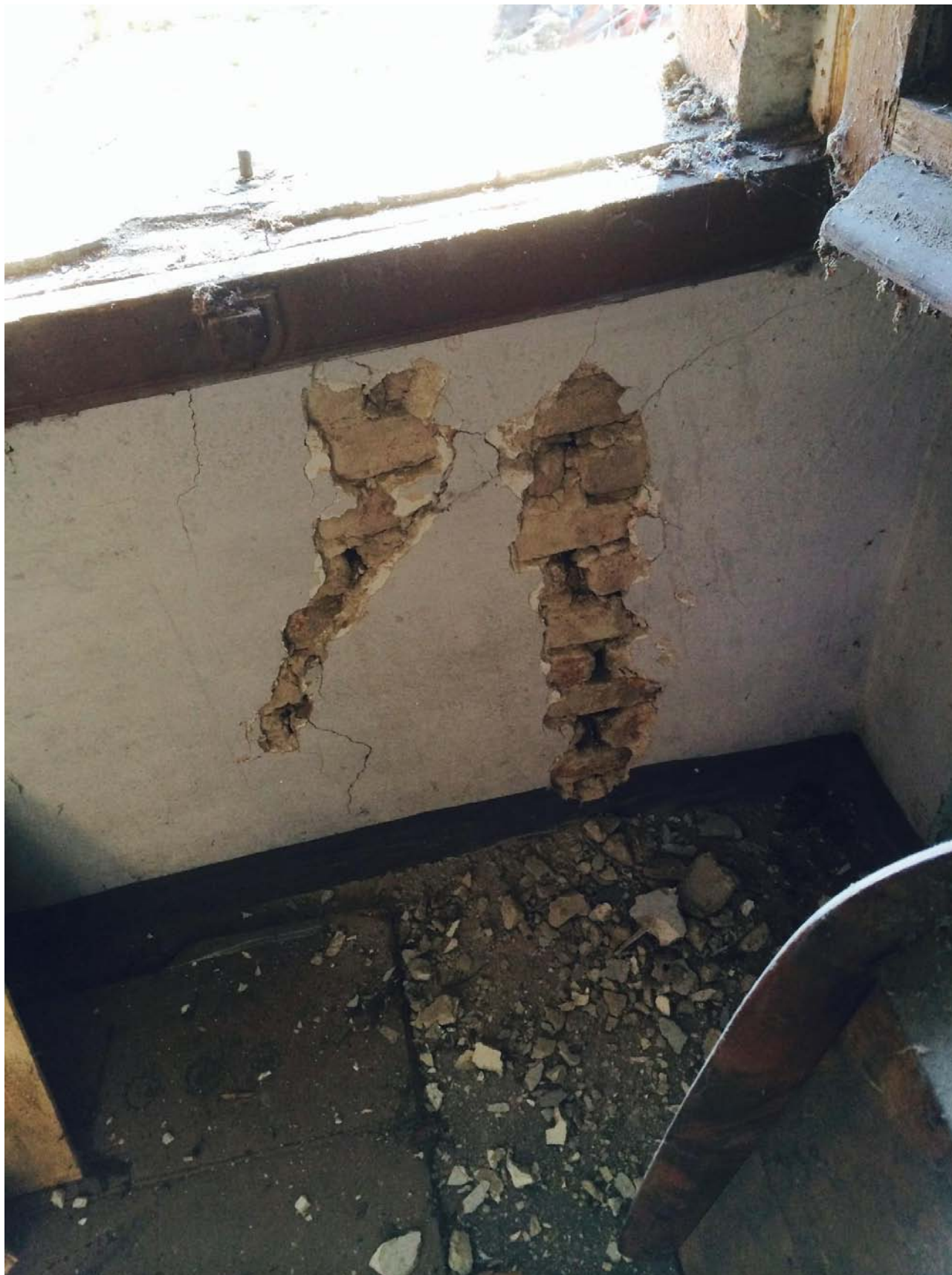
Fig. 102 – Lesione passante nella parete portante vista dall'interno
