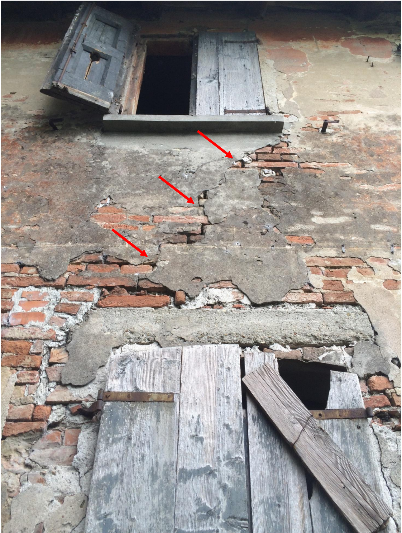
Fig. 26 – Lesione diagonale passante nella parete portante
