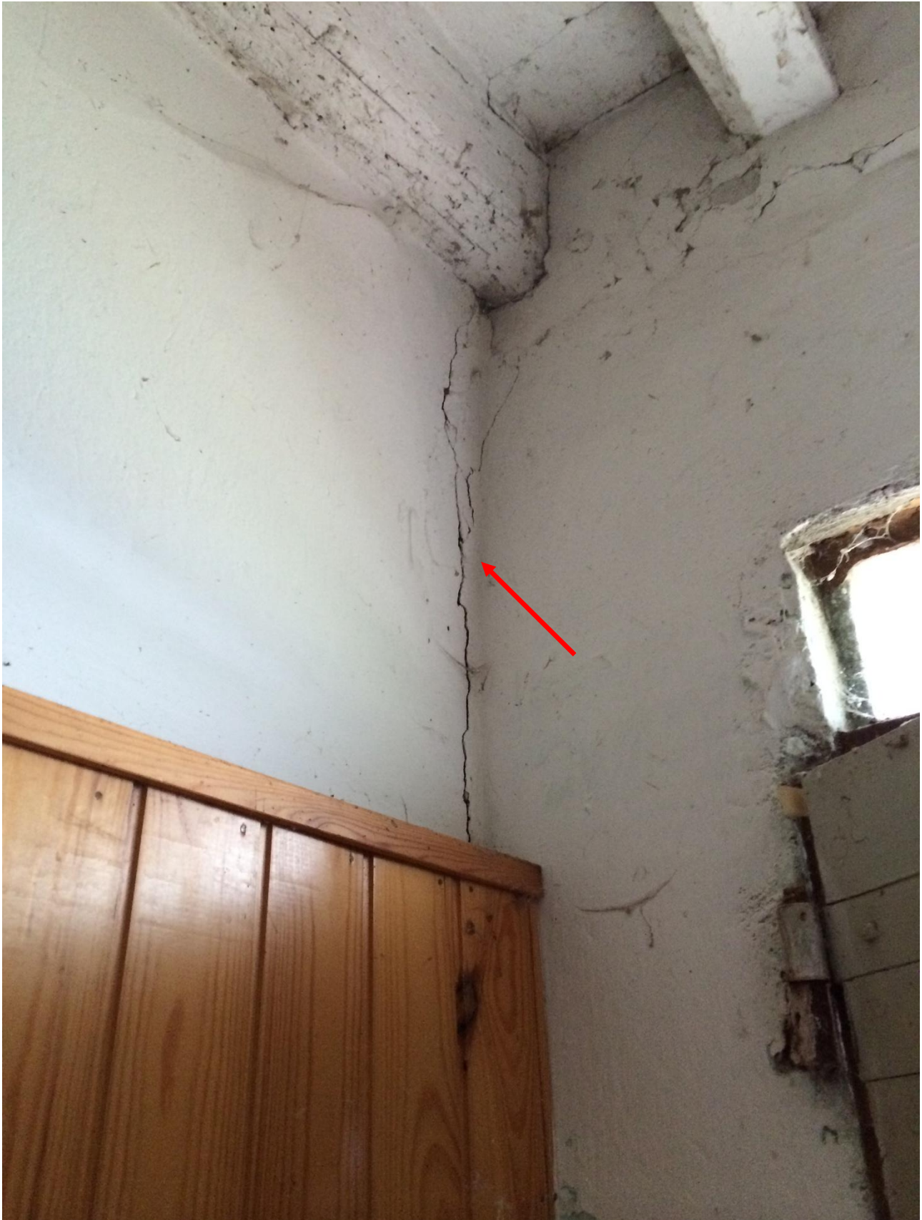
Fig. 61 – Lesione verticale nella parete portante
