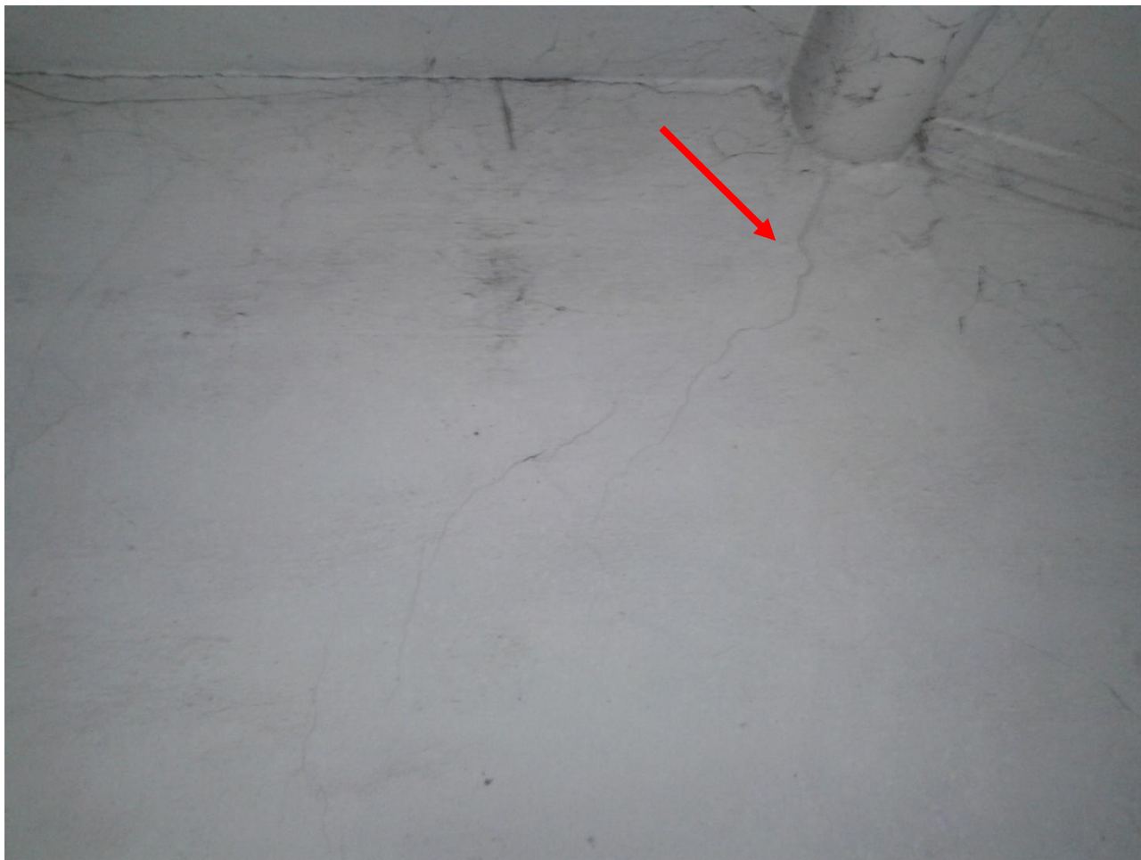
Fig. 64 – Lesione nella parete portante
