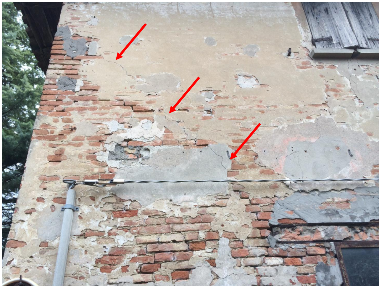
Fig. 2 – Lesione diagonale nella muratura portante esterna
