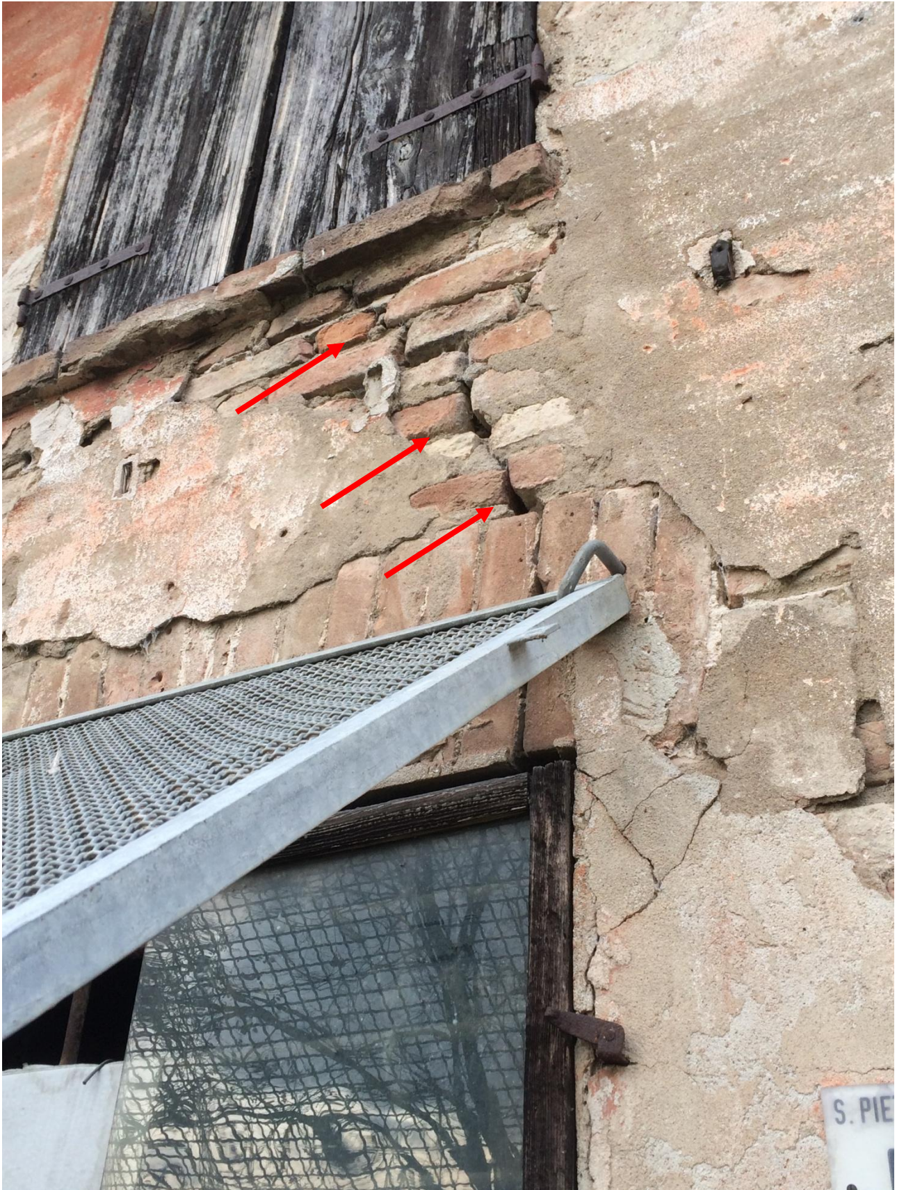
Fig. 15 – Lesione diagonale nella parete portante
