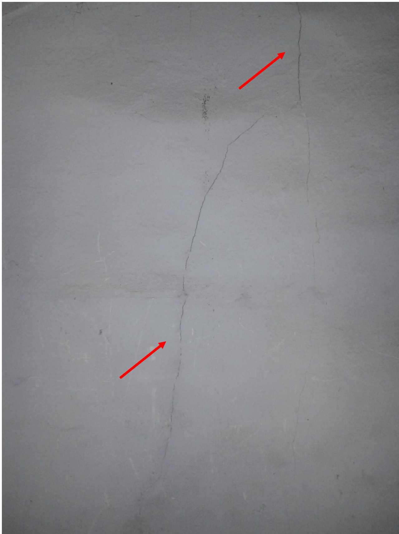
Fig. 52 – Lesione nella parete portante
