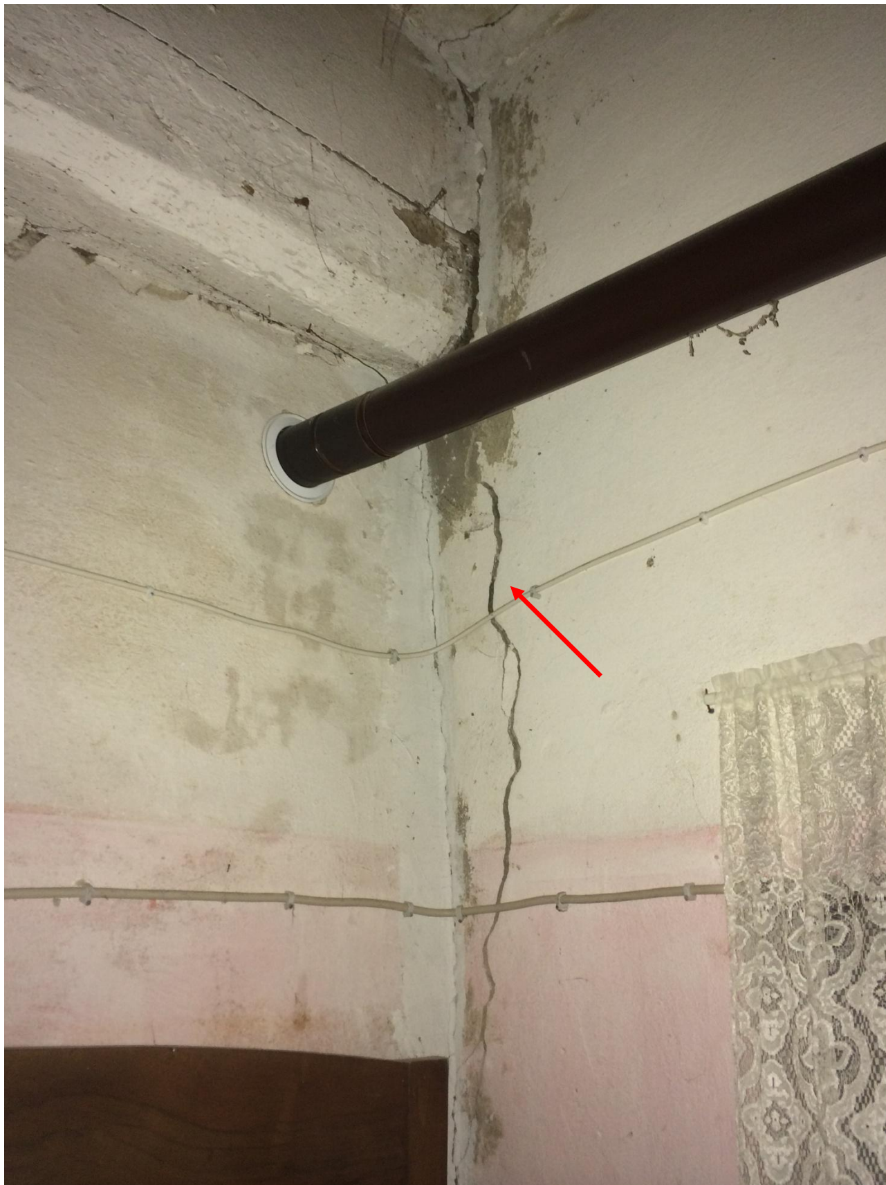
Fig. 48 – Distacco completo della parete portante
