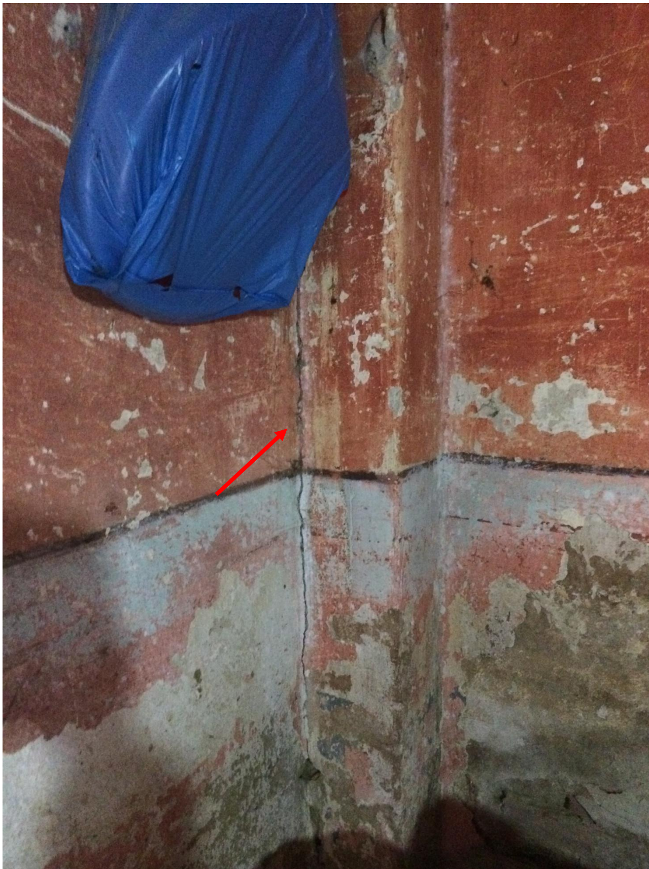
Fig. 31 – Lesione passante nella parete portante
