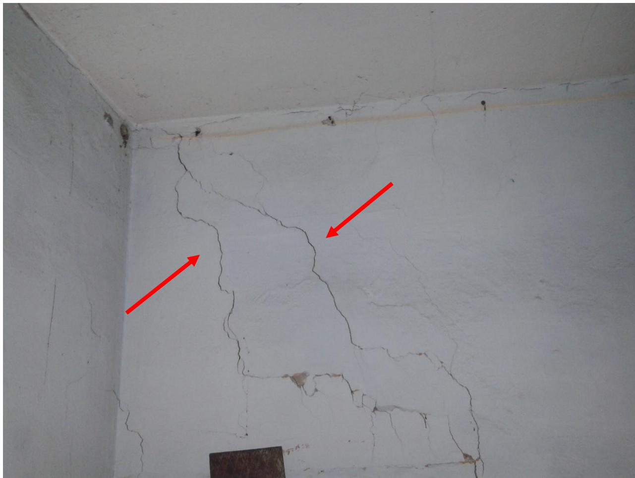
Fig. 59 – Lesioni nella parete portante
