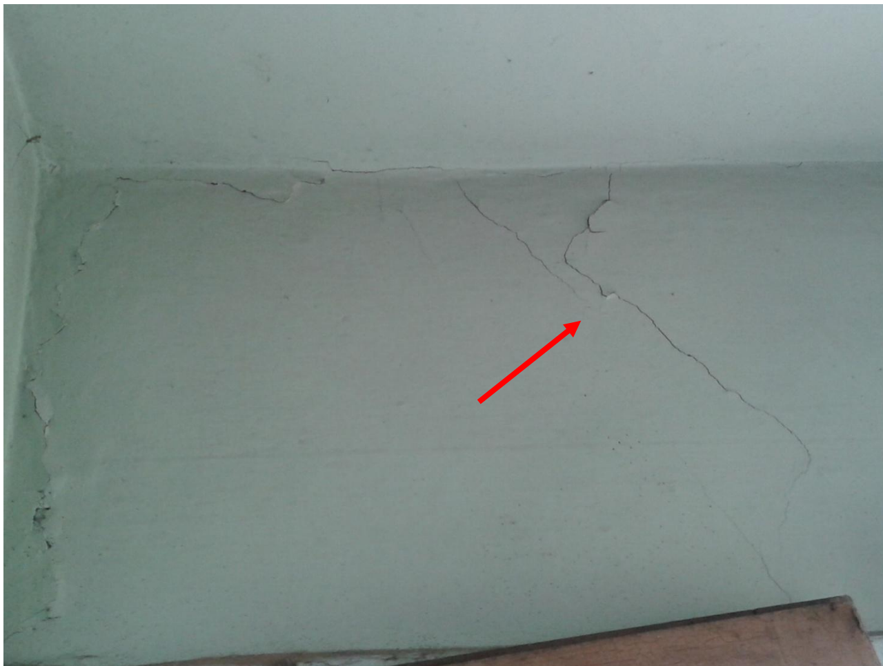
Fig. 96 – Lesione nella parete portante
