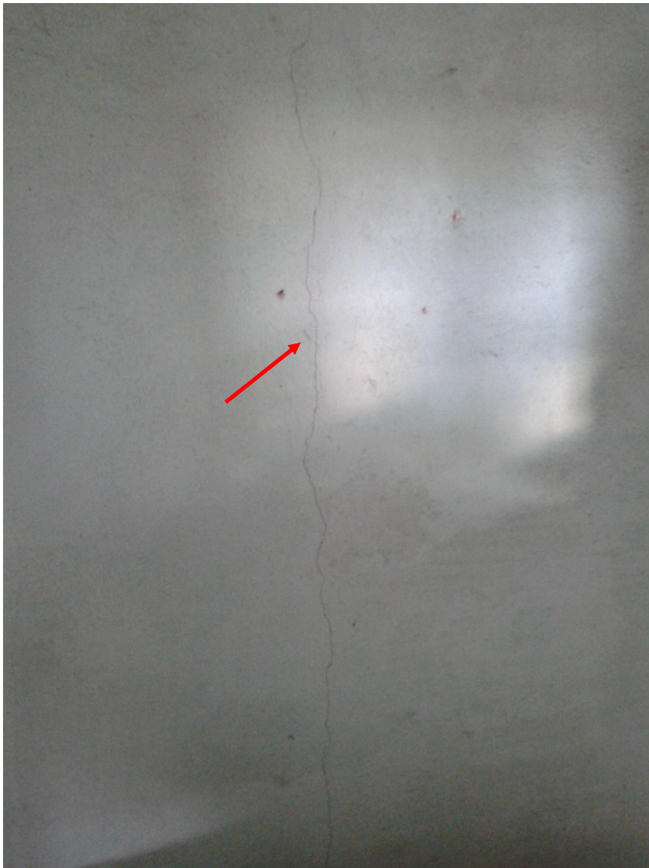
Fig. 77 – Lesione nella parete portante
