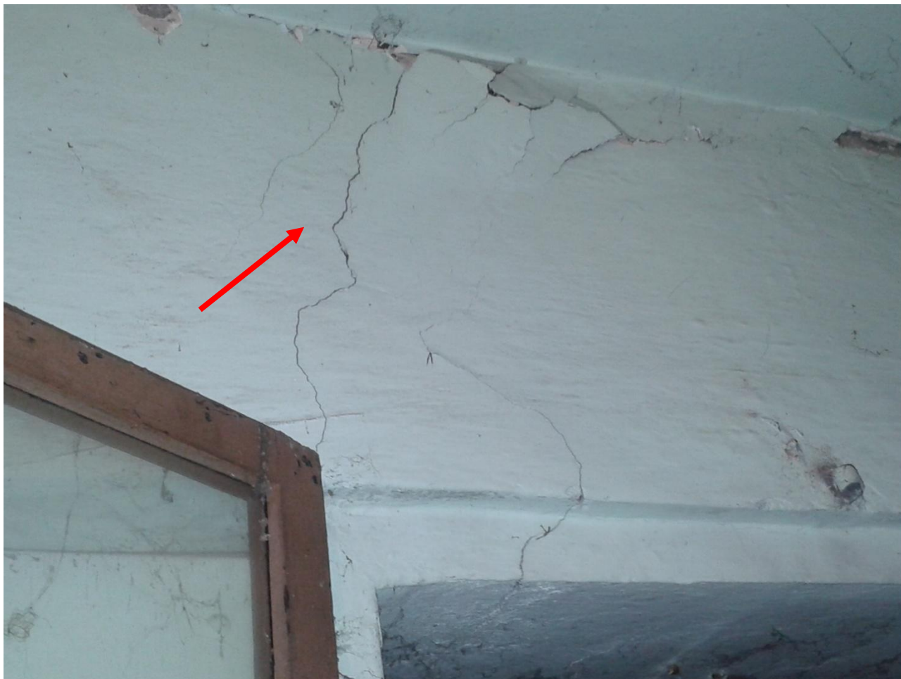
Fig. 95 – Lesione nella parete portante
