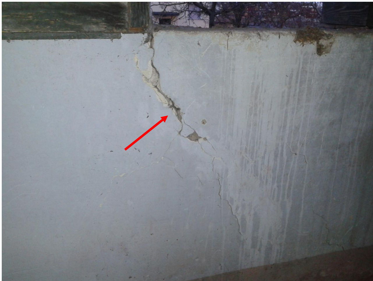
Fig. 80 – Lesione passante nella parete portante
