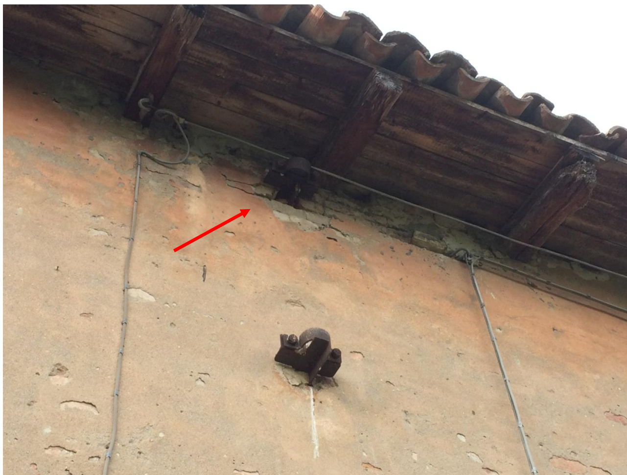
Fig. 14 – Lesioni nella parete esterna in corrispondenza del coperto in legno
