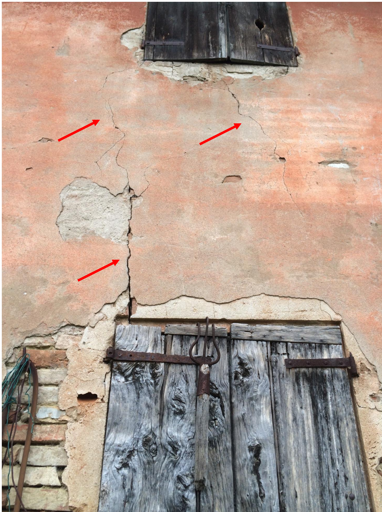
Fig. 18 – Lesioni passanti nella parete portante
