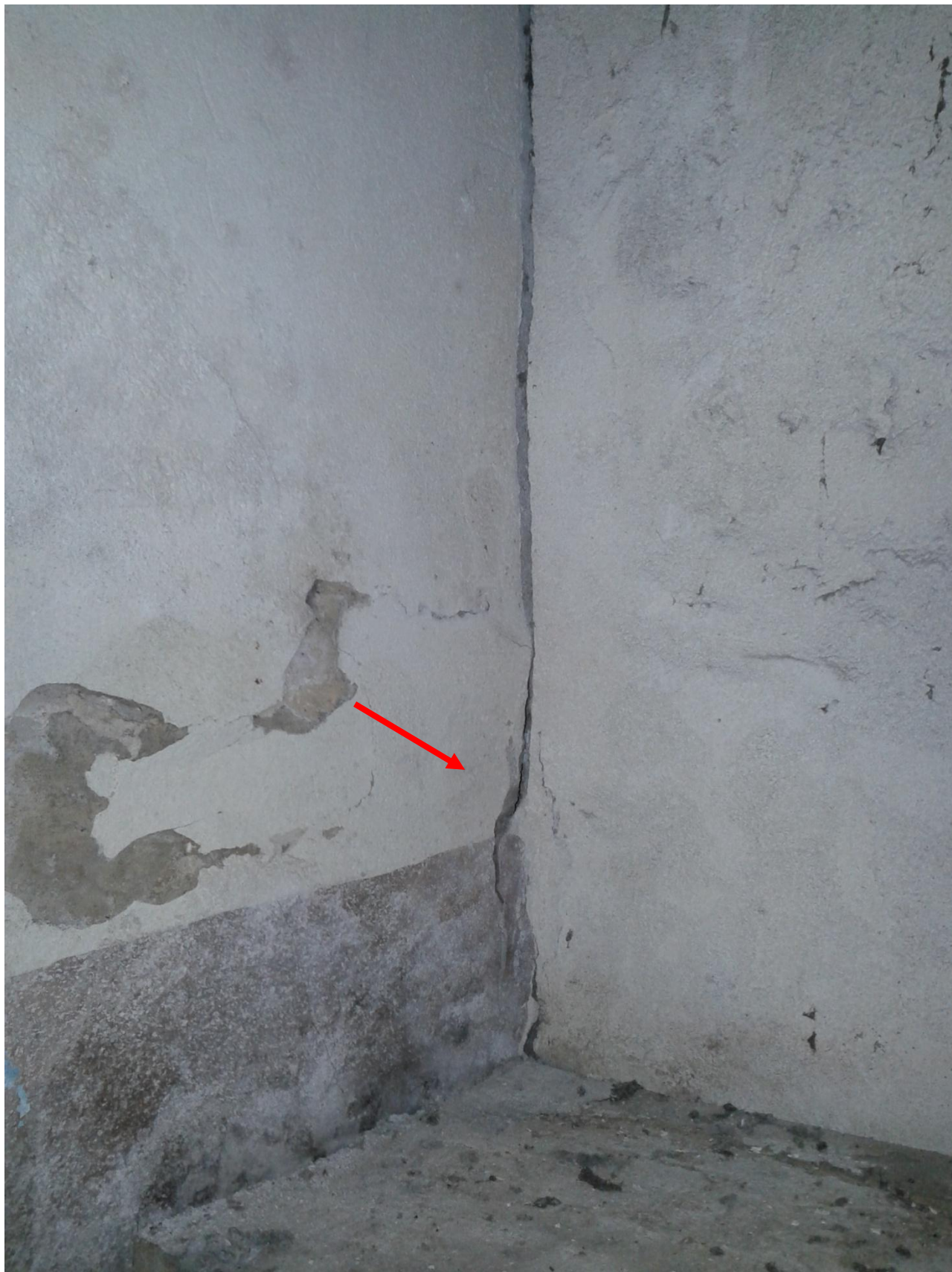
Fig. 46 – Lesione nella parete portante
