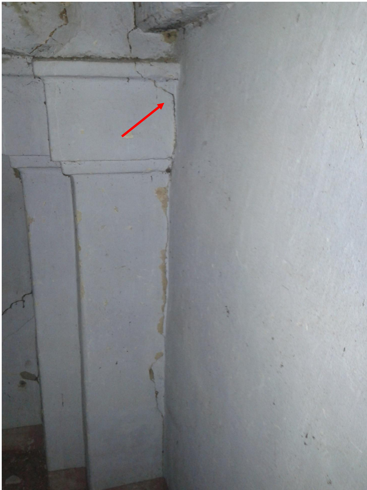
Fig. 36 – Lesione nella parete portante
