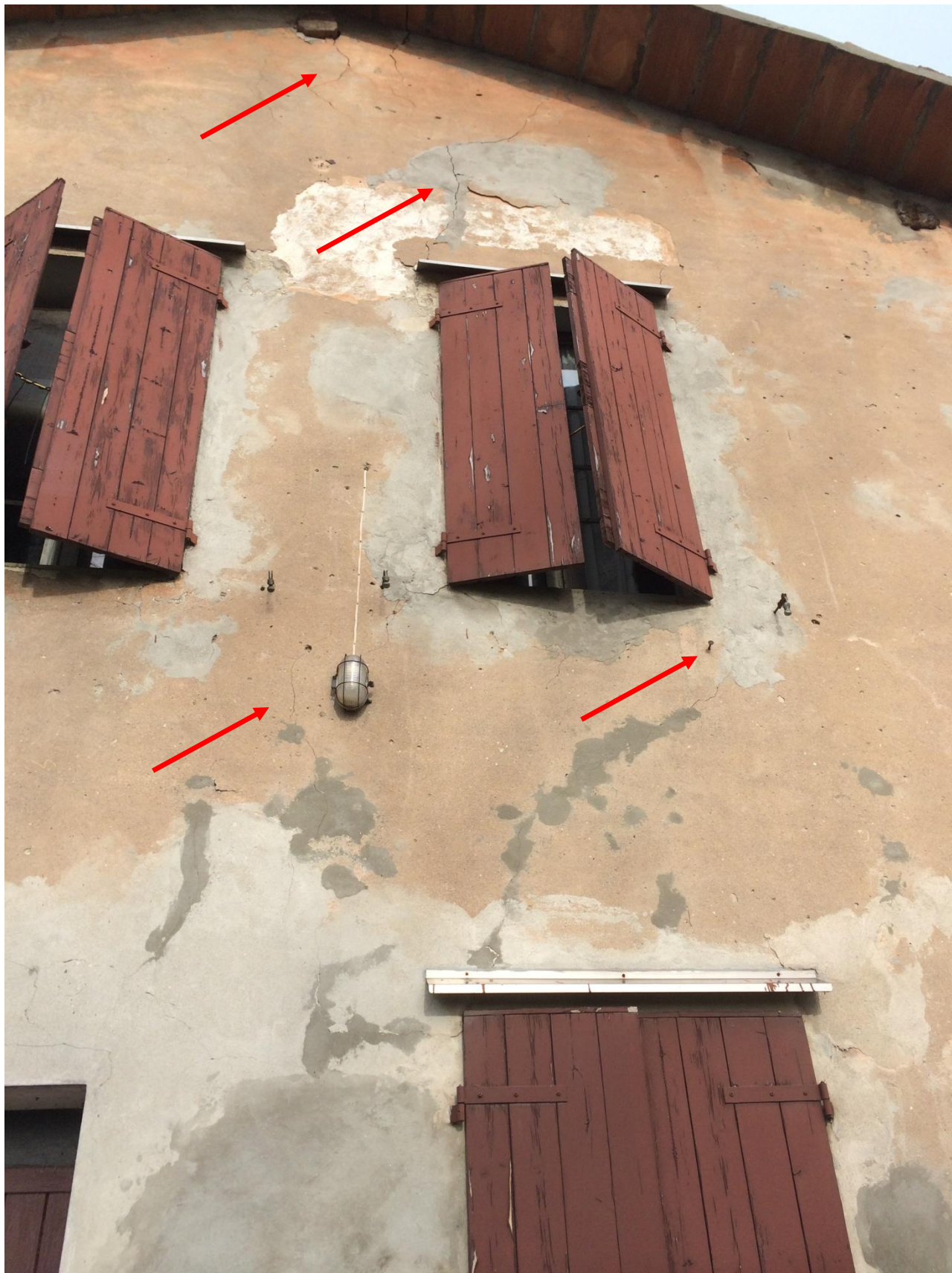
Fig. 6 – Lesioni diffuse nella parete esterna
