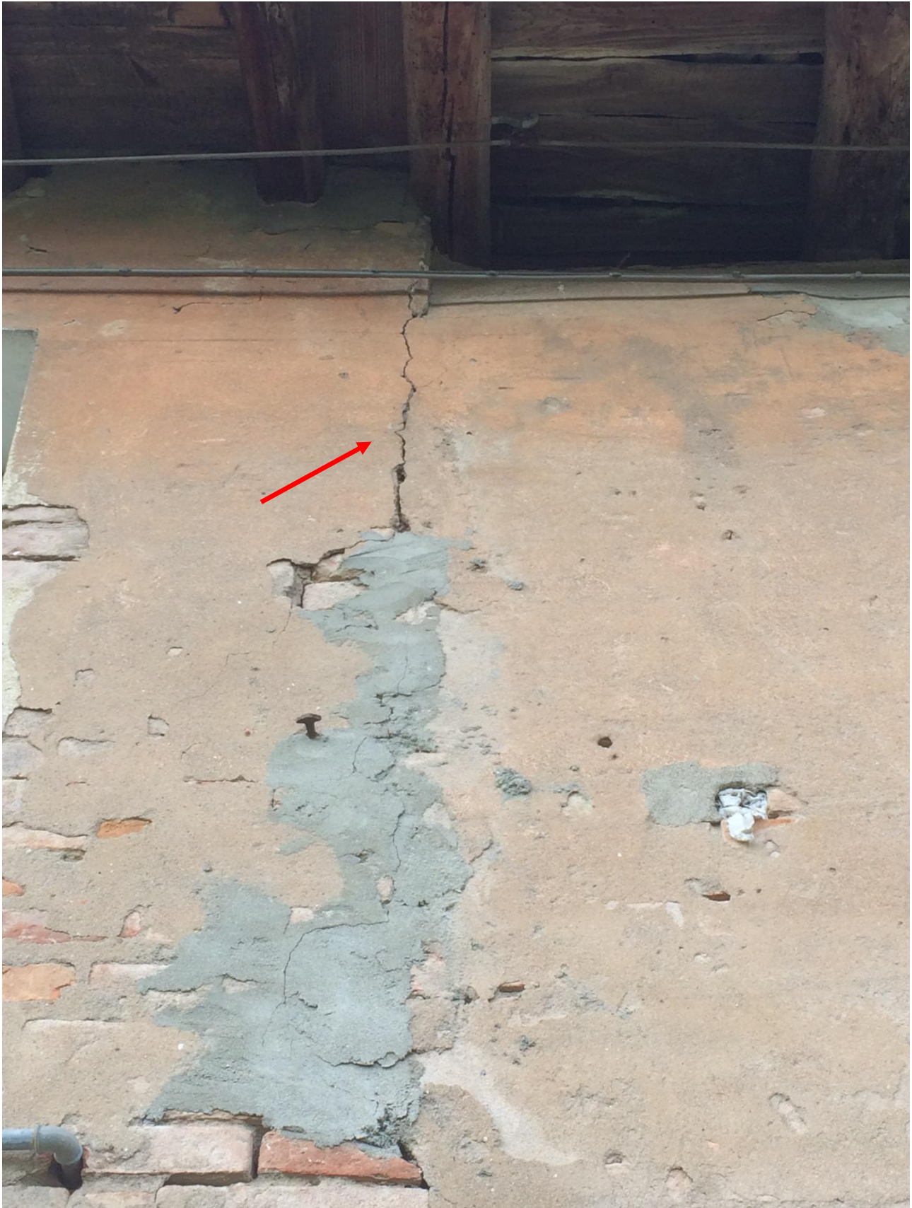
Fig. 17 – Lesioni nella parete esterna
