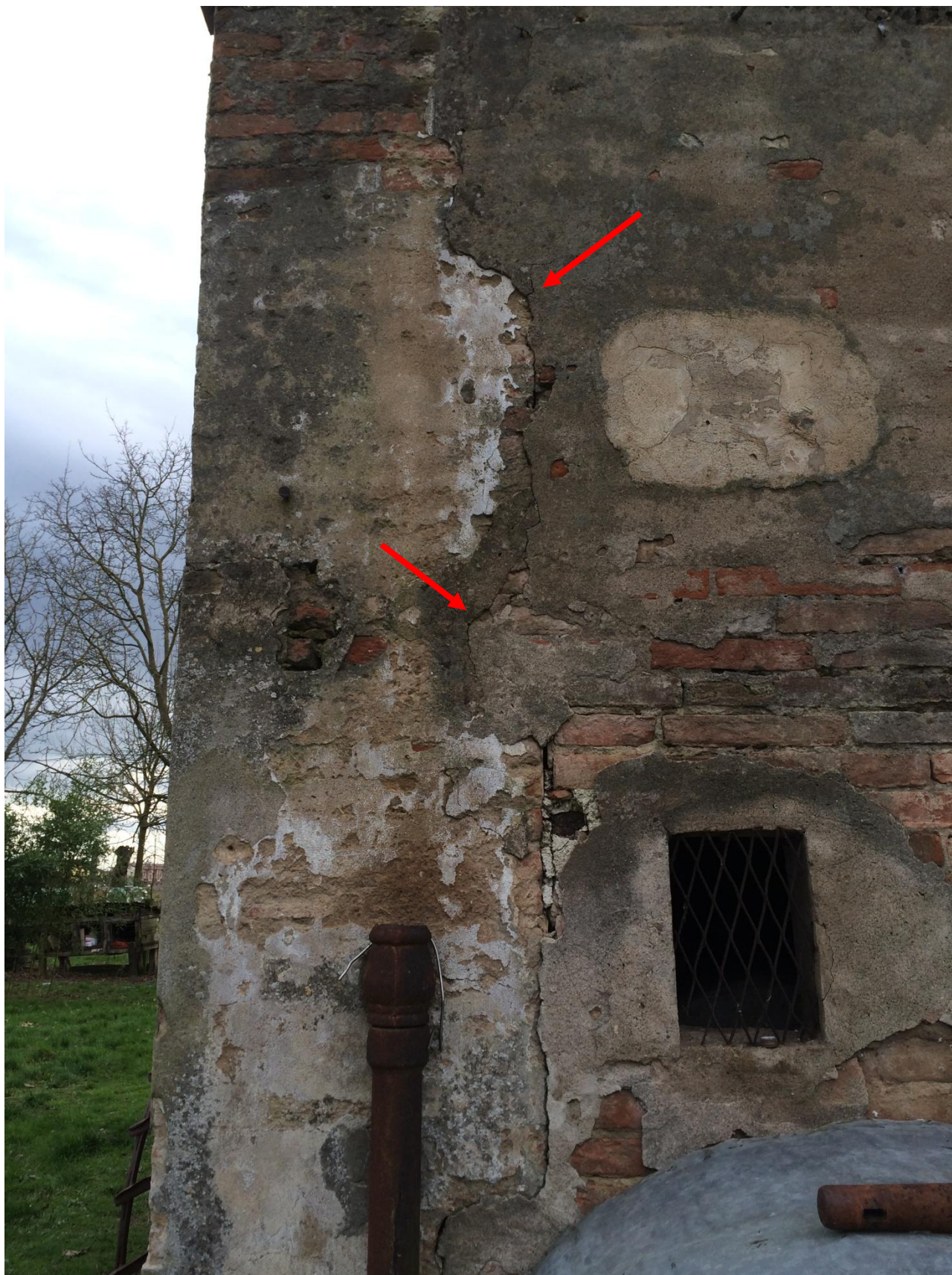
Fig. 23 – Lesione con distacchi della parete portante
