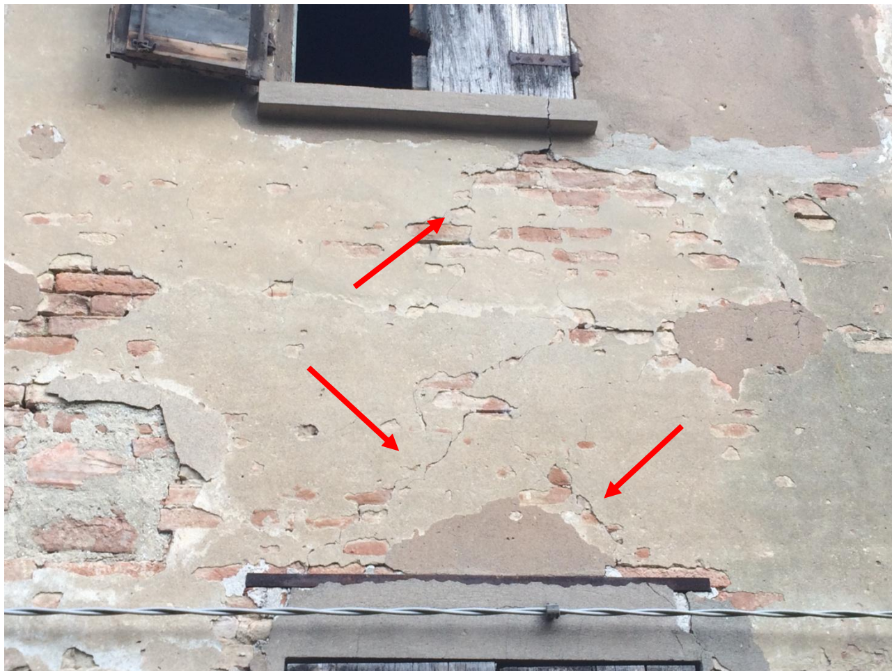
Fig. 5 - Lesioni diagonali nella muratura portante esterna
