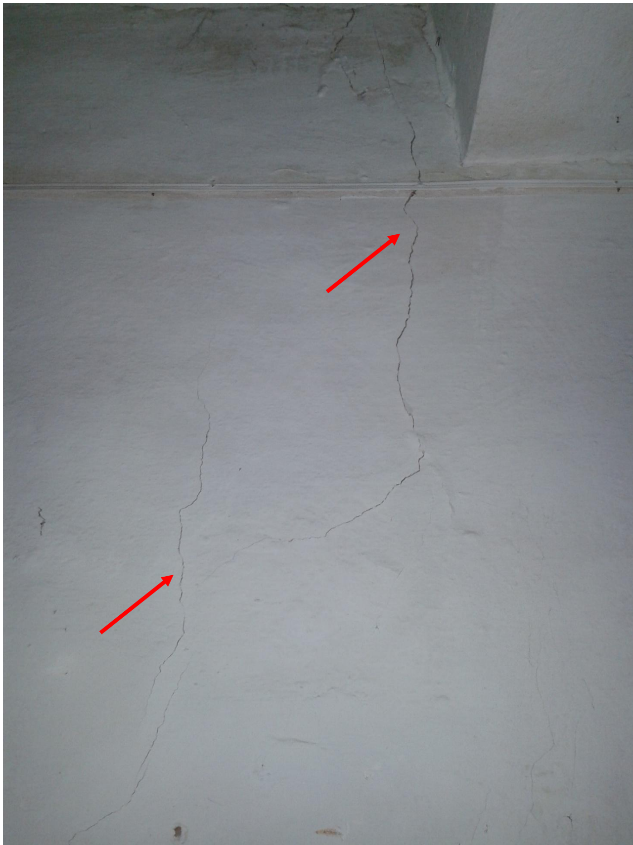
Fig. 99 – Lesione nella parete portante
