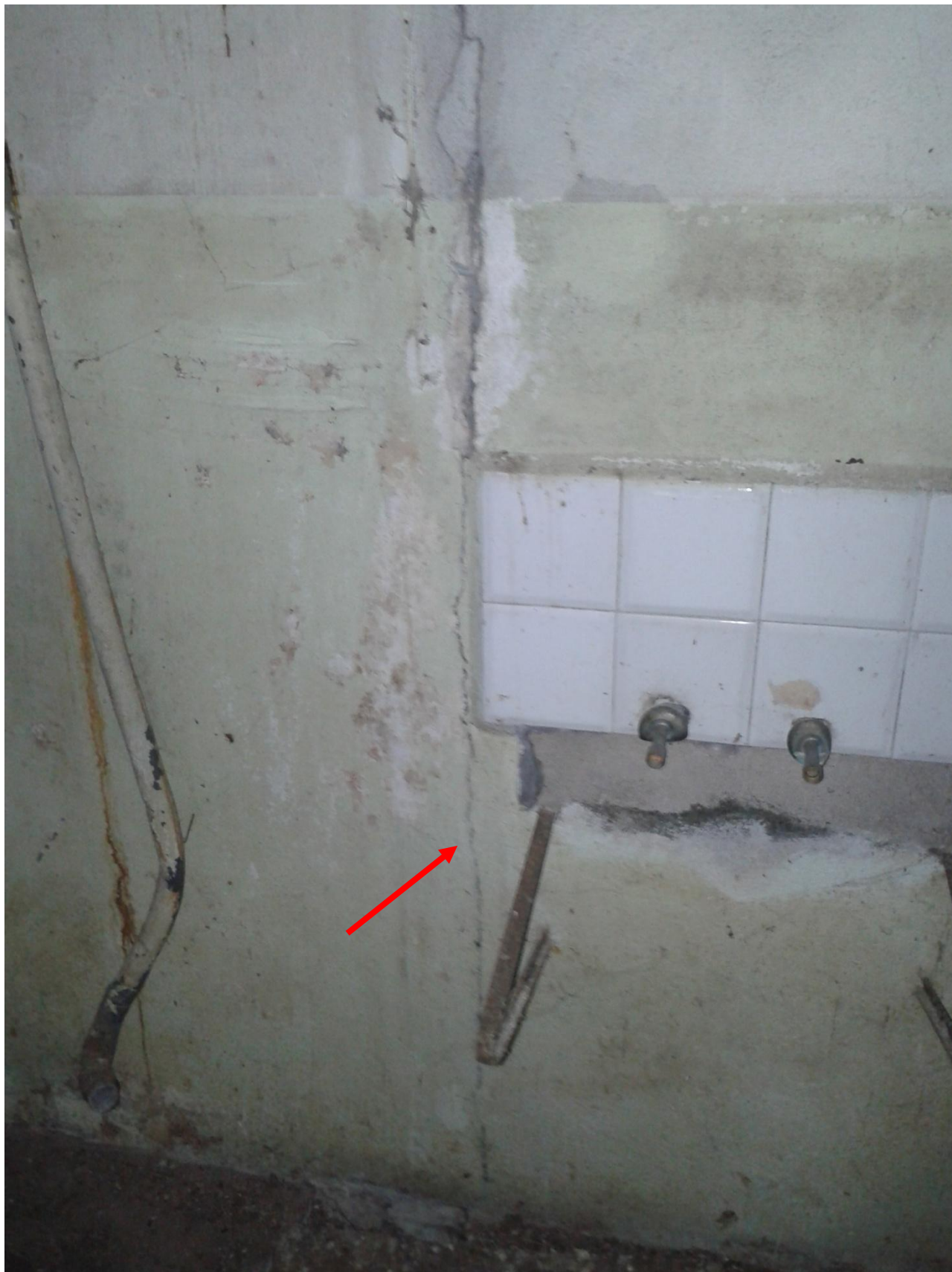
Fig. 67 – Lesione nella parete portante
