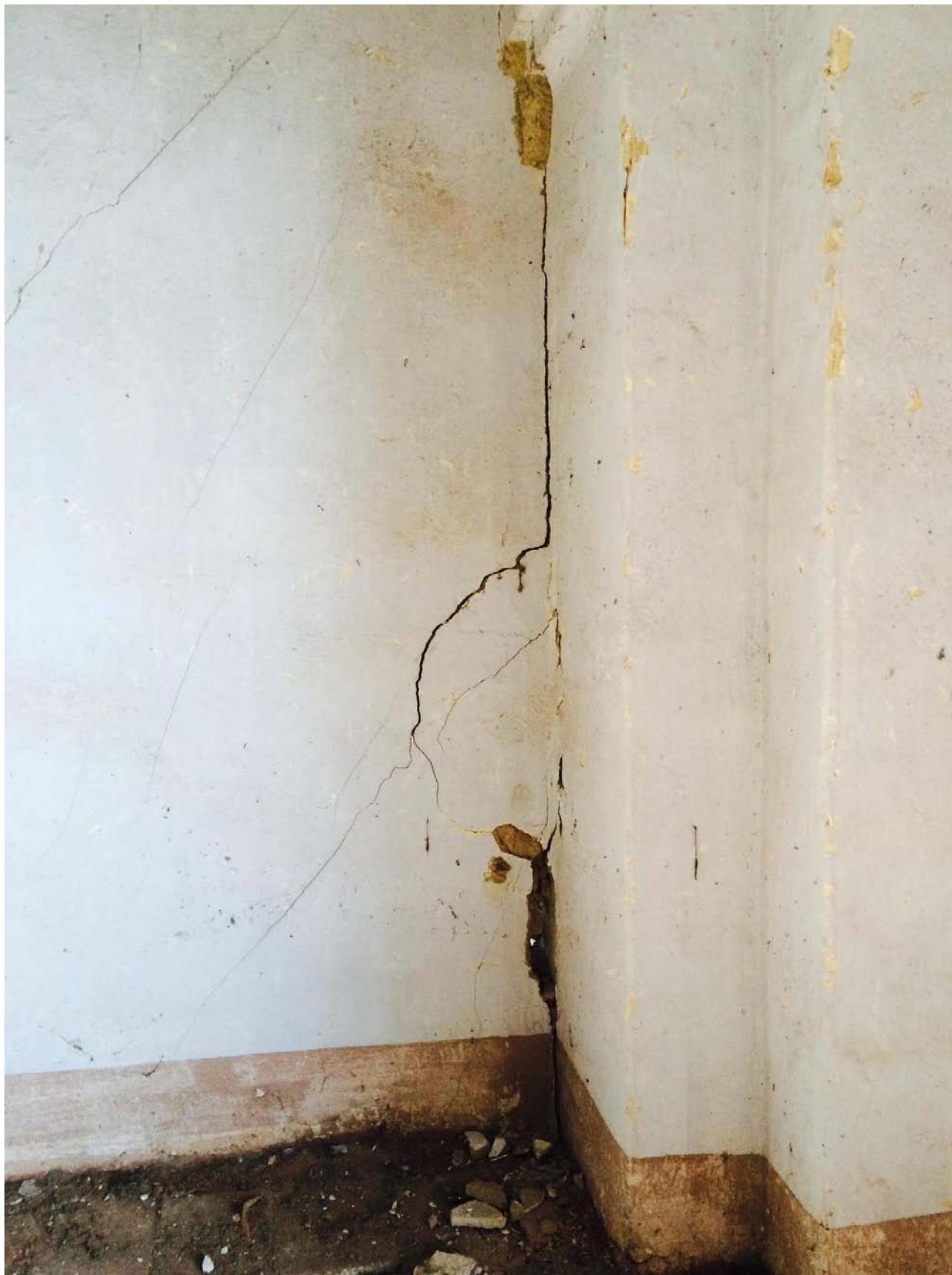
Fig. 33a – Lesione passante nella parete portante
