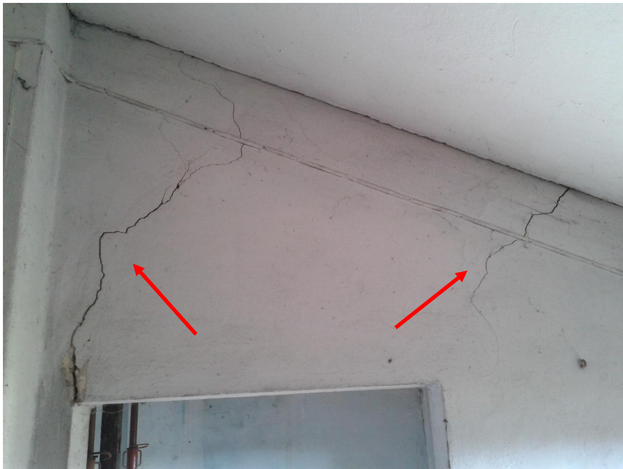
Fig. 72 – Lesione passante nella parete portante
