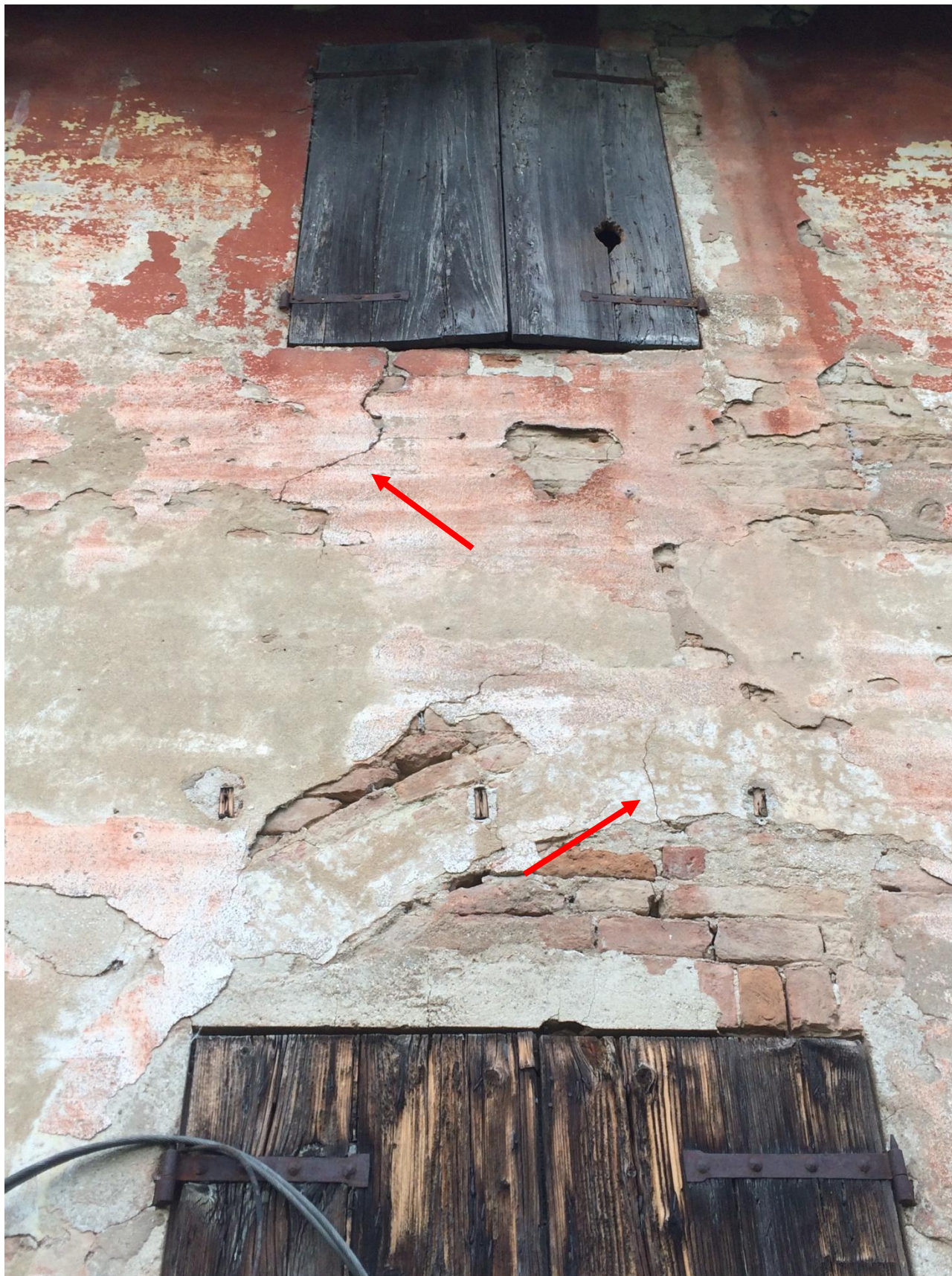
Fig. 11 – Lesione nella parete portante
