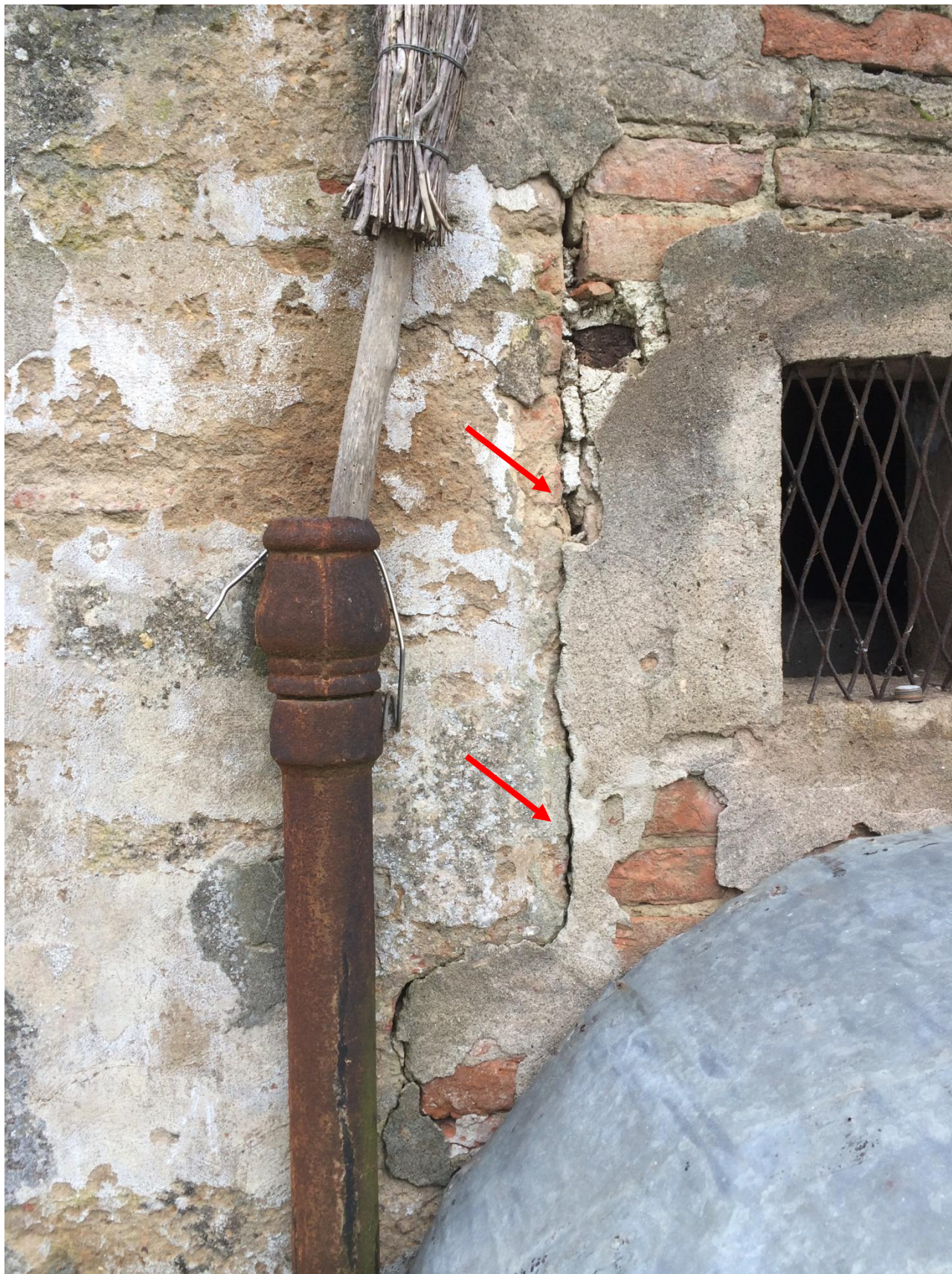
Fig. 22 – Lesione con distacchi della parete portante
