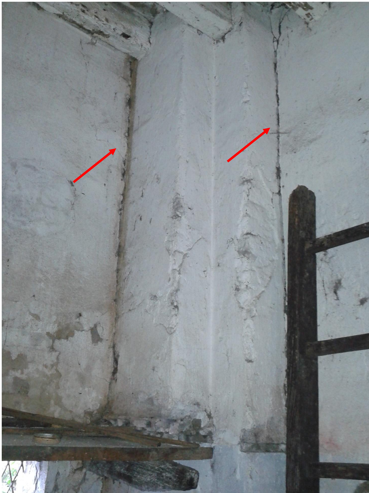
Fig. 41 – Lesioni passanti nella parete portante
