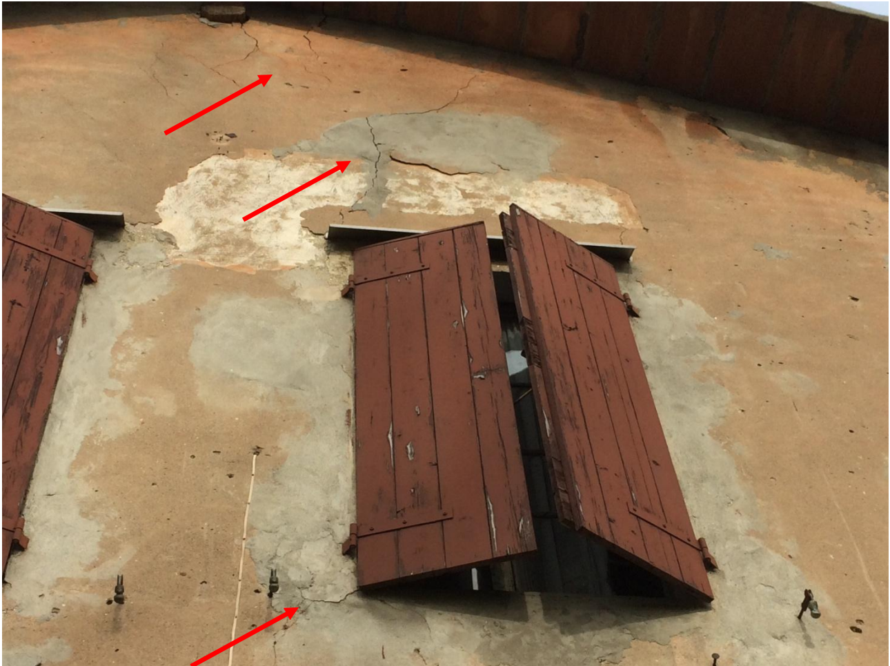
Fig. 10 – Lesioni nella parete esterna
