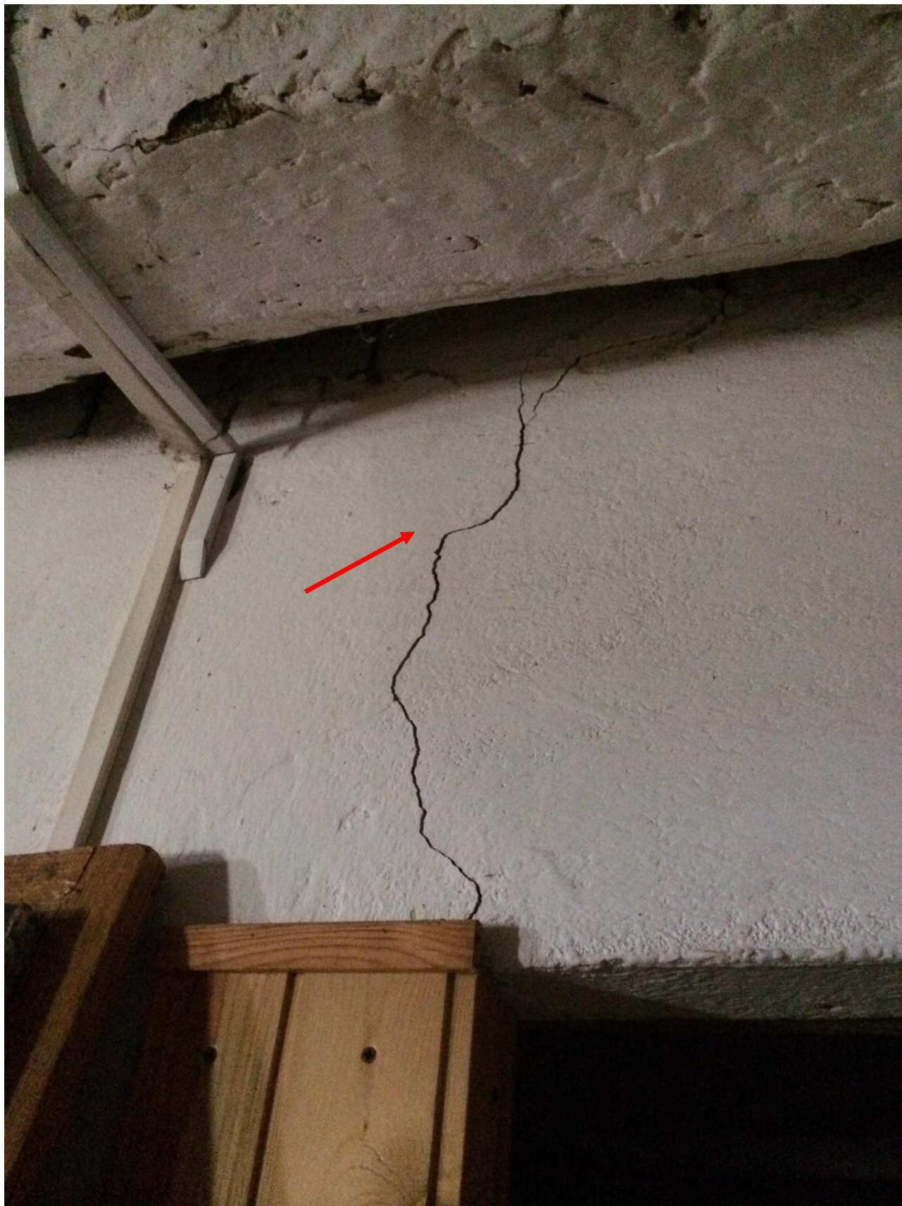
Fig. 31 – Lesioni nella muratura di tamponamento
