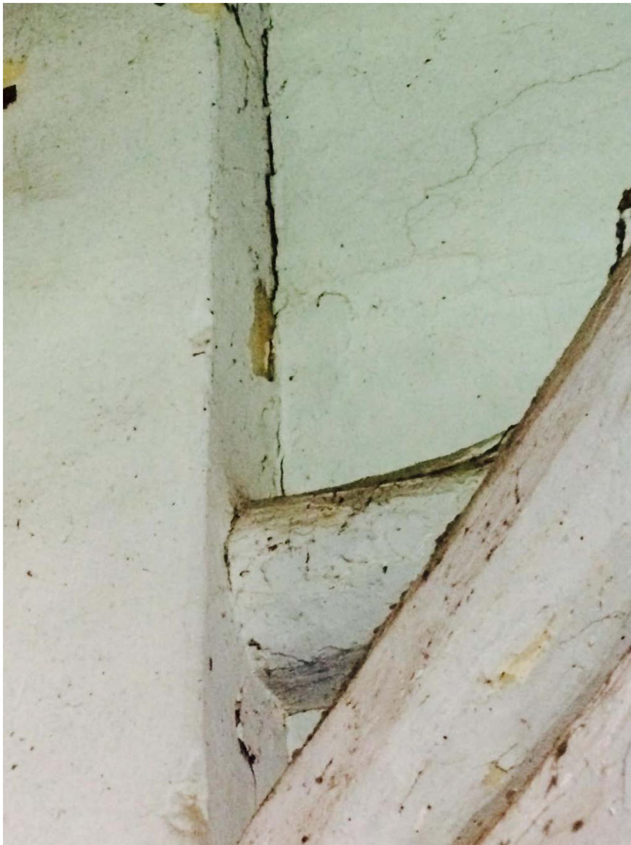
Fig. 49b – Lesione passante nella parete portante
