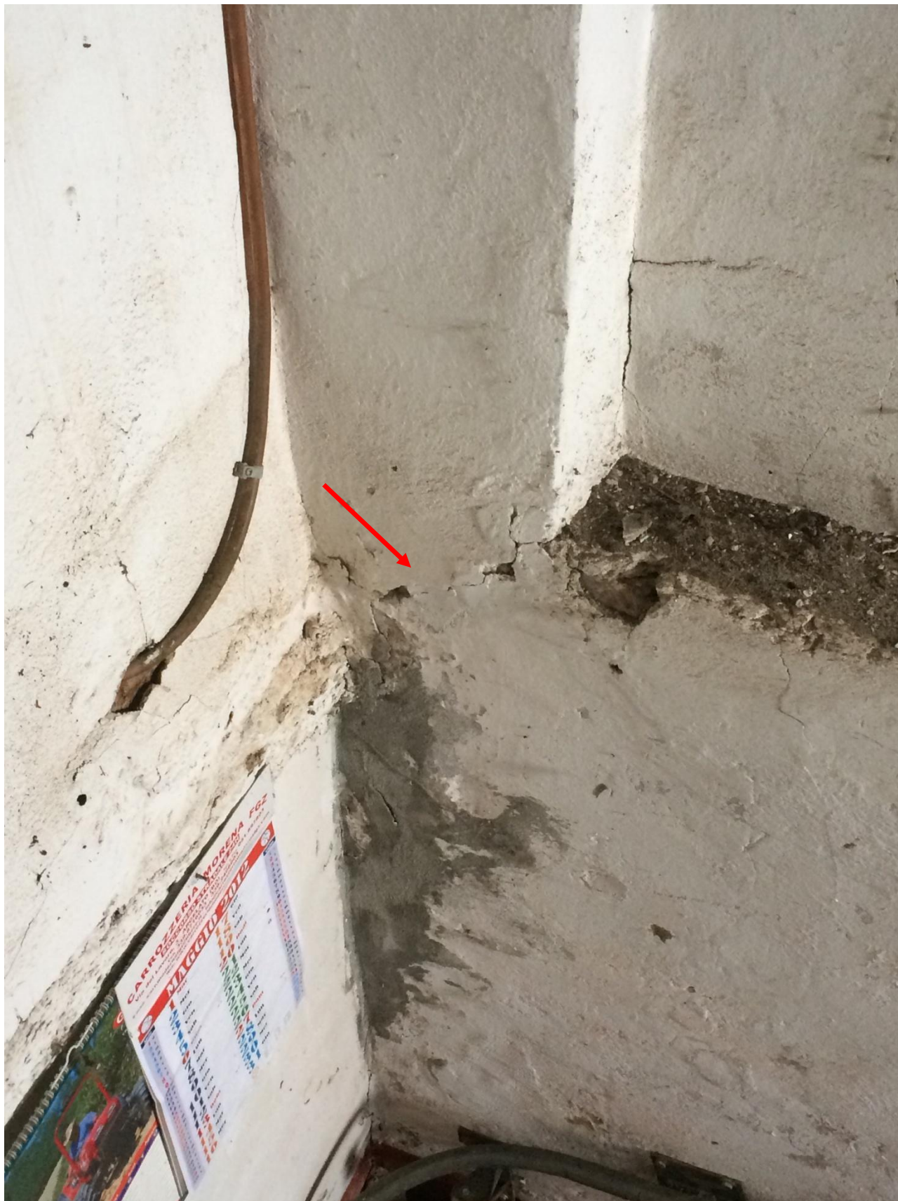
Fig. 33 – Taglio e rotazione alla base del pilastro in muratura
