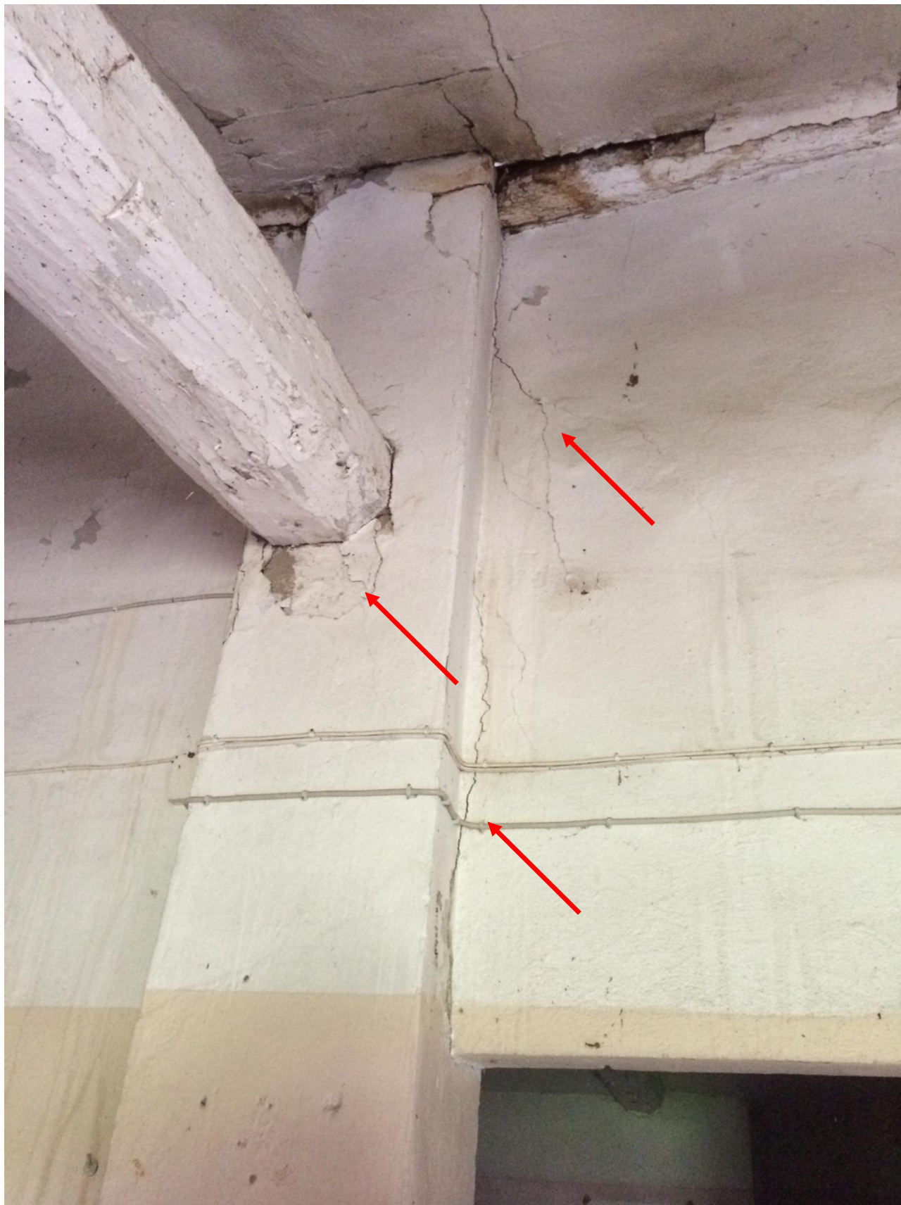
Fig. 39 – Lesioni nella muratura portante e sfondamento della trave di copertura nel pilastro
