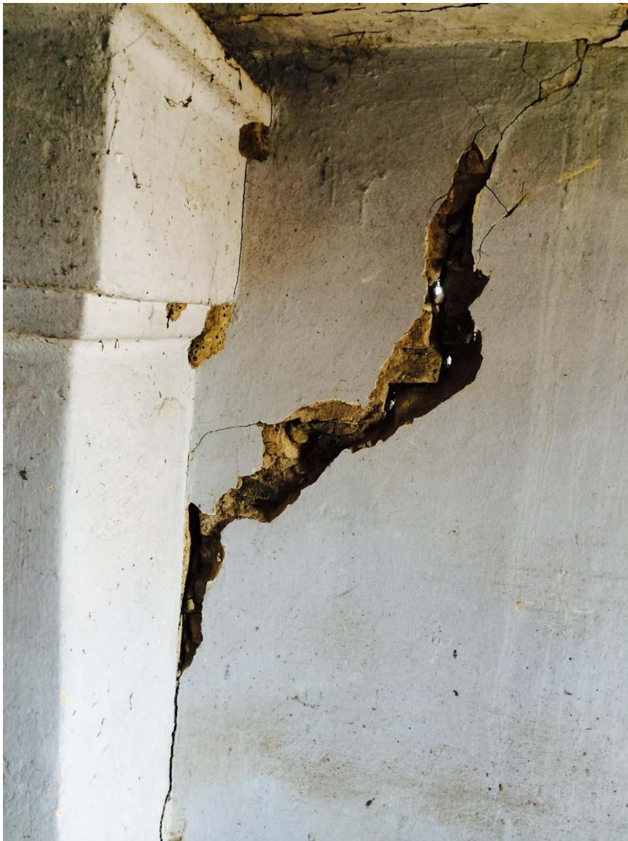
Fig. 33b – Lesione passante nella parete portante
