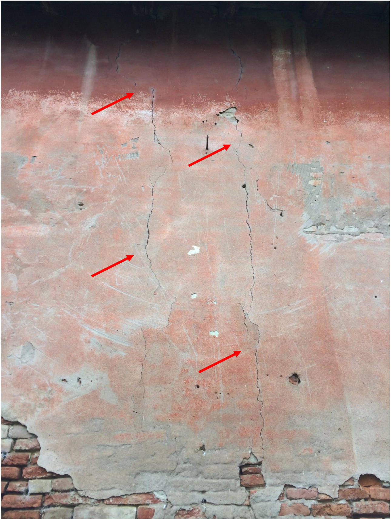
Fig. 19 – Lesioni verticali nella parete portante
