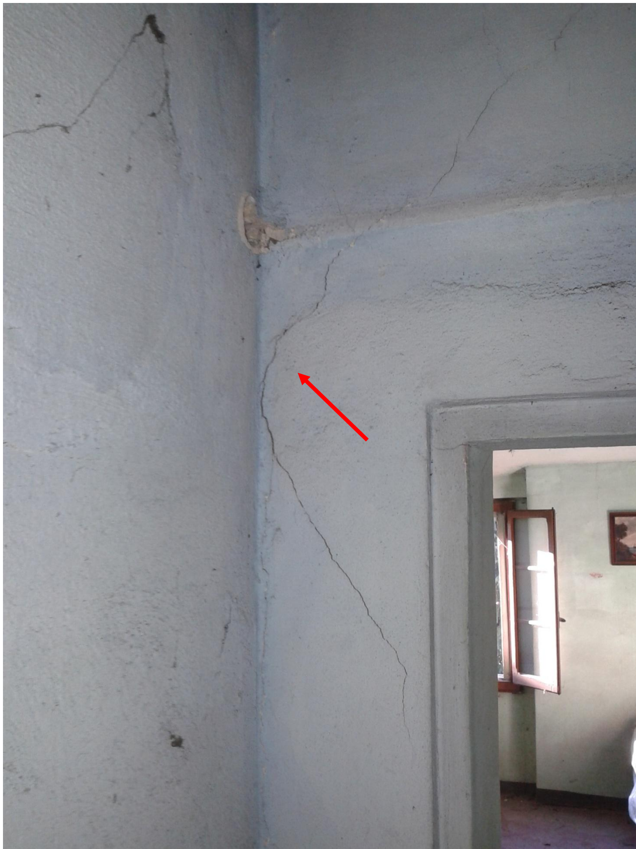
Fig. 74 – Lesione nella parete portante
