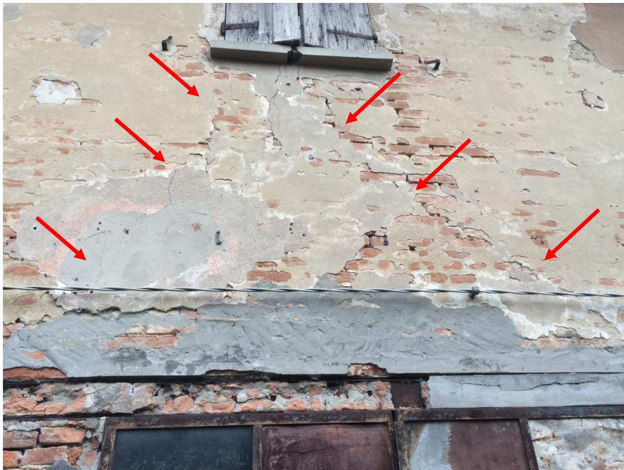
Fig. 3 – Lesioni diagonali nella muratura portante esterna
