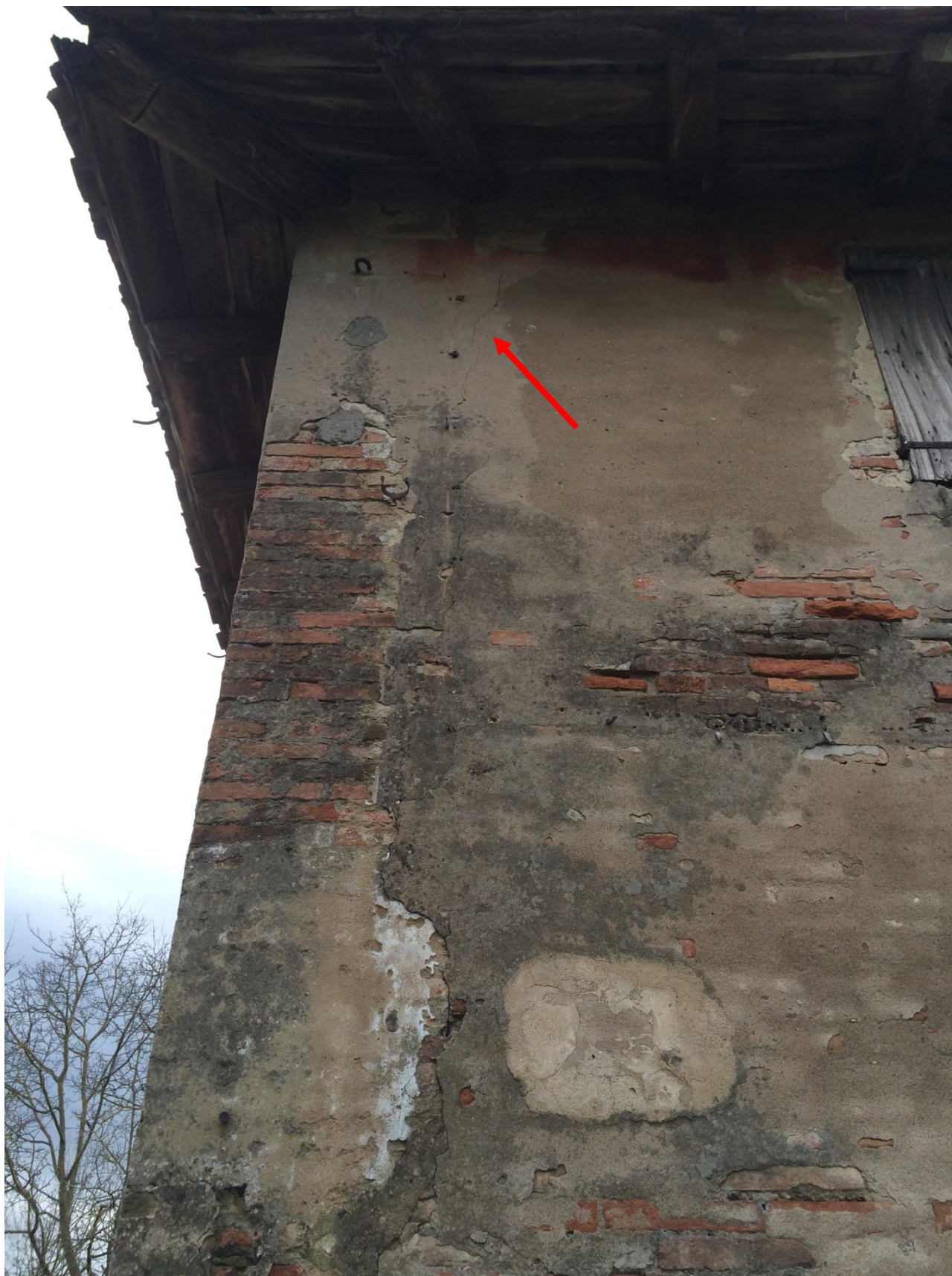
Fig. 24 – Lesione verticale nella parete portante
