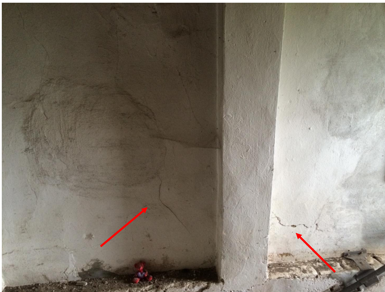
Fig. 38 – Lesioni nella muratura portante e nel pilastro
