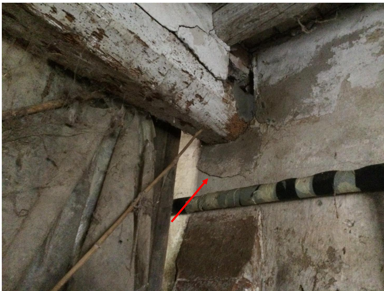
Fig. 57 – Lesione nella parete portante a causa dello spostamento della trave in legno
