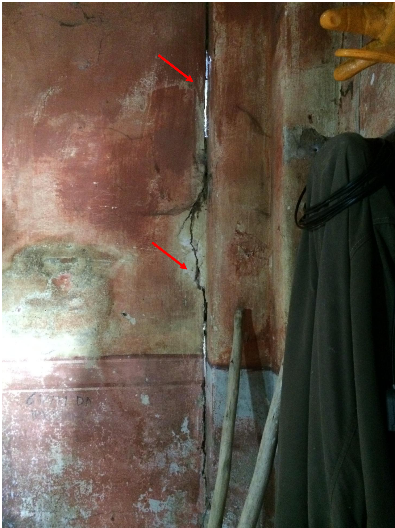
Fig. 28 – Lesione passante nella parete portante
