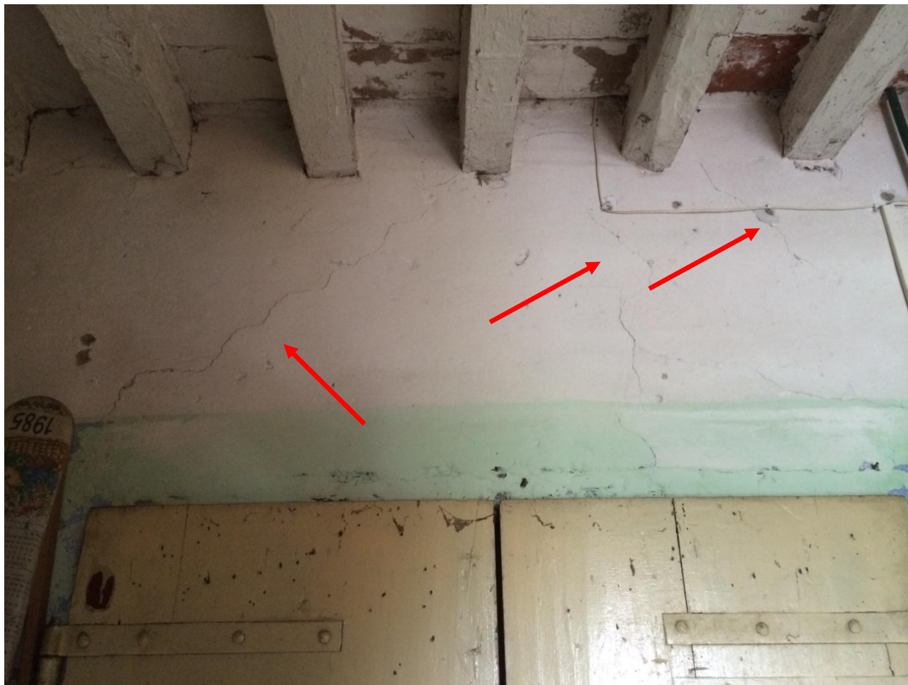
Fig. 28 – Lesioni diagonali e verticali nella muratura portante
