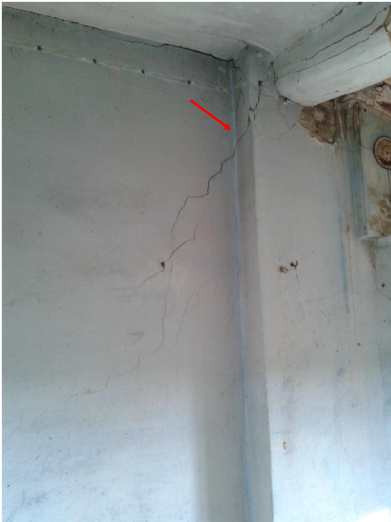
Fig. 70 – Lesione nella parete portante
