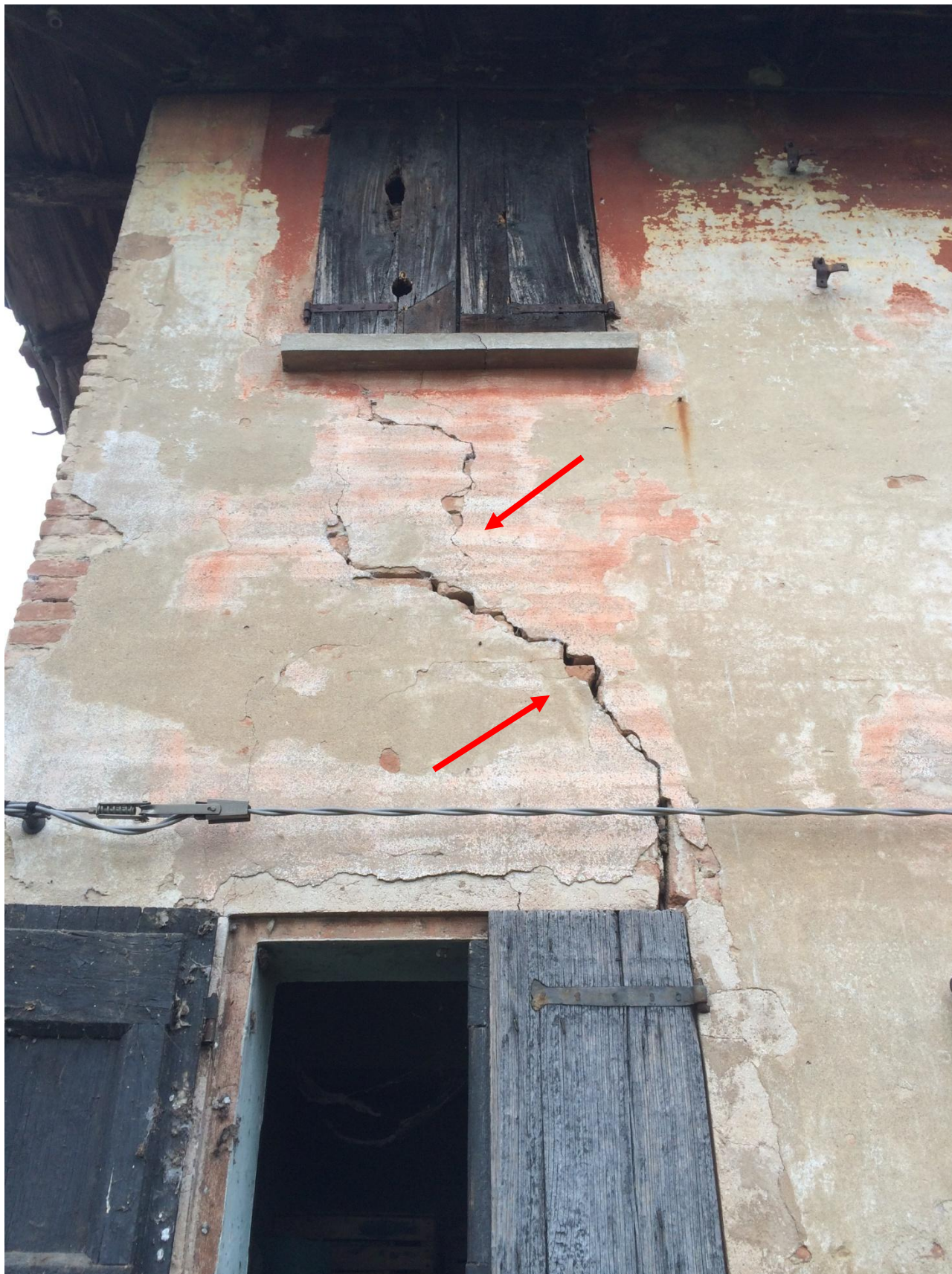
Fig. 9 – Lesioni diagonali passanti nella parete portante
