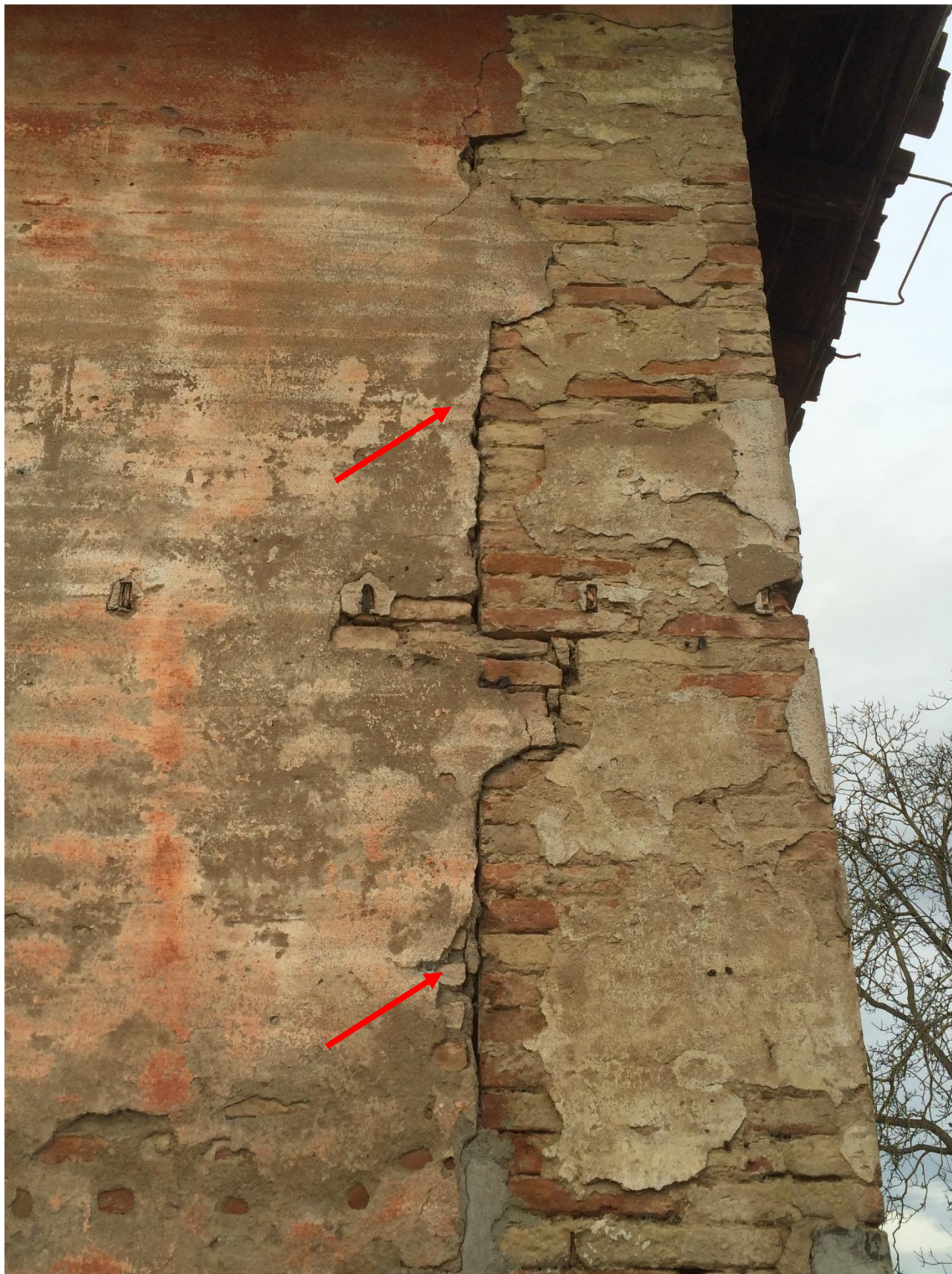
Fig. 13 – Fessure passanti con distacchi della parete portante
