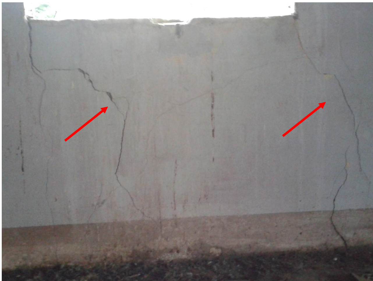
Fig. 34 – Lesioni nella parete portante
