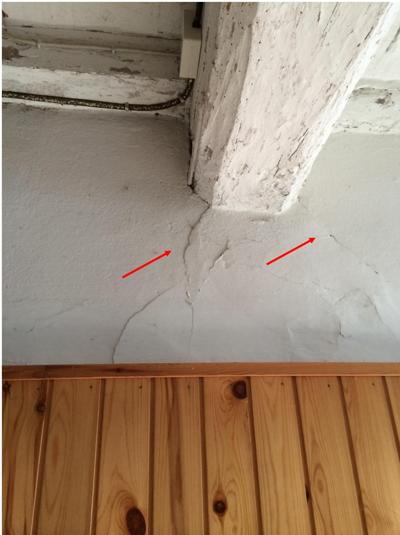
Fig. 25 – Lesioni nella muratura portante causate dallo sfilamento della trave in legno
