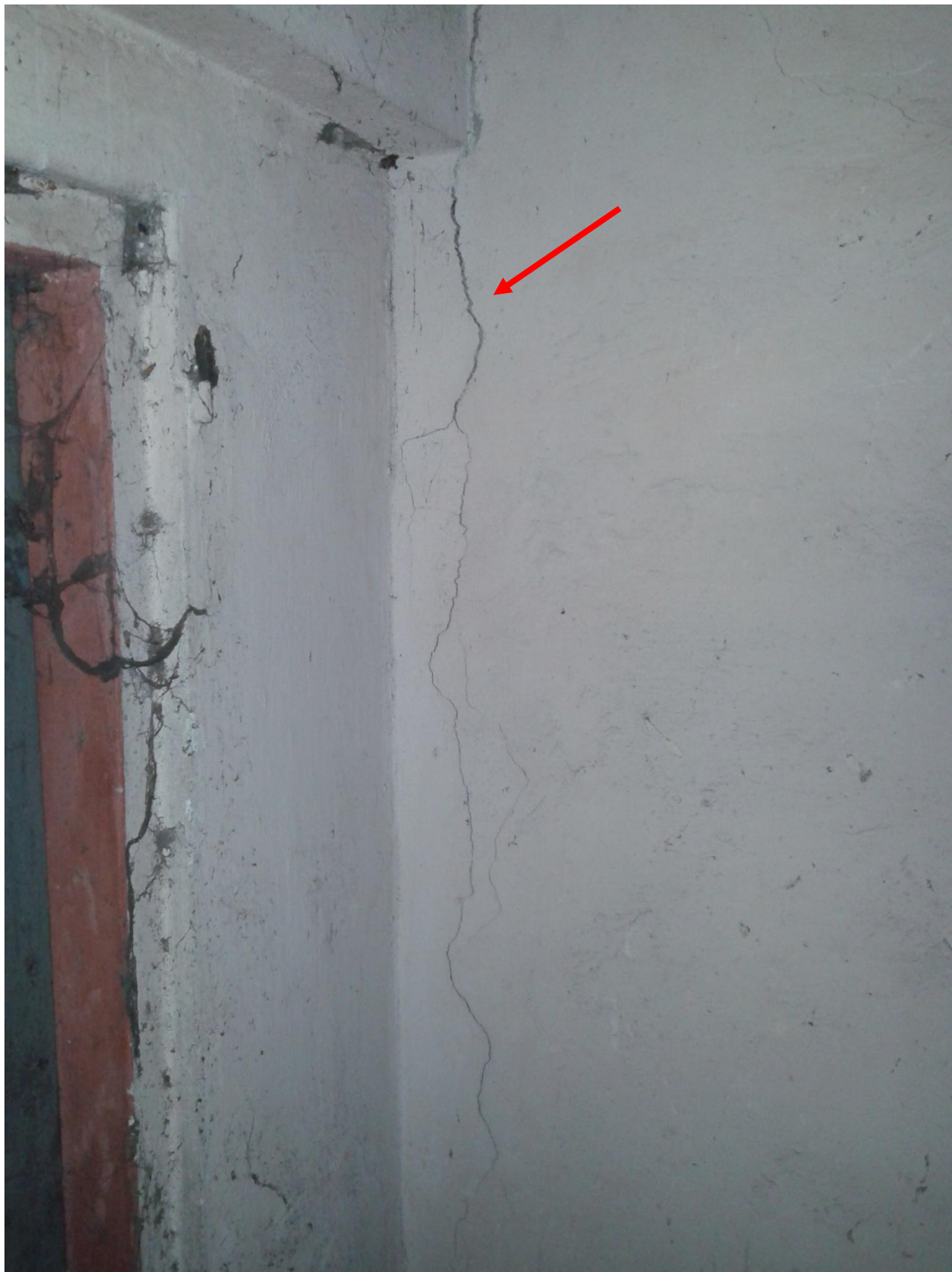
Fig. 55 – Lesione nella parete portante
