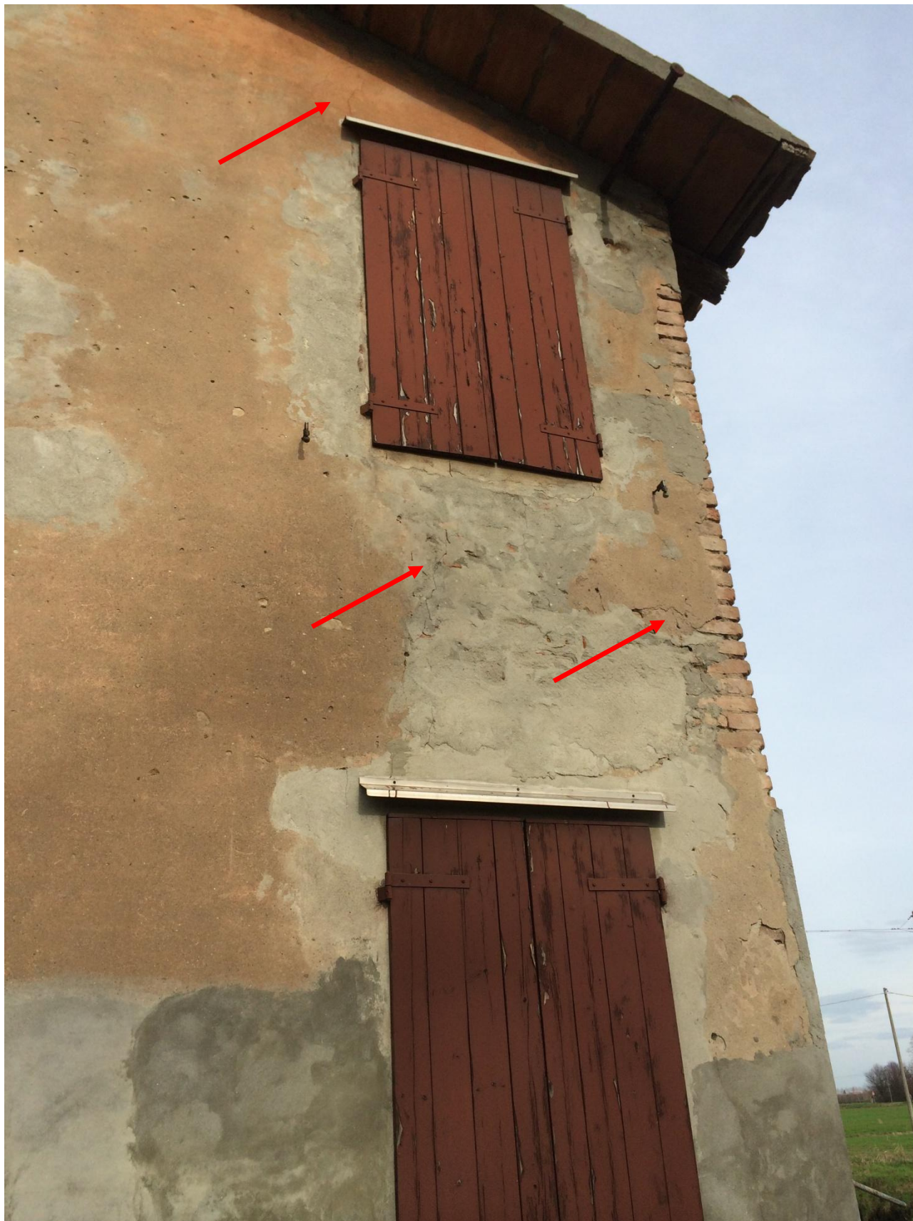
Fig. 8 – Lesioni nella parete esterna
