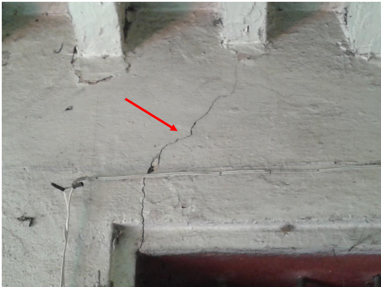
Fig. 91 – Lesione nella parete portante
