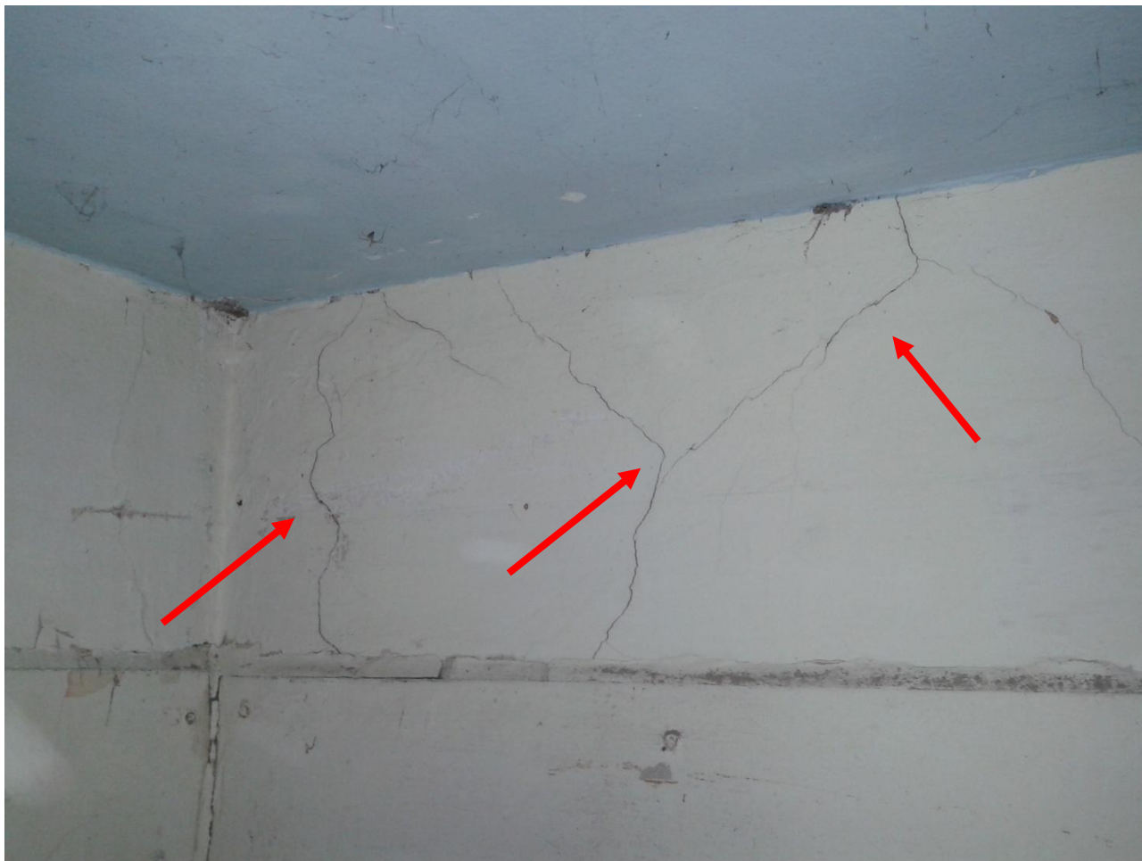
Fig. 100 – Lesioni nella parete portante
