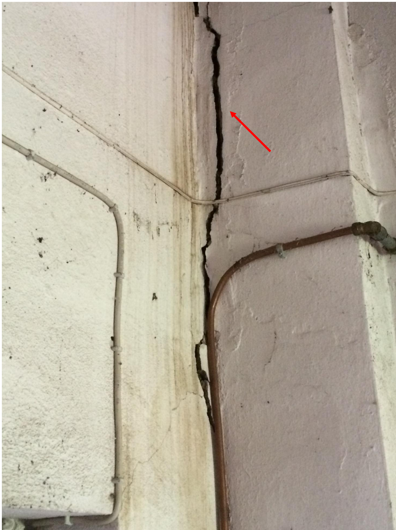
Fig. 36 – Distacco completo del pilastro con perdita di verticalità in entrambe le direzioni
