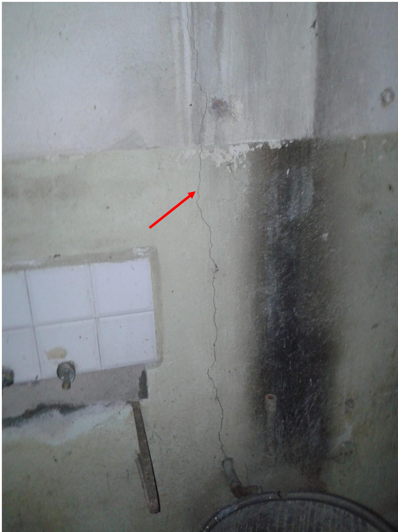
Fig. 69 – Lesione nella parete portante
