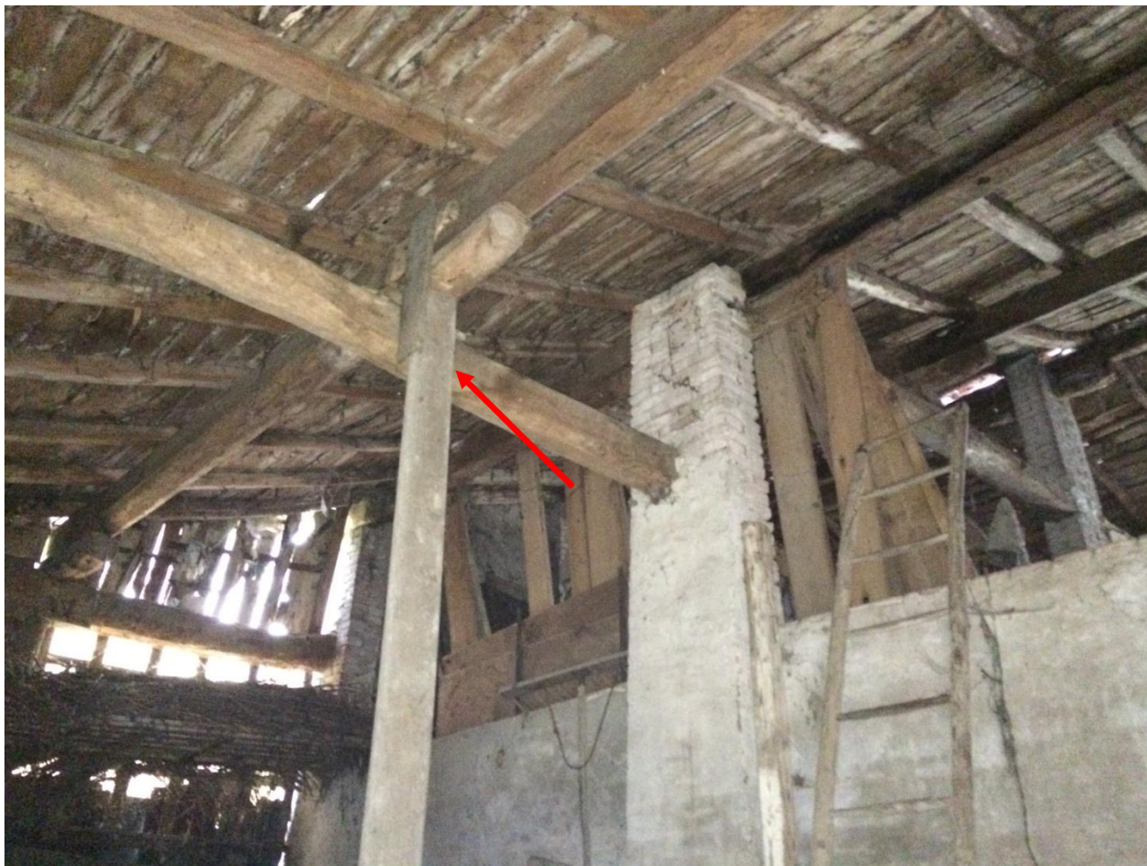
Fig. 60 – Rottura della trave in legno ed inserimento di puntello in legno per evitare il crollo della copertura
