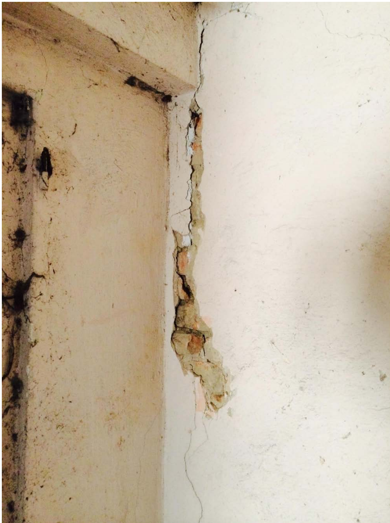
Fig. 55 – Lesione passante nella parete portante
