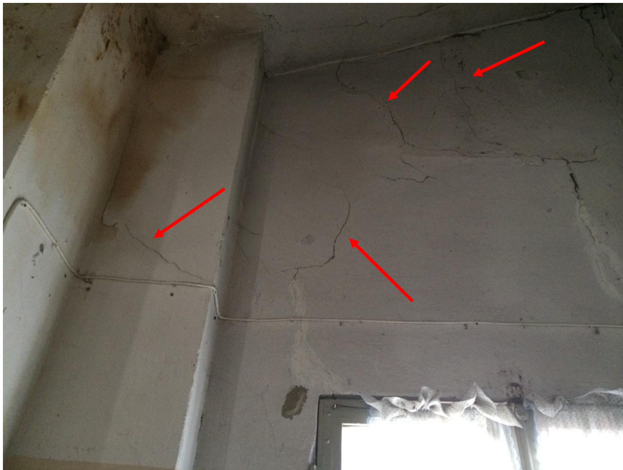
Fig. 44 – Lesioni nel pilastro e nella parete portante
