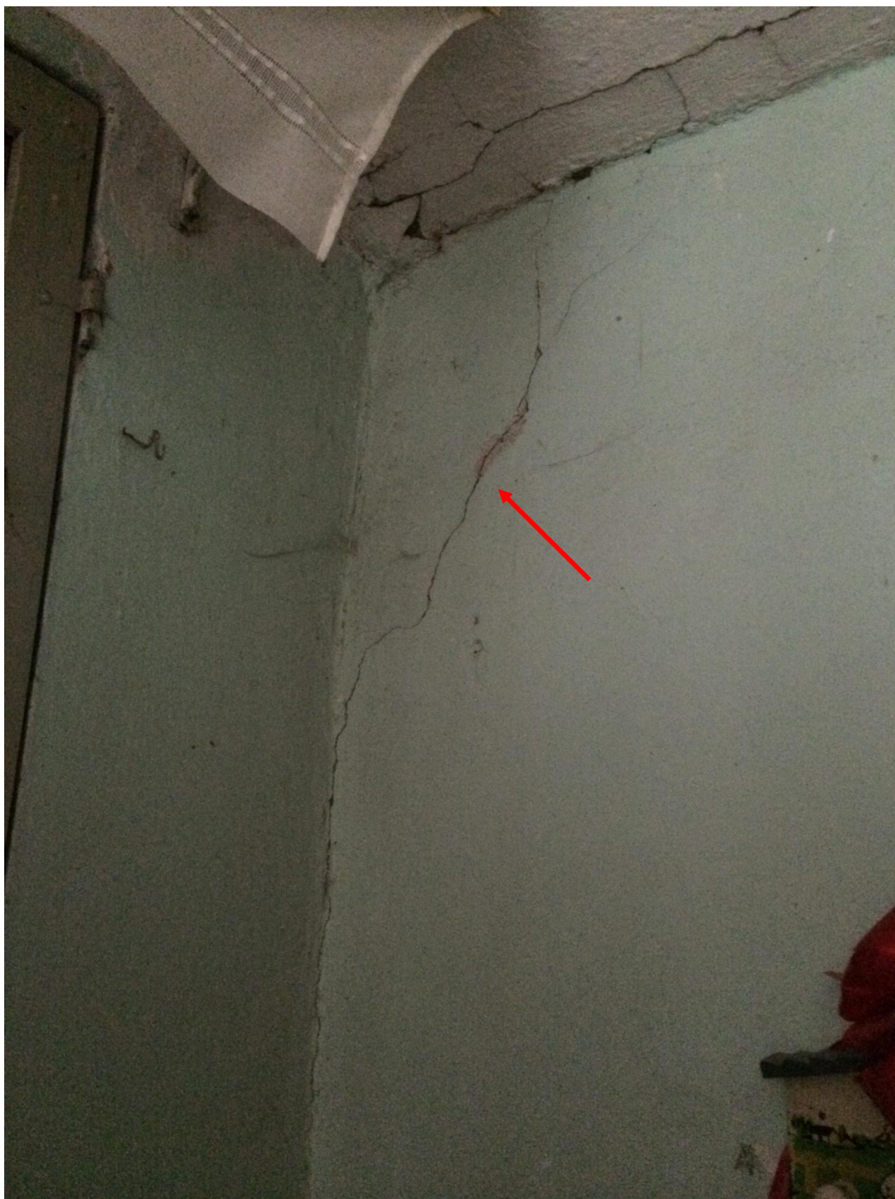
Fig. 55 – Lesione nella parete portante
