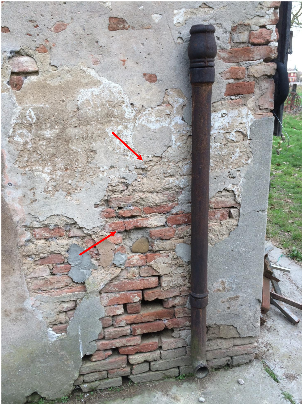
Fig. 6 - Lesioni diagonali nella muratura portante esterna
