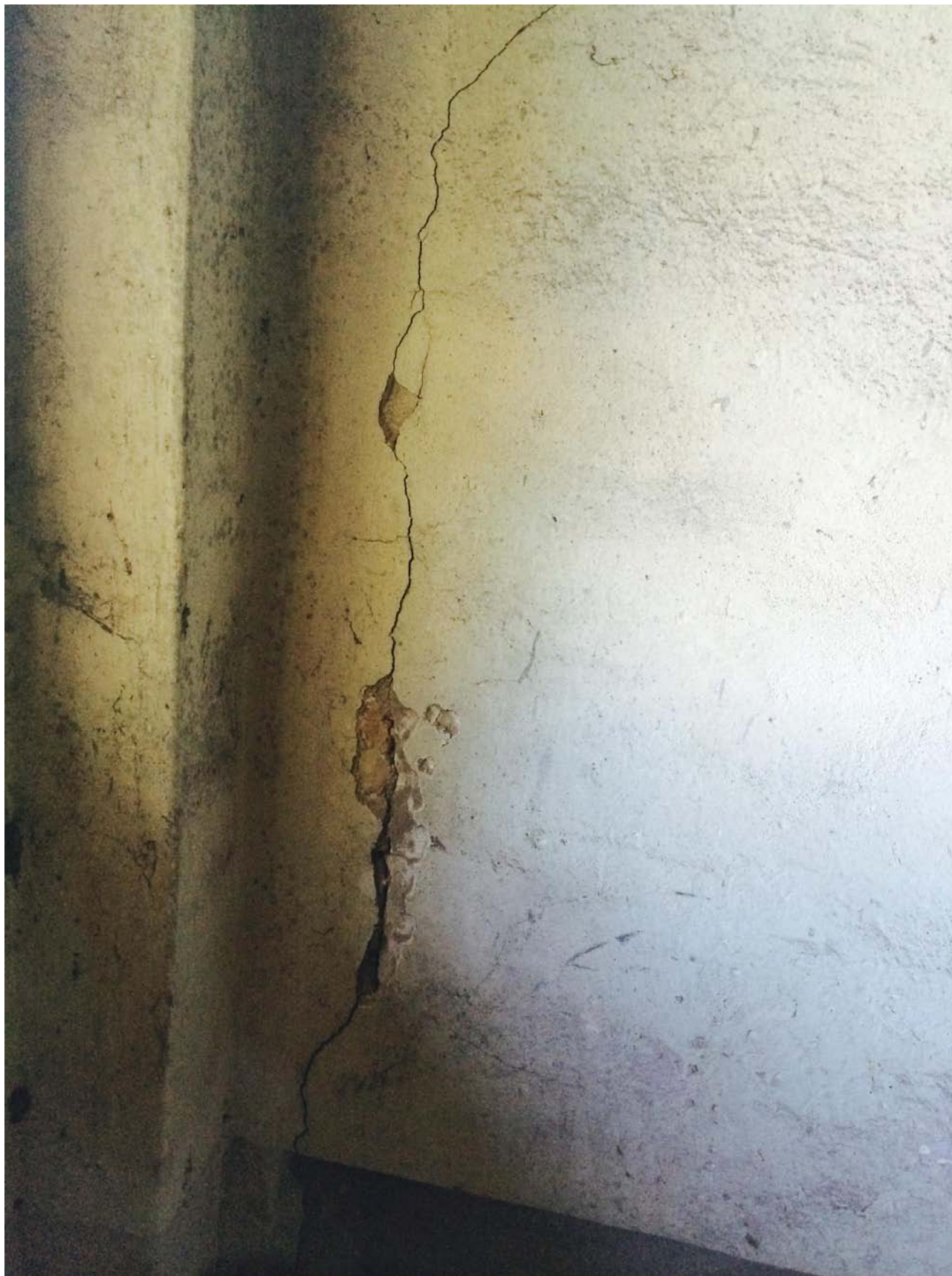
Fig. 48 – Lesione passante nella parete portante
