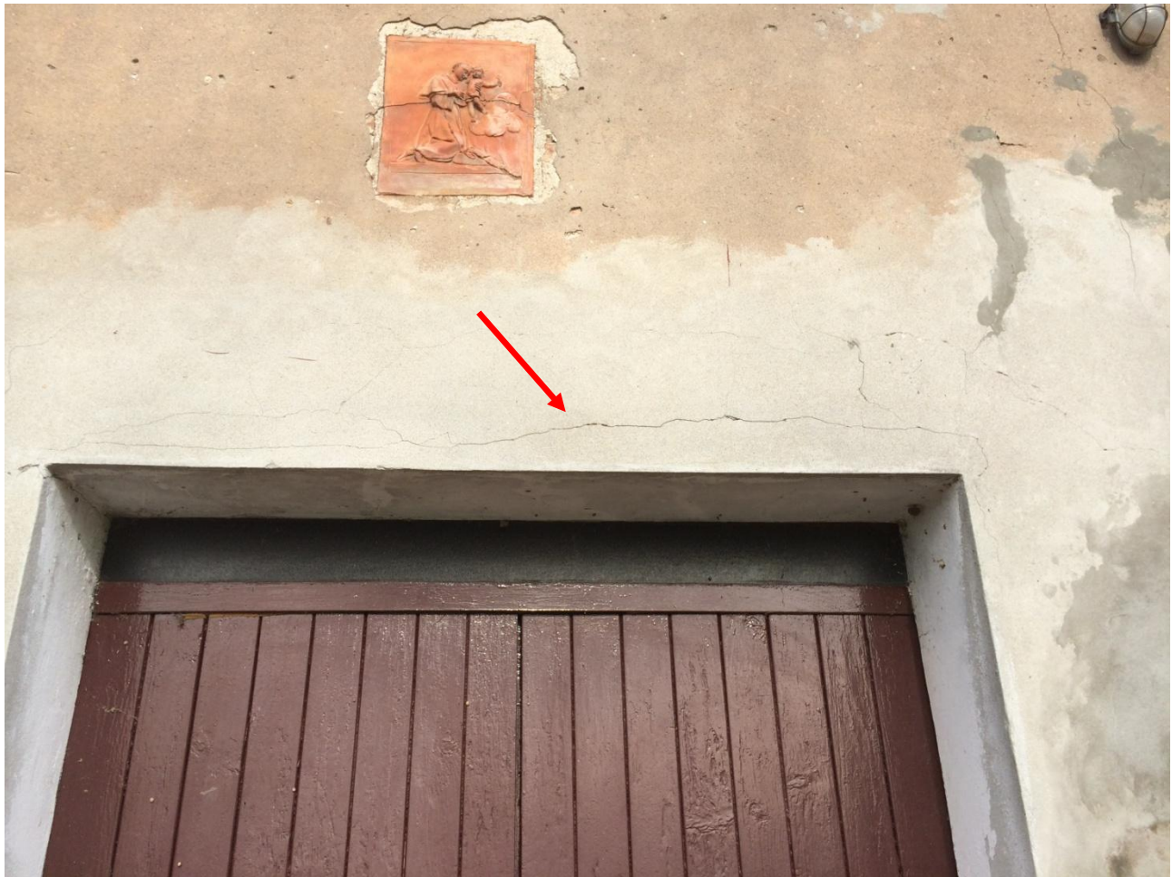
Fig. 5 – Lesioni nella parete esterna e nell'architrave
