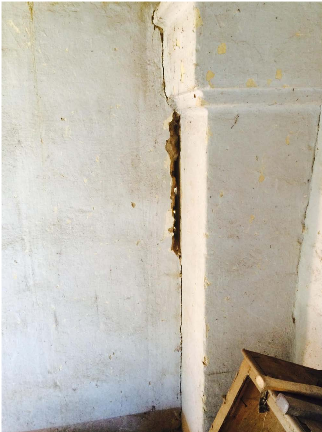
Fig. 35 – Lesione passante nella parete portante
