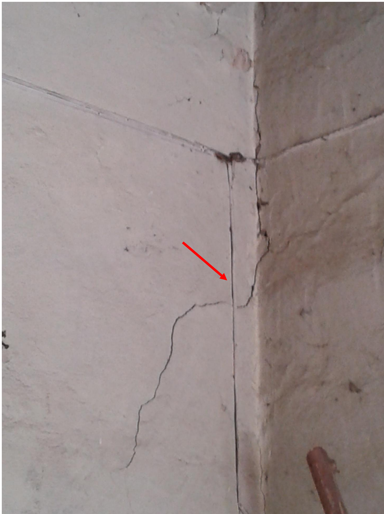
Fig. 94 – Lesione nella parete portante
