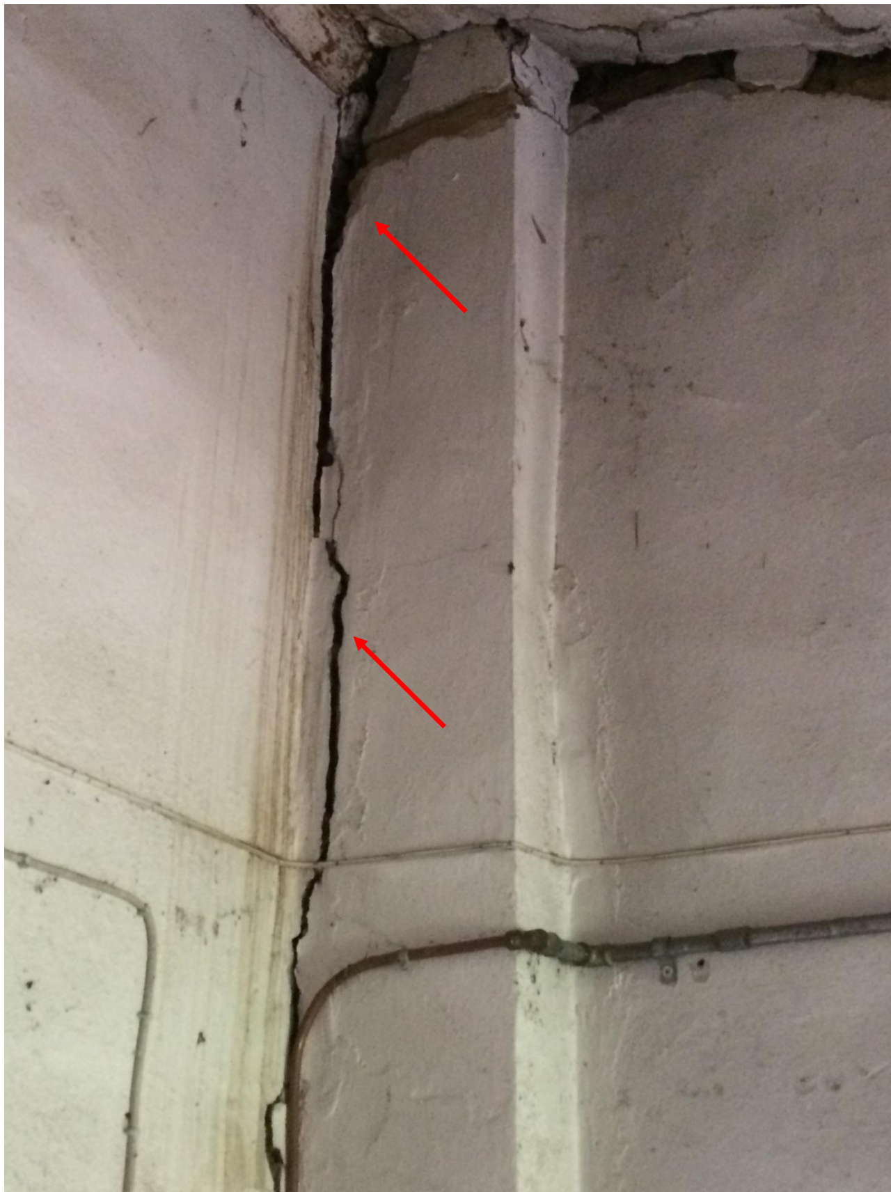
Fig. 35 – Distacco completo del pilastro con perdita di verticalità e rotazione del coperto in legno
