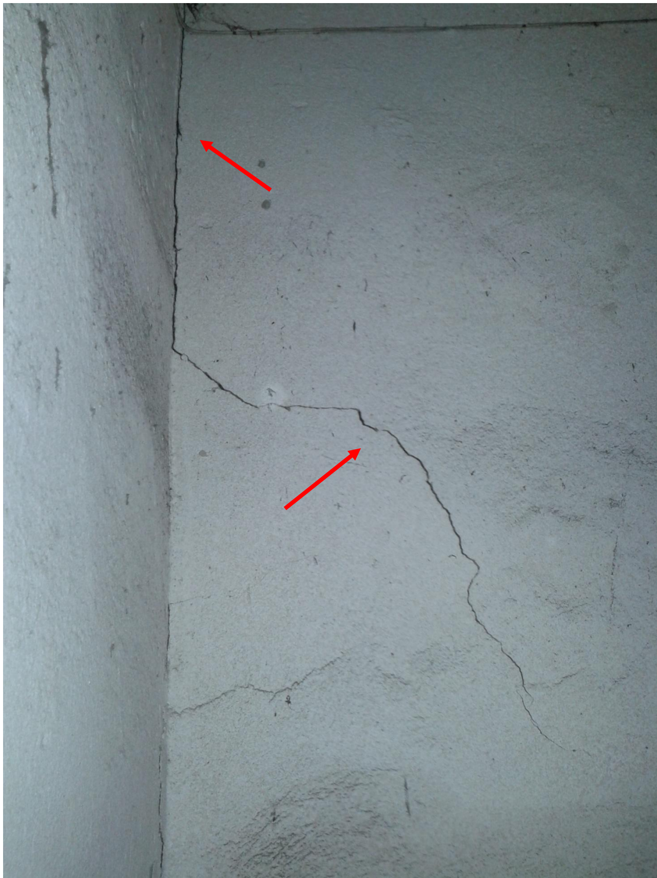
Fig. 87 – Lesione nella parete portante
