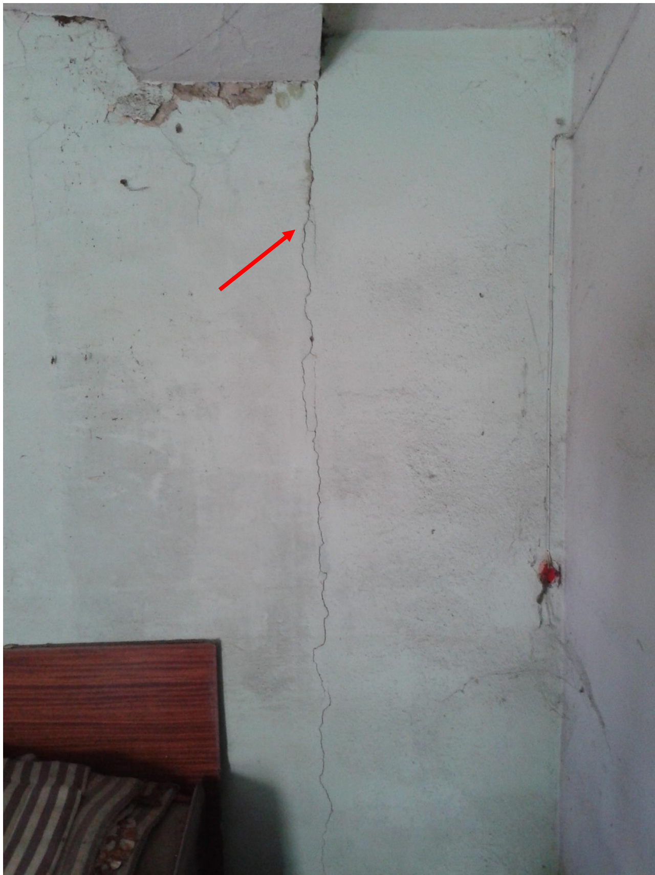
Fig. 73 – Lesione nella parete portante
