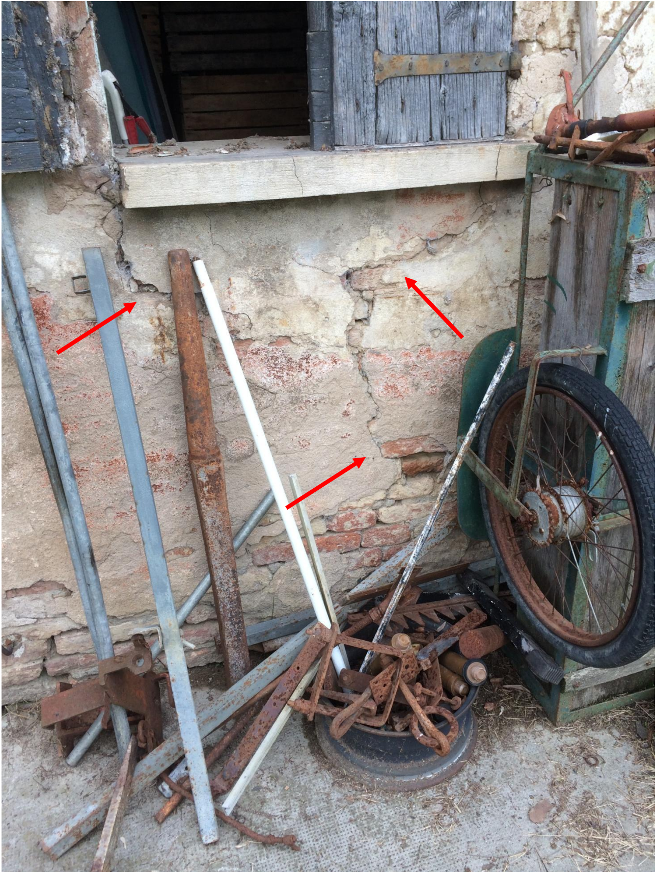
Fig. 8 – Lesioni passanti nella parete portante
