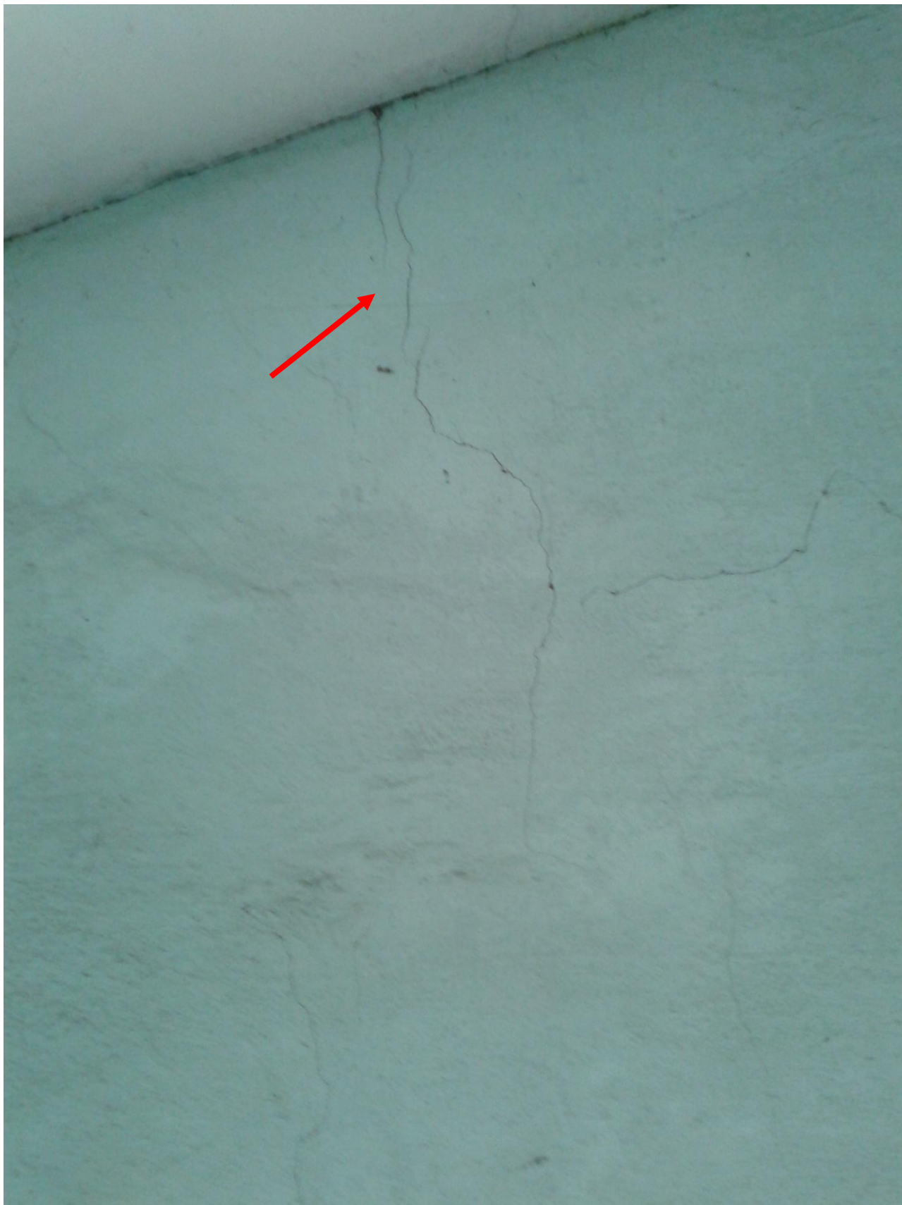
Fig. 78 – Lesione nella parete portante
