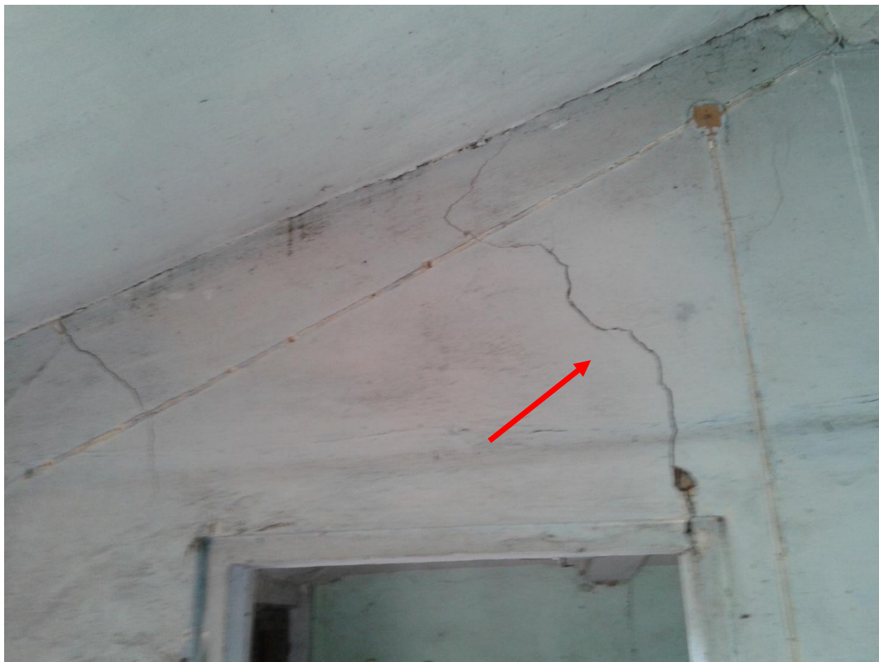
Fig. 71 – Lesione passante nella parete portante
