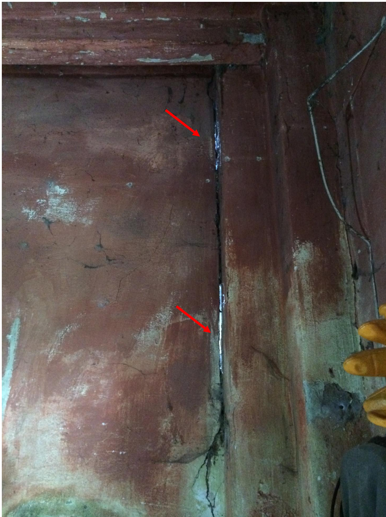
Fig. 29 – Lesione passante nella parete portante
