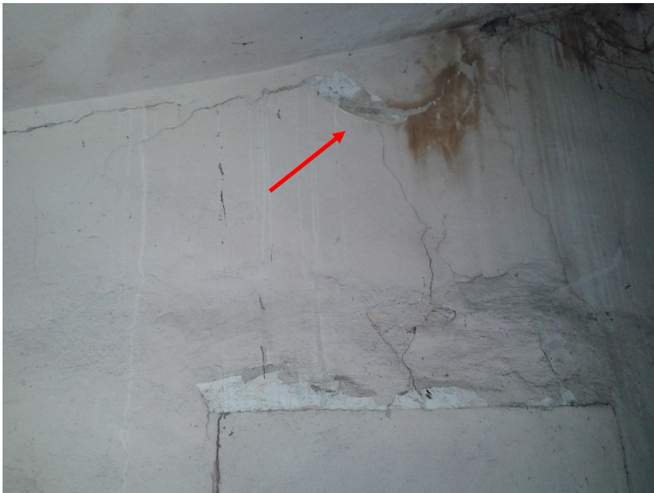
Fig. 85 – Lesione nella parete portante
