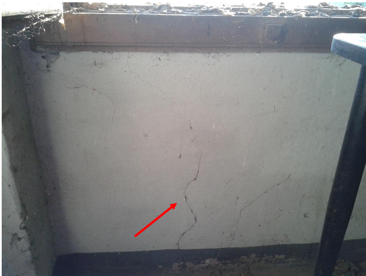
Fig. 103 – Lesione verticale nella parete portante
