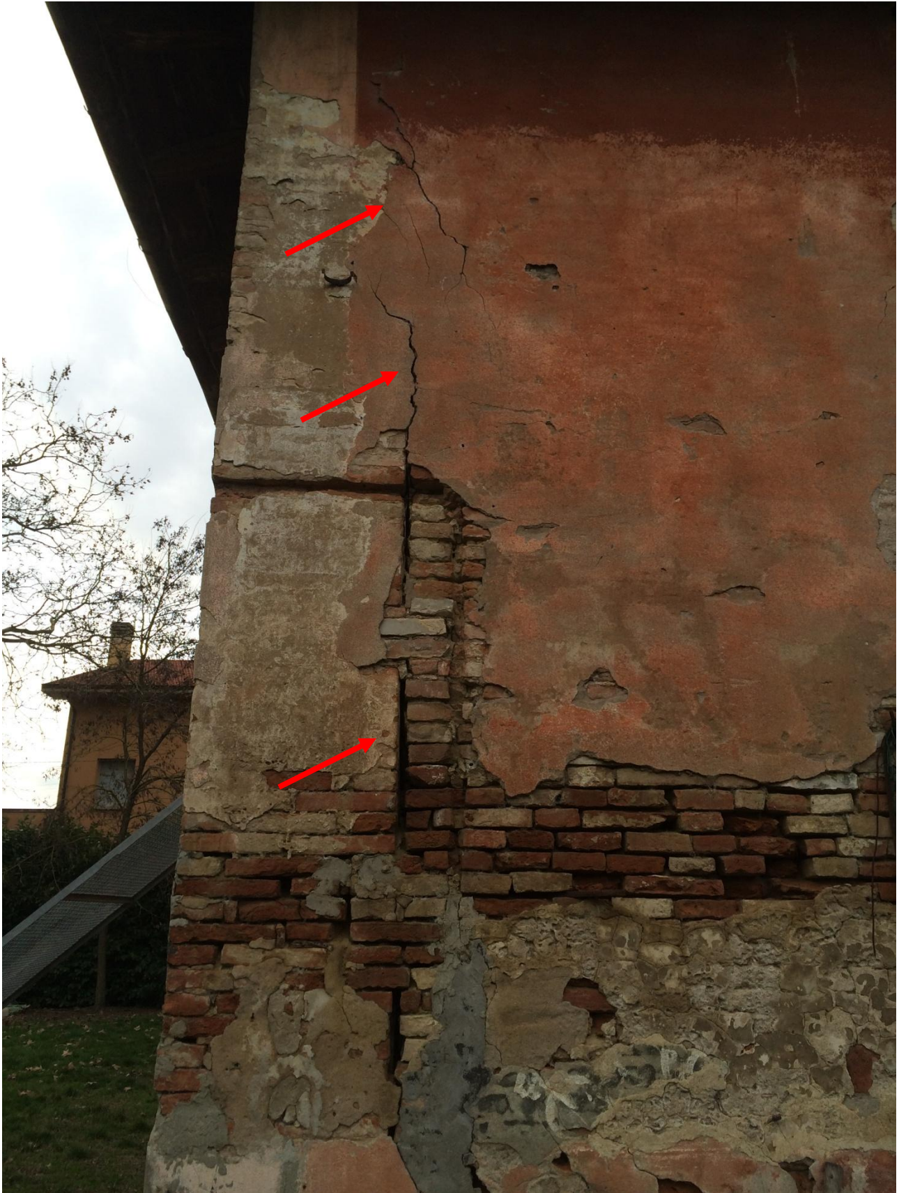
Fig. 17 – Fessure passanti con distacchi della parete portante
