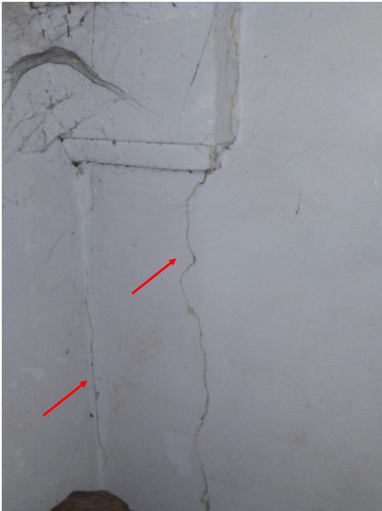
Fig. 53 – Lesione nella parete portante
