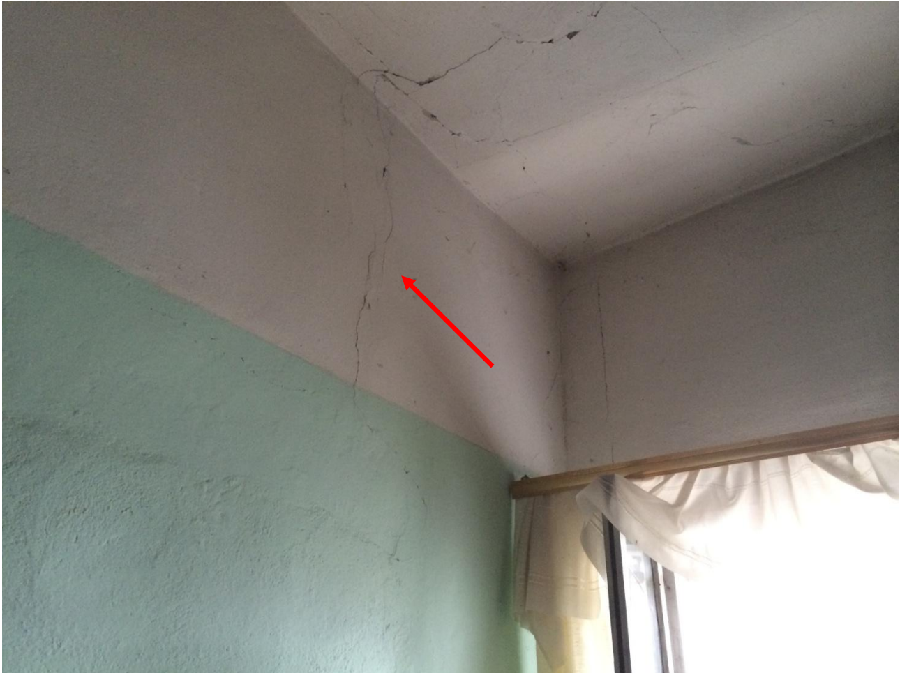
Fig. 53 – Lesioni nella parete portante
