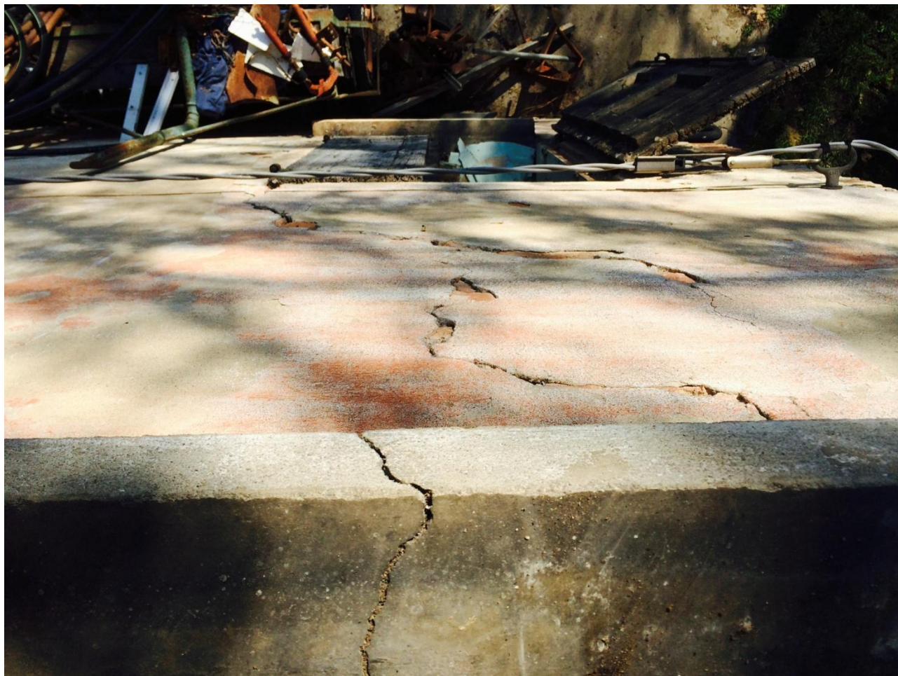
Fig. 9 – Lesione passante nella parete portante vista da sopra
