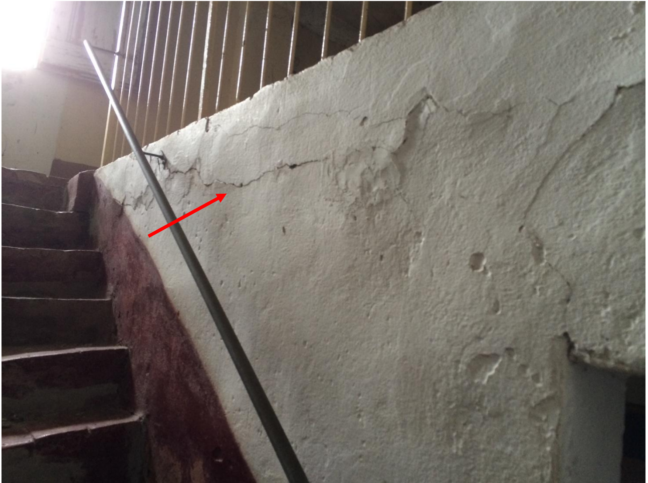
Fig. 32 – Lesioni orizzontali nel solaio di piano primo
