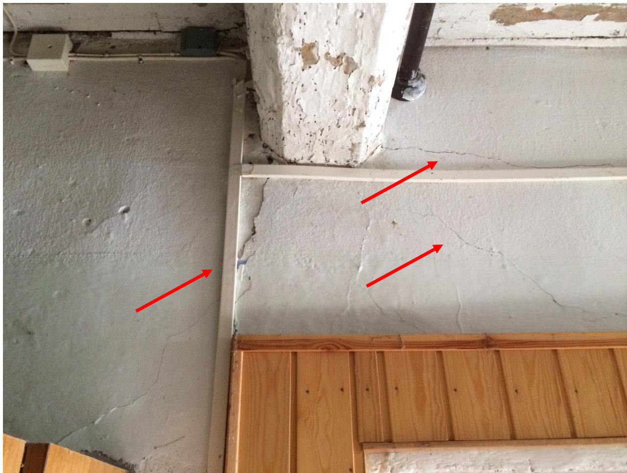
Fig. 26 – Lesioni nella muratura portante causate dallo sfilamento della trave in legno
