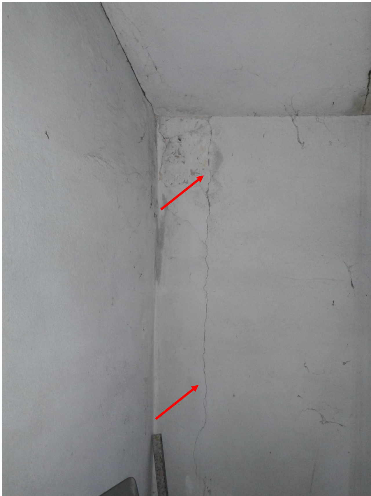
Fig. 66 – Lesione nella parete portante
