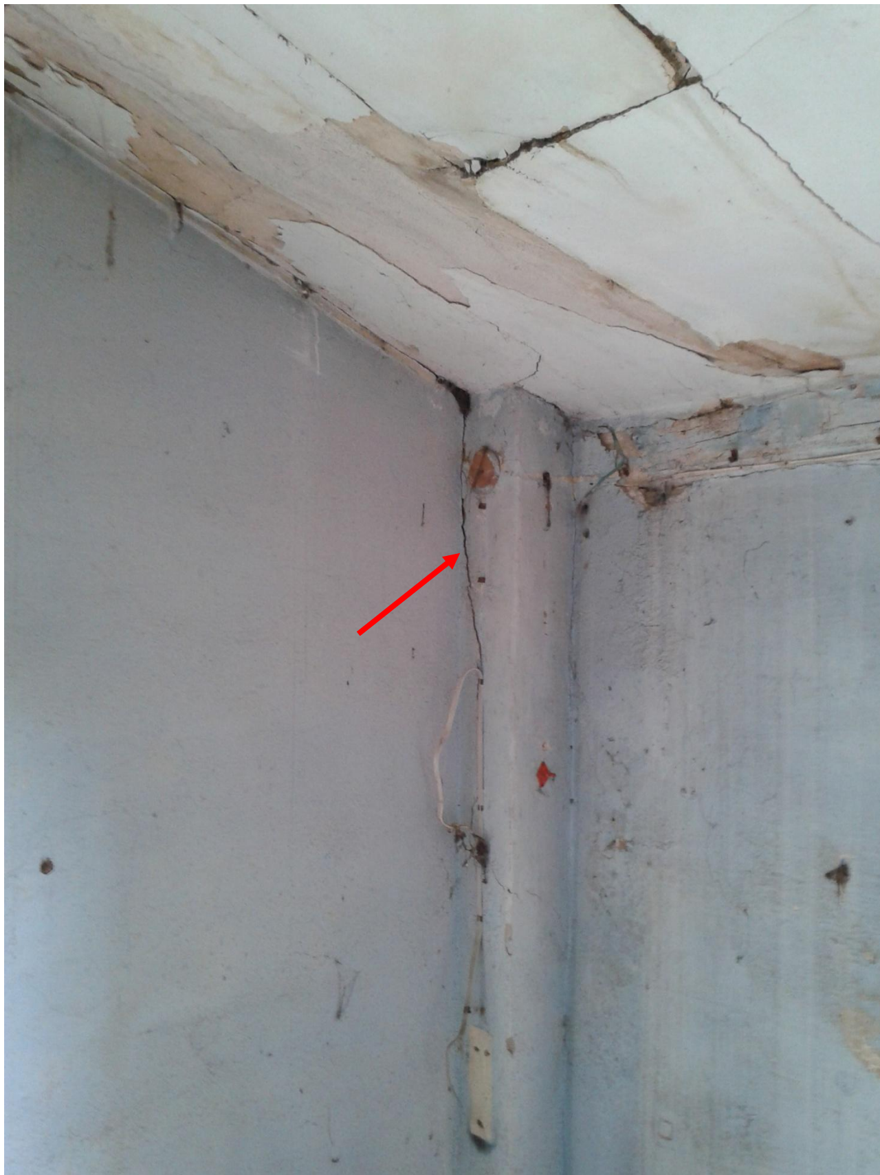
Fig. 90 – Lesione nella parete portante
