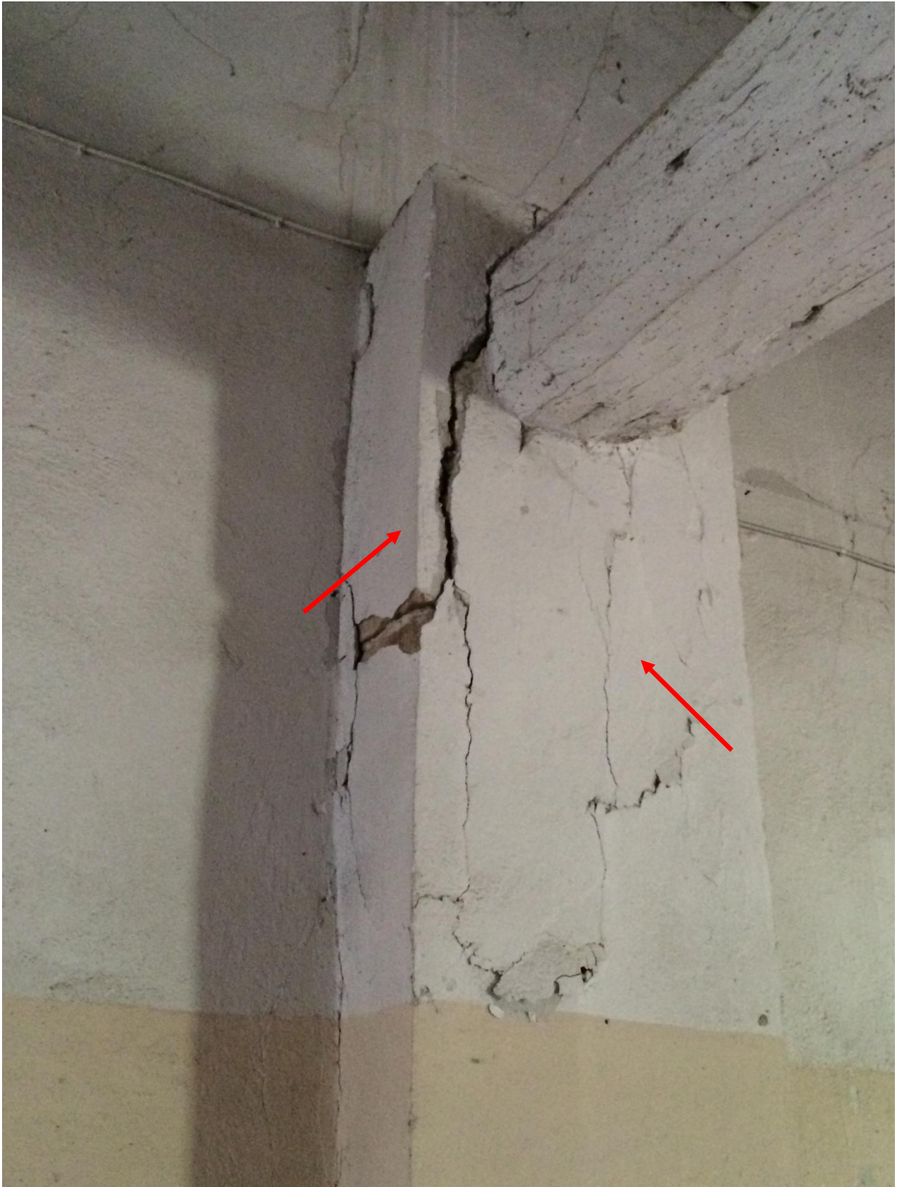
Fig. 42 – Rottura del pilastro a causa del movimento della trave in legno
