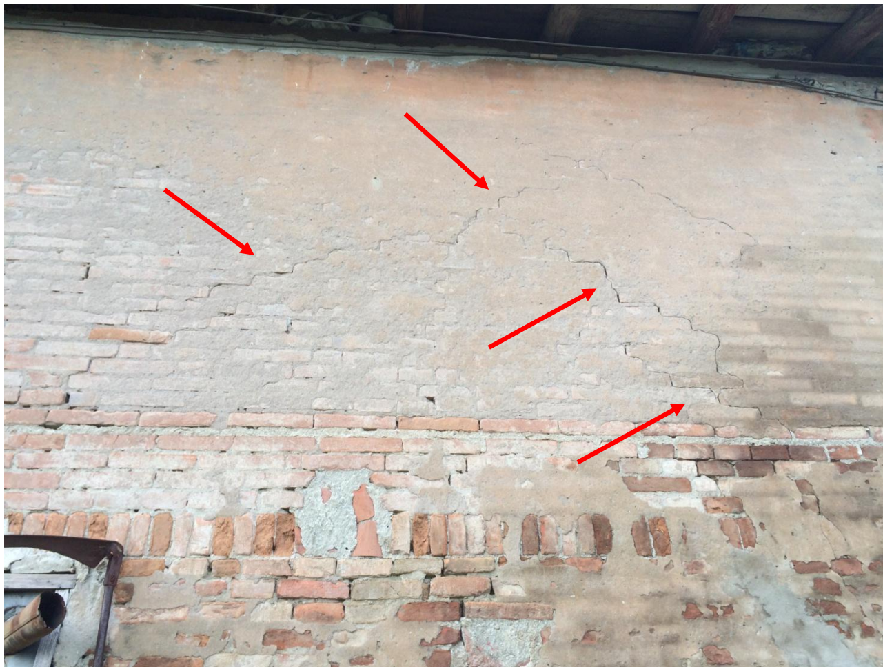
Fig. 18 – Lesioni nella parete esterna
