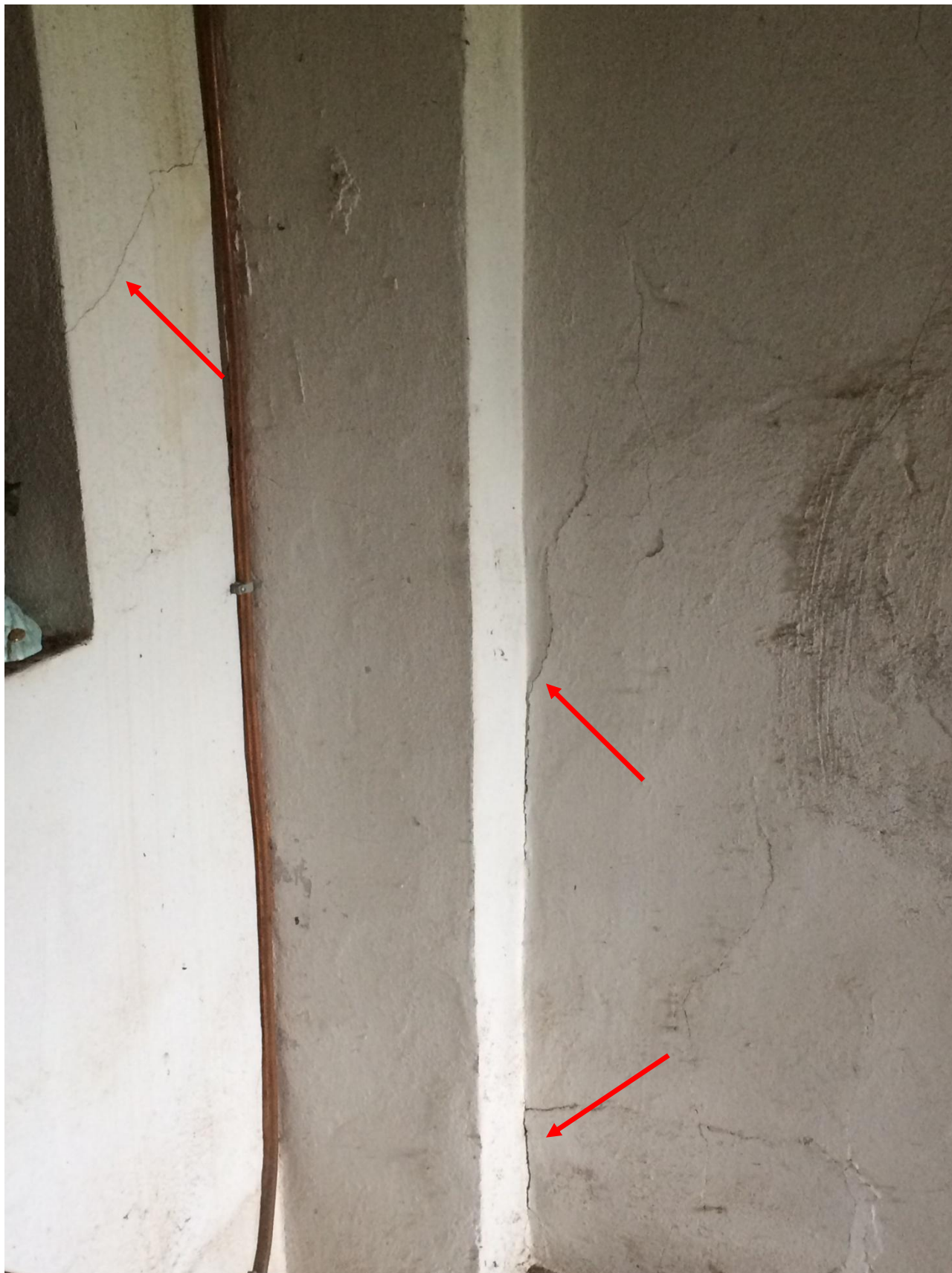
Fig. 34 – Lesioni verticali nella muratura portante
