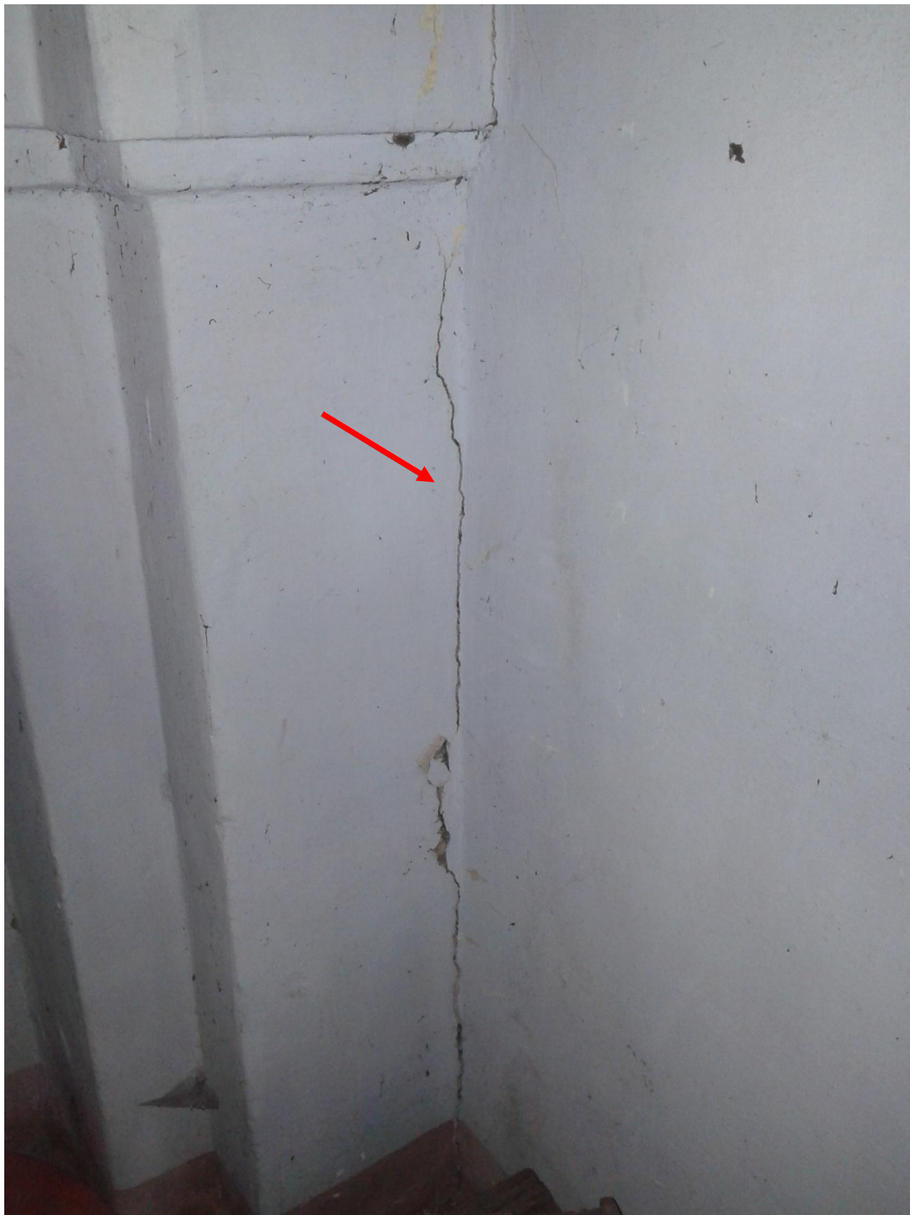
Fig. 51 – Lesione nella parete portante
