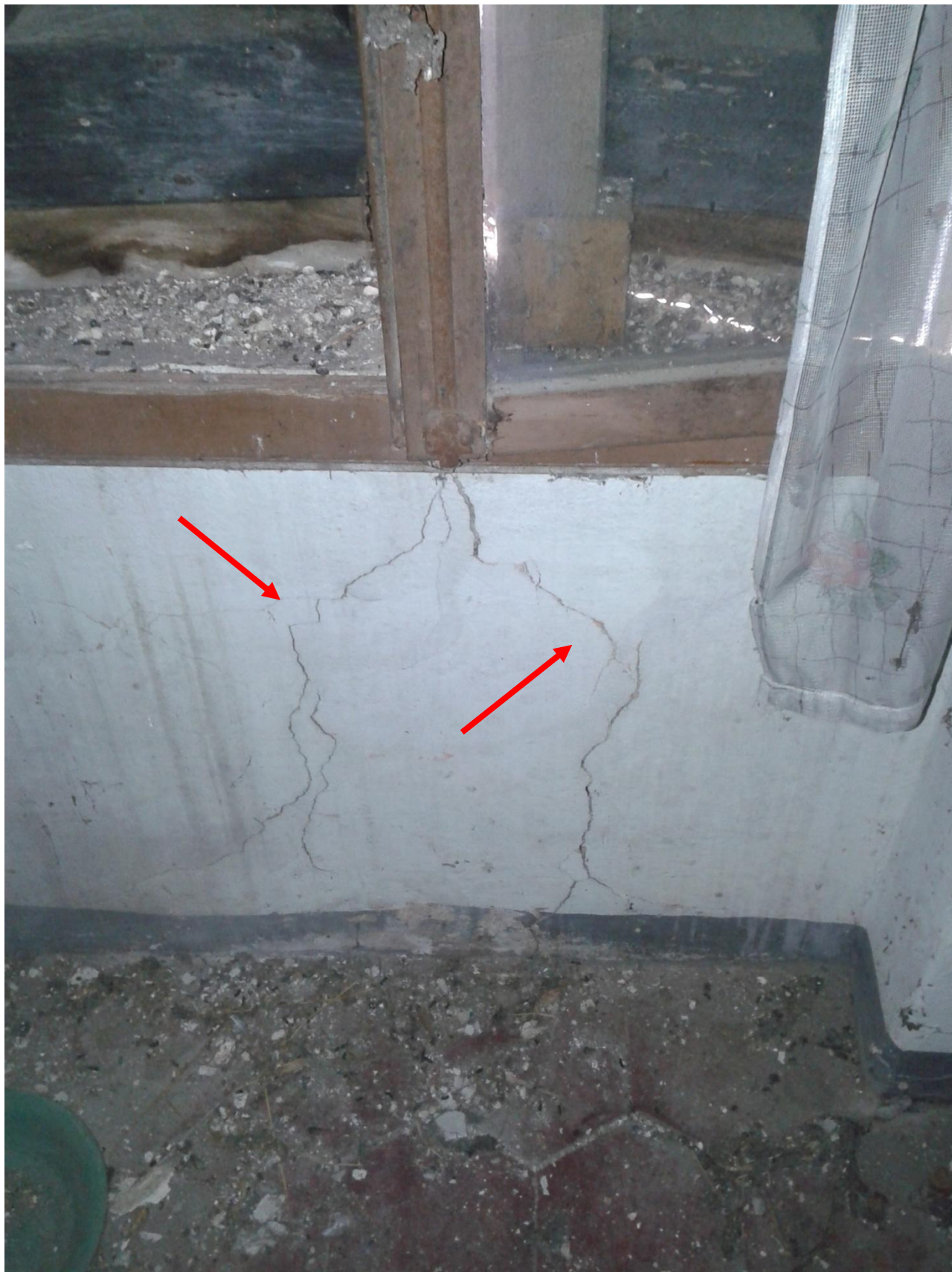
Fig. 65 – Lesione passante nella parete portante
