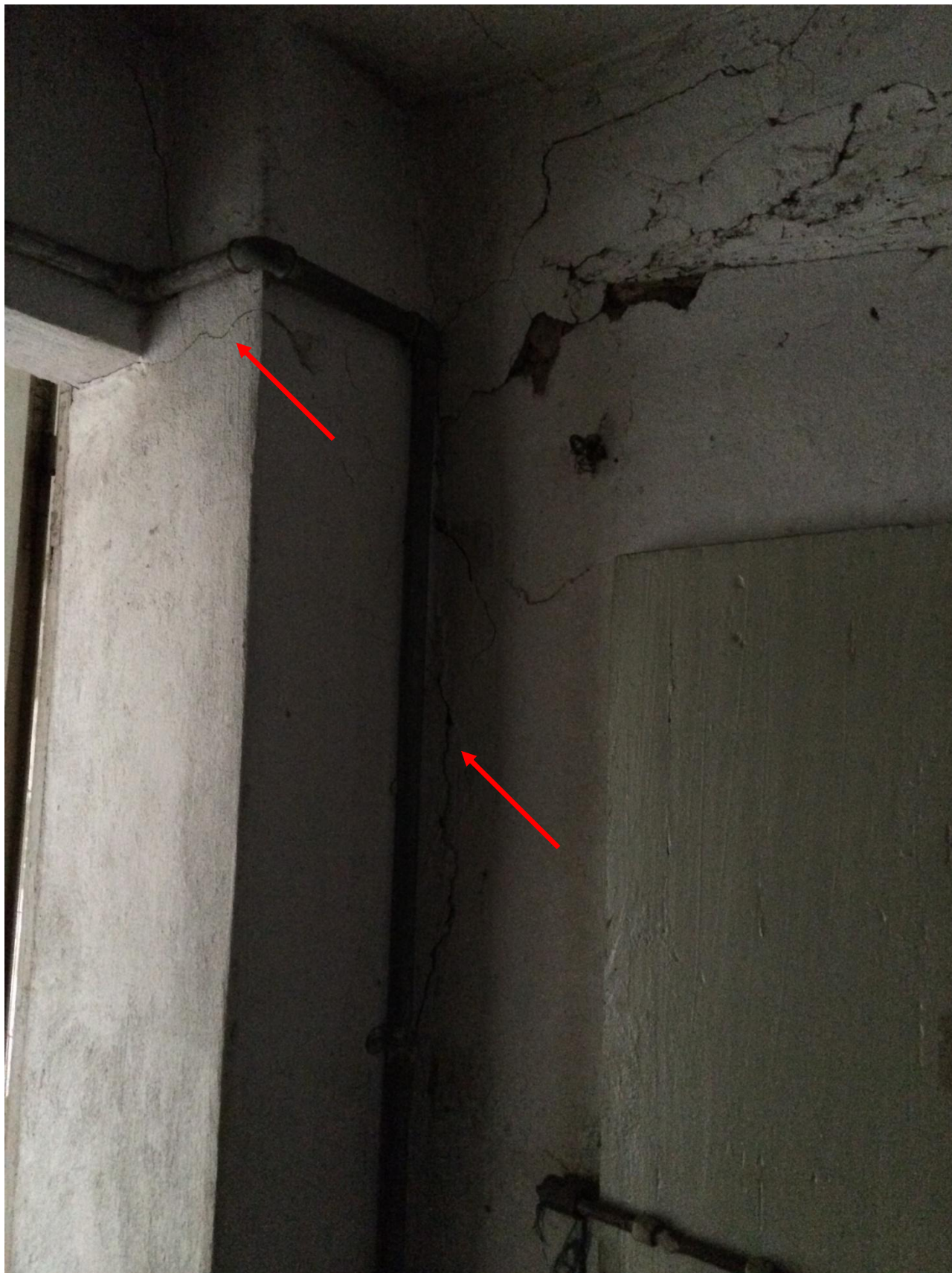
Fig. 64 – Taglio orizzontale del pilastro e lesioni nella parete portante
