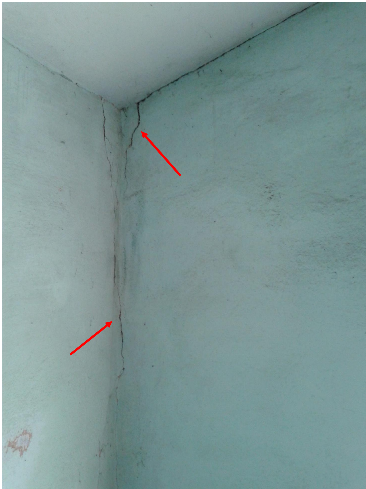
Fig. 76 – Lesione nella parete portante
