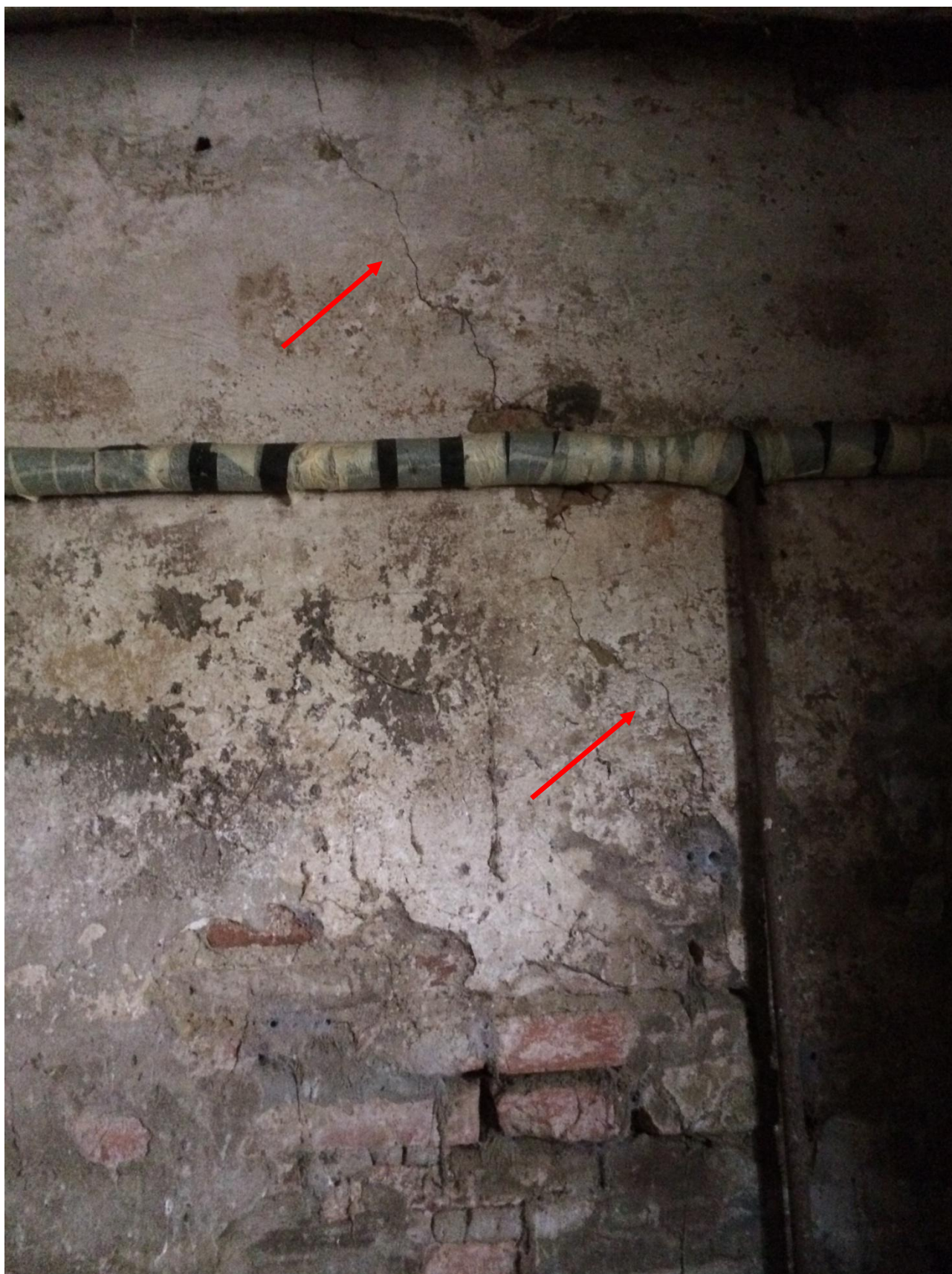
Fig. 56 – Lesione nella parete portante
