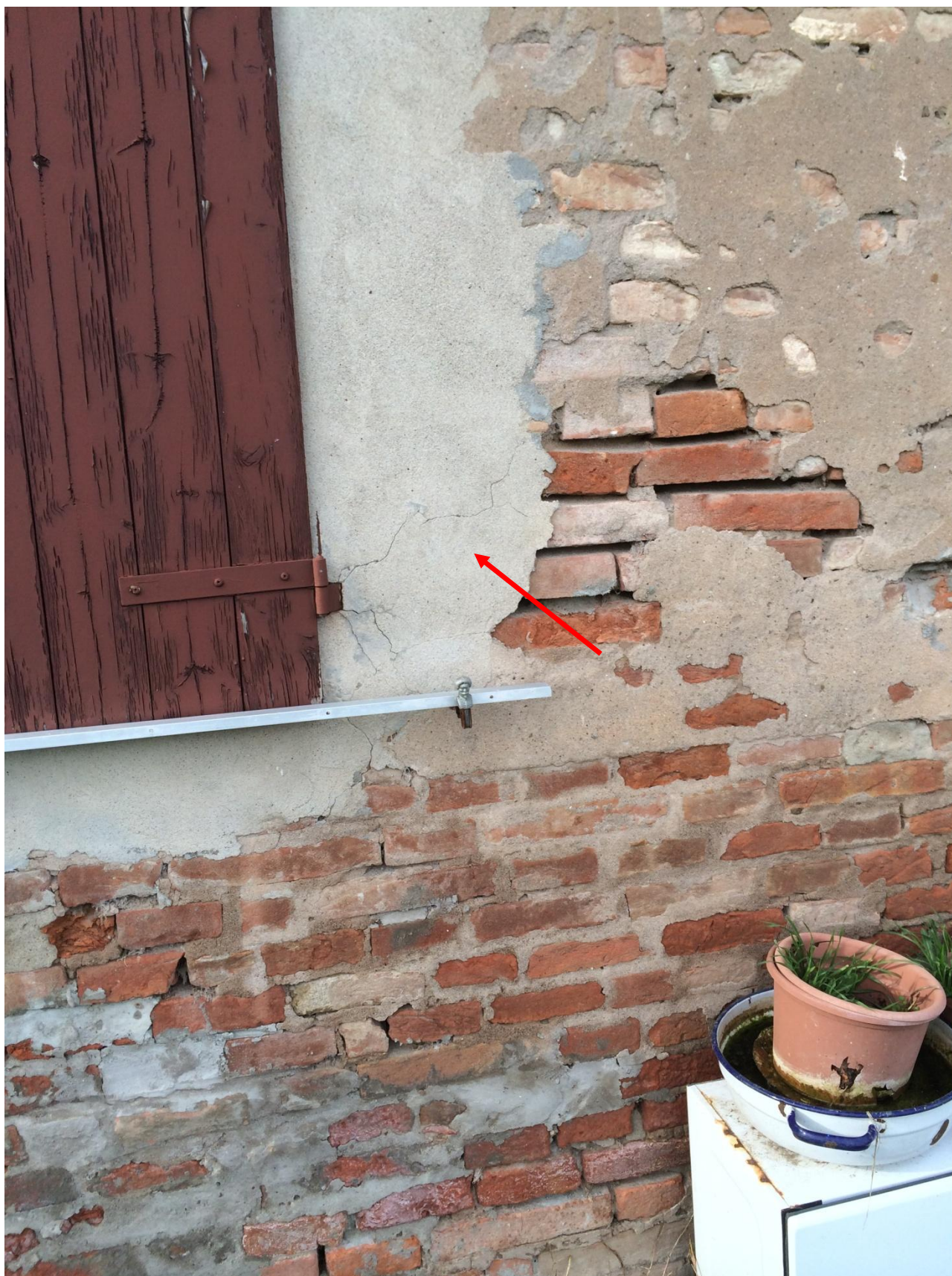
Fig. 12 – Lesioni nella parete esterna
