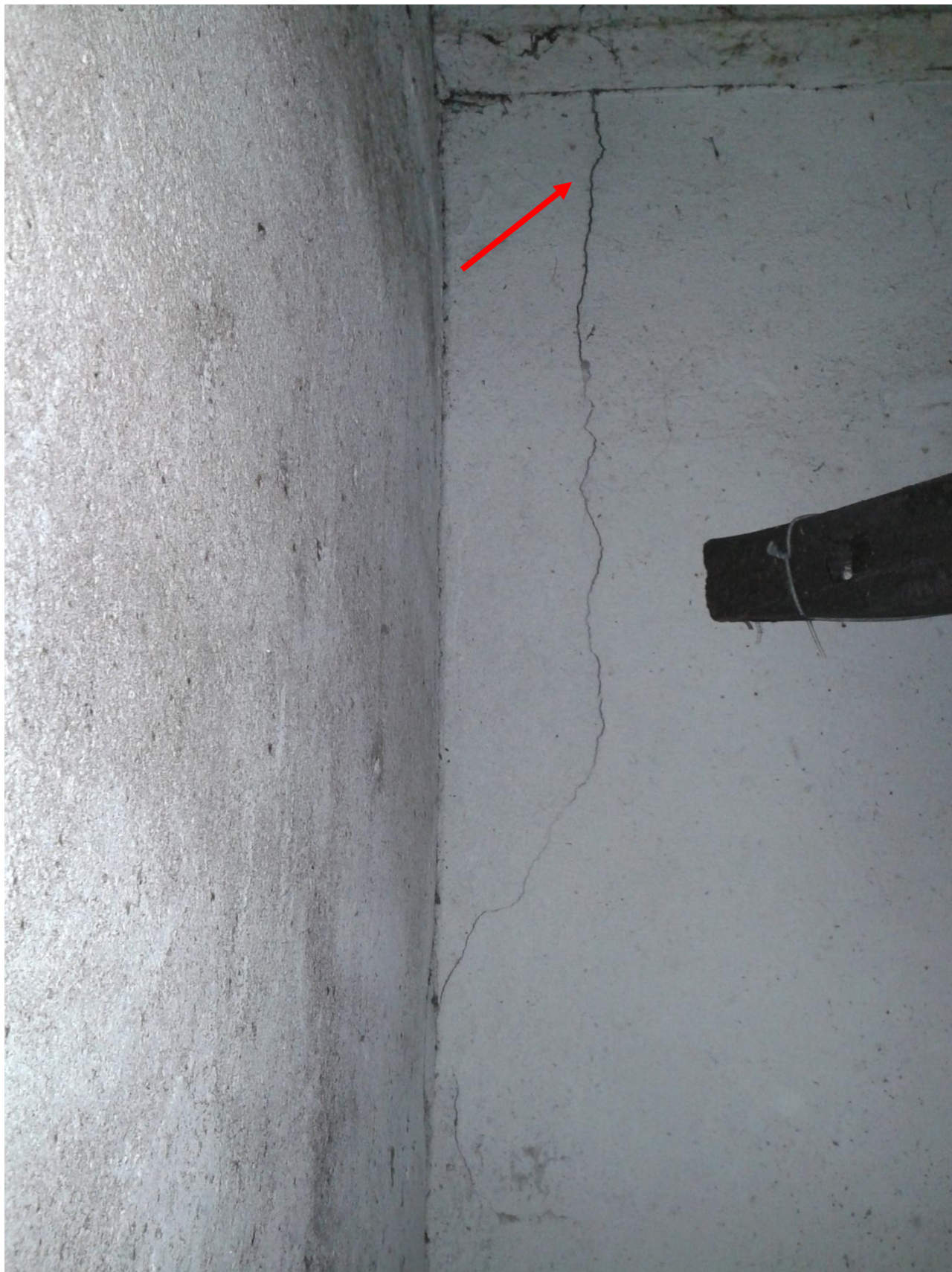
Fig. 86 – Lesione nella parete portante
