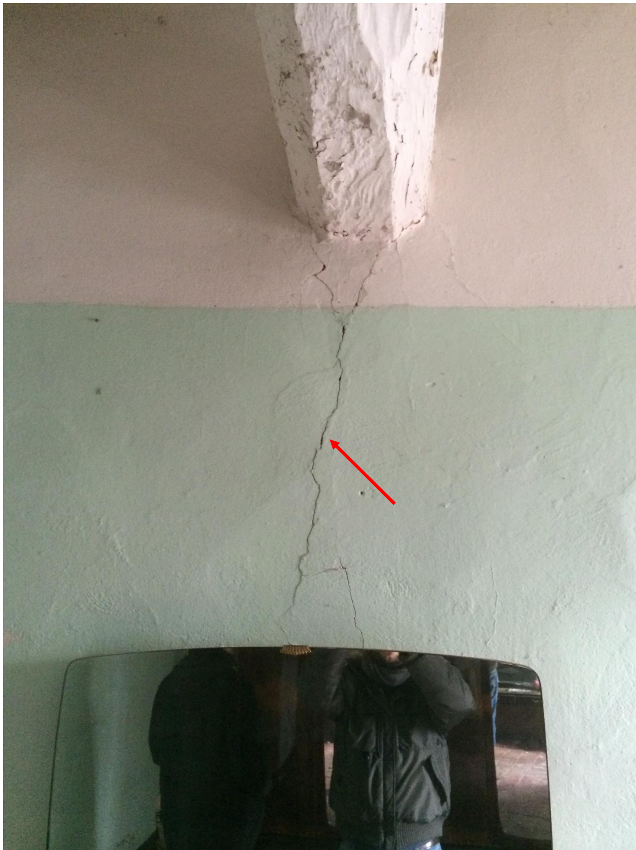
Fig. 52 – Lesioni nella parete portante dovute allo sfilamento della trave
