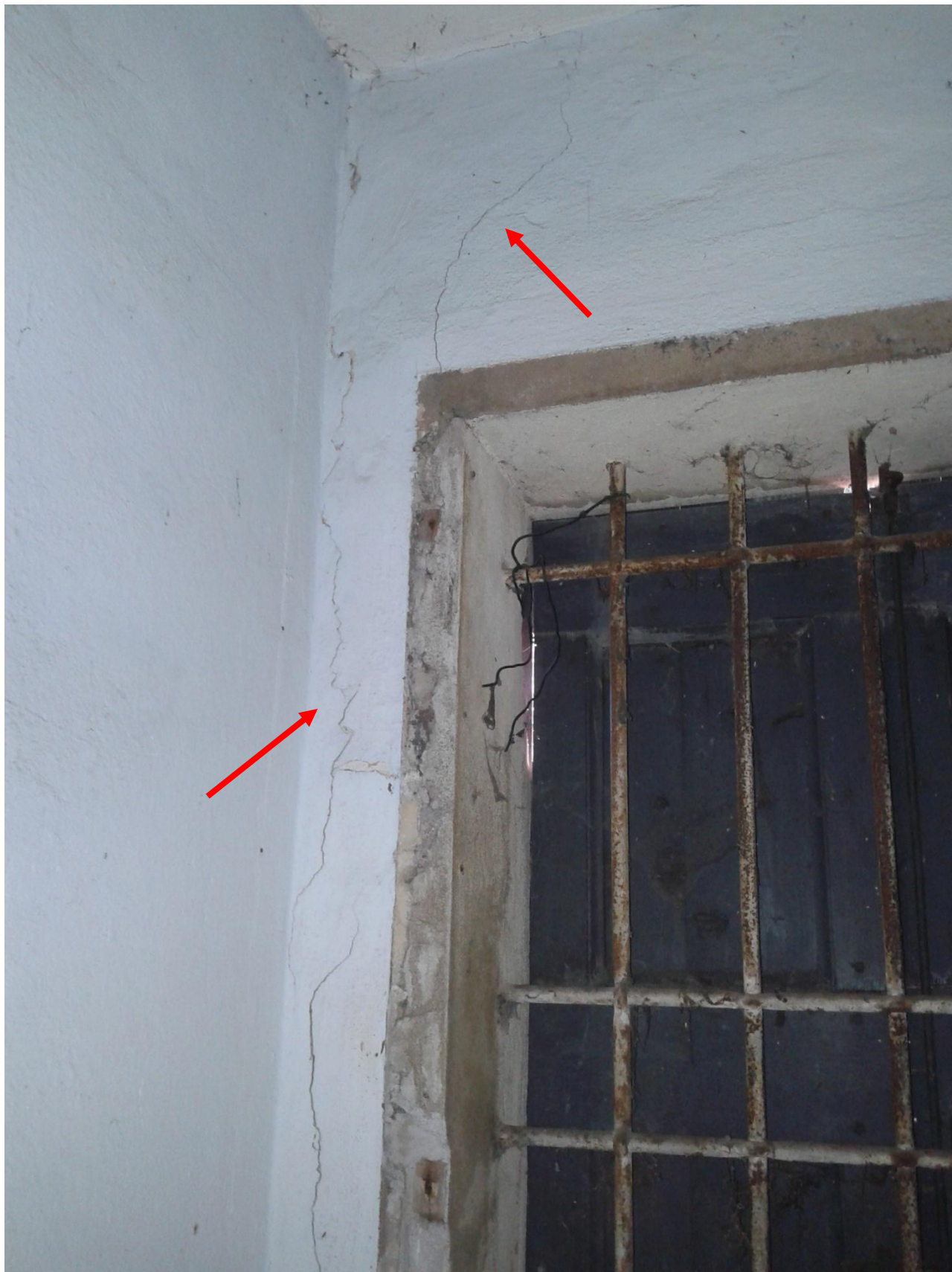
Fig. 60 – Lesioni nella parete portante
