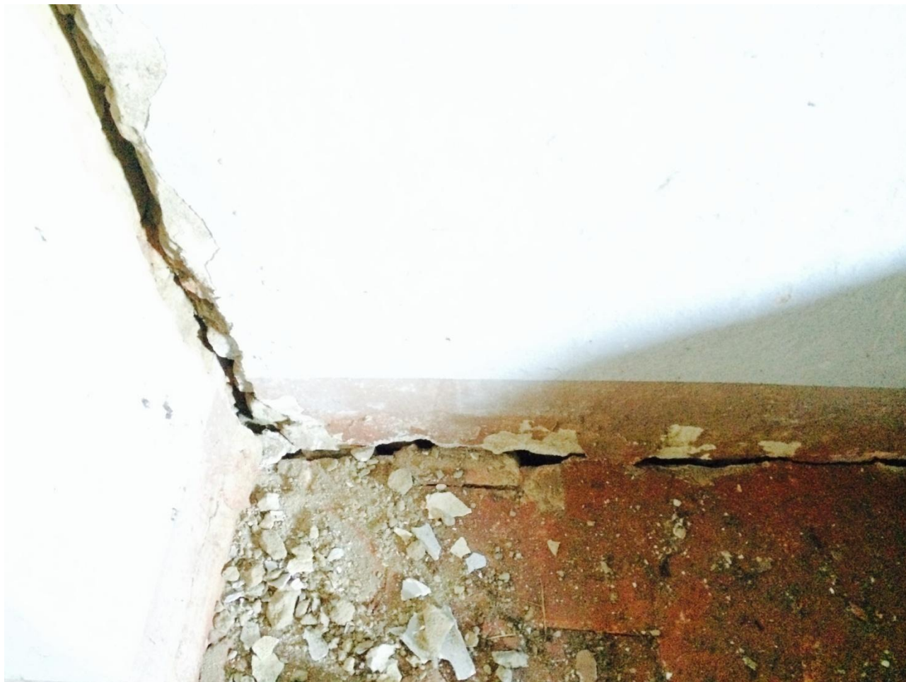
Fig. 83 – Lesione passante nella parete portante e distacco del solaio di piano primo
