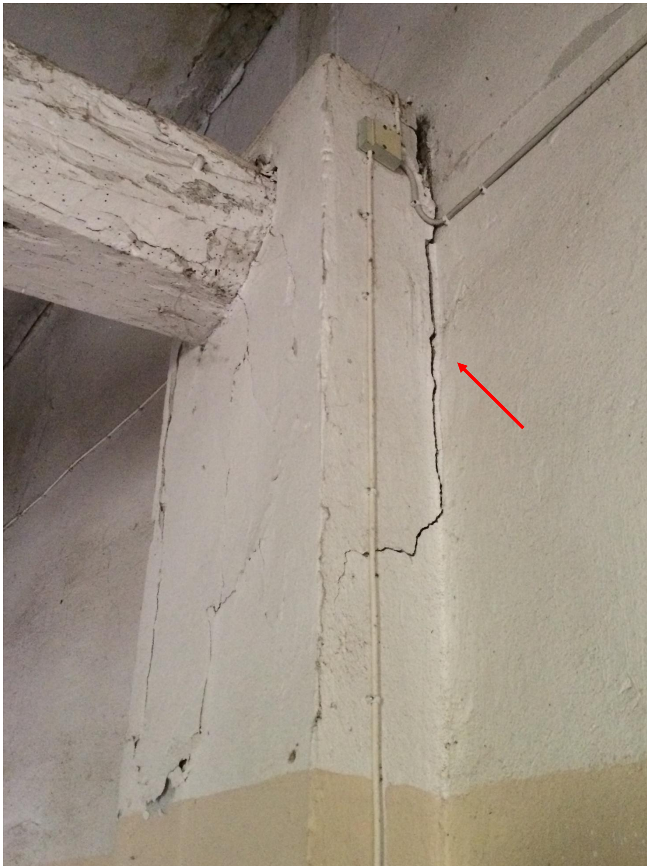
Fig. 41 – Rottura verticale del pilastro a metà con conseguente distacco
