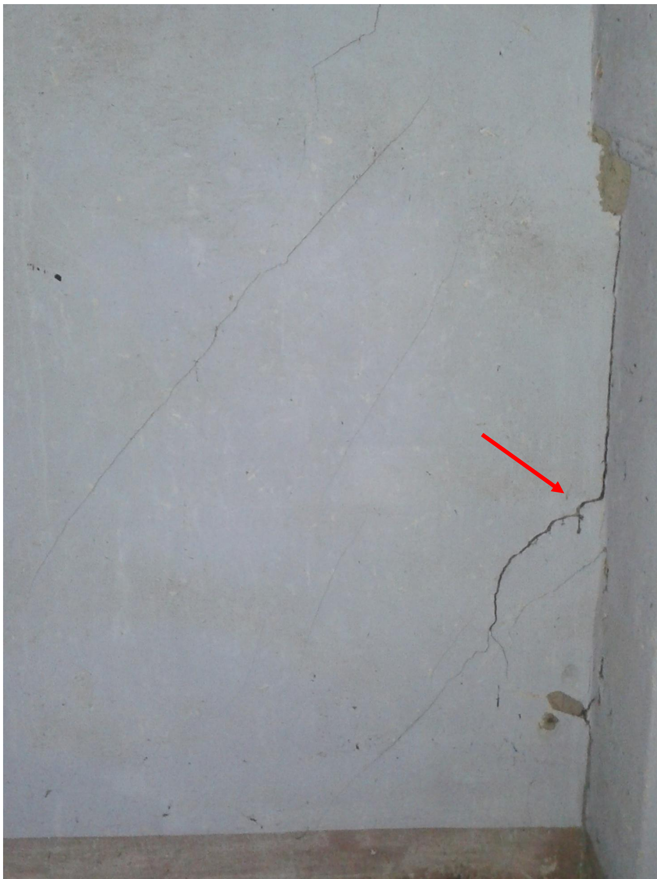
Fig. 35 – Lesione nella parete portante
