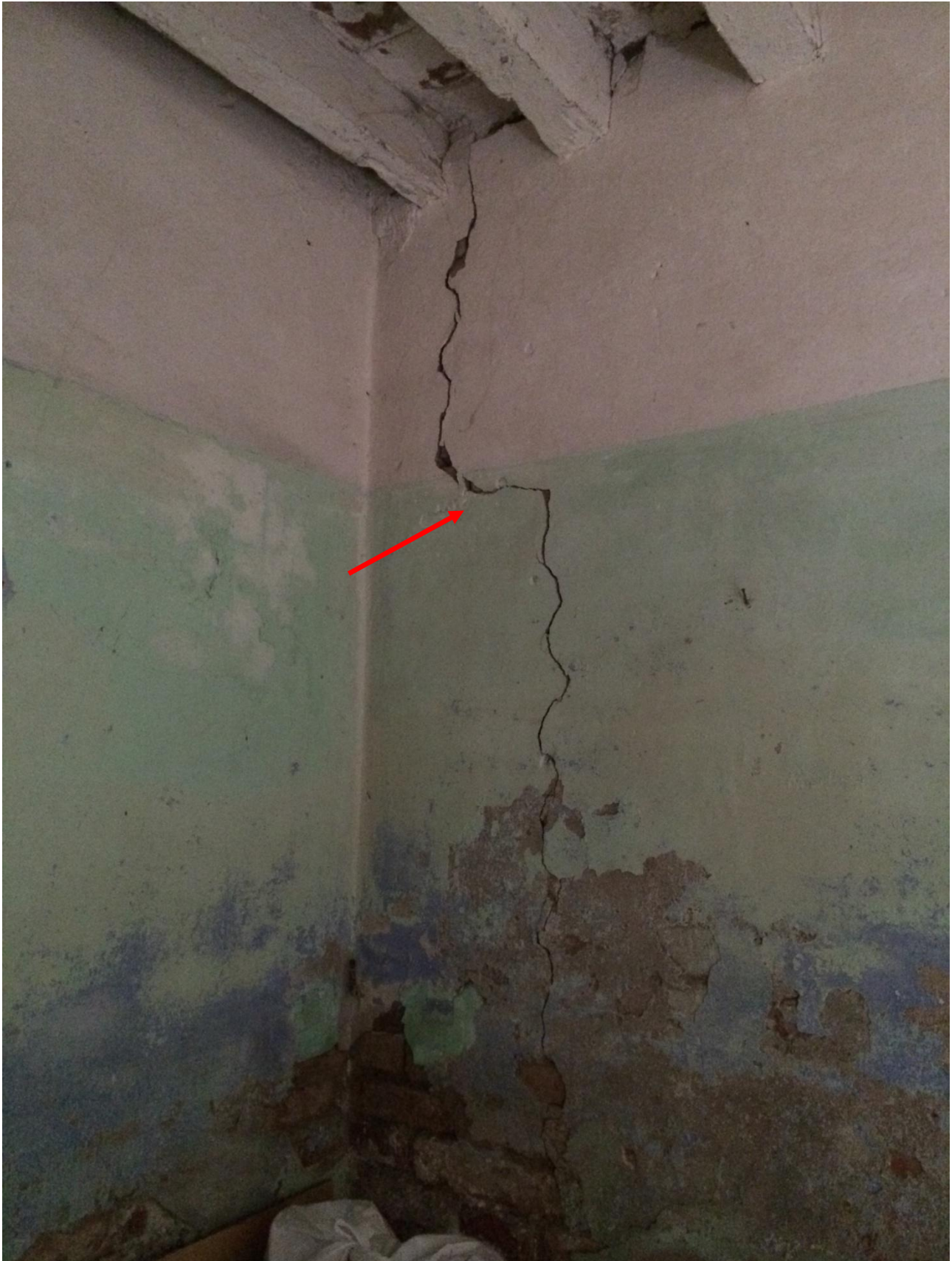
Fig. 29 – Lesioni verticale nella muratura portante
