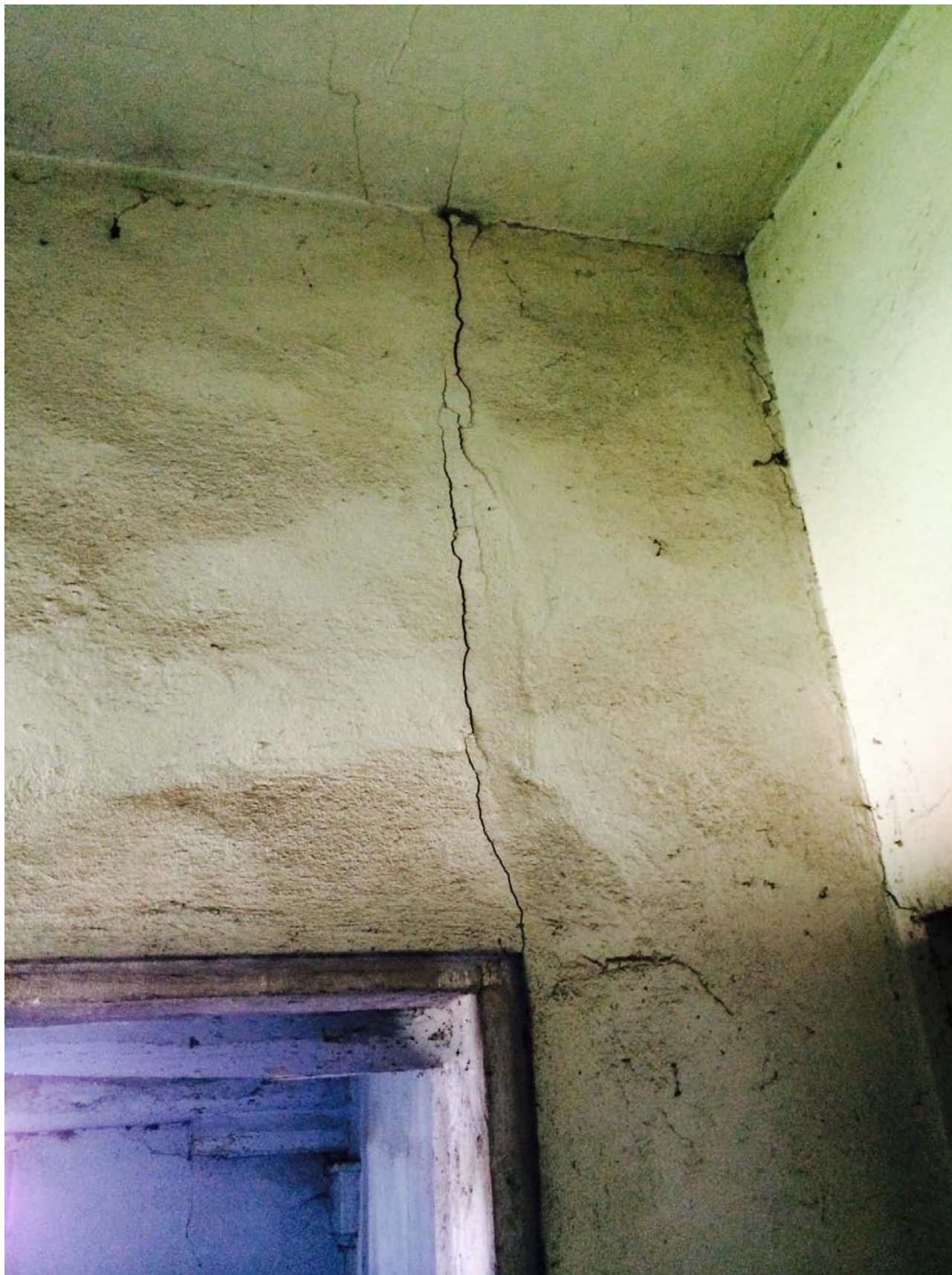
Fig. 49a – Lesione passante nella parete portante
