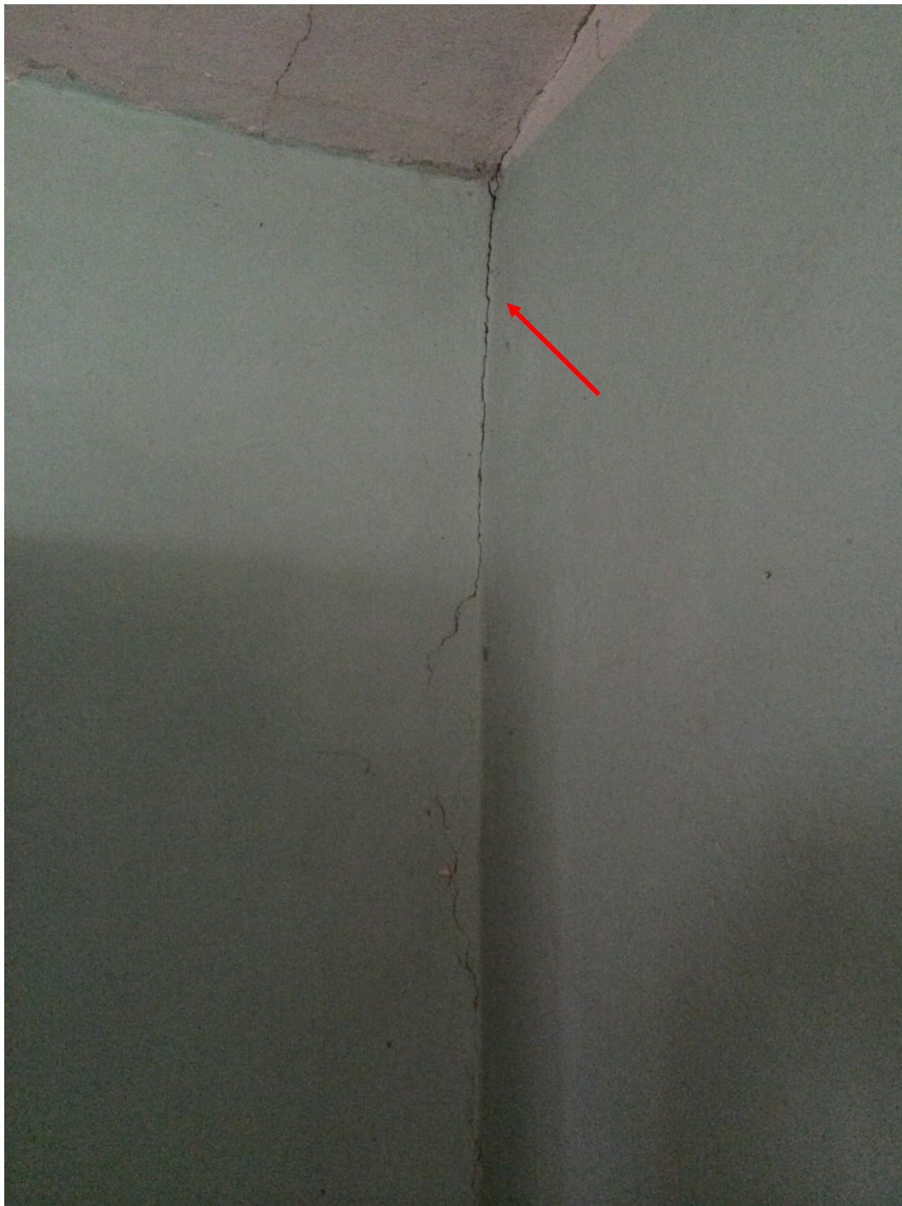
Fig. 54 – Lesione verticale nella parete portante
