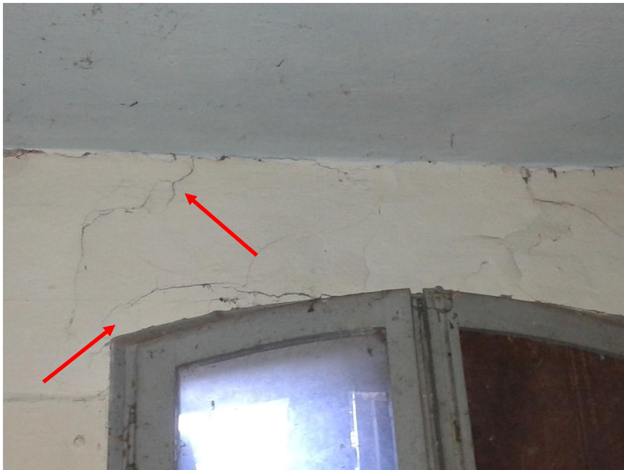
Fig. 101 – Lesioni nella parete portante
