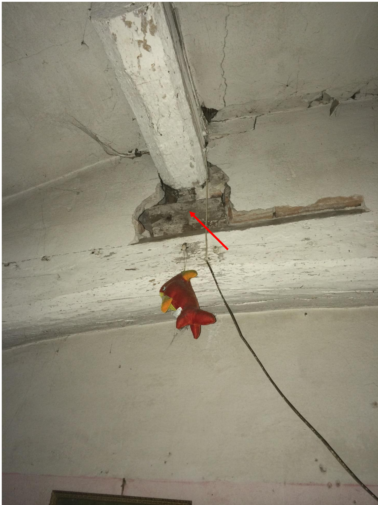
Fig. 49 – Lesioni nella parete portante con crollo di materiale dovuto allo sfilamento della trave in legno di copertura
