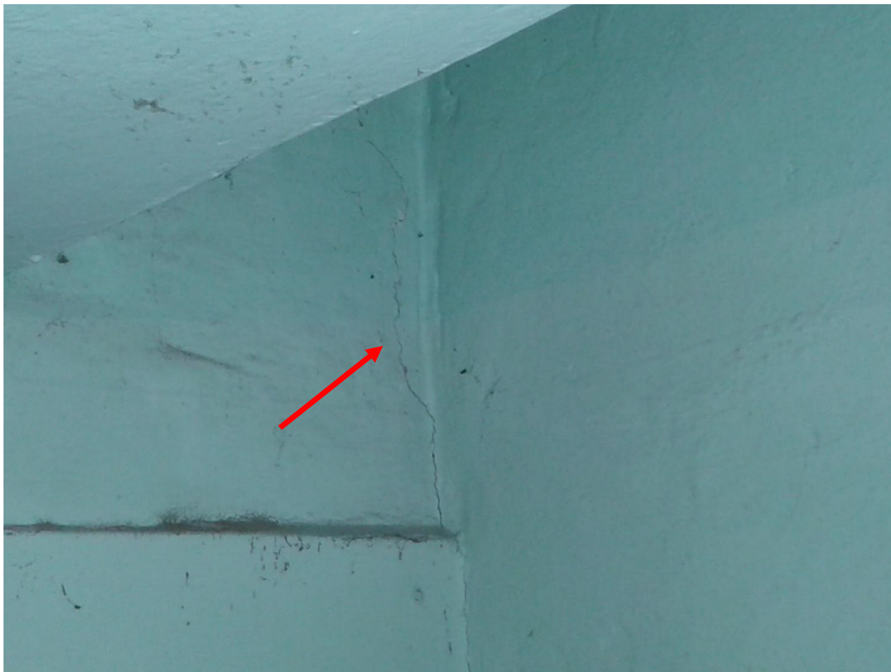
Fig. 97 – Lesione nella parete portante
