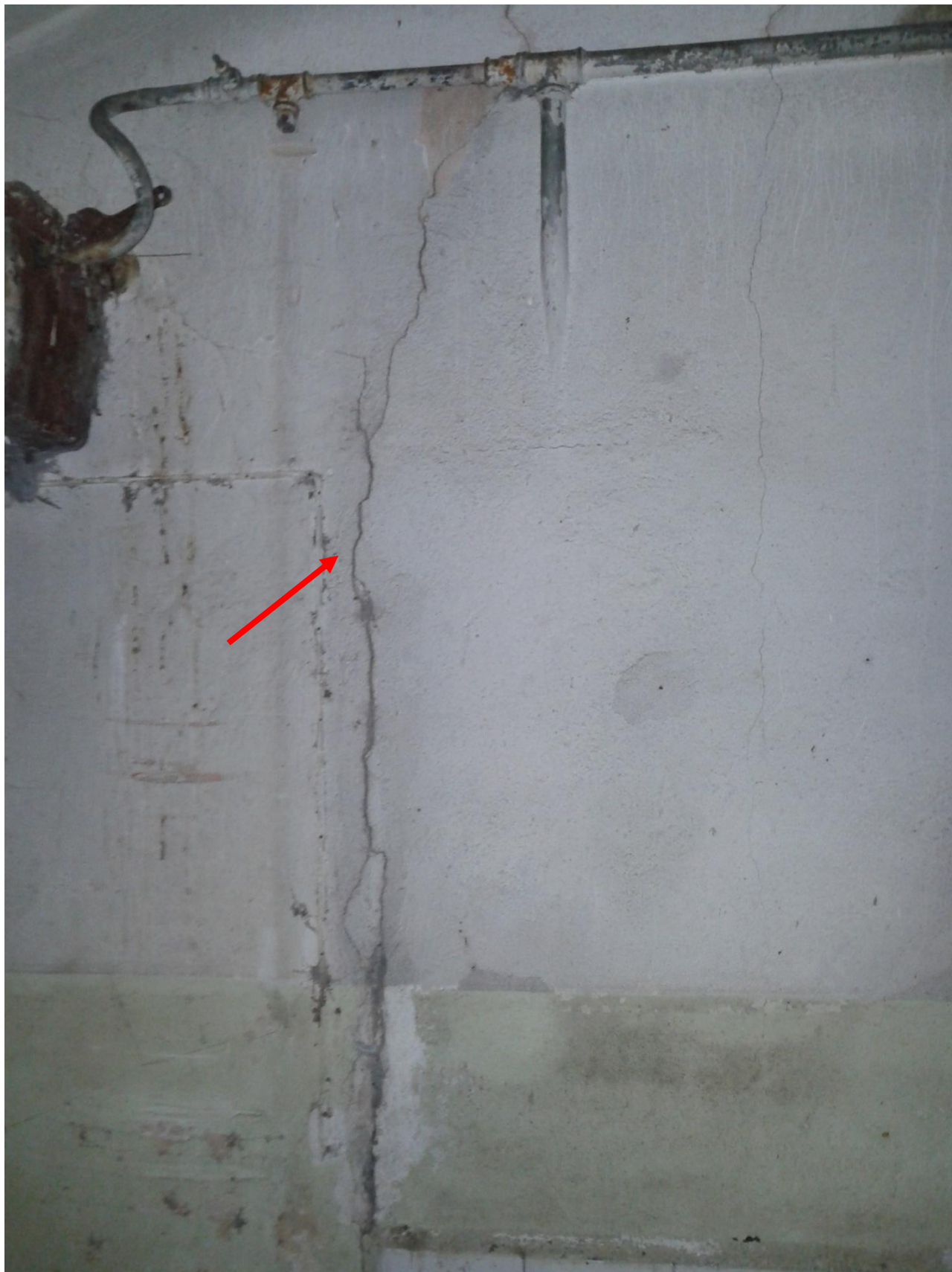
Fig. 68 – Lesione nella parete portante
