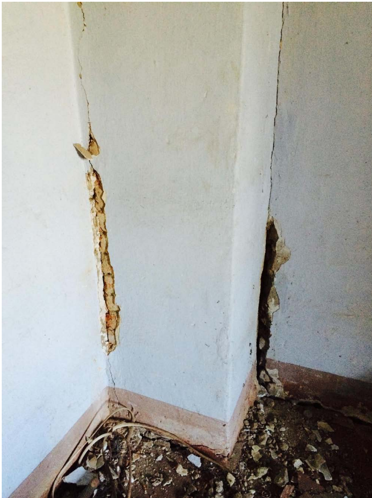
Fig. 81 – Lesione passante nella parete portante
