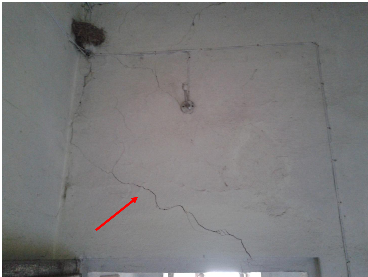
Fig. 63 – Lesione nella parete di tamponamento
