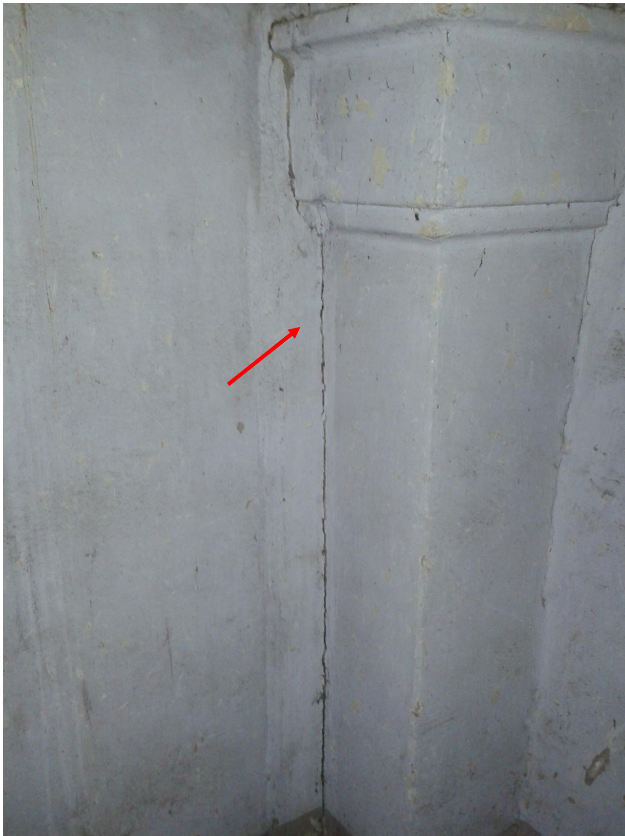
Fig. 37 – Lesione nella parete portante
