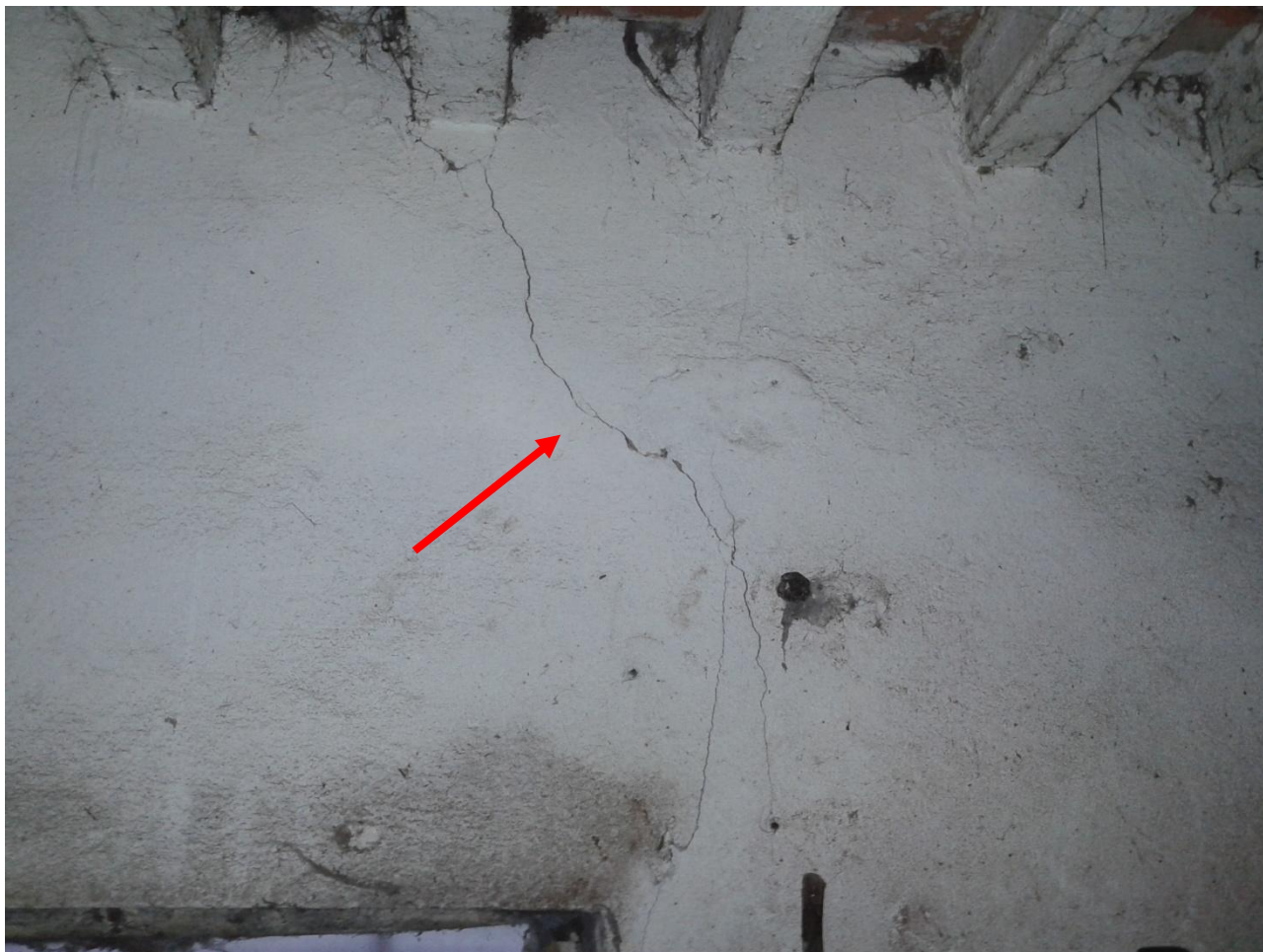
Fig. 39 – Lesione nella parete portante
