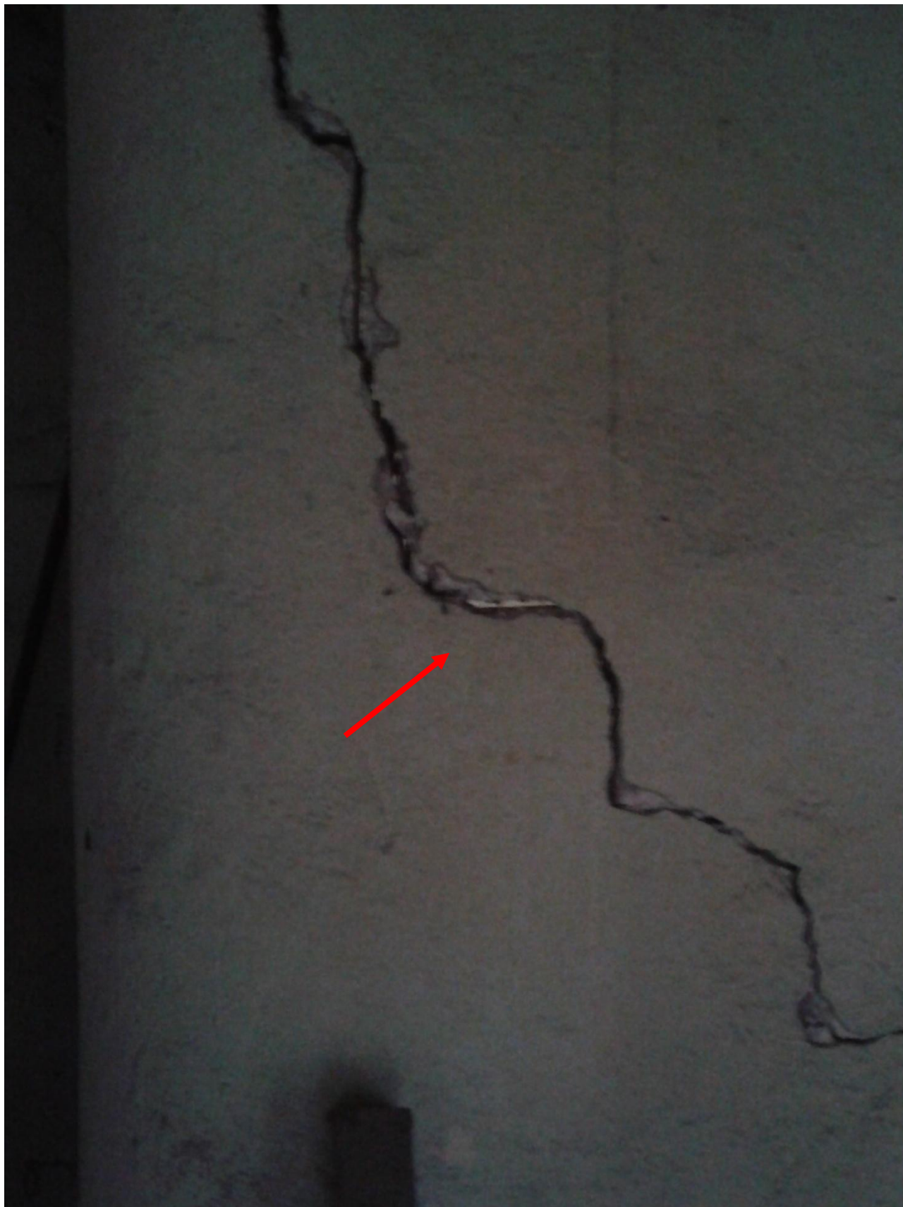
Fig. 47 – Lesione passante nella parete di tamponamento
