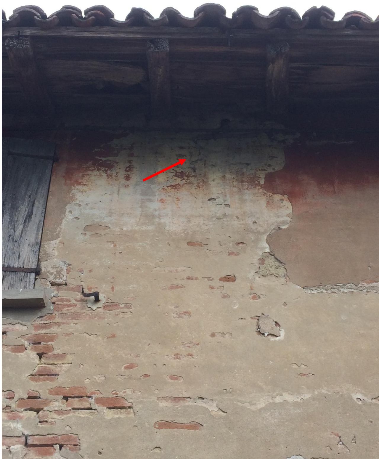
Fig. 4 – Lesione verticale nella muratura portante esterna
