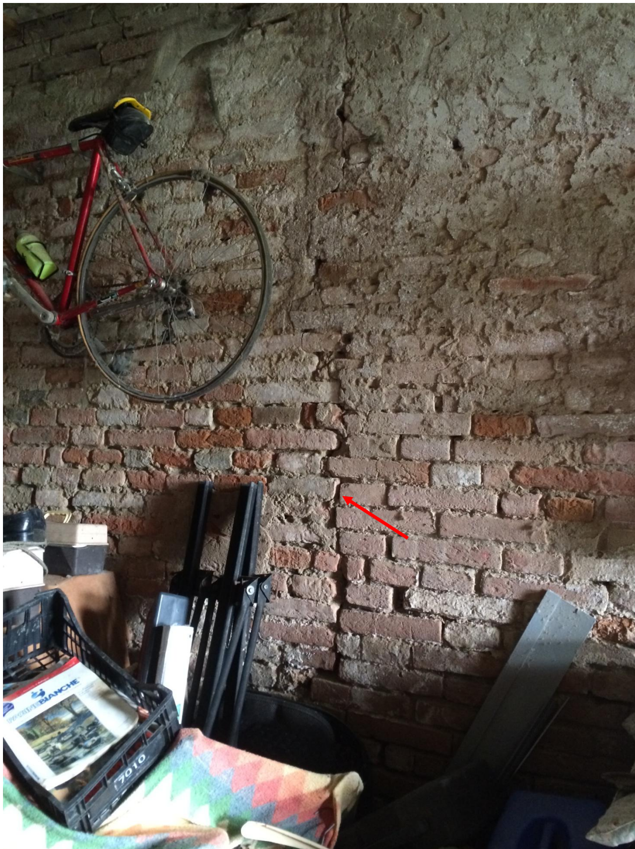
Fig. 24 – Lesione verticale nella muratura portante
