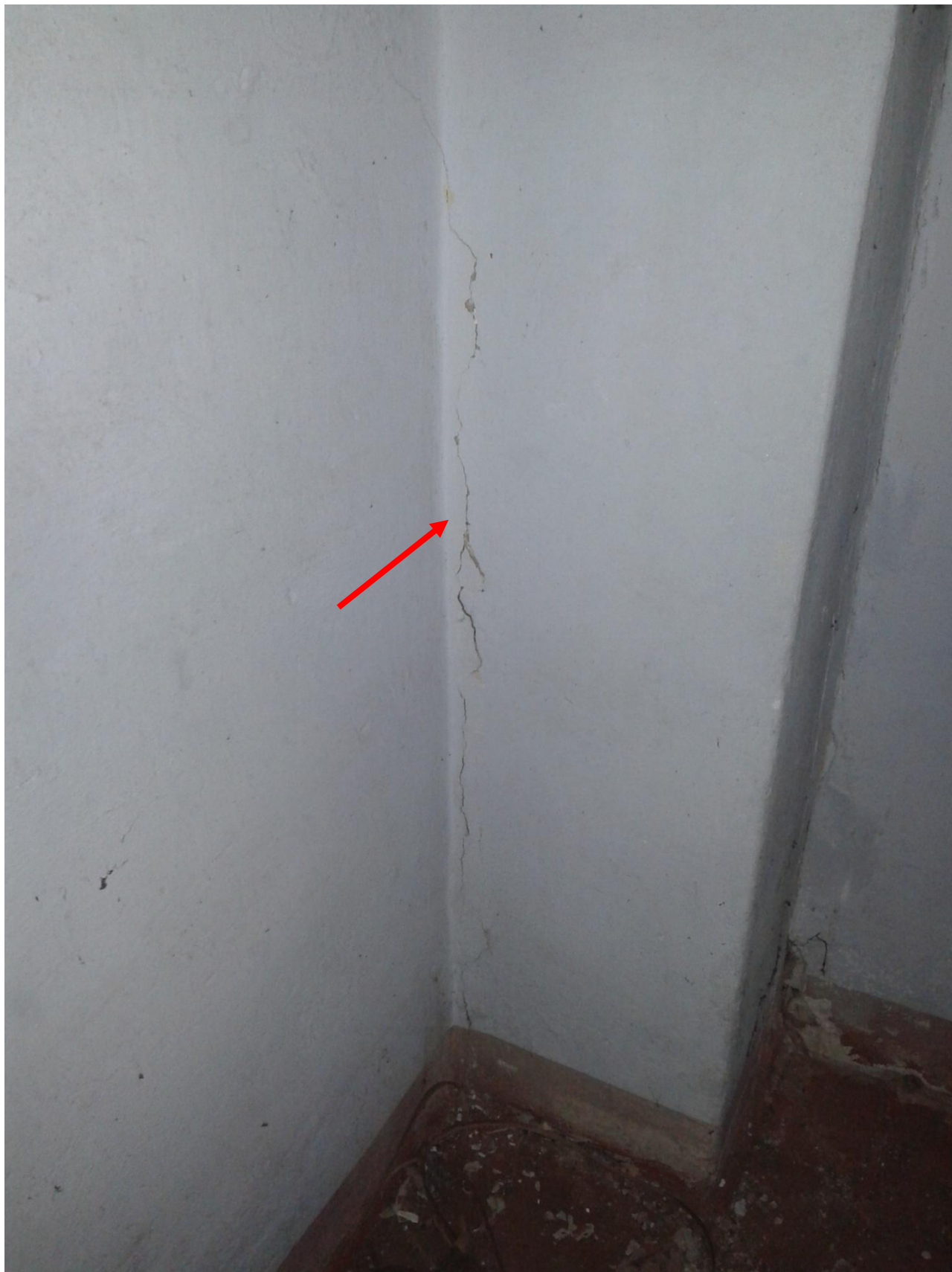
Fig. 82 – Lesione nella parete portante
