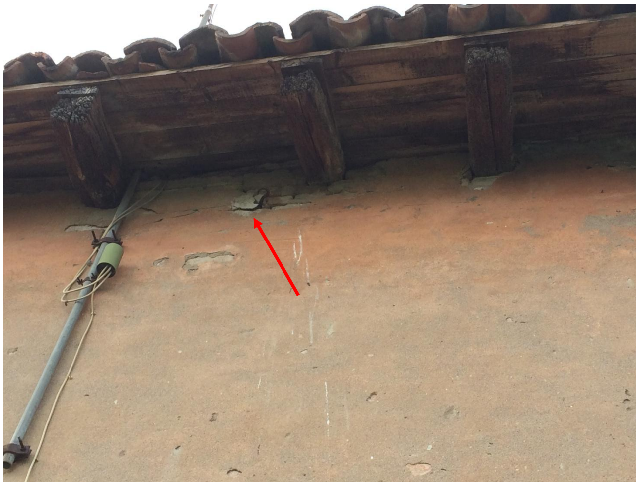
Fig. 13 – Lesioni nella parete esterna in corrispondenza del coperto in legno
