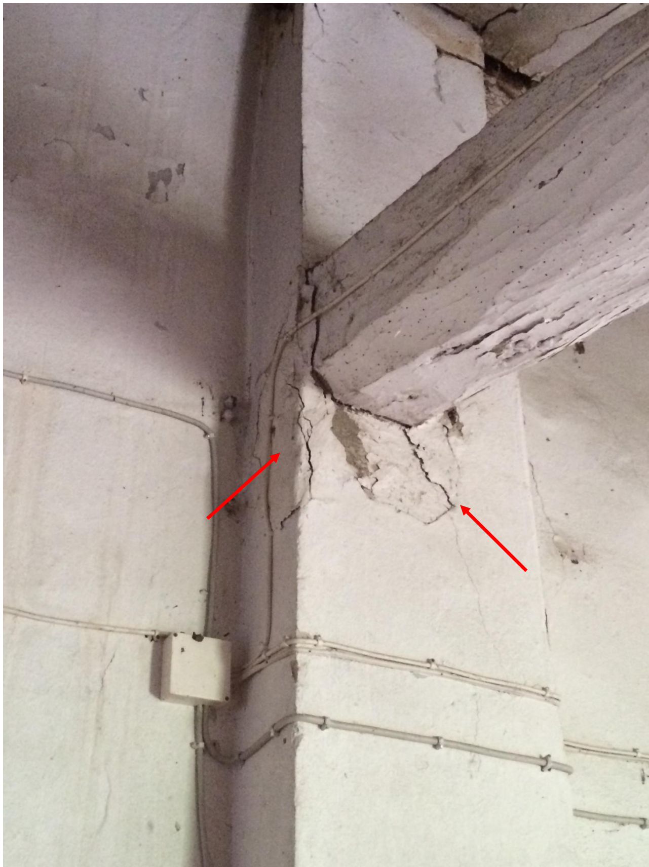
Fig. 40 – Rottura del pilastro per sfondamento della trave in legno che sostiene il coperto
