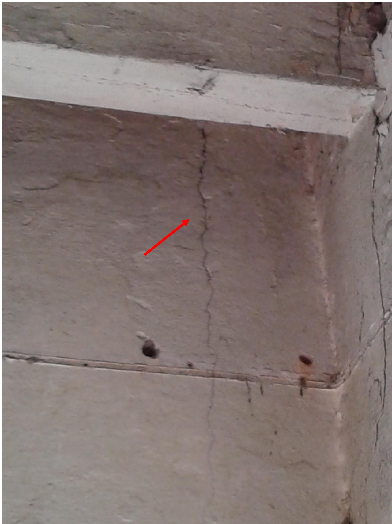
Fig. 92 – Lesione nella parete portante
