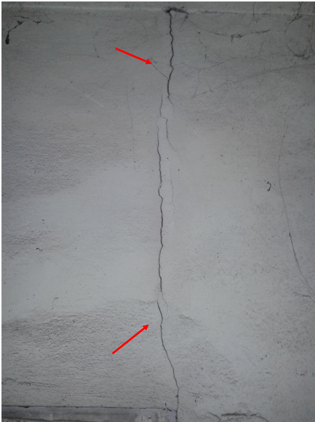
Fig. 49 – Lesione nella parete portante
