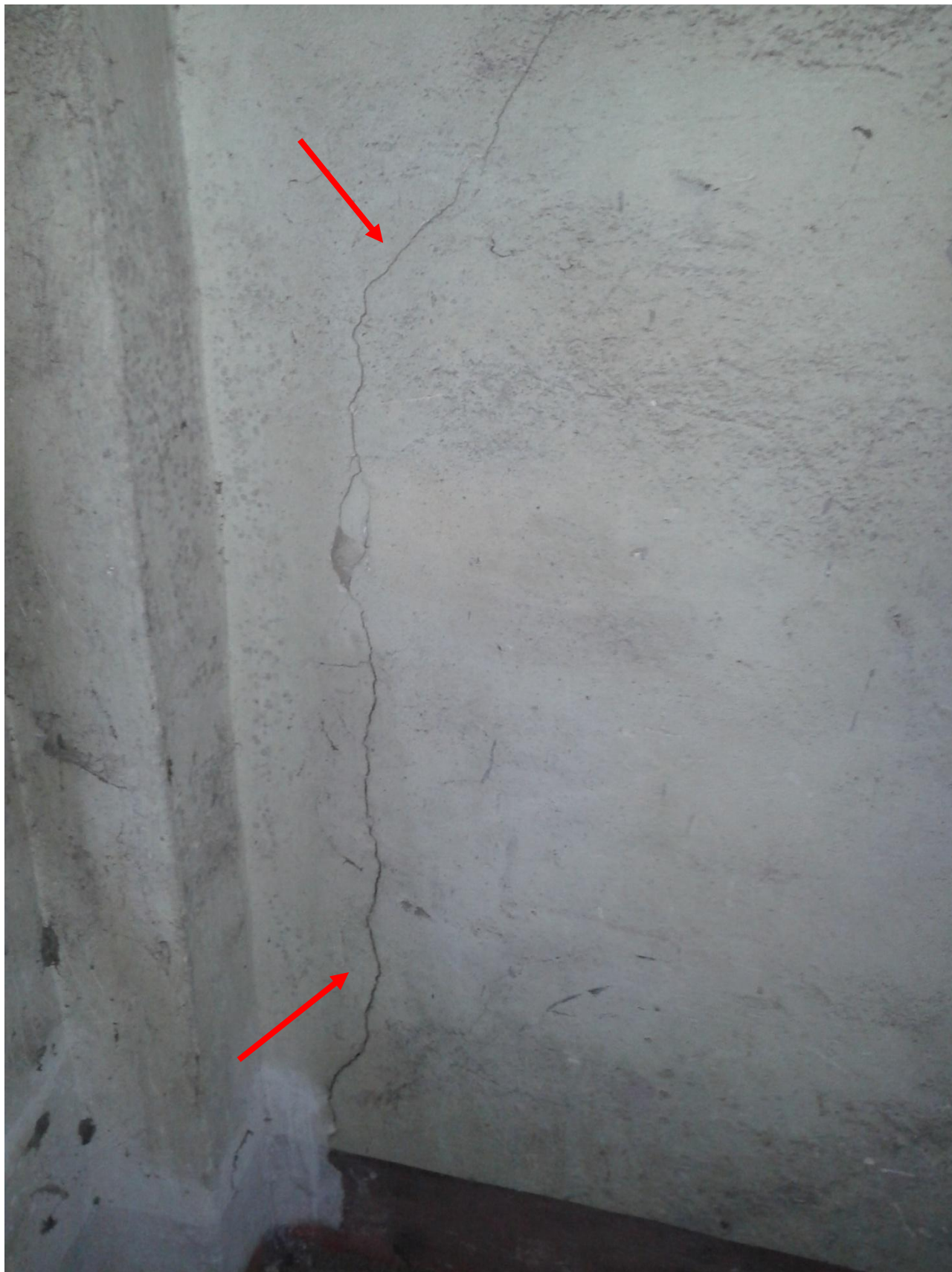
Fig. 48 – Lesione nella parete portante
