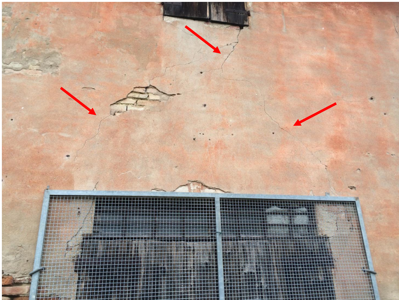
Fig. 20 – Lesioni diagonali nella parete portante
