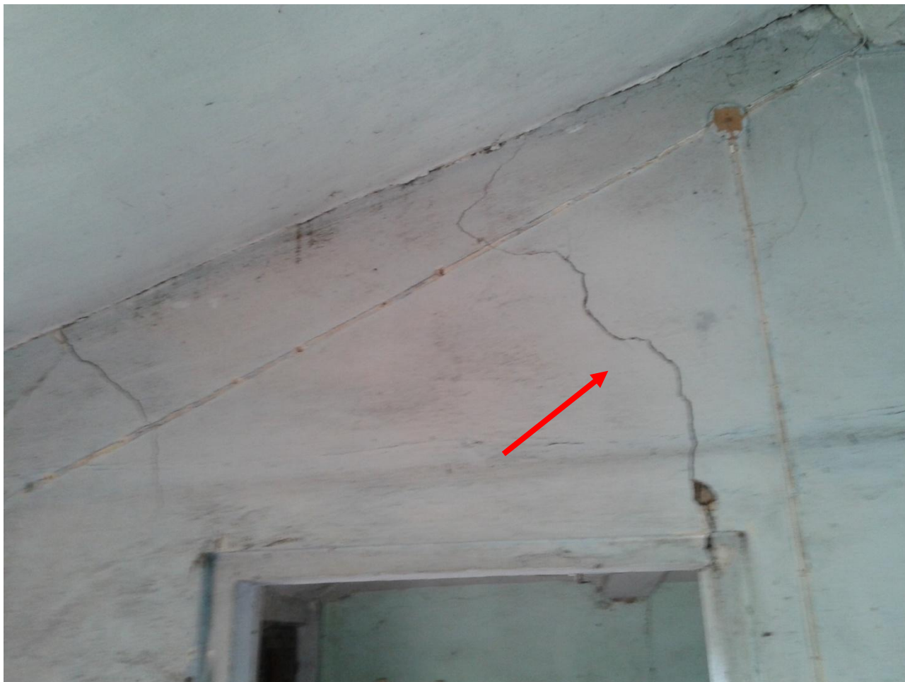
Fig. 71 – Lesione passante nella parete portante
