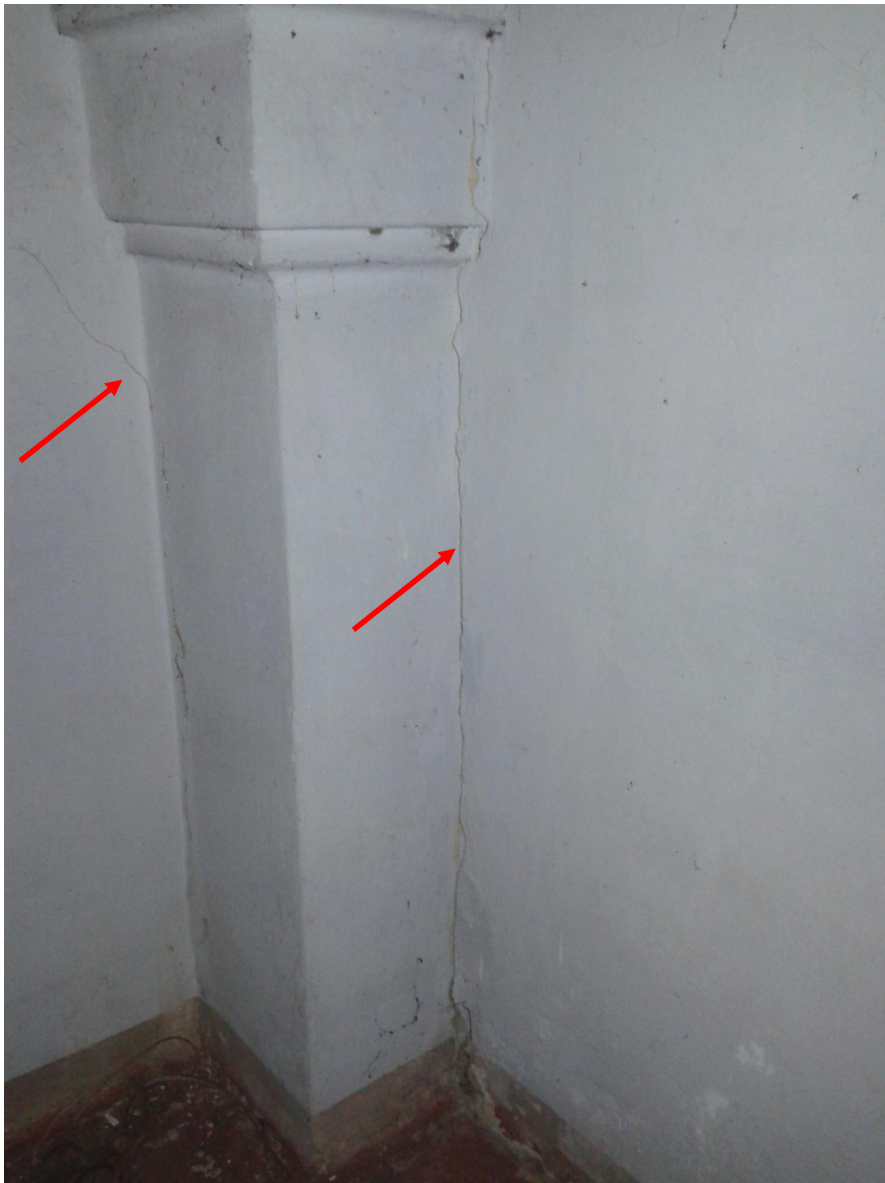
Fig. 83 – Lesione nella parete portante
