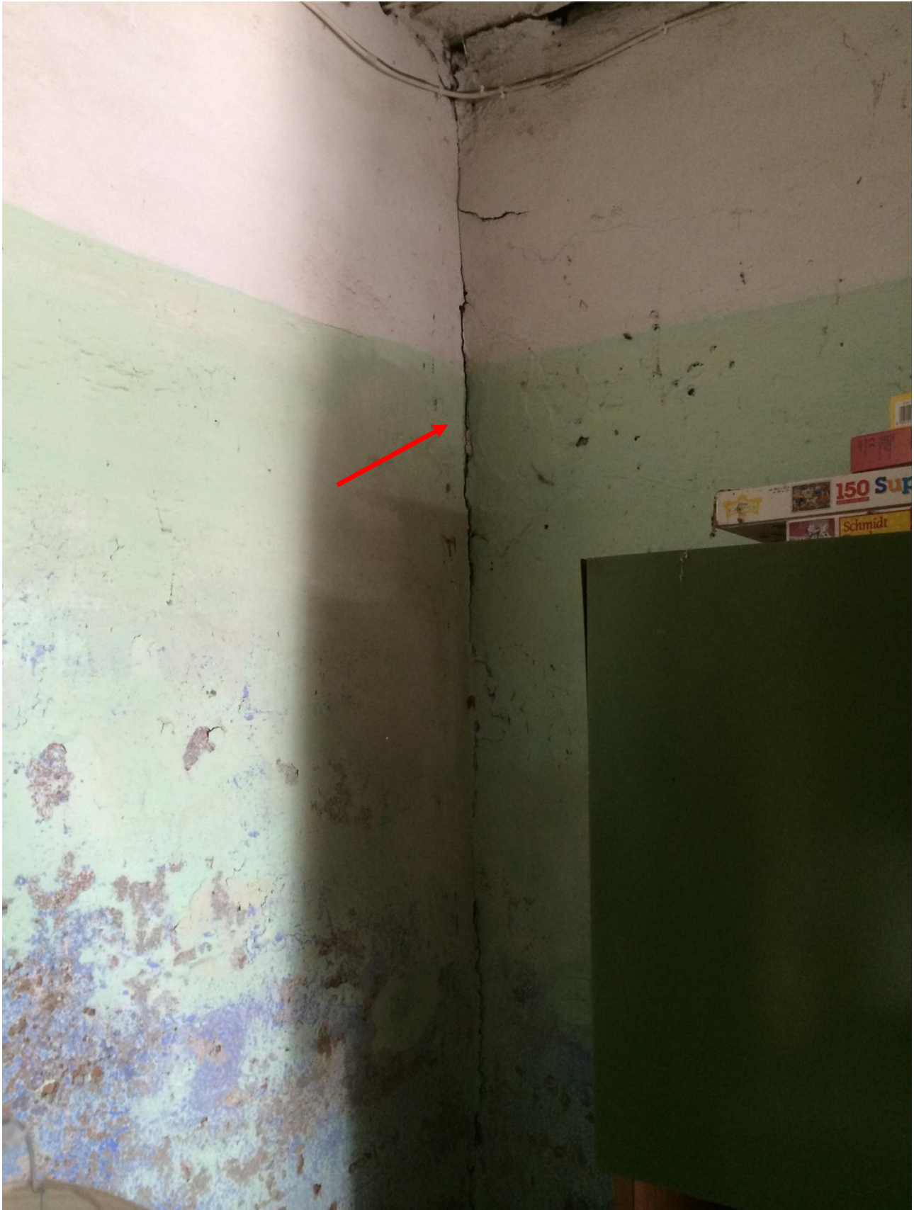
Fig. 27 – Lesioni verticale nella muratura portante
