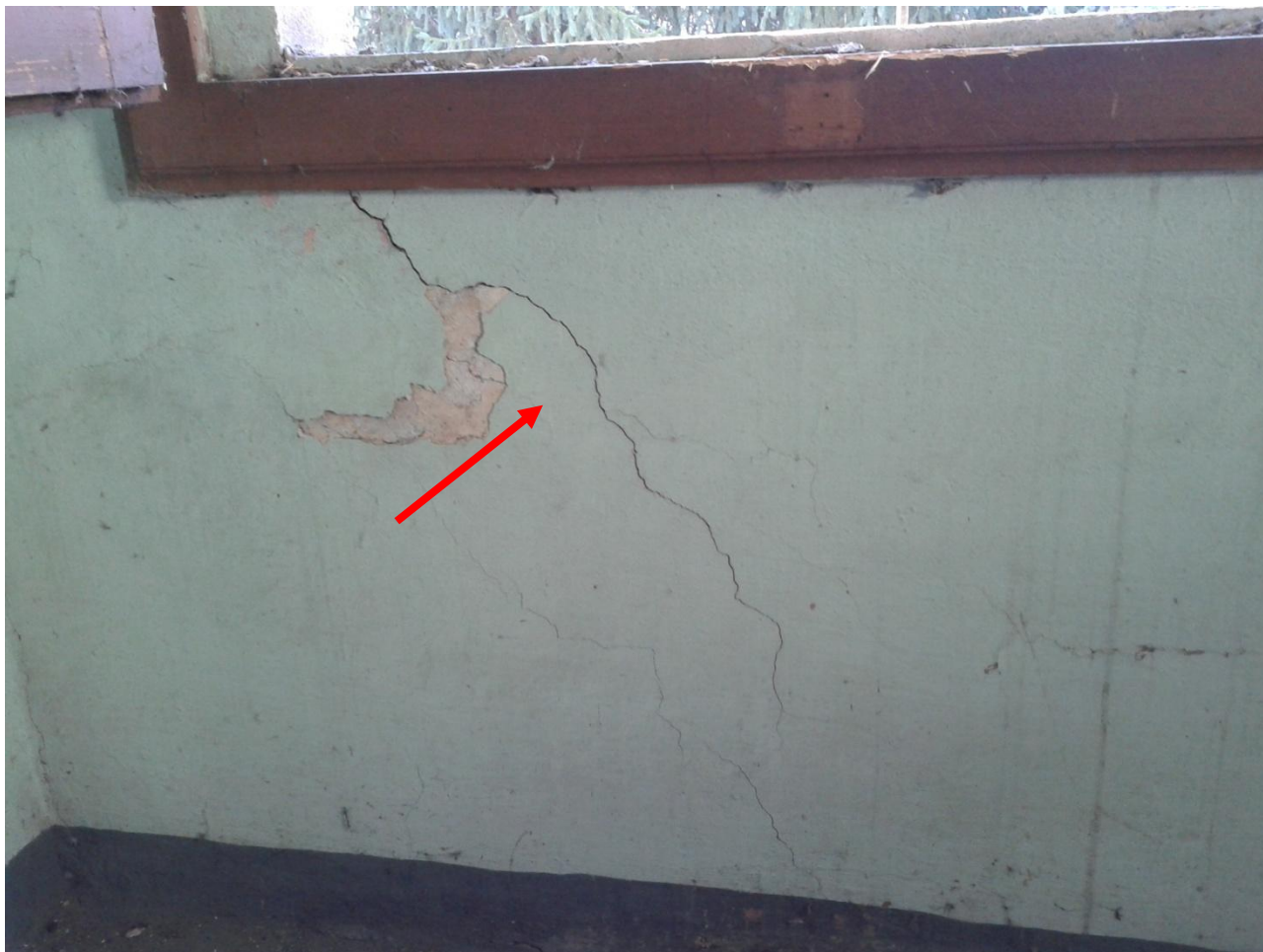
Fig. 79 – Lesione passante nella parete portante
