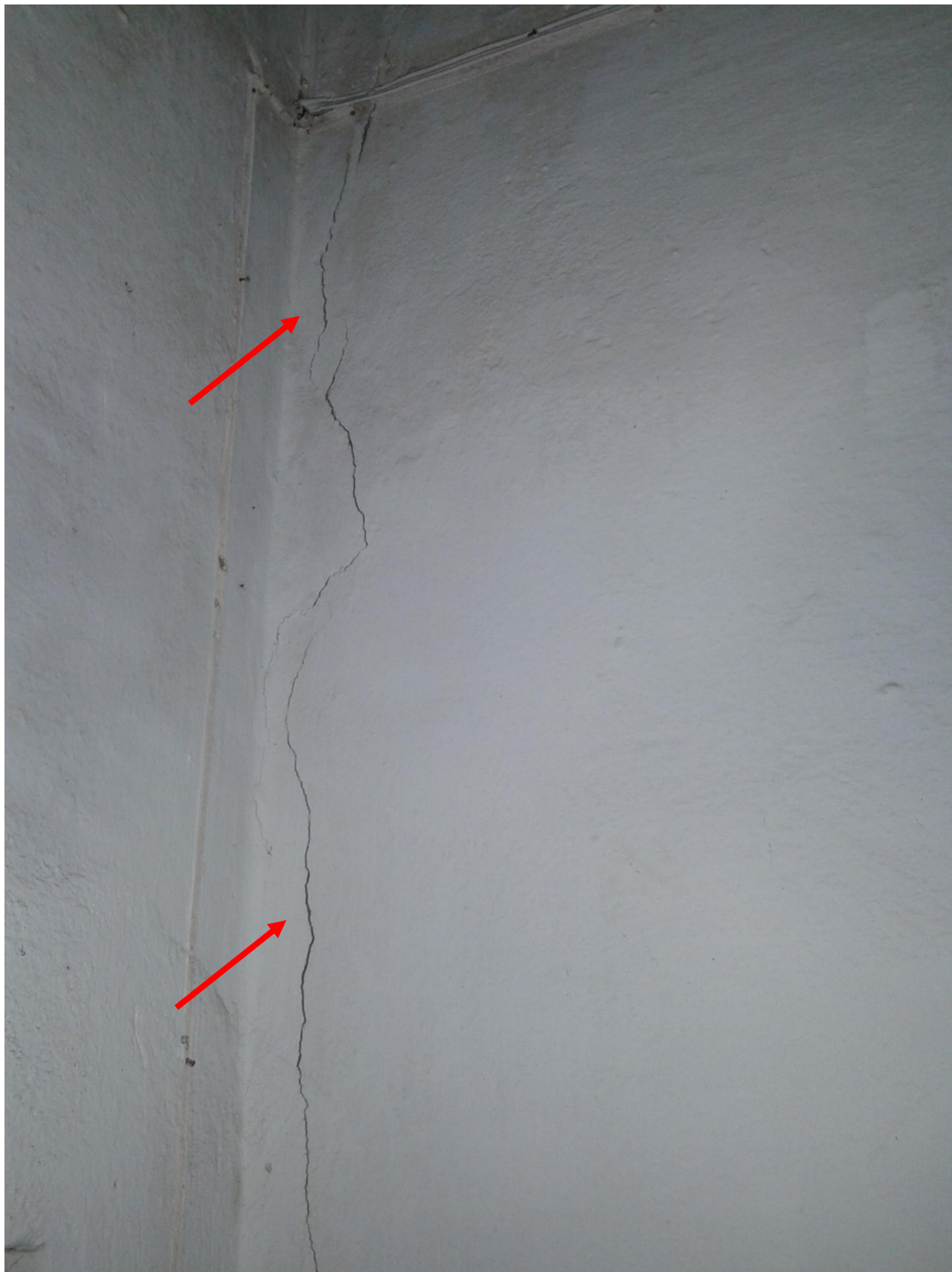
Fig. 98 – Lesione nella parete portante
