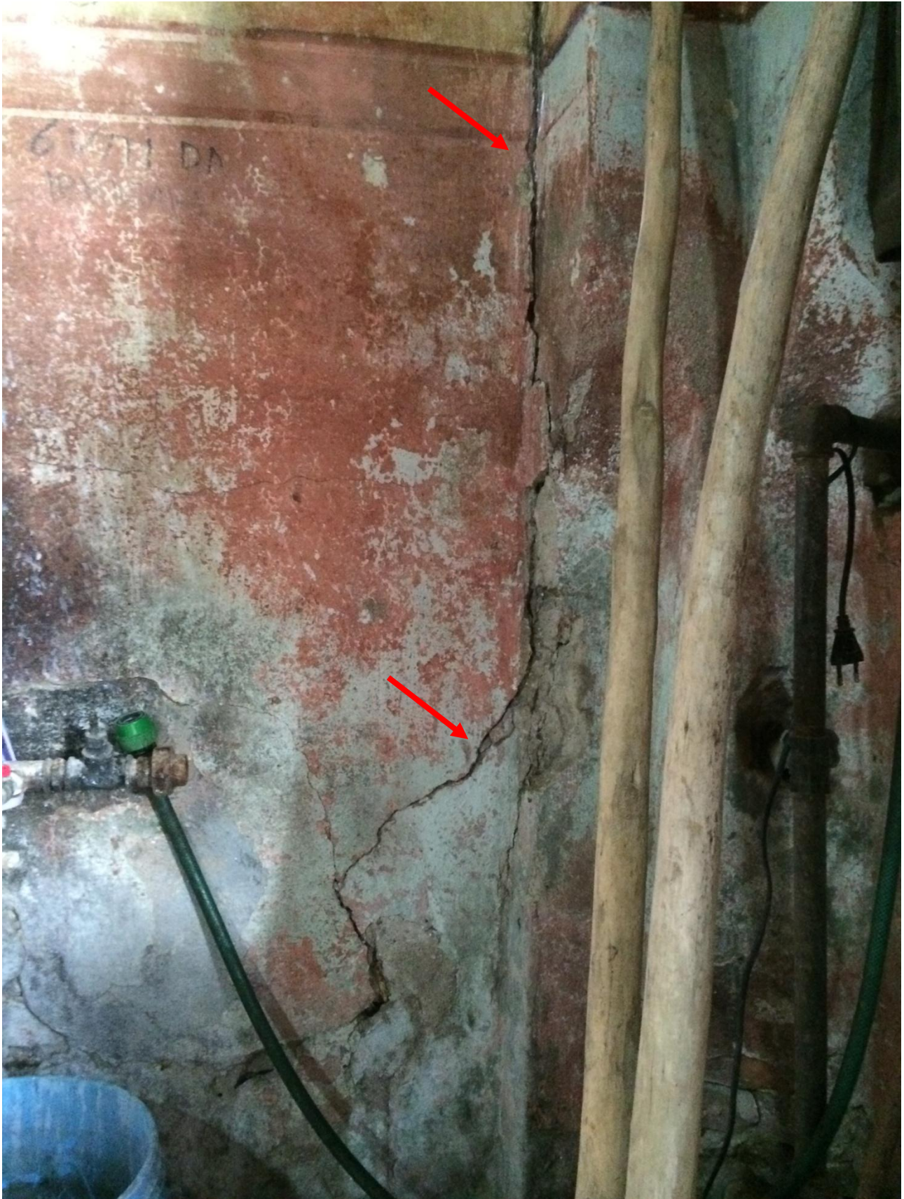
Fig. 27 – Lesione passante nella parete portante
