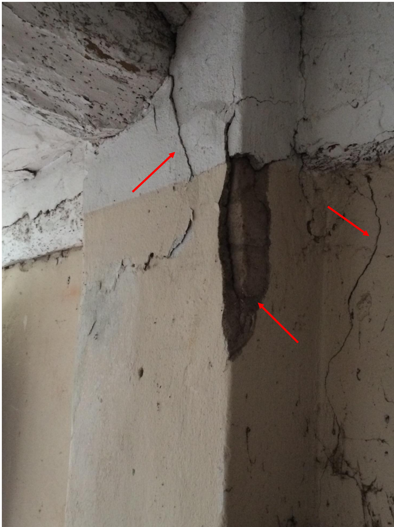
Fig. 46 – Rottura del pilastro per sfondamento della trave in legno che sostiene il coperto con parziale crollo di materiale
