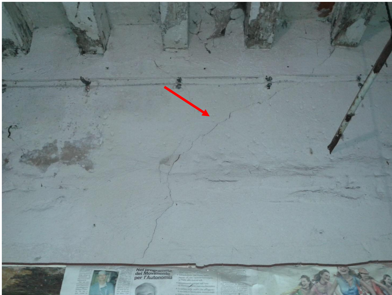
Fig. 44 – Lesione diagonale nella parete portante
