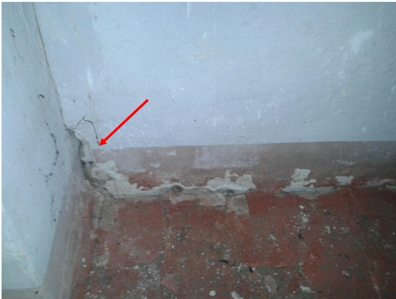
Fig. 84 – Lesione nella parete portante
