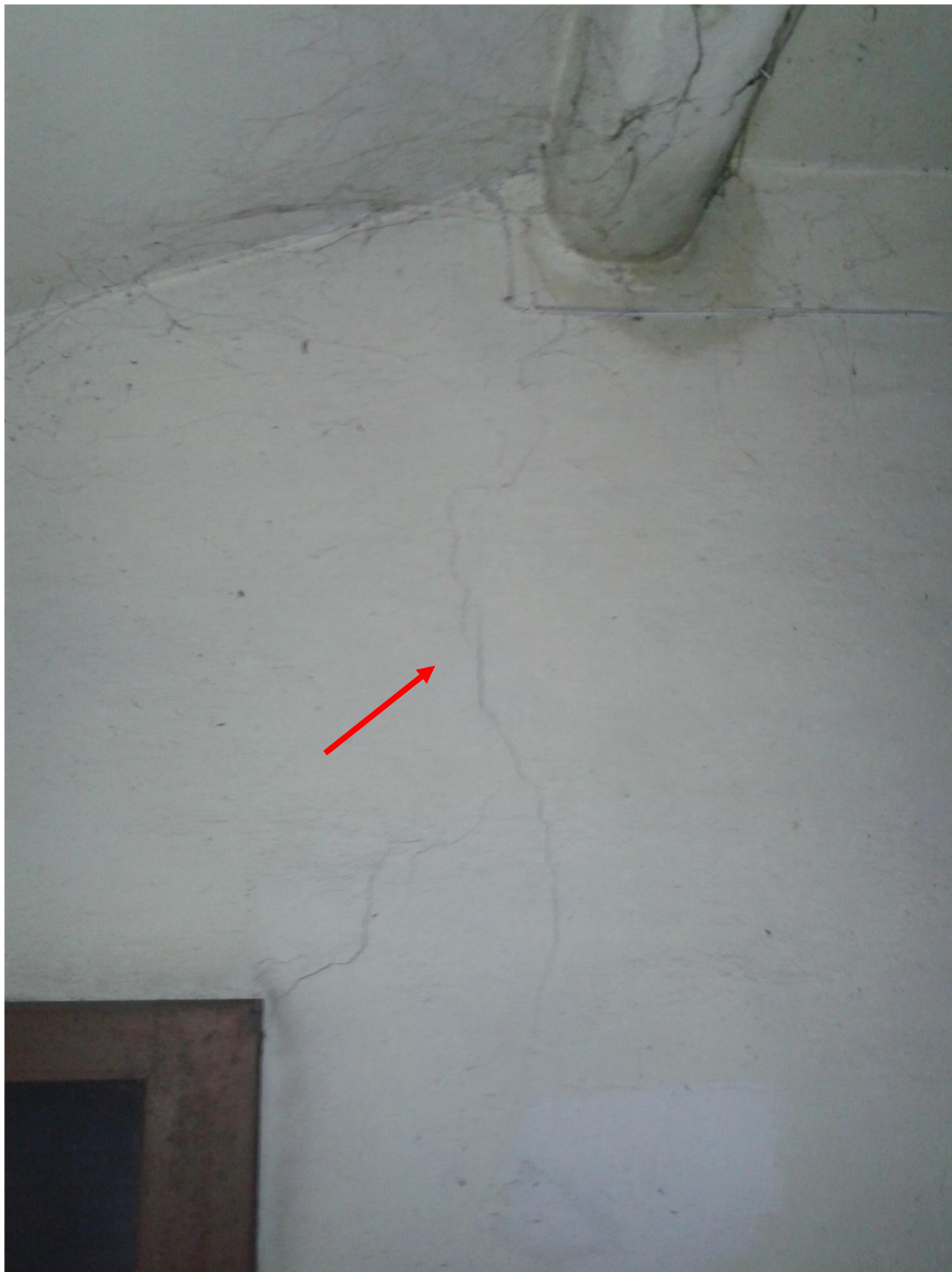
Fig. 62 – Lesione nella parete di tamponamento
