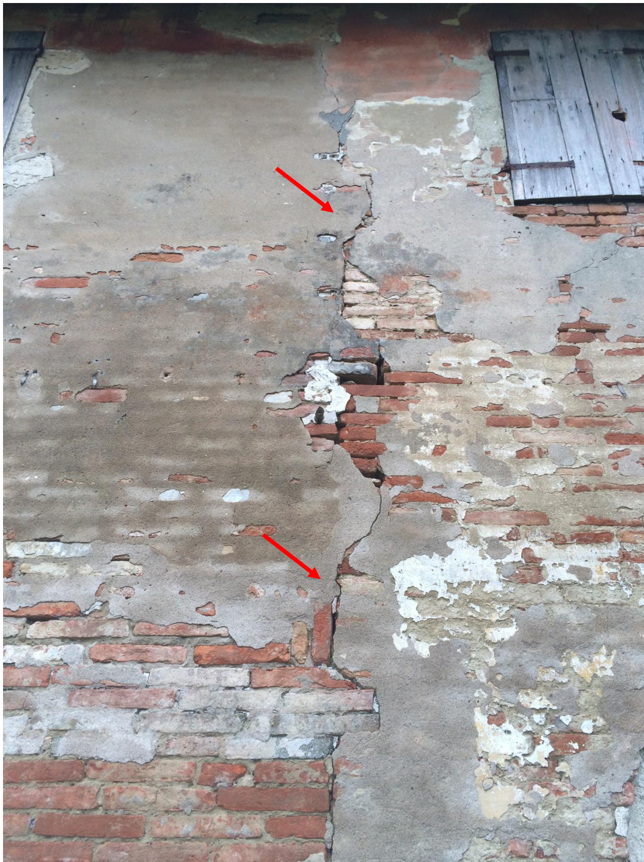
Fig. 25 – Lesione verticale passante nella parete portante
