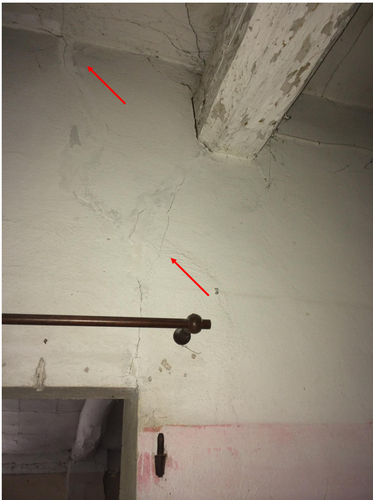
Fig. 51 – Lesioni nella parete portante dovute allo sfilamento della trave
