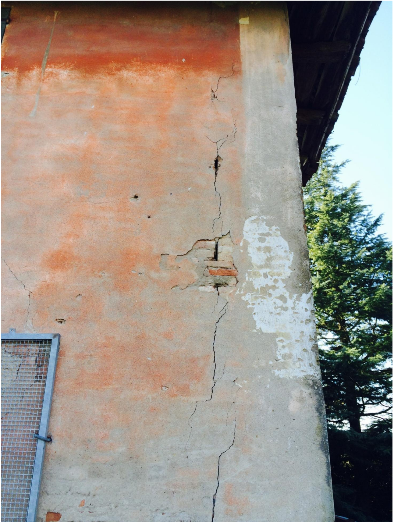
Fig. 104 – Lesione passante nella parete portante
