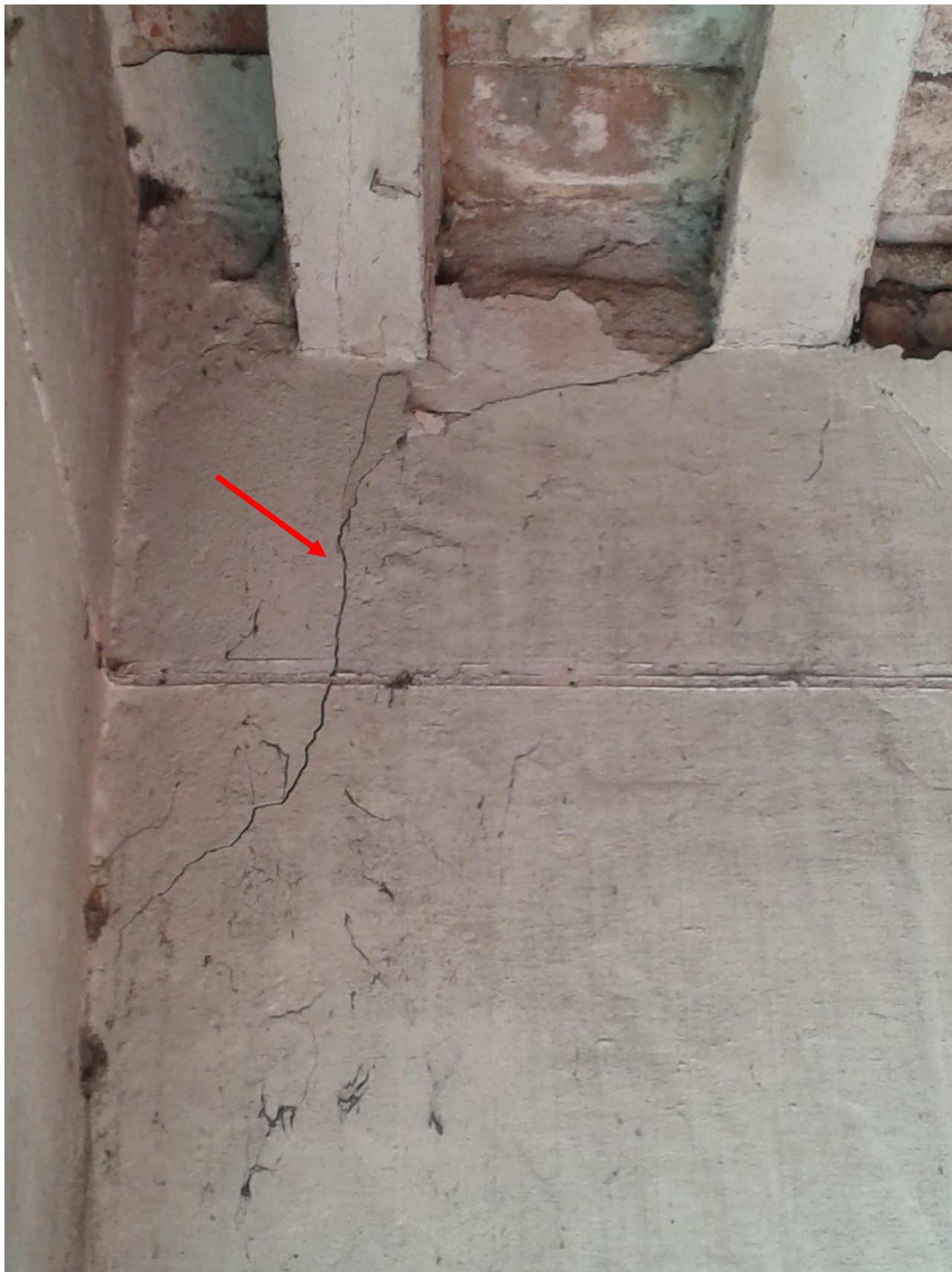
Fig. 93 – Lesione nella parete portante
