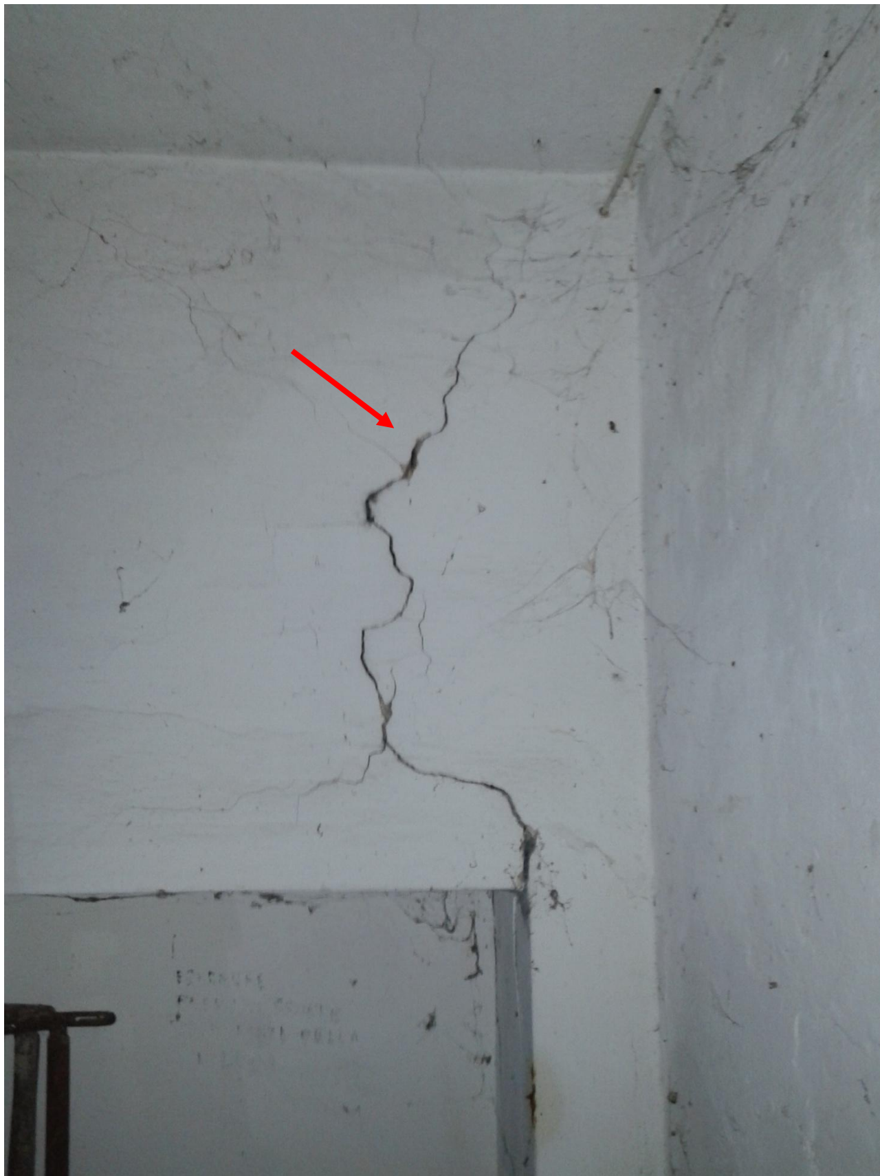
Fig. 61 – Lesione passante nella parete portante
