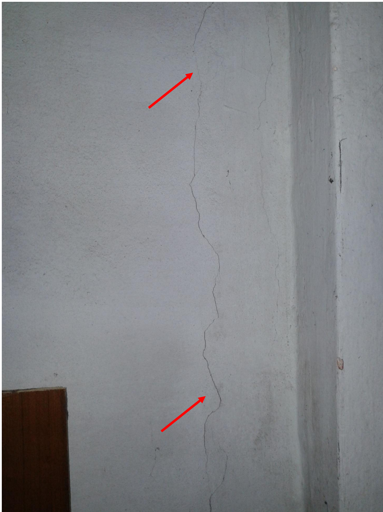
Fig. 88 – Lesione nella parete portante
