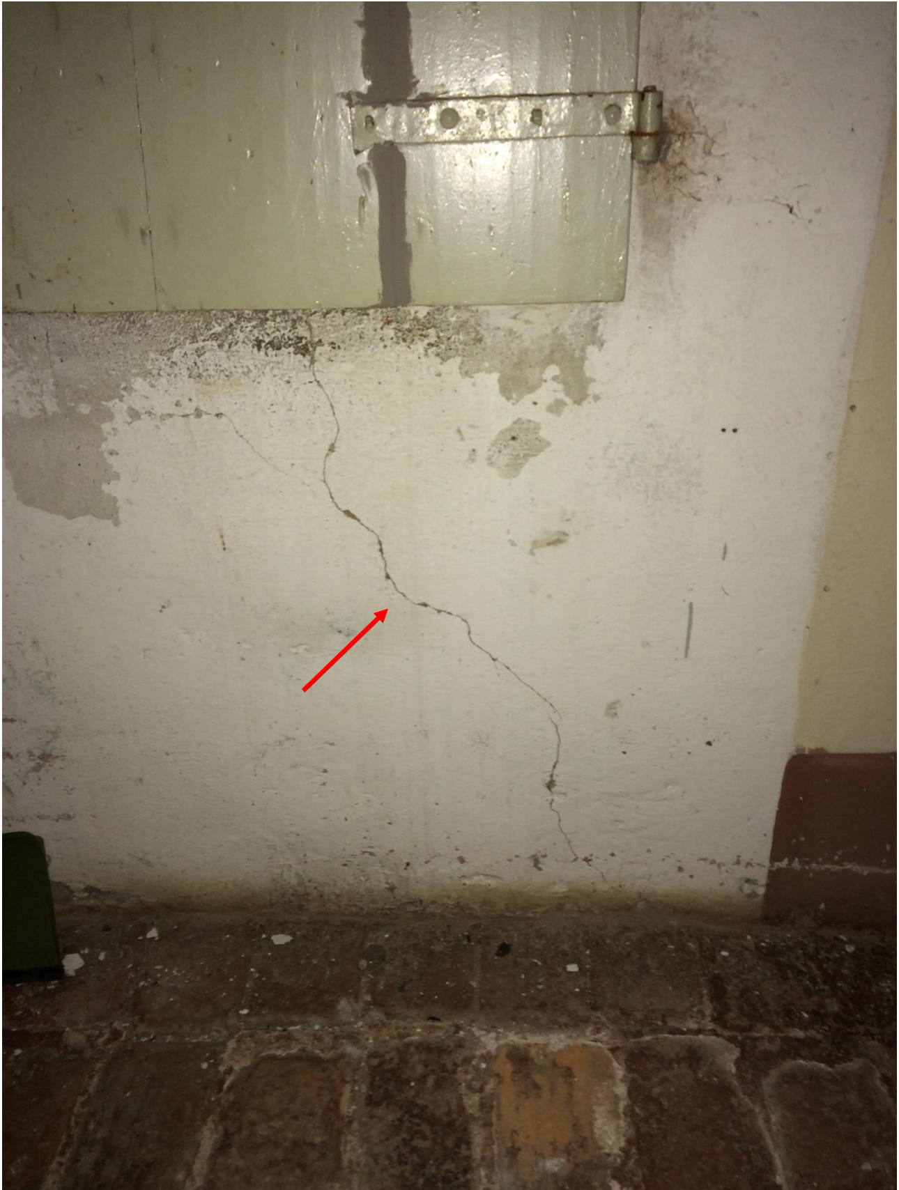
Fig. 62 – Lesione nella parete portante
