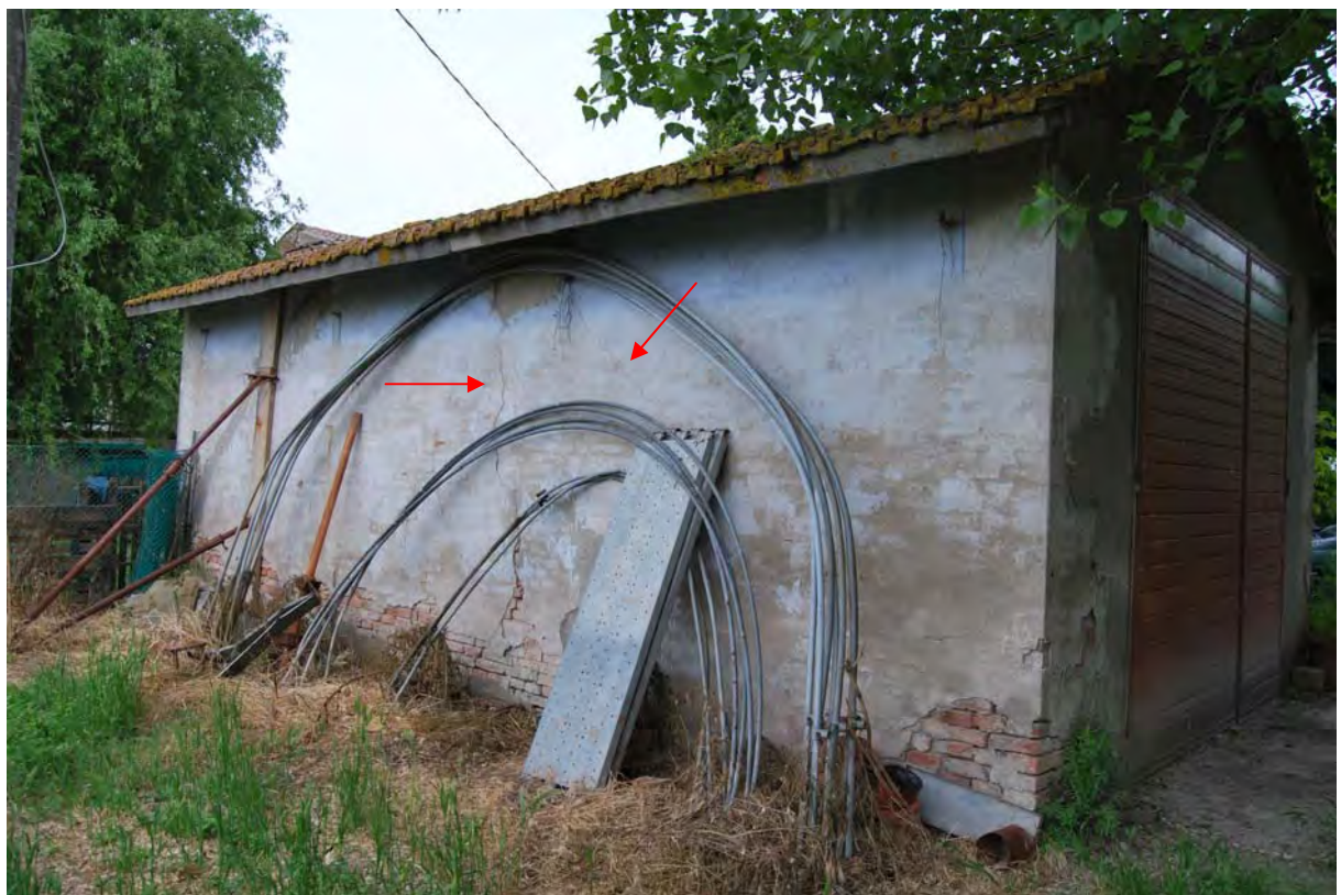
Presenza di lesioni passanti con andamento verticale e diagonale sulle murature perimetrali.
