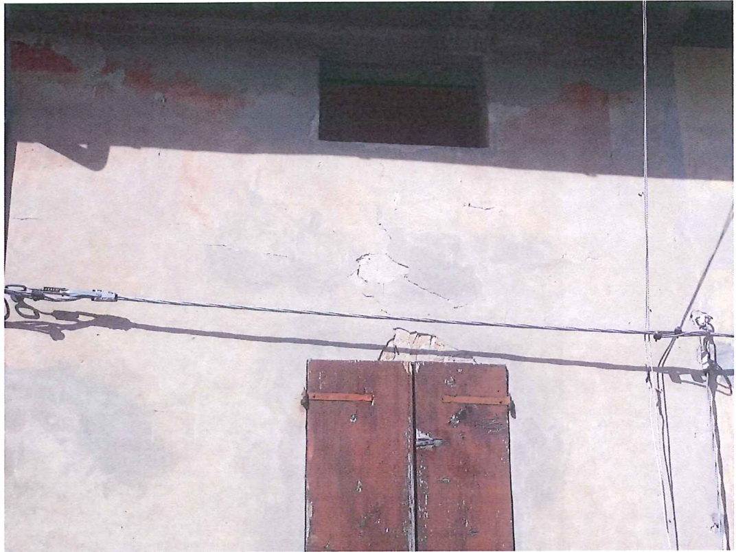
FOTO 7 = Prospetto principale – Dettaglio della lesione di una pattabanda
