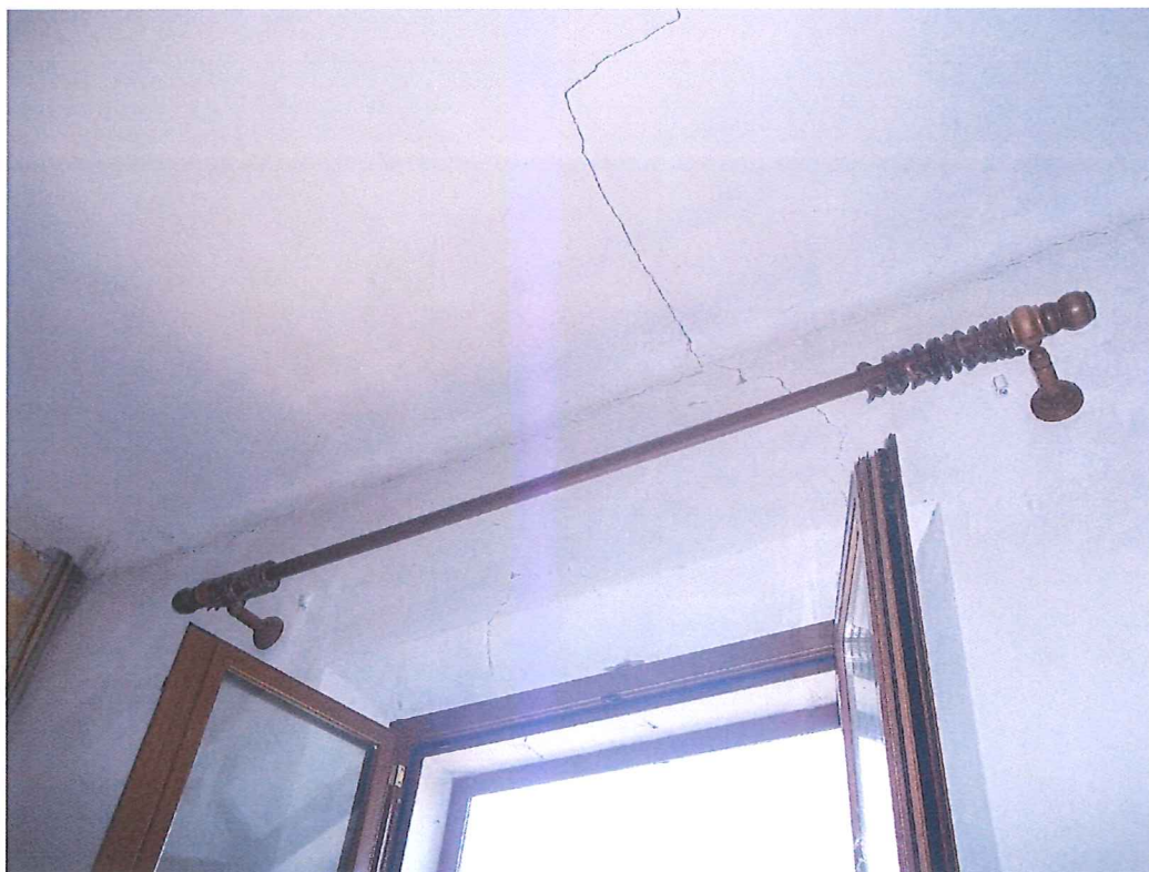
FOTO 38 = Interno – Lesione delle piattabande e del controsoffitto
