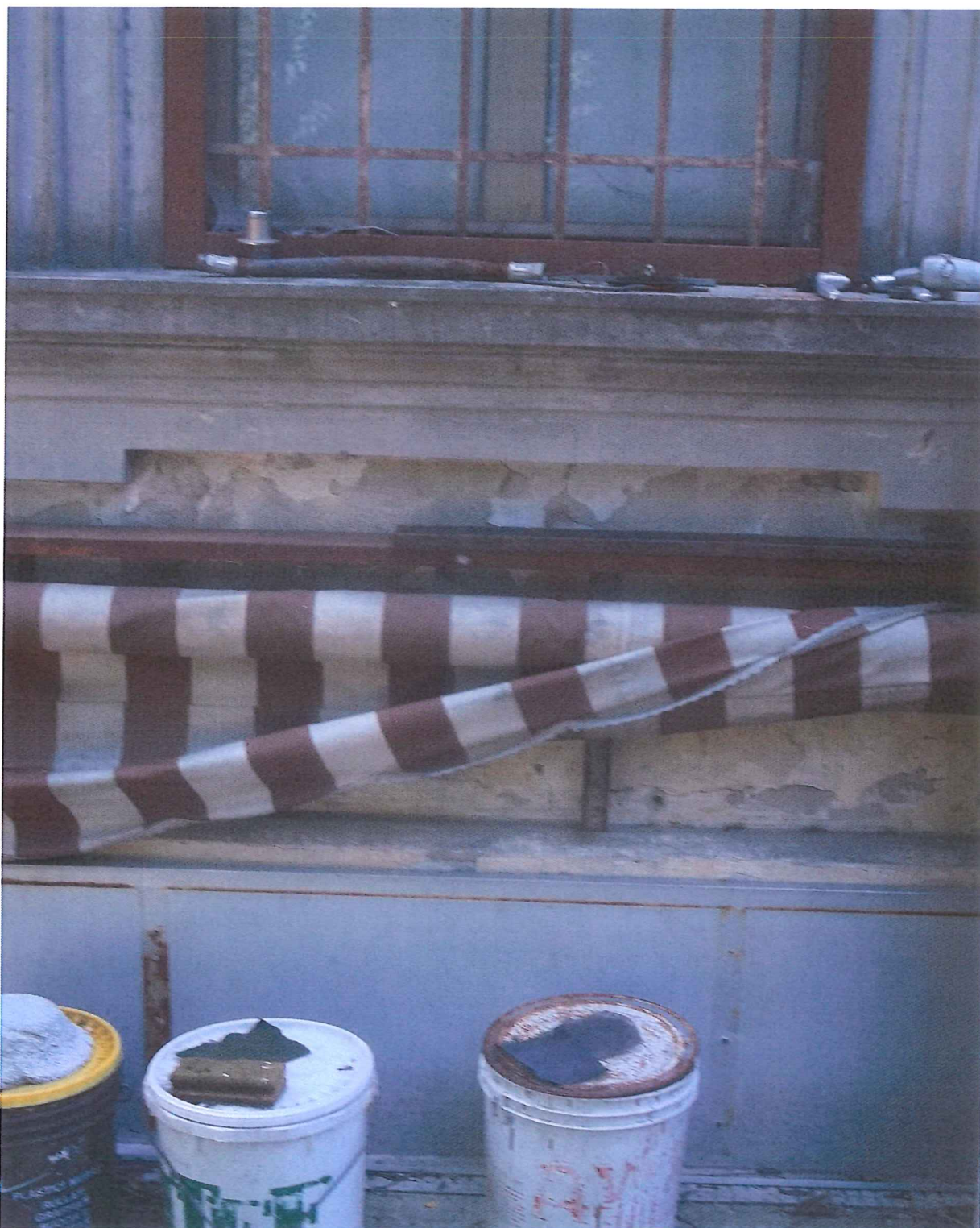
FOTO 18 = Prospetto laterale – Bancale lesionato ed umidità di risalita
