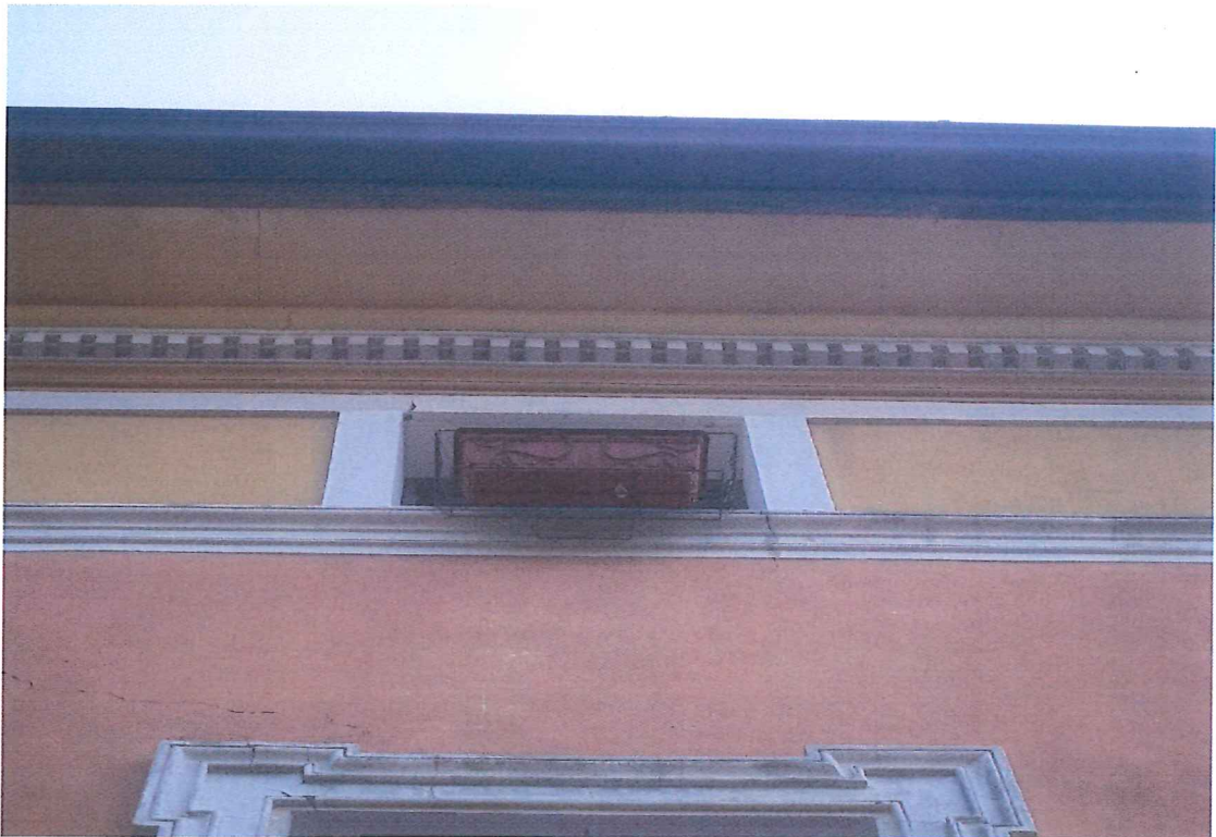
FOTO 7 = Prospetto principale – Dettaglio della lesione di una pattabanda
