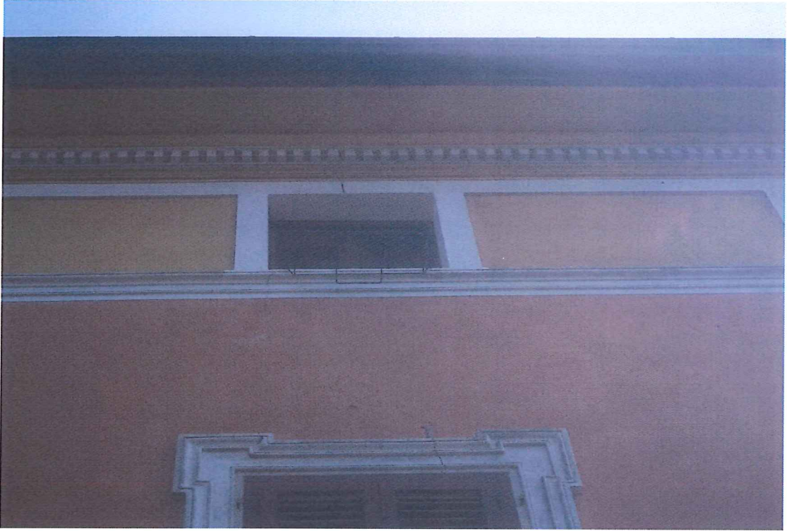
FOTO 6 = Prospetto principale – Dettaglio della lesione di una pattabanda
