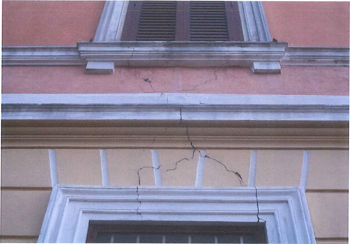
FOTO 4 = Prospetto principale – Dettaglio della lesione di una pattabanda
