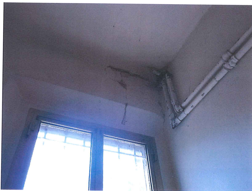
FOTO 31 = Interno – Lesione delle piattabande
