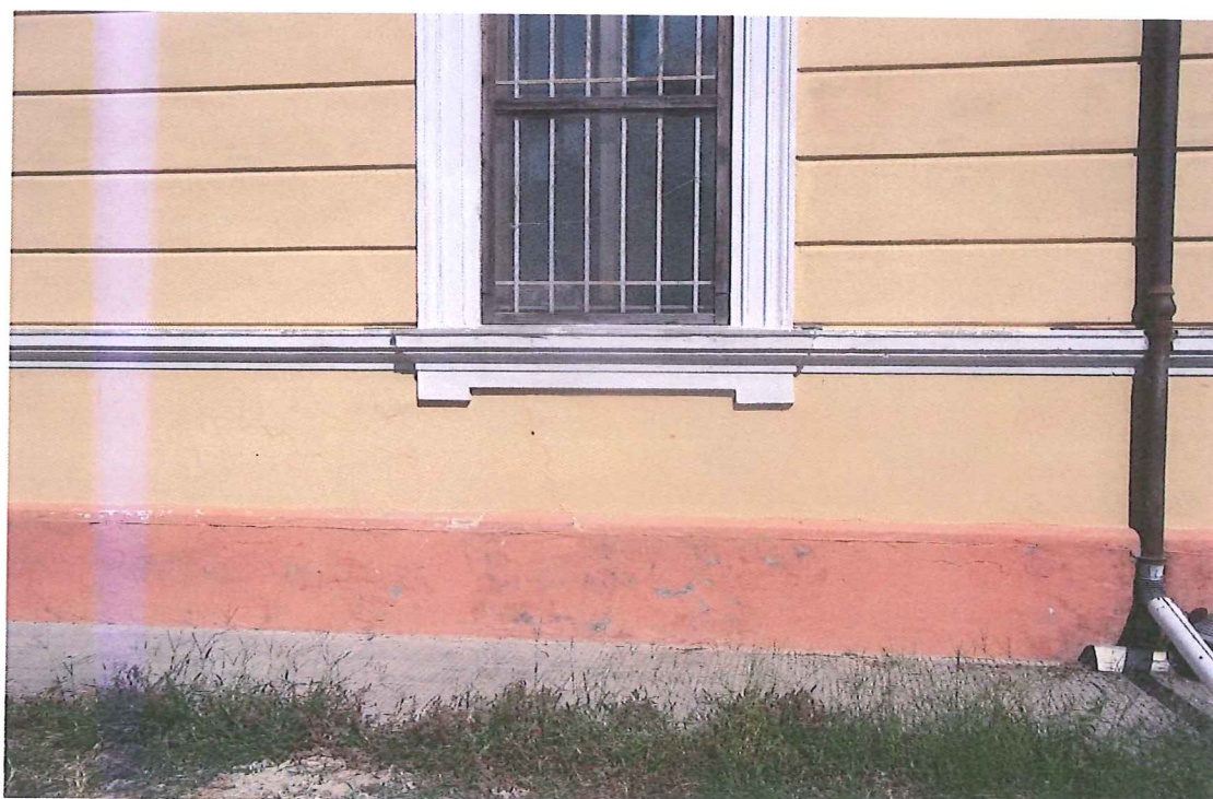
FOTO 10 = Prospetto laterale – Dettaglio della lesione di un bancale
