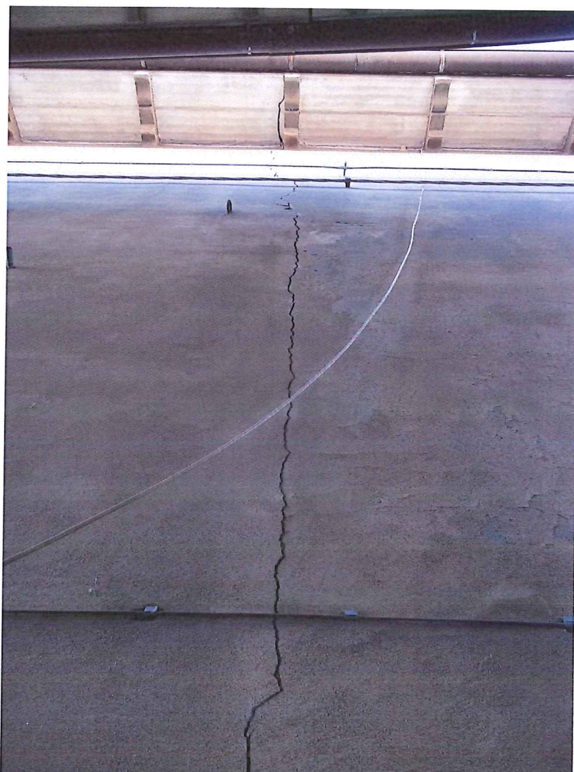
FOTO 10 = Prospetto sulla corte interna – Dettaglio di una lesione verticale e lesione nei tavelloni di coperto
