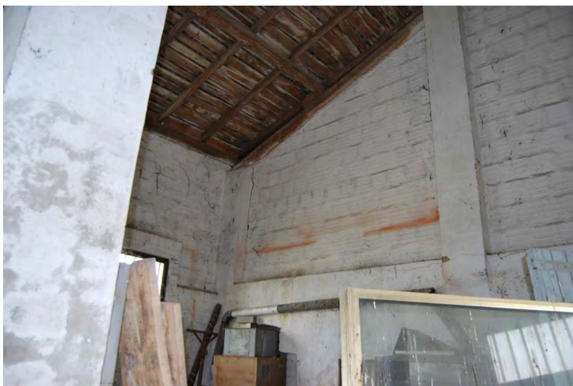
Presenza di lesioni per distacco tra i pilastri portanti in mattoni pieni e i tamponamenti in mattoni forati.
