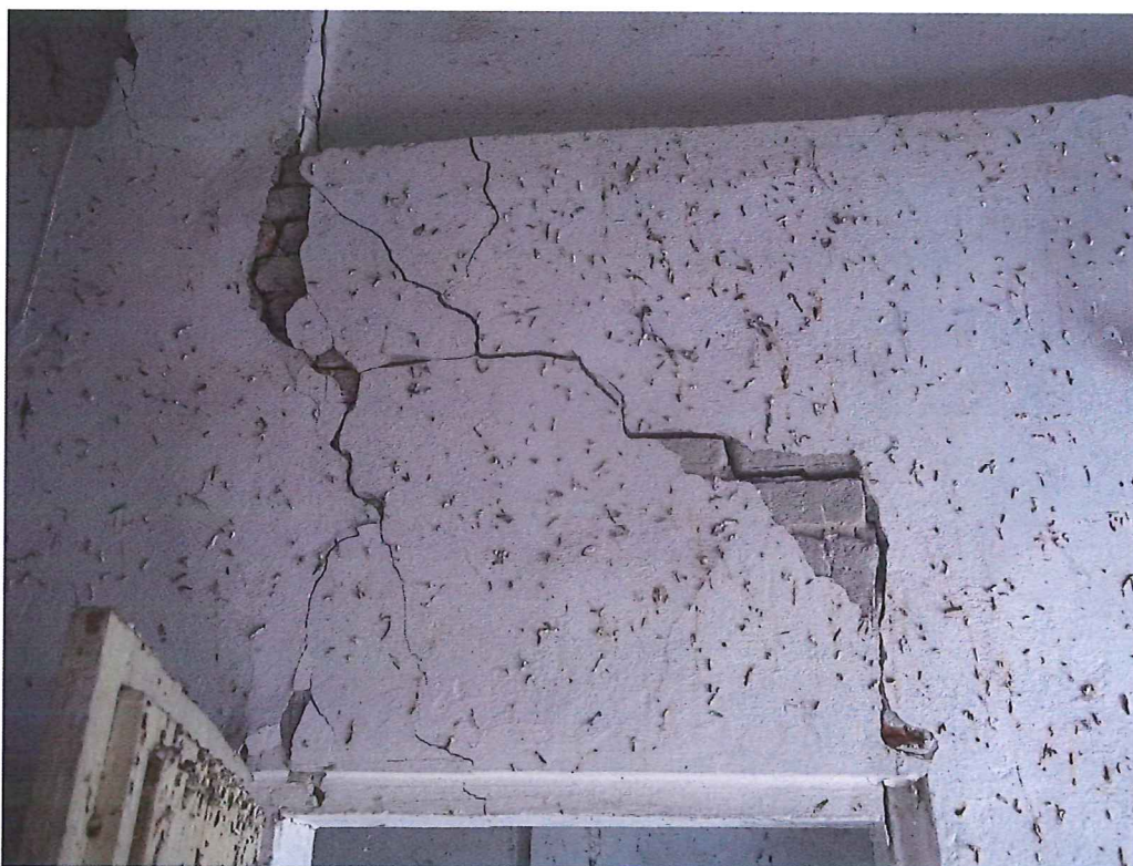
FOTO 17 = Interno – Dettaglio lesione piattabanda
