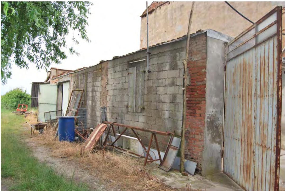
Vista dell'altro fabbricato ad uso deposito, sottratto del piano primo con intervento di demolizione per la sua precaria stabilità avvenuto prima degli eventi sismici.
