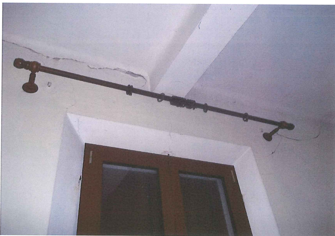
FOTO 42 = Lesione della piattabanda con appoggio trave lignea di solaio
