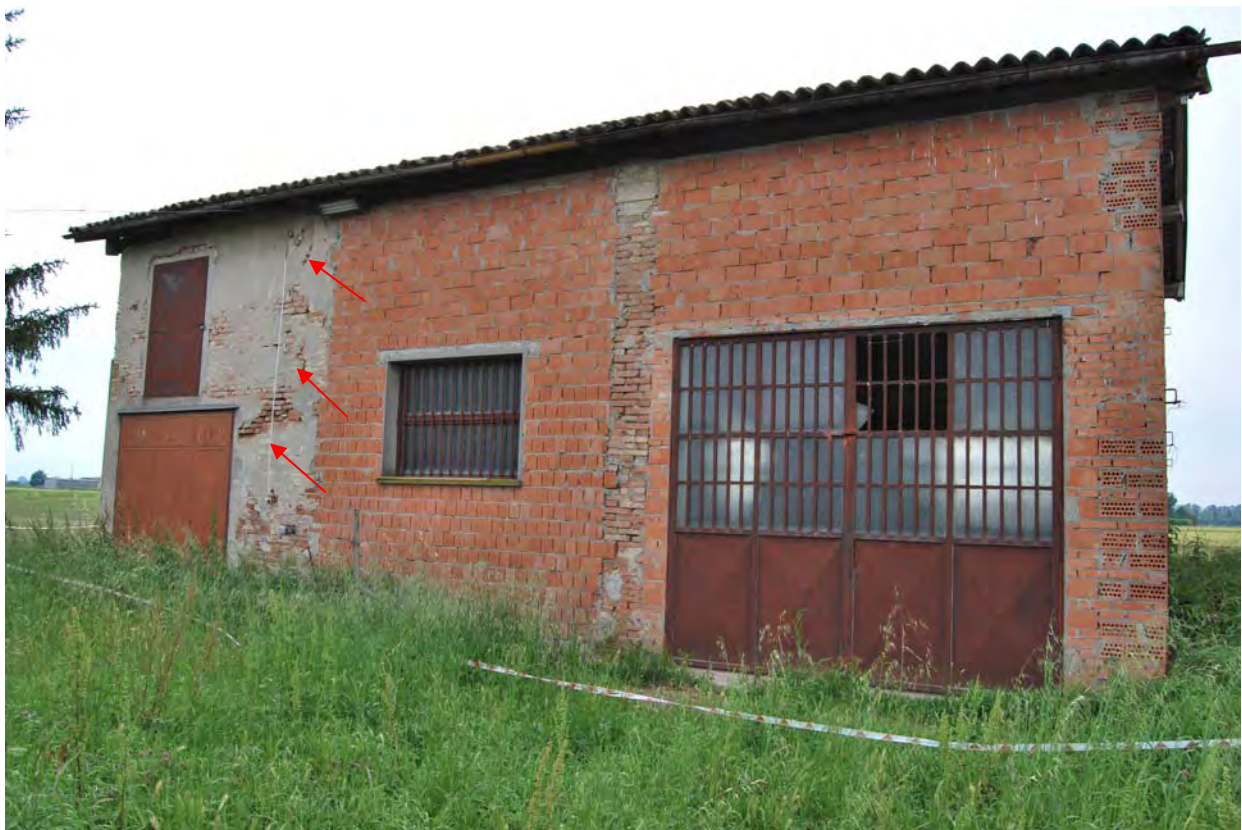
Presenza di lesioni passanti sulle murature perimetrali portanti che interessano in alcuni casi il distacco tra i paramenti murari.
