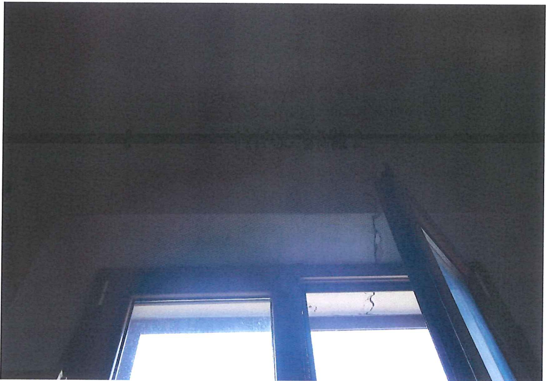
FOTO 41 = Interno – Lesione delle piattabande
