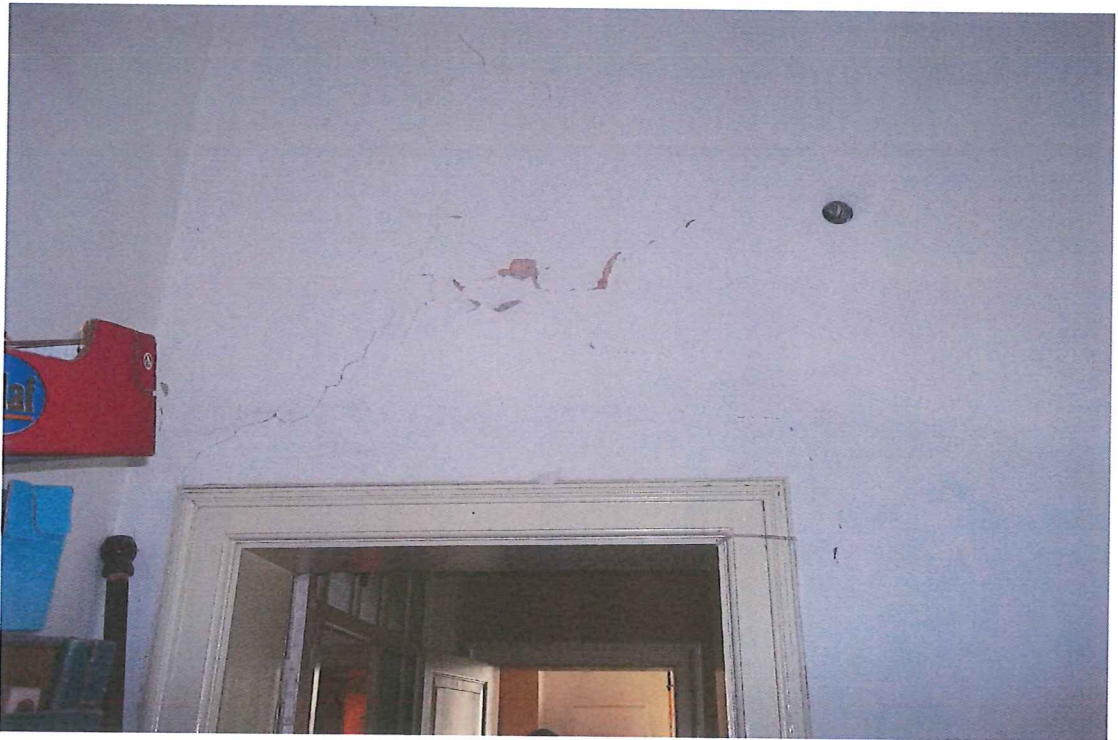
FOTO 26 = Interno – Lesione di una piattabanda
