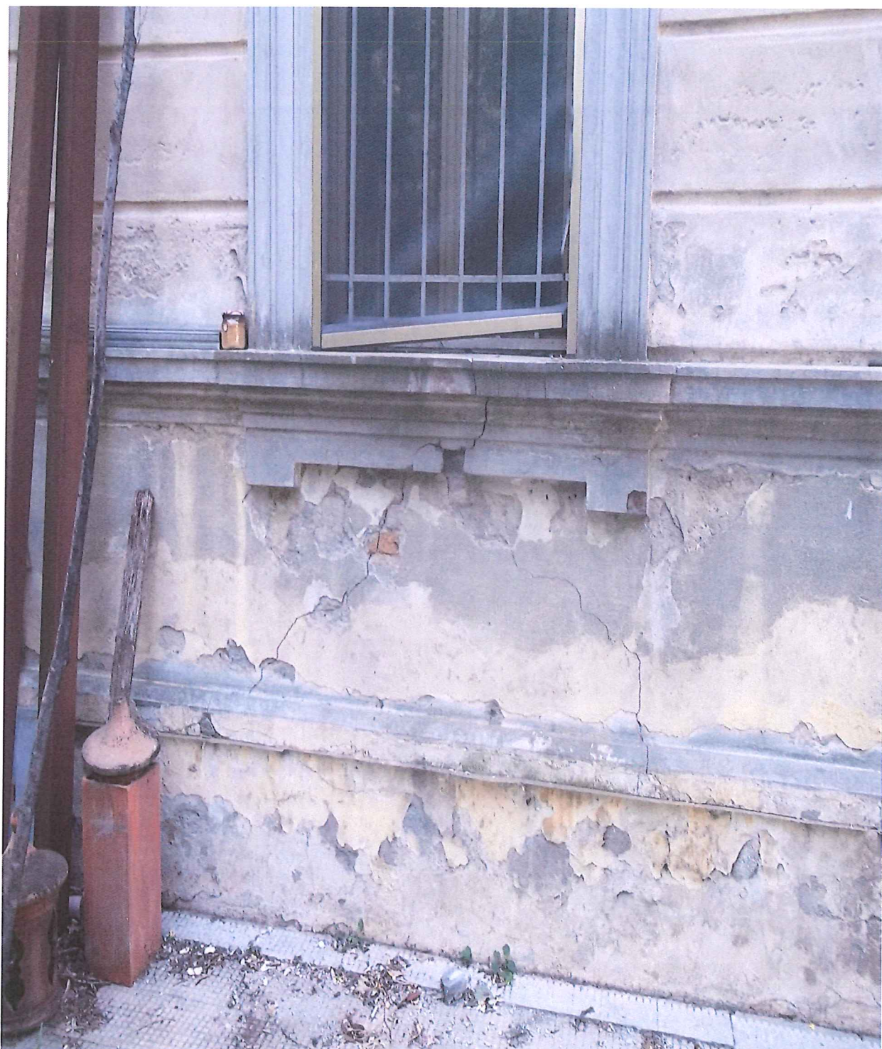
FOTO 16 = Prospetto laterale – Dettaglio della lesione di un bancale
