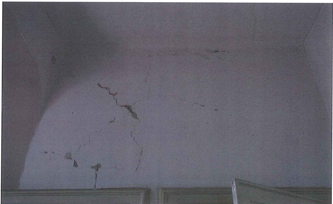
FOTO 37 = Interno – Lesione delle piattabande (Muro a una testa)
