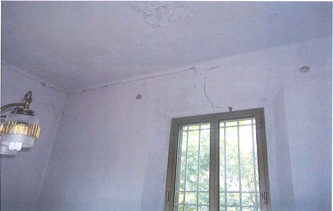
FOTO 23 = Interno – Lesione delle piattabande
