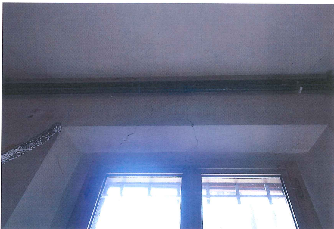
FOTO 29 = Interno – Lesione delle piattabande
