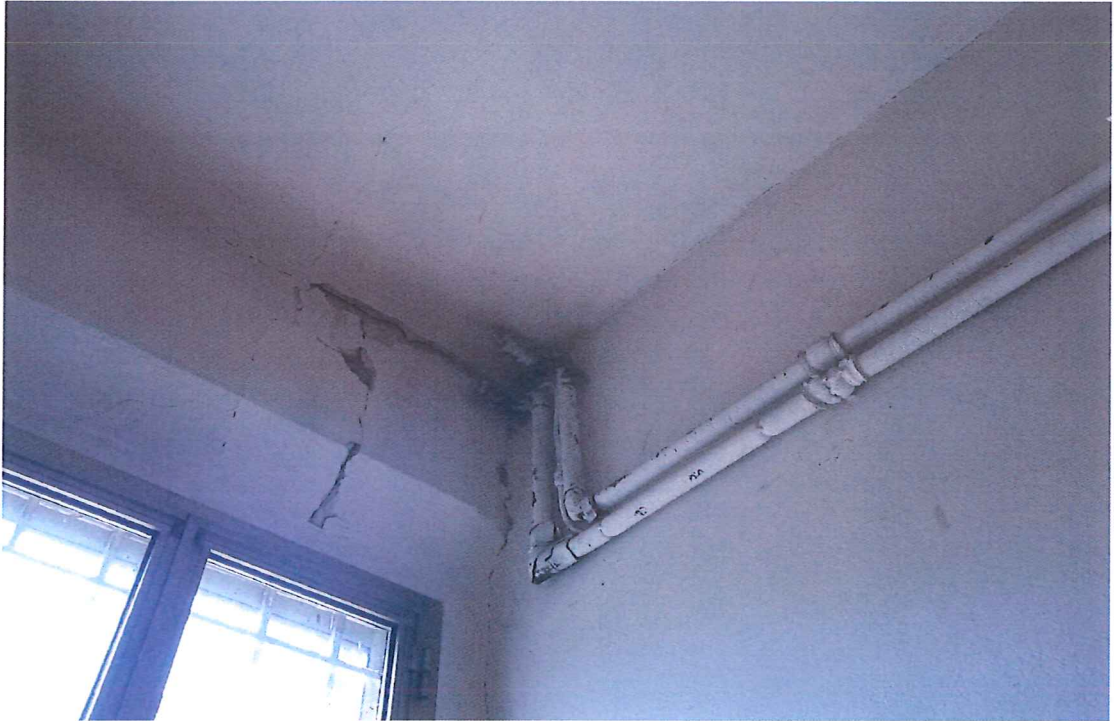
FOTO 32 = Interno – Lesione delle piattabande
