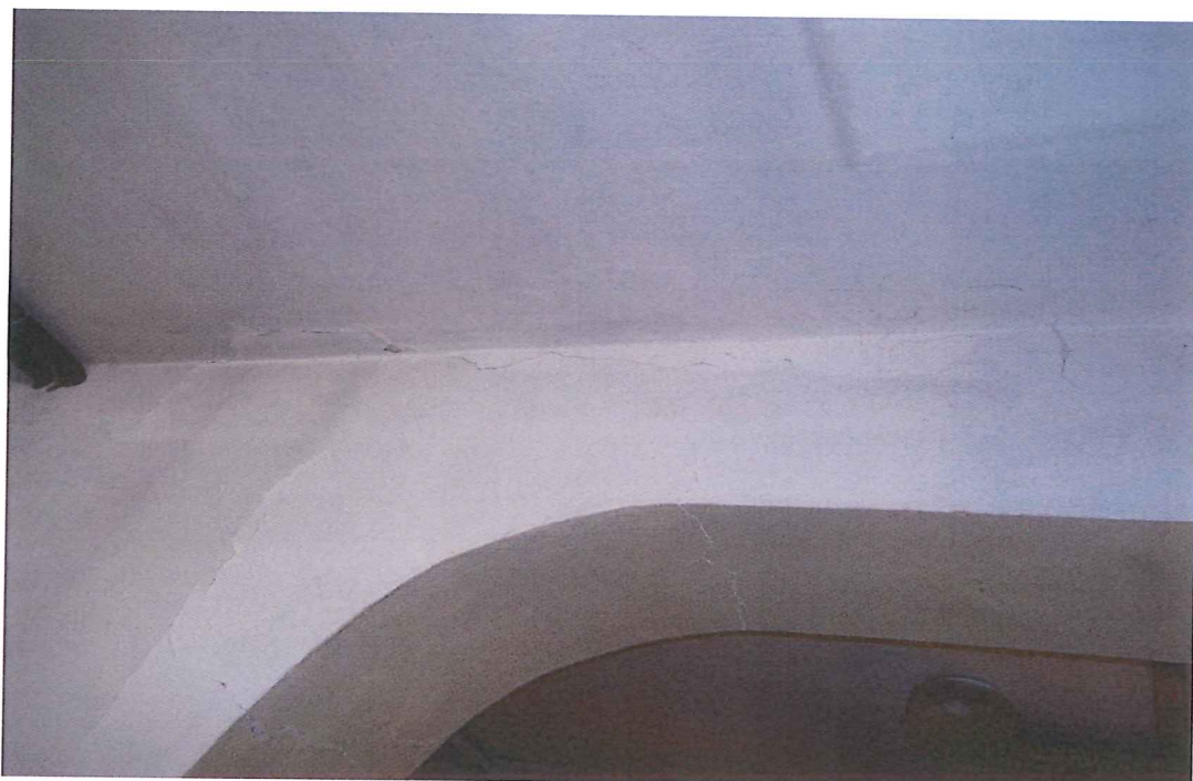
FOTO 30 = Lesione in corrispondenza dell'attacco della scala con l'arco in muratura
