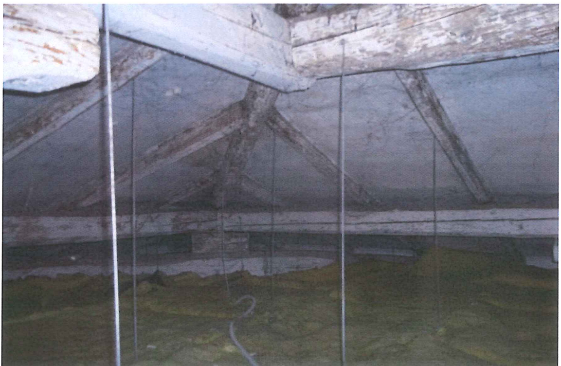
FOTO 54 = Dettaglio della copertura – Da notare le tracce di infiltrazioni di acqua
