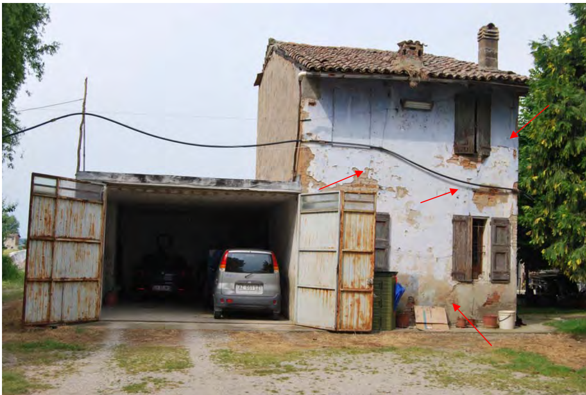
Presenza di lesioni passanti con andamento diagonale sulle murature perimetrali e precarietà della struttura di copertura.
