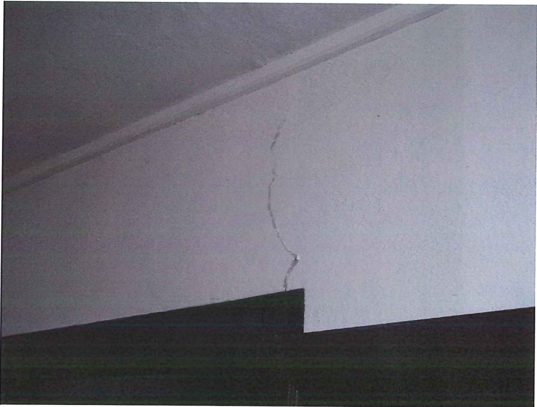
FOTO 23 = Interno – Lesione delle piattabande
