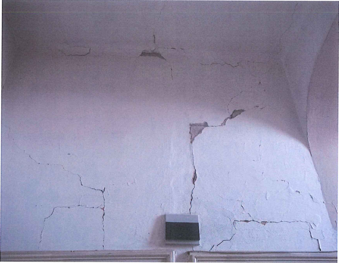
FOTO 36 = Interno – Lesione delle piattabande (Muro a una testa)
