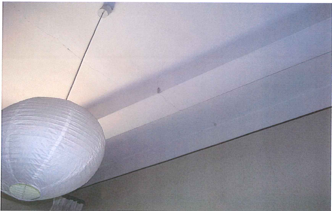
FOTO 45 =Interno - Lesione ai controsoffitti
