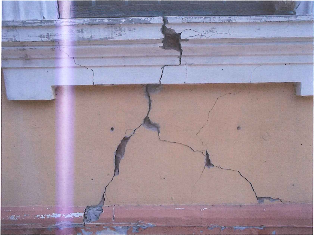
FOTO 2 = Prospetto principale – Dettaglio della lesione di un bancale
