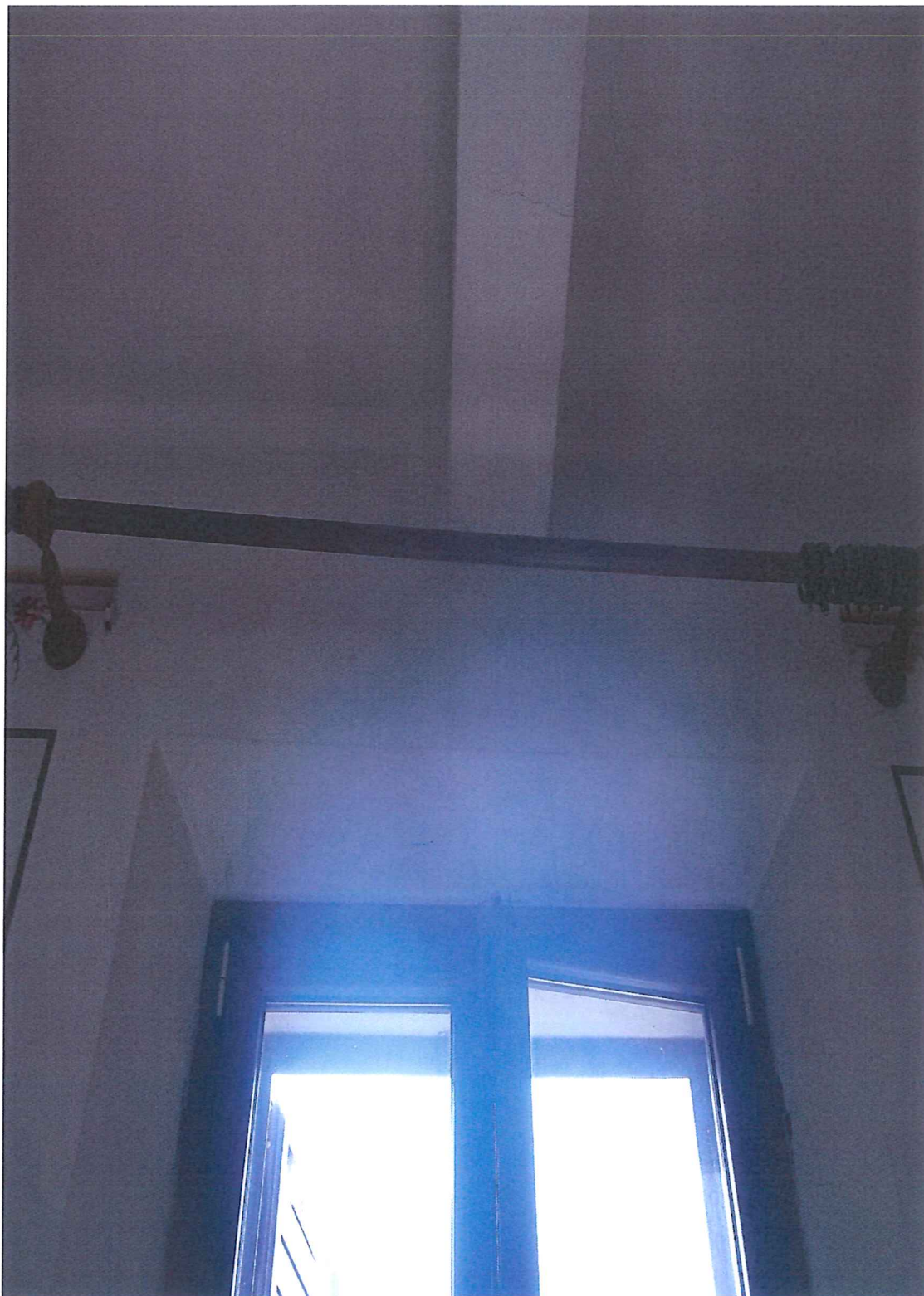
FOTO 49 = Lesione della piattabanda con appoggio trave lignea di solaio
