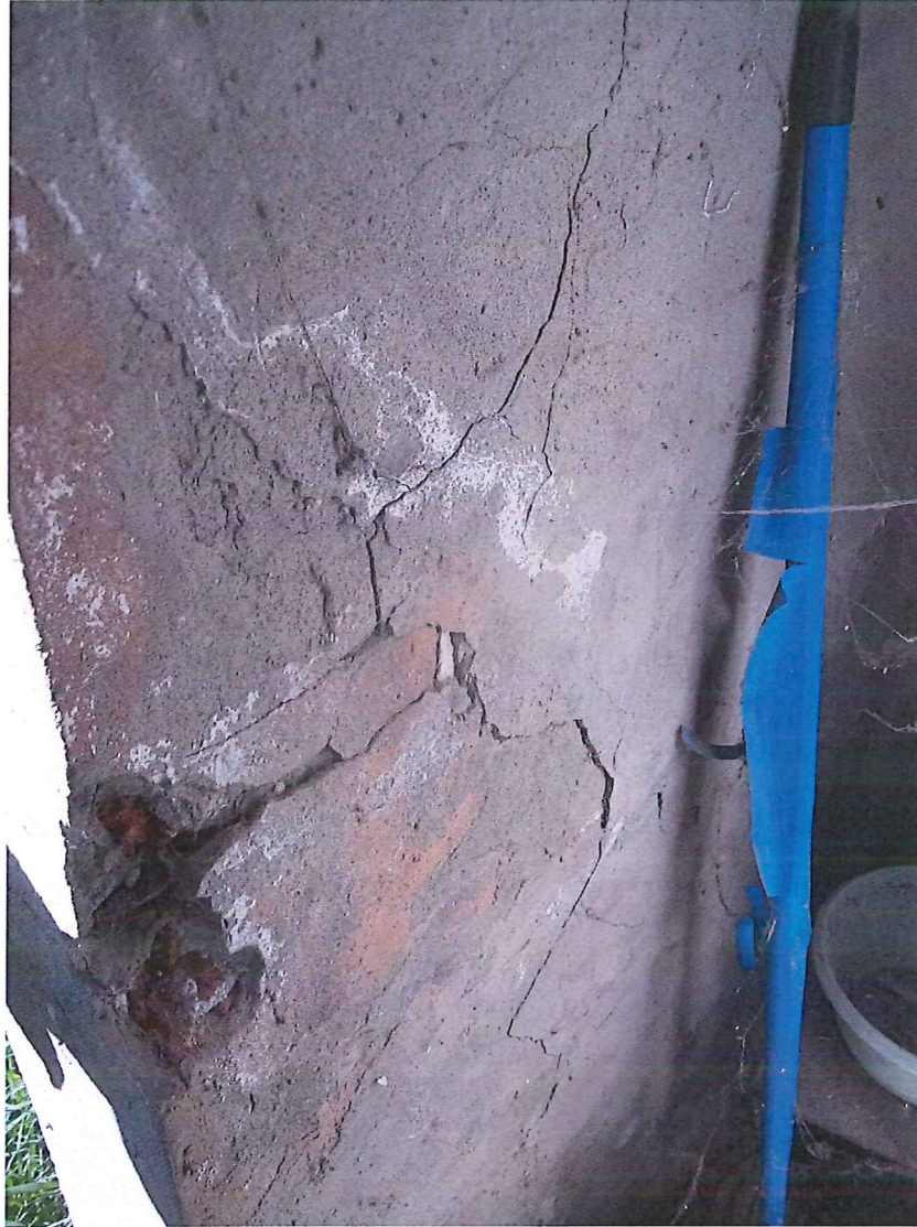
FOTO 19 = Interno – Lesione verticale lato finestra
