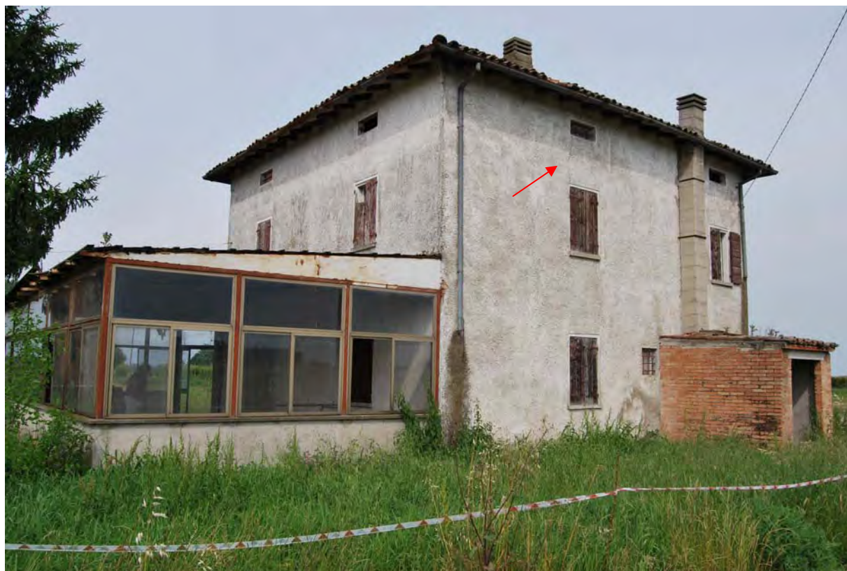
Presenza di lesioni passanti sulle murature perimetrali portanti.
