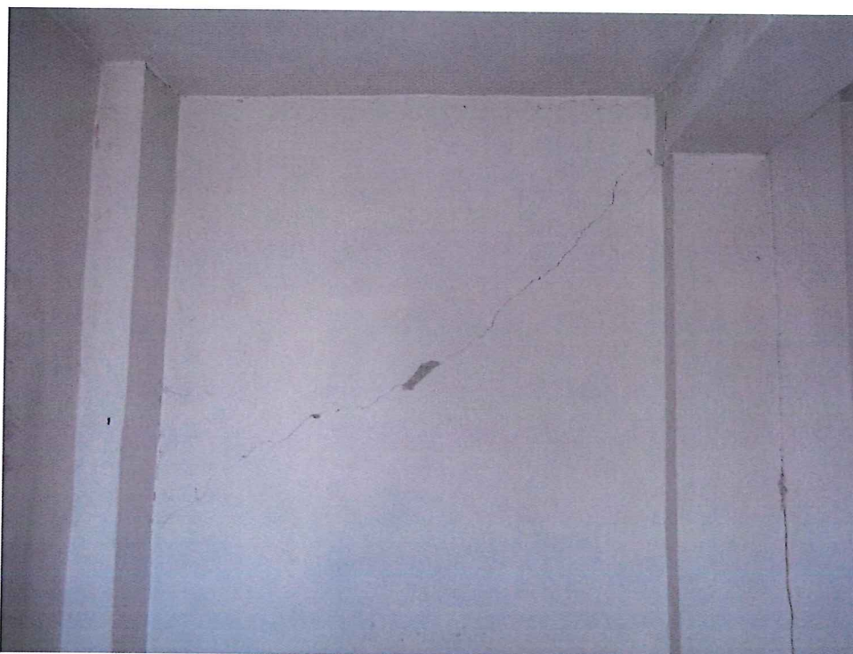
FOTO 30 = Interno – Lesione diagonale di un setto
