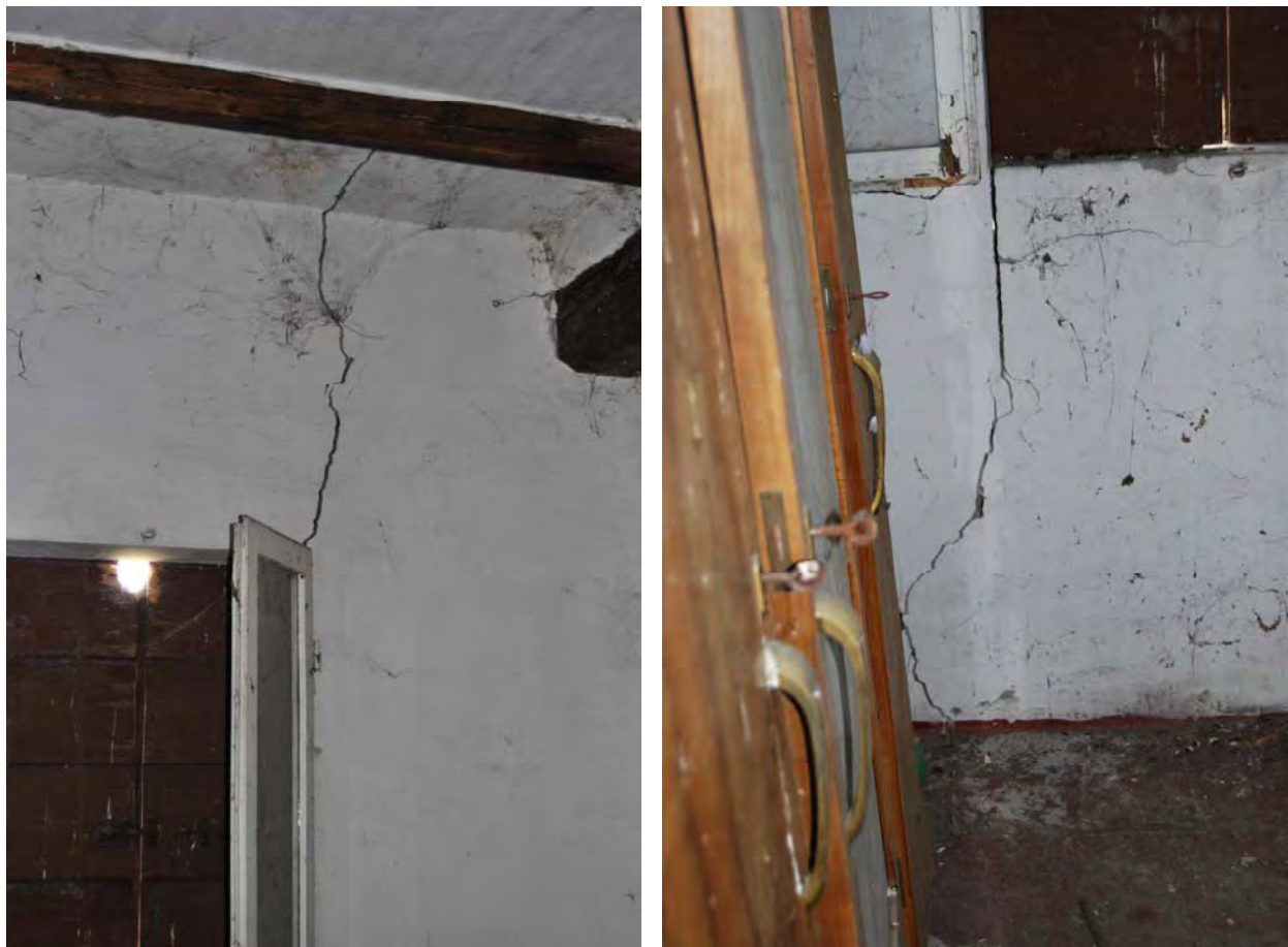
Presenza di lesioni passanti sulle murature perimetrali portanti.
