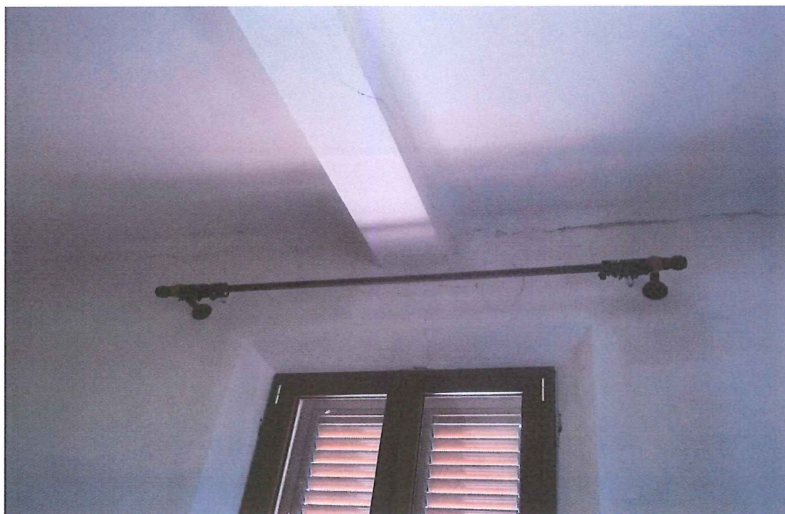
FOTO 39 = Lesione della piattabanda con appoggio trave lignea di solaio
