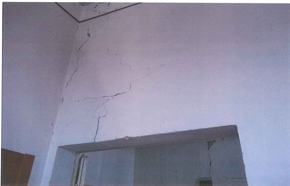
FOTO 47 = Interno – Lesione delle piattabande (Muro a una testa)
