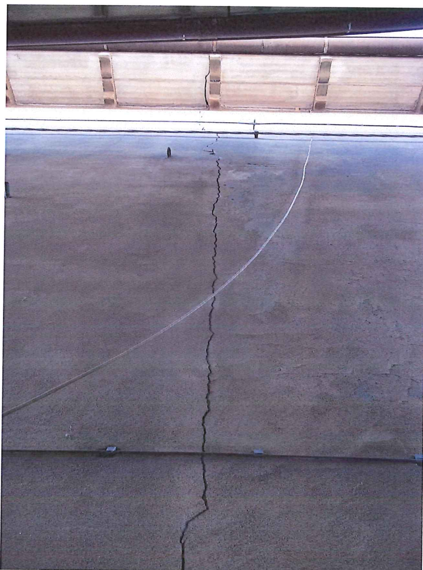
FOTO 10 = Prospetto sulla corte interna – Dettaglio di una lesione verticale e lesione nei tavelloni di coperto
