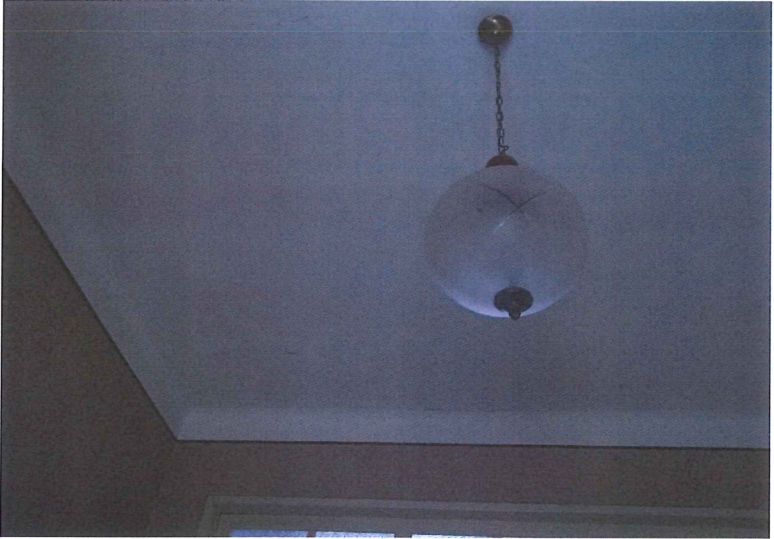
FOTO 22 = Interno – Lesione dei controsoffitti
