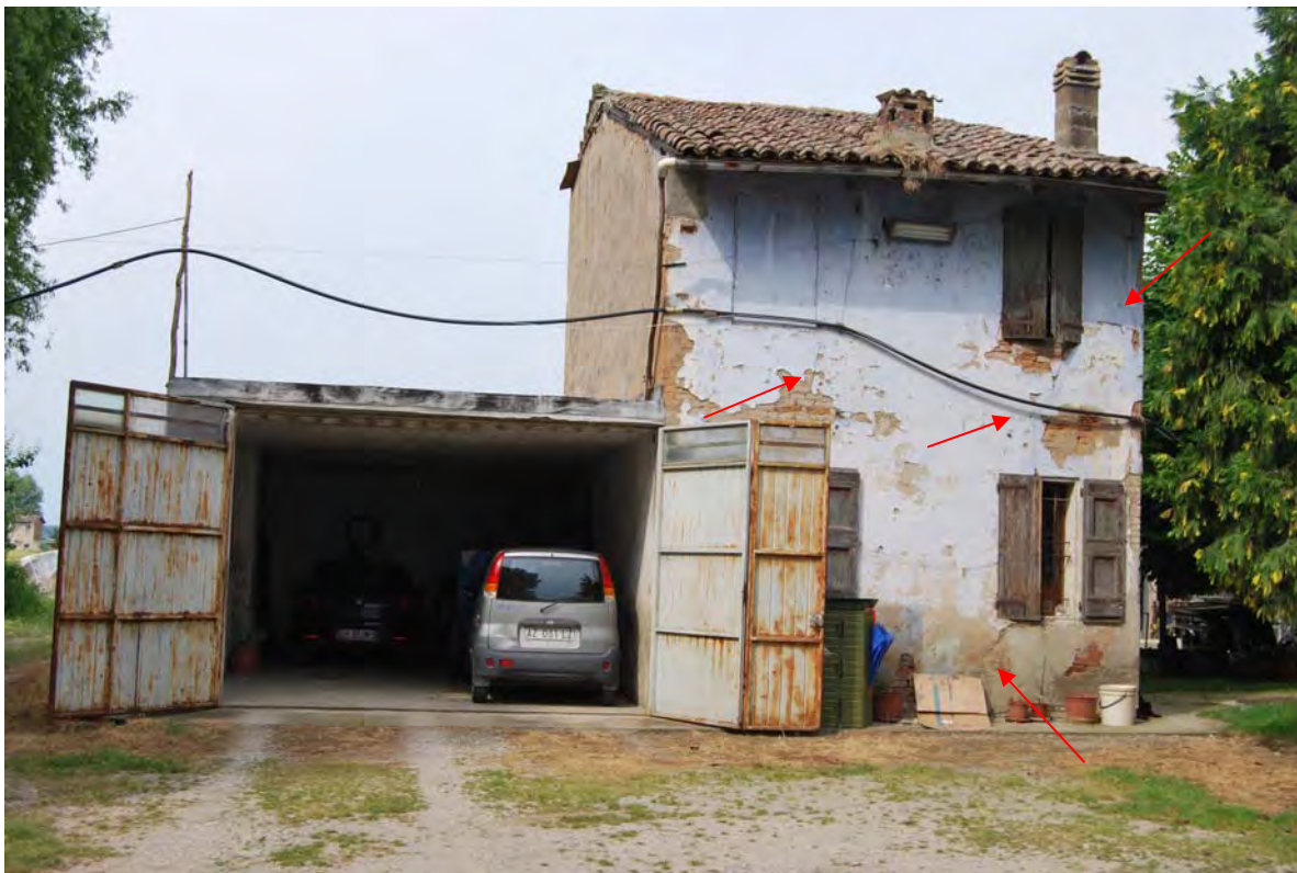
Presenza di lesioni passanti con andamento diagonale sulle murature perimetrali e precarietà della struttura di copertura.
