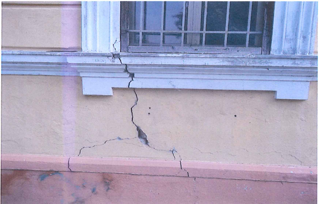
FOTO 3 = Prospetto principale – Dettaglio della lesione di un bancale
