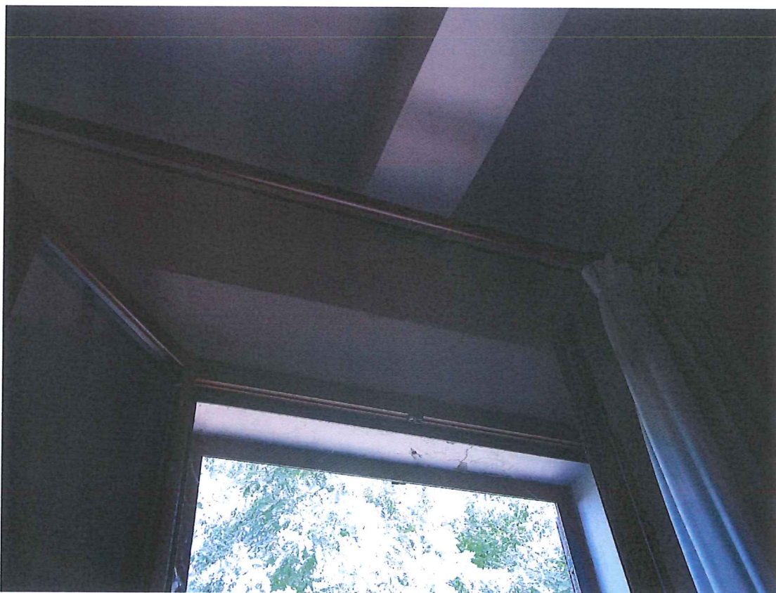
FOTO 46 = Lesione della piattabanda con appoggio trave lignea di solaio
