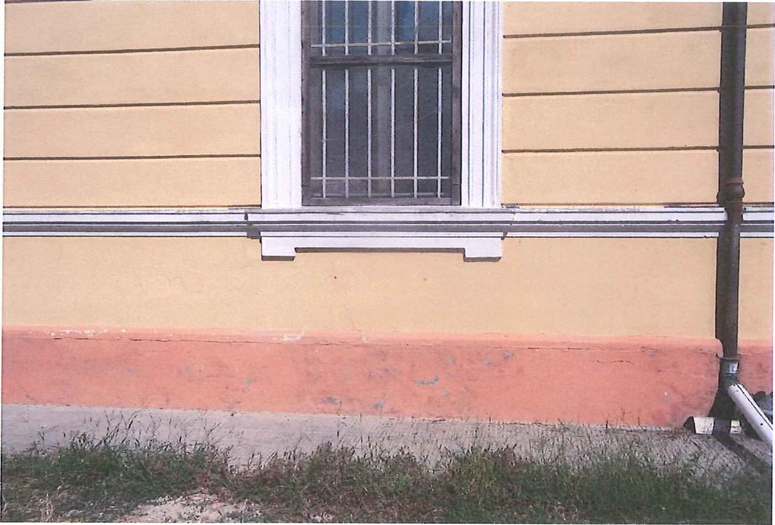
FOTO 11 = Prospetto laterale – Dettaglio della lesione di un bancale
