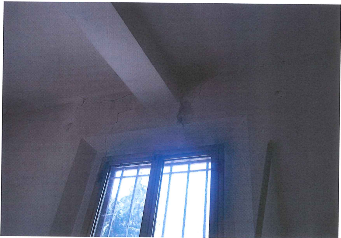
FOTO 27 = Lesione della piattabanda con appoggio trave lignea di solaio
