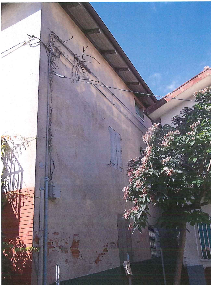
FOTO 9 = Prospetto laterale – Dettaglio della caduta degli intonaci
