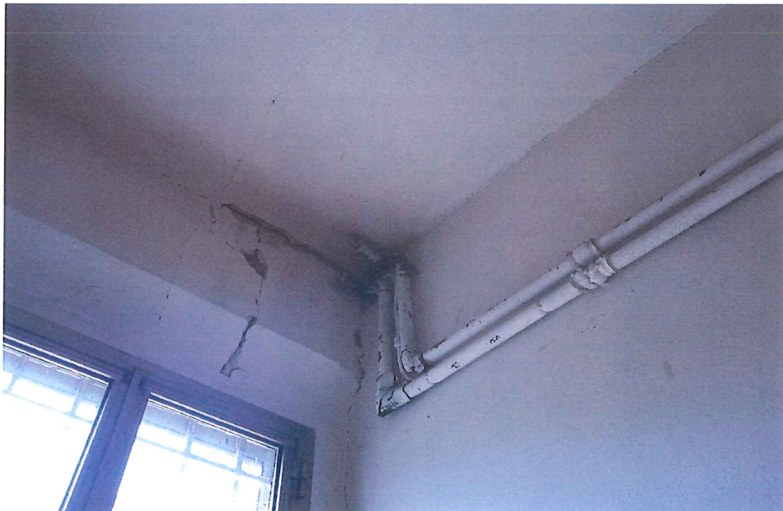
FOTO 32 = Interno – Lesione delle piattabande
