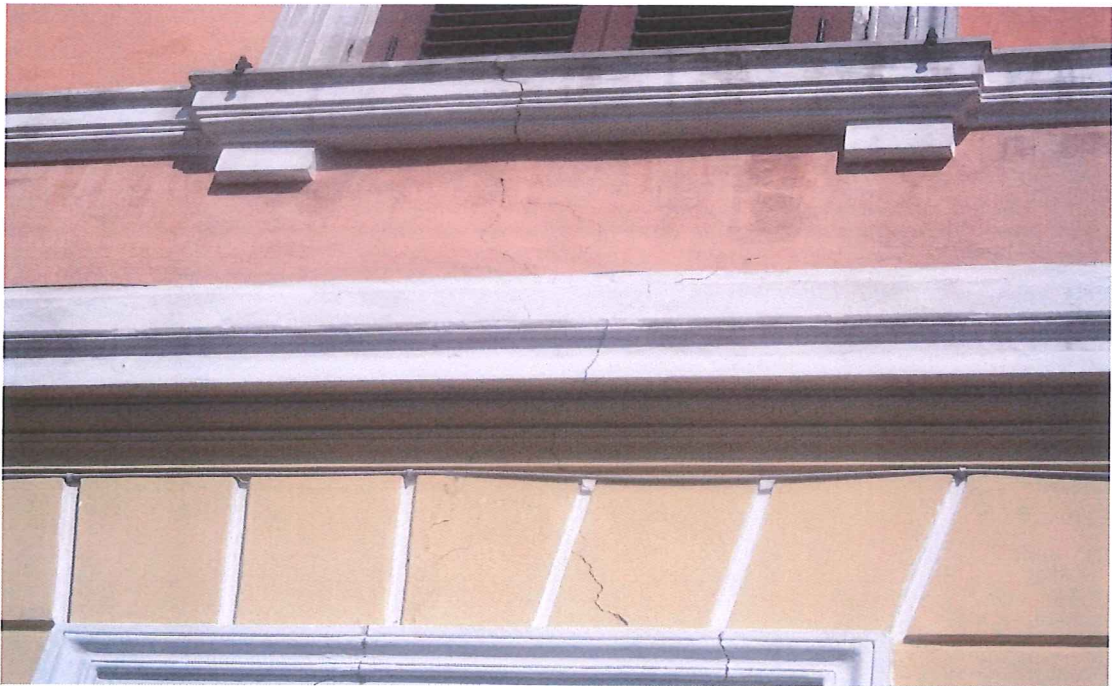
FOTO 12 = Prospetto laterale – Dettaglio della lesione di una pattabanda
