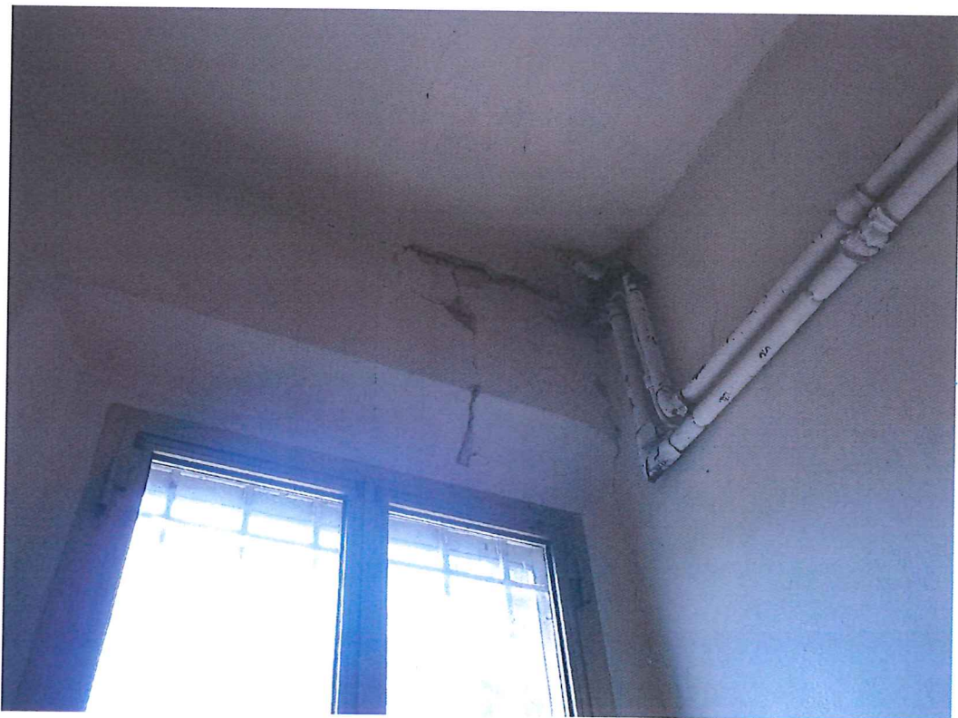
FOTO 31 = Interno – Lesione delle piattabande
