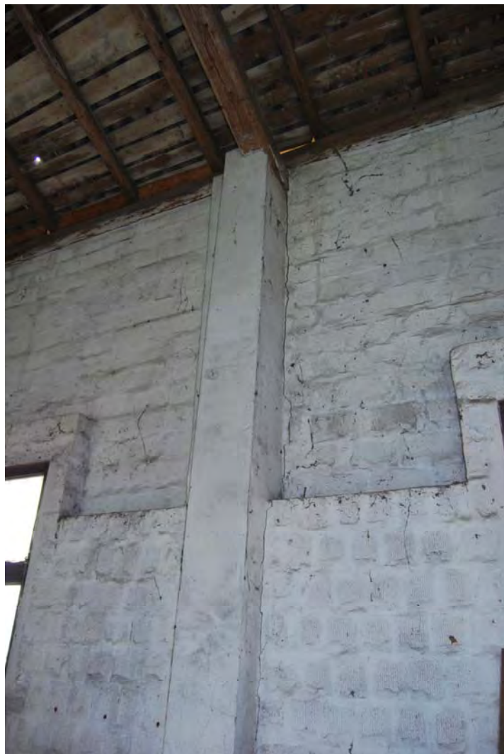
Presenza di lesioni per distacco tra i pilastri portanti in mattoni pieni e i tamponamenti in mattoni forati.
