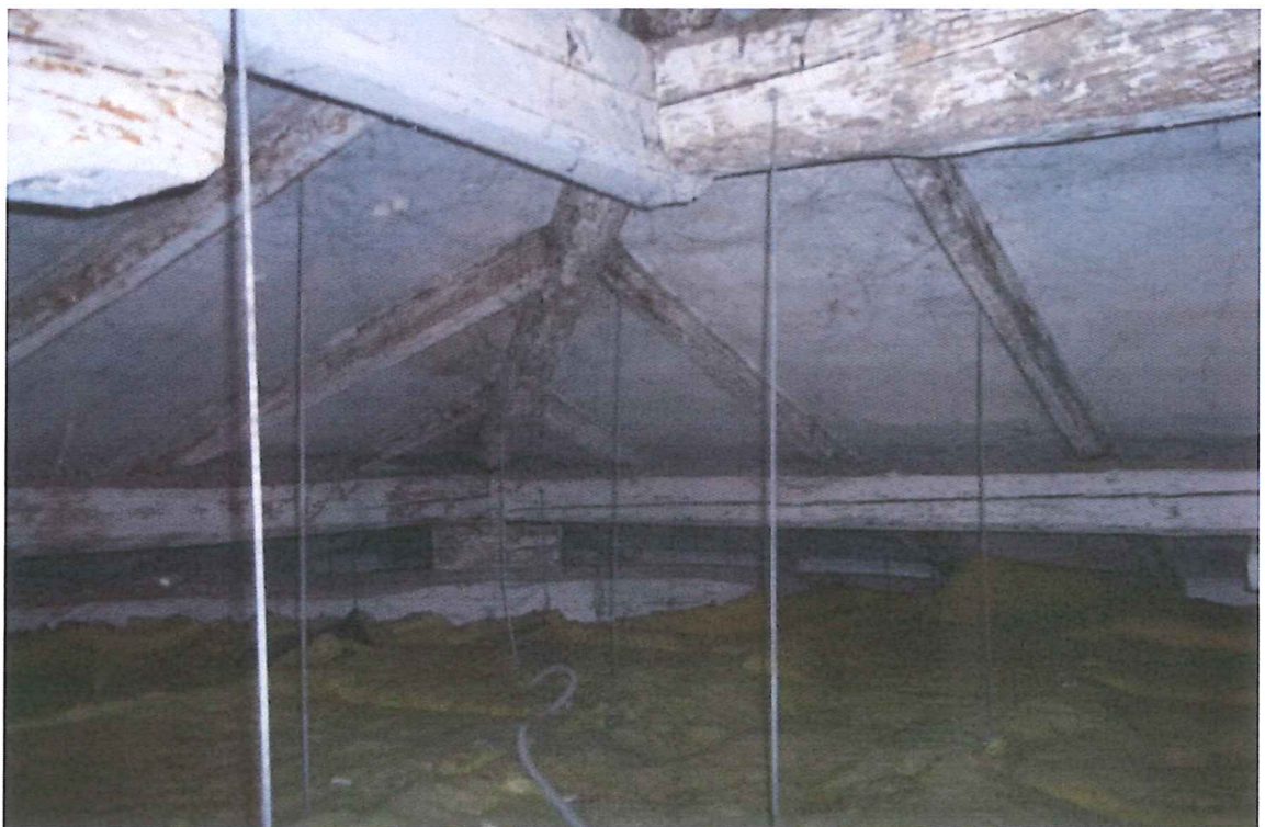
FOTO 54 = Dettaglio della copertura – Da notare le tracce di infiltrazioni di acqua
