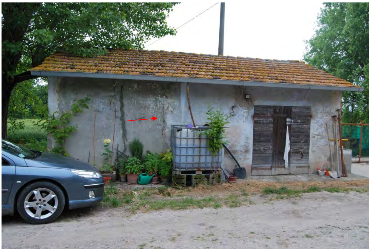
Presenza di lesioni passanti con andamento verticale sulle murature perimetrali.
