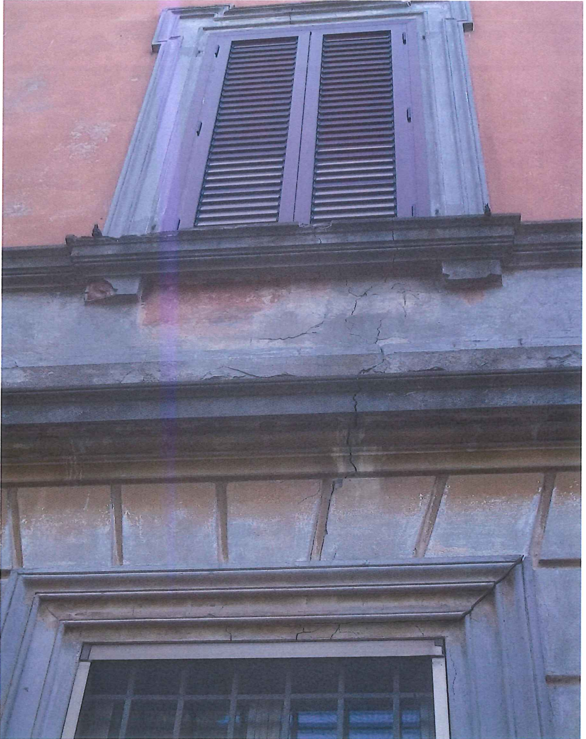
FOTO 17 = Prospetto laterale – Dettaglio della lesione di una pattabanda
