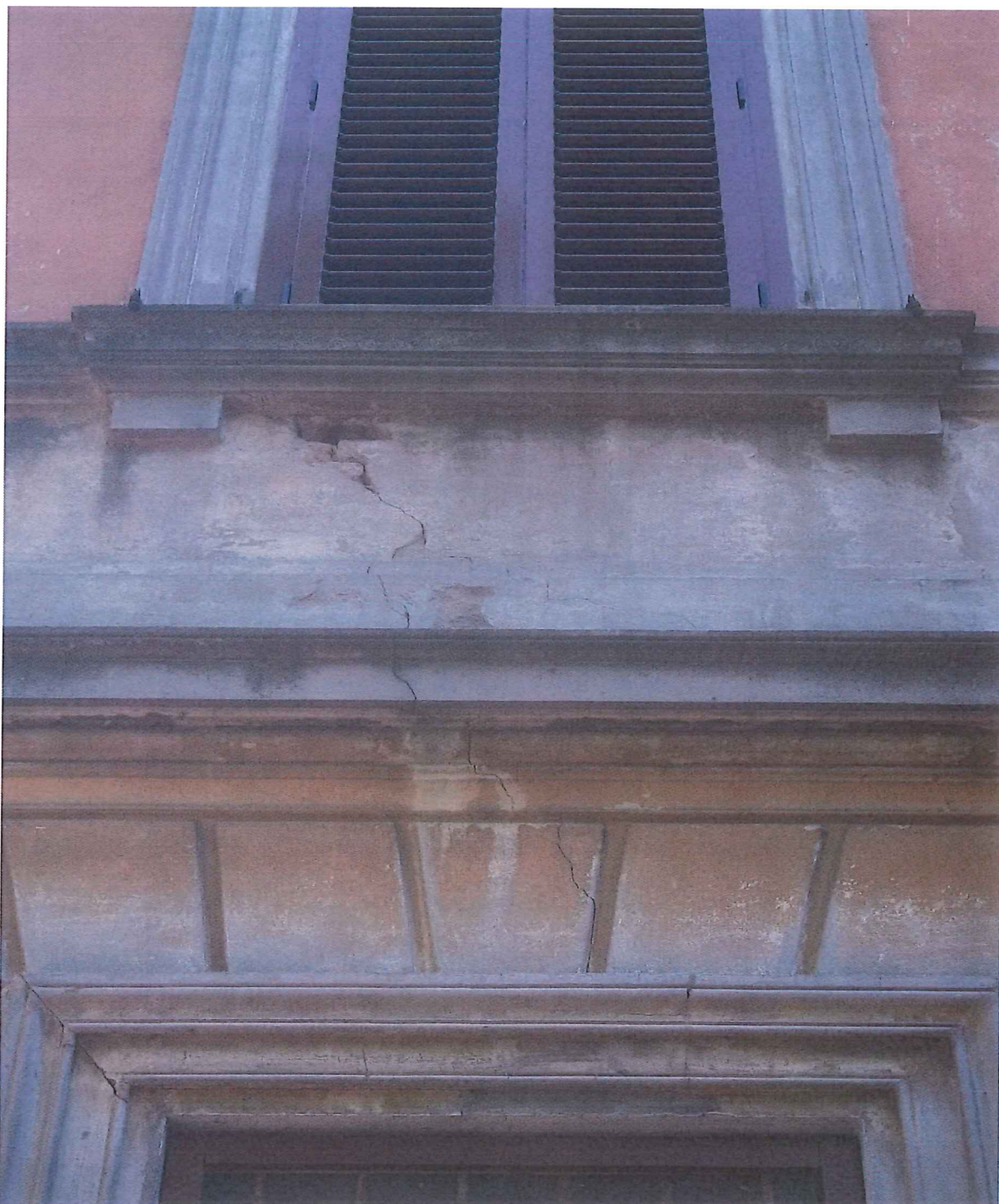
FOTO 19 = Prospetto laterale – Dettaglio della lesione di una pattabanda
