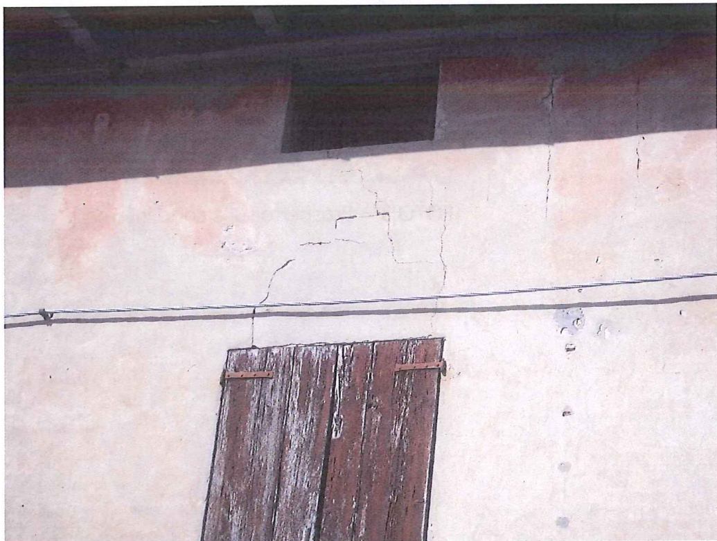
FOTO 5 = Prospetto principale – Dettaglio della lesione di una pattabanda
