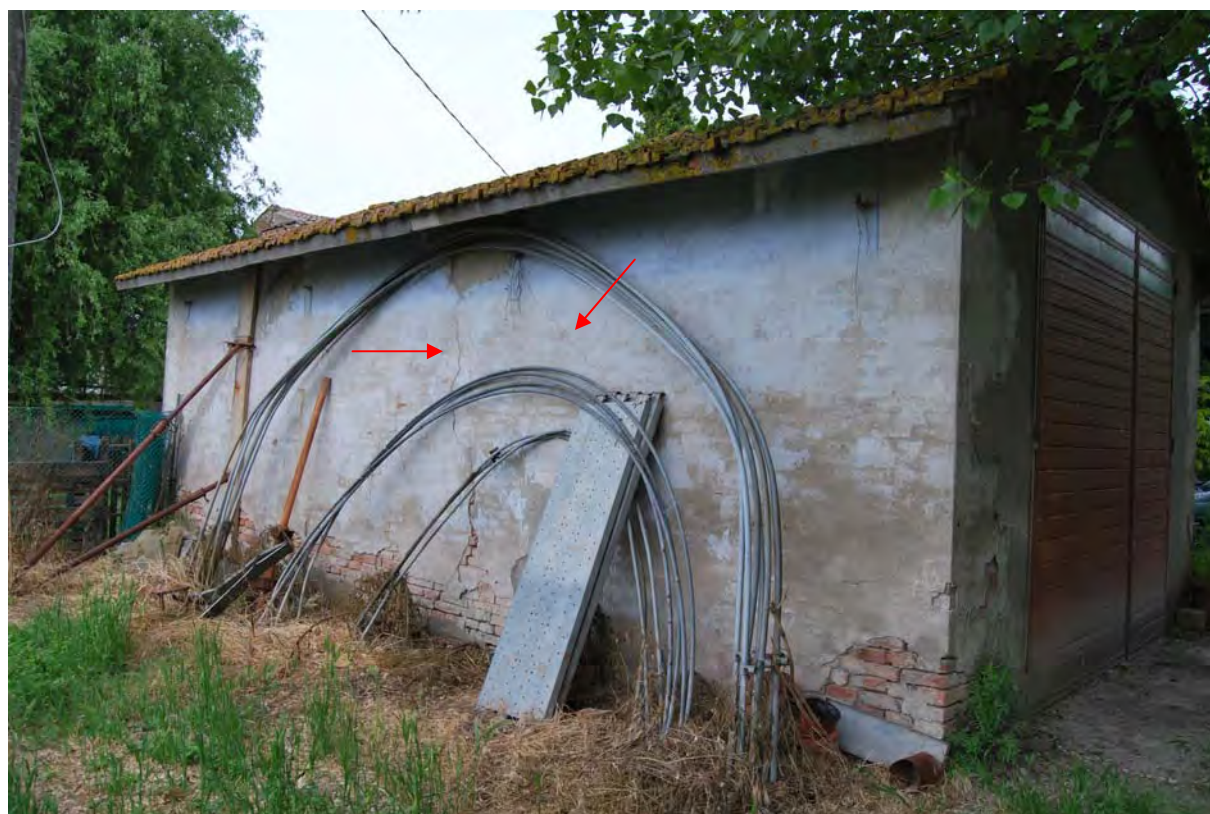
Presenza di lesioni passanti con andamento verticale e diagonale sulle murature perimetrali.
