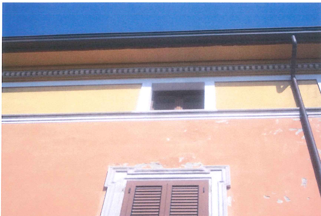
FOTO 13 = Prospetto laterale – Dettaglio della lesione di una pattabanda
