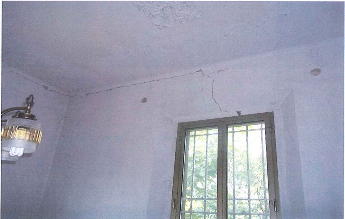
FOTO 23 = Interno – Lesione delle piattabande
