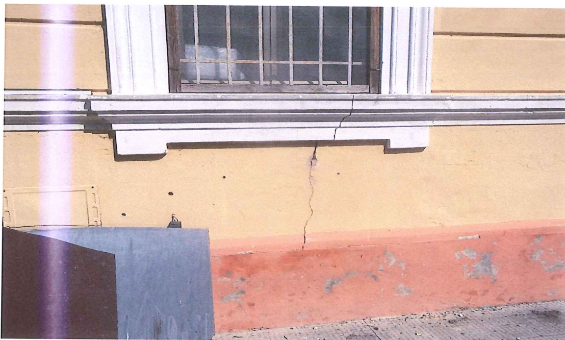
FOTO 9 = Prospetto laterale – Dettaglio della lesione di un bancale
