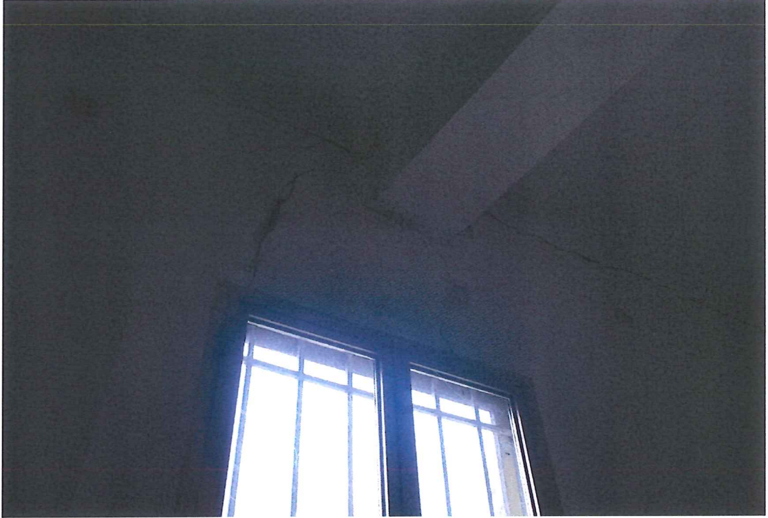
FOTO 24 = Lesione della piattabanda con appoggio trave lignea di solaio
