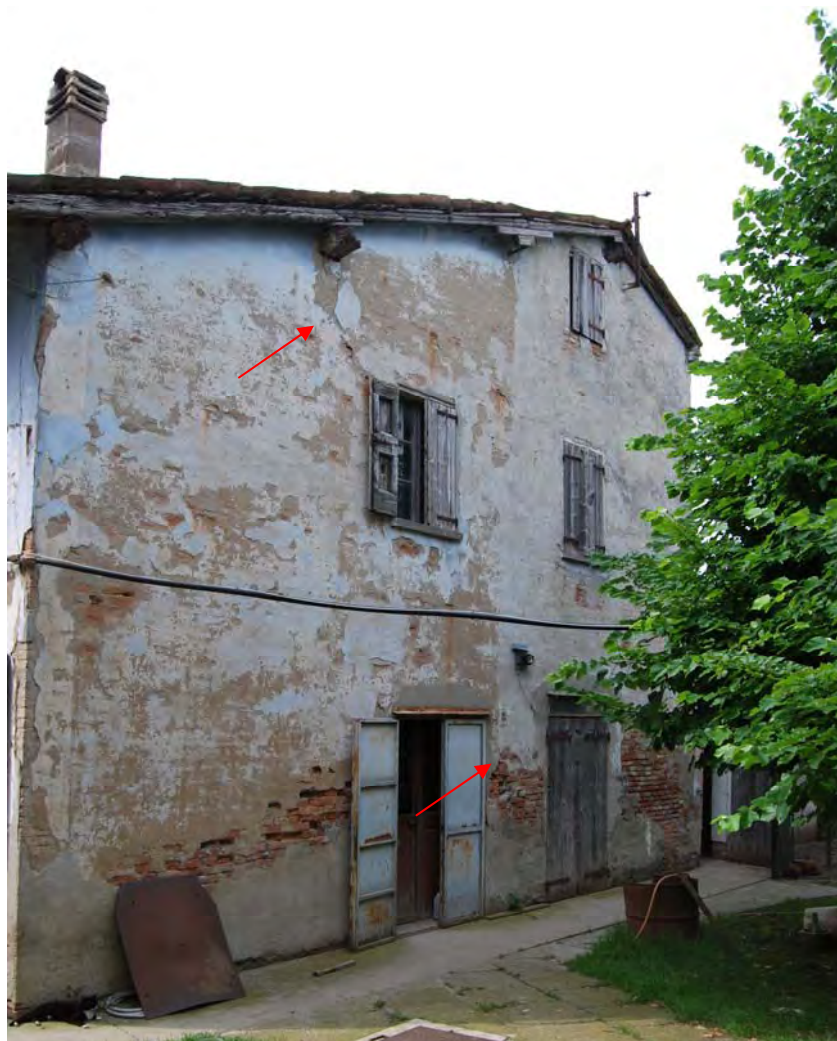
Presenza di lesioni passanti con andamento diagonale sulle murature perimetrali.
