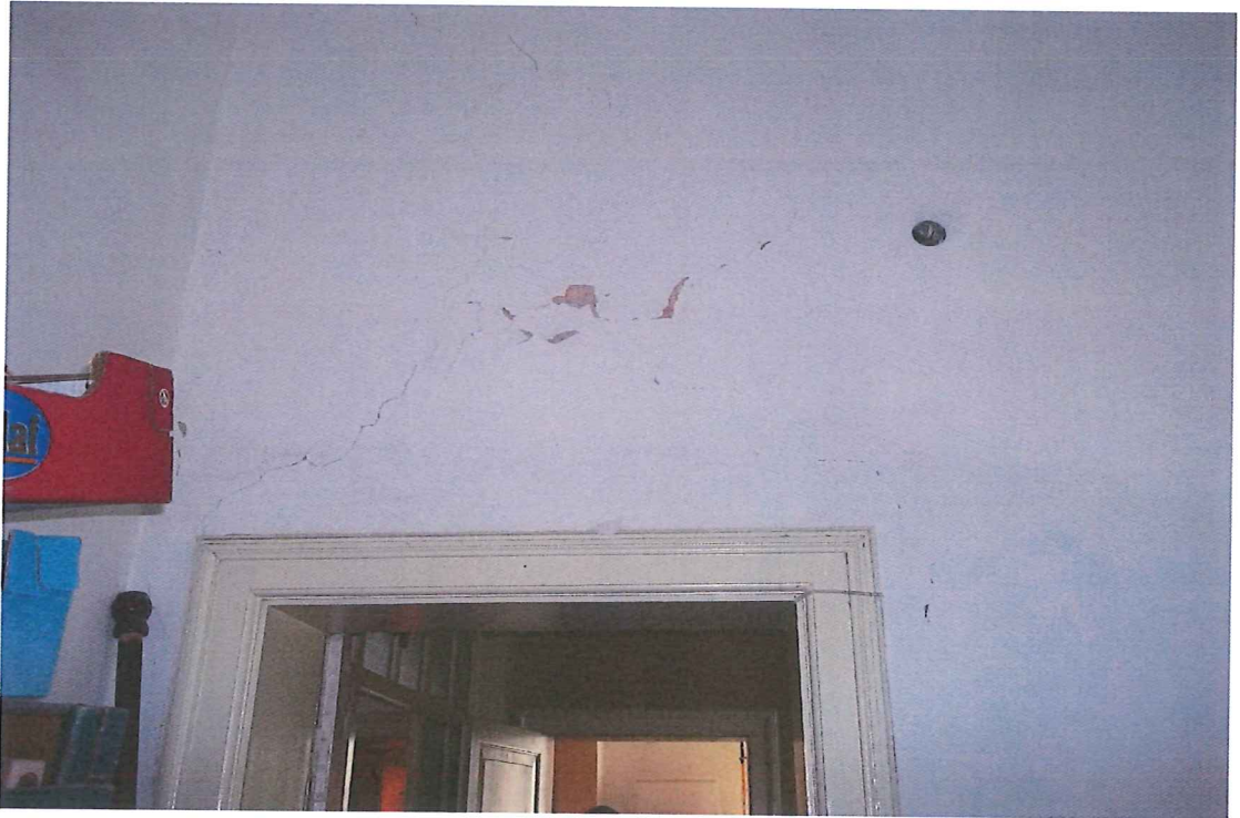
FOTO 26 = Interno – Lesione di una piattabanda
