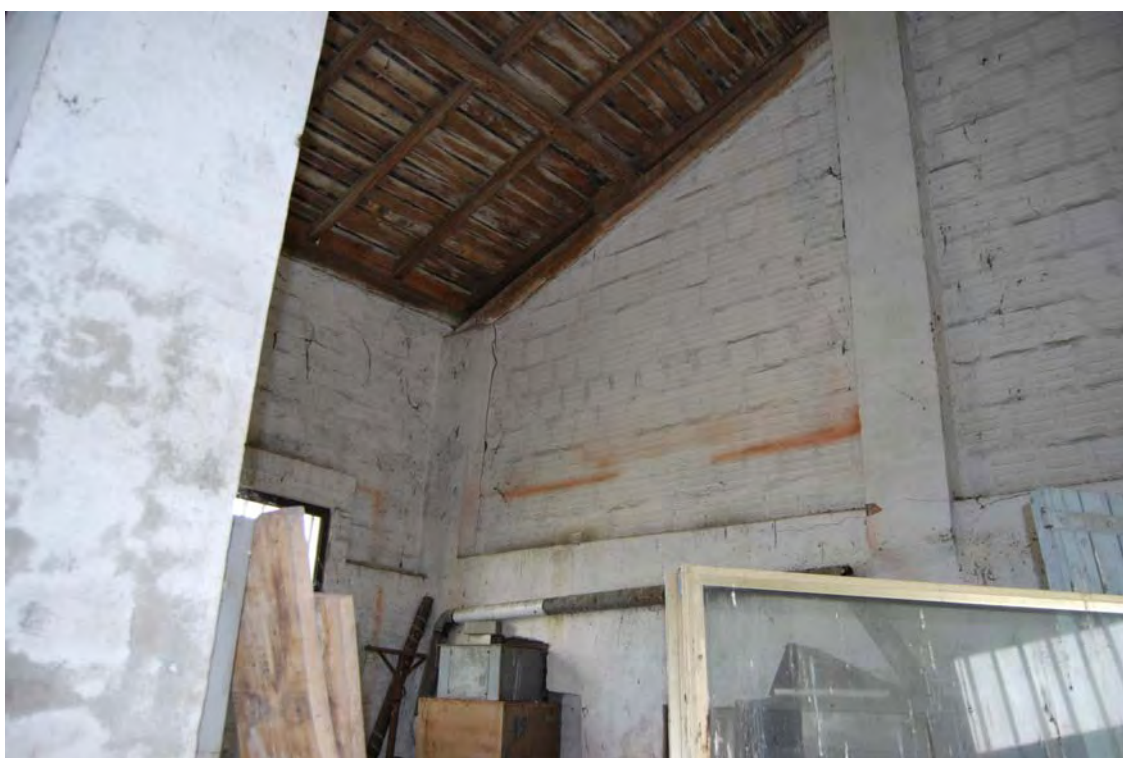
Presenza di lesioni per distacco tra i pilastri portanti in mattoni pieni e i tamponamenti in mattoni forati.
