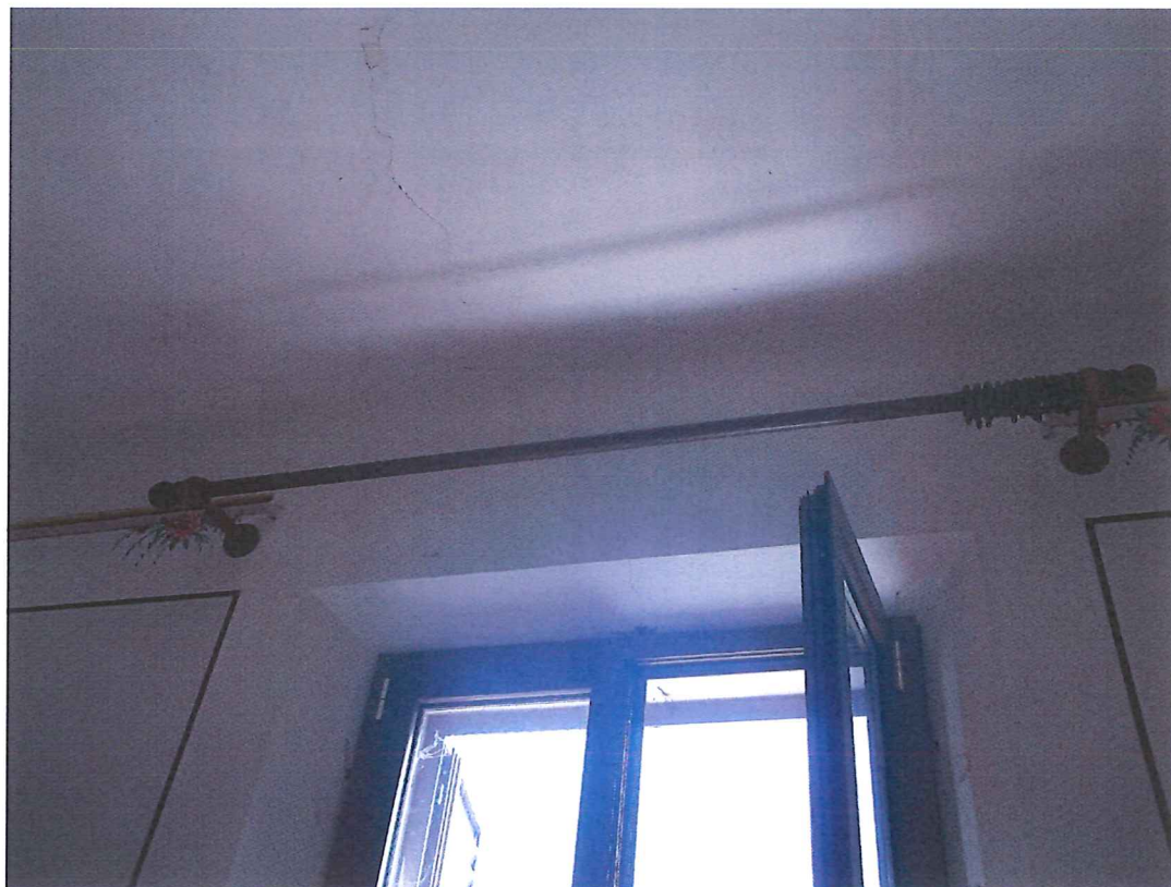
FOTO 48 = Interno – Lesione delle piattabande
