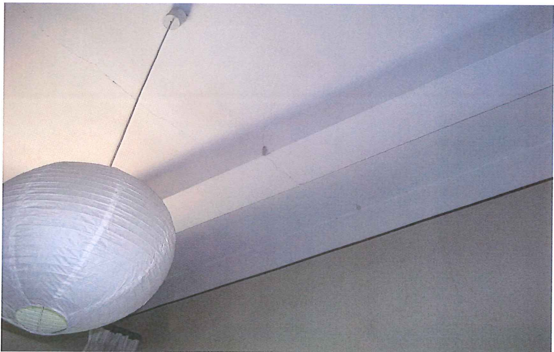
FOTO 45 =Interno - Lesione ai controsoffitti
