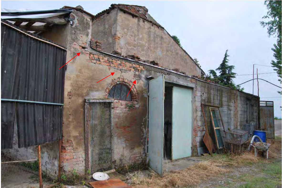
Presenza di lesioni passanti con andamento diagonale sulle murature perimetrali.
