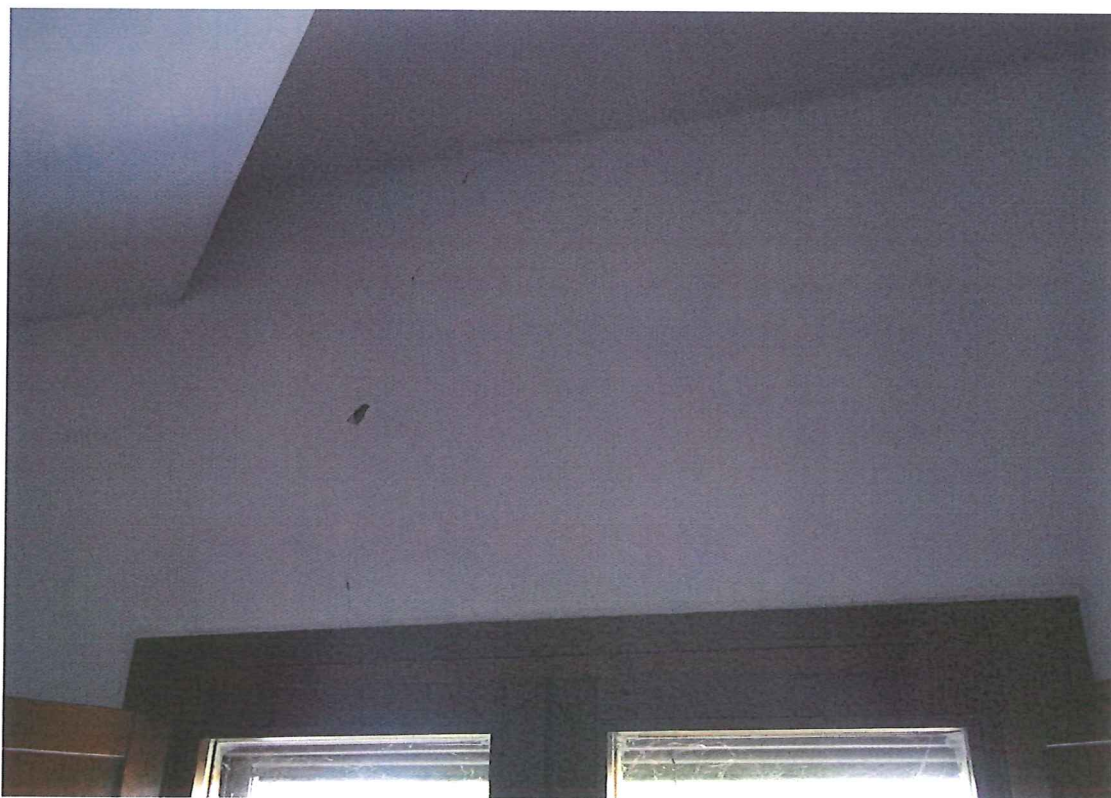
FOTO 52 = Interno – Lesione delle piattabande
