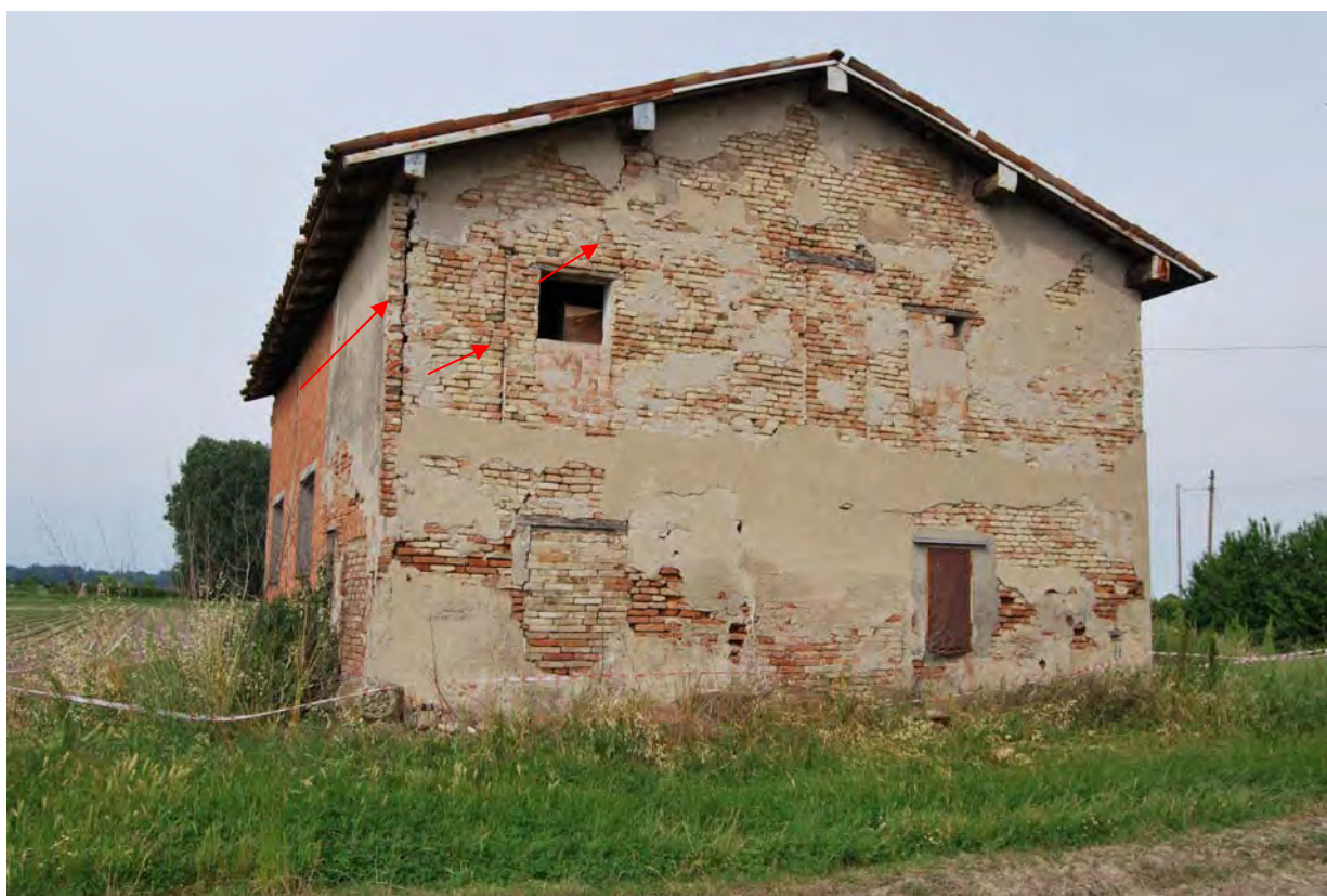
Presenza di lesioni passanti sulle murature perimetrali portanti che interessano in alcuni casi il distacco tra i paramenti murari.
