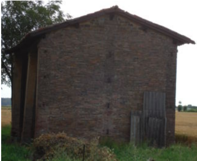
STRAPIOMBO DEL PILASTRO CENTRALE DEL LATO SUD EST DEL FABBRICATO
