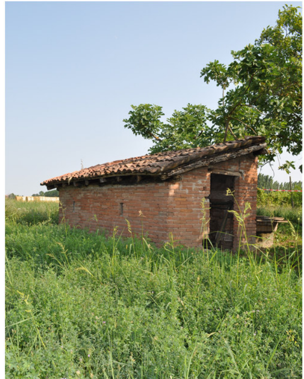
Foto 1. Vista del forno sul retro dell'abitazione
