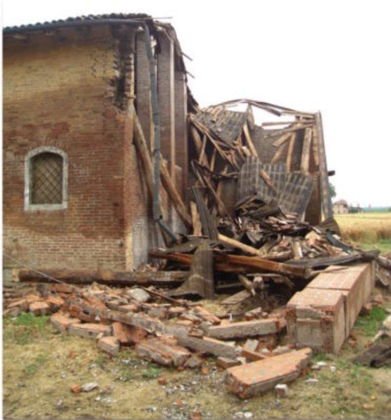
CROLLO PARZIALE DI UNA PARTE DELL'EDIFICIO
